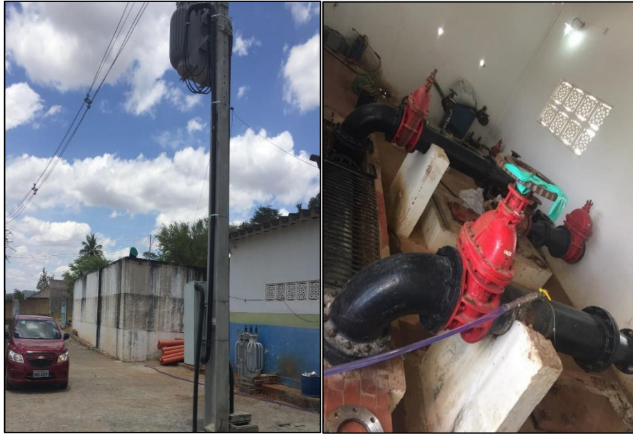
Figura 30 – Estação Elevatória de Água Tratada: EEAT III. Fonte: DRZ – Geotecnologia e Consultoria, 2017.
