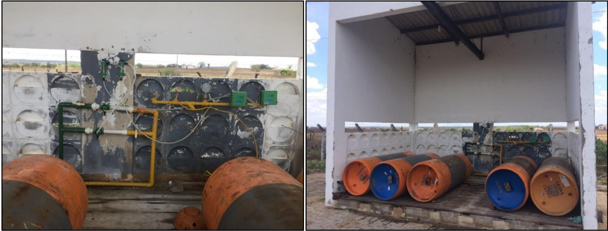
Figura 36 – Dosador de cloro gás e depósito de cilindros.
