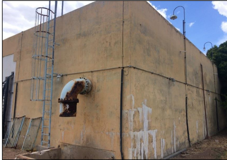
Figura 34 – Reservatório de contato para desinfecção com adição de cloro. Fonte: DRZ – Geotecnologia e Consultoria, 2017.
