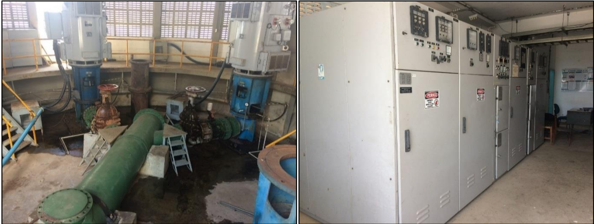
Figura 20 – Casa de bombas da captação do Sistema Coletivo da Bacia Leiteira.
