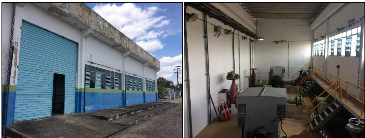
Figura 26 – Estação Elevatória de Água Tratada: EEAT II. Fonte: DRZ – Geotecnologia e Consultoria, 2017.
