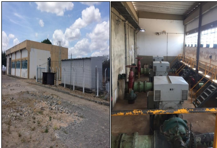
Figura 24 – Estação Elevatória de Água Tratada: EEAT I.
