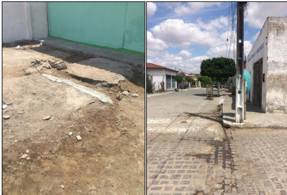
Figura 53 – Fossa rudimentar residencial e lançamento de esgoto em via pública na comunidade São Cristóvão.
