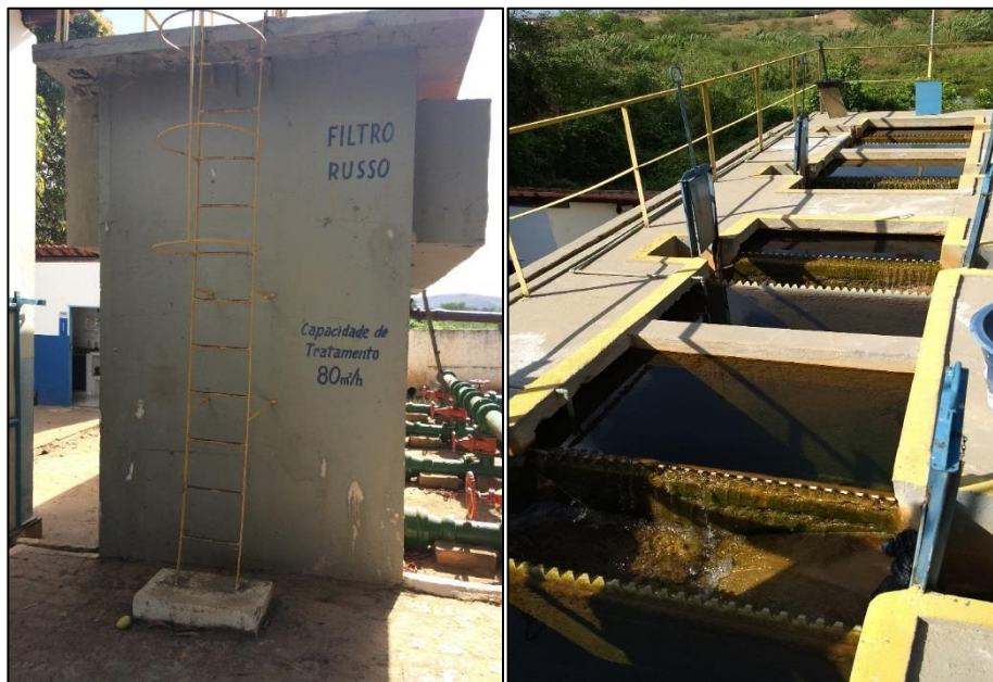
Figura 30 – Filtro russo da ETA.
