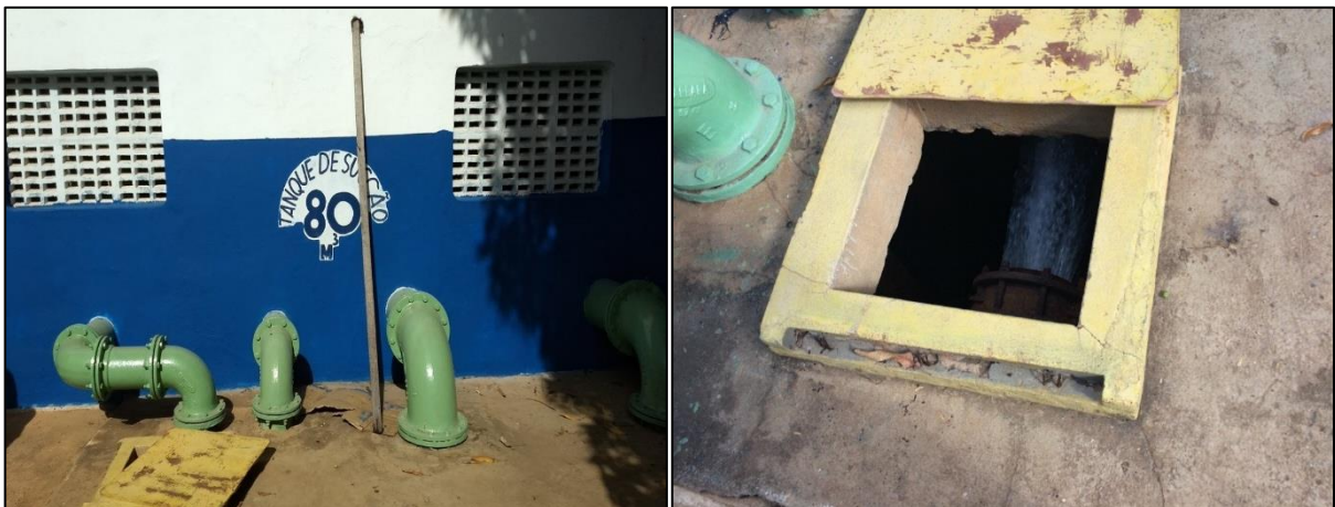
Figura 32 – Tanque de sucção (REN) de 80 m 3 , onde são aplicados os produtos químicos. Fonte: DRZ – Geotecnologia e Consultoria, 2017.
