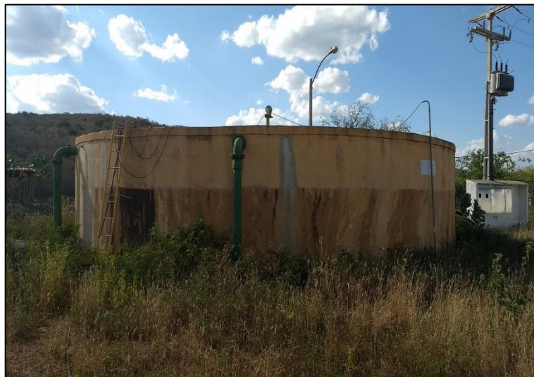
Figura 40 – Reservatório apoiado (RAP) - caixa de reunião, 300 m 3 .
