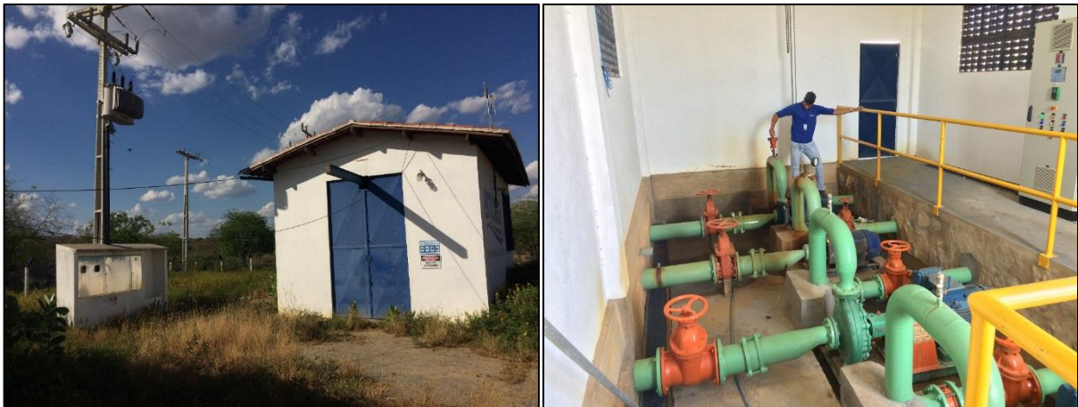
Figura 36 – Estação elevatória de água tratada do Poço 01.
