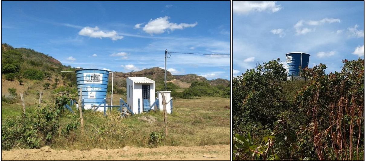
Figura 61 – Área do poço que atende a comunidade Cirica, localizado em Serra do Noel, e reservatório.
