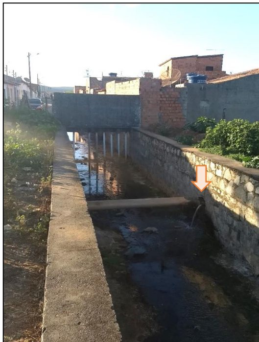
Figura 68 – Lançamento de esgoto no canal de drenagem, em área próxima às fossas. Fonte: DRZ – Geotecnologia e Consultoria, 2017.
