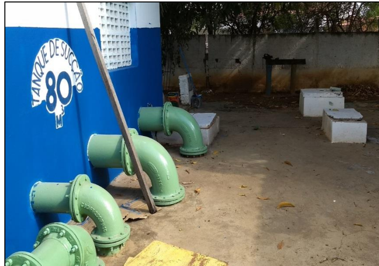
Figura 42 – Reservatório enterrado (REN) – tanque de sucção, 80 m 3 . Fonte: DRZ – Geotecnologia e Consultoria, 2017.
