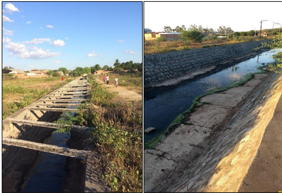
Figura 139 – Canais de drenagem: Canal 1 (do Rio Vermelho) e Canal 2, respectivamente. Fonte: DRZ – Geotecnologia e Consultoria, 2017.
