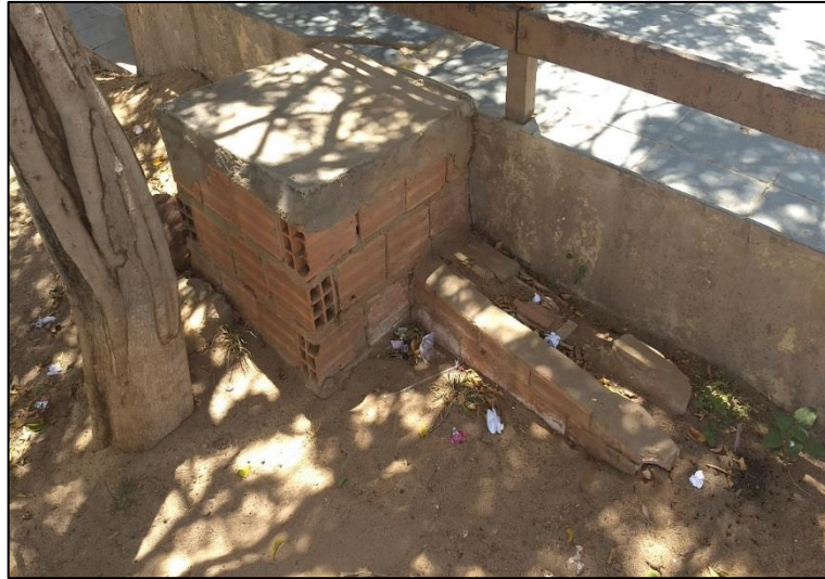
Figura 79 – Exemplo de fossa rudimentar utilizada na comunidade Água Branca. Fonte: DRZ – Geotecnia e Consultoria, 2017.
