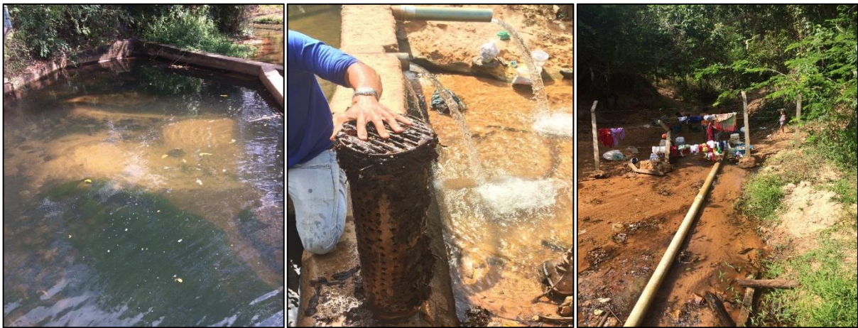
Figura 21 – Problemas de assoreamento, acúmulo de vegetais e utilização inadequada da captação superficial.
