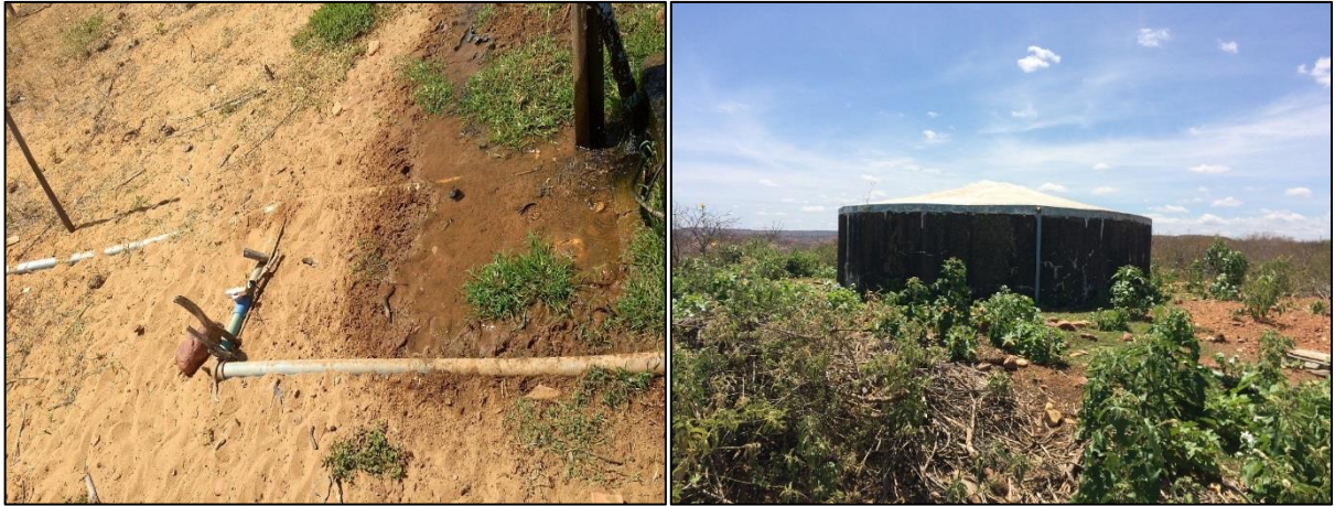
Figura 48 – Adutora de água bruta e reservatório do distrito Canché.
