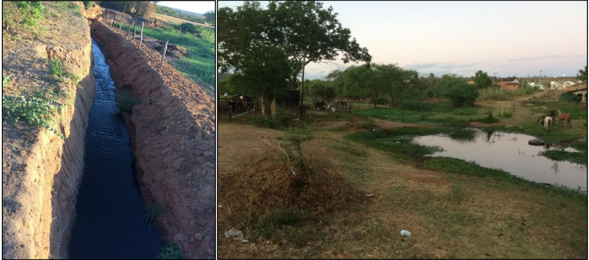
Figura 143 – Vala aberta para o escoamento da drenagem pluvial com esgoto sanitário, até o rio Vaza-Barris.
