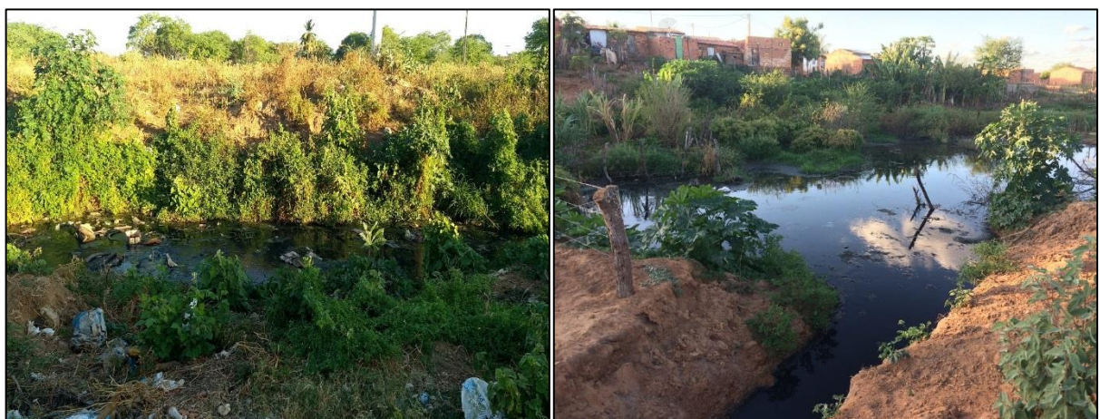
Figura 142 – Acúmulo de esgoto sanitário e resíduos após o encontro dos canais de drenagem.
