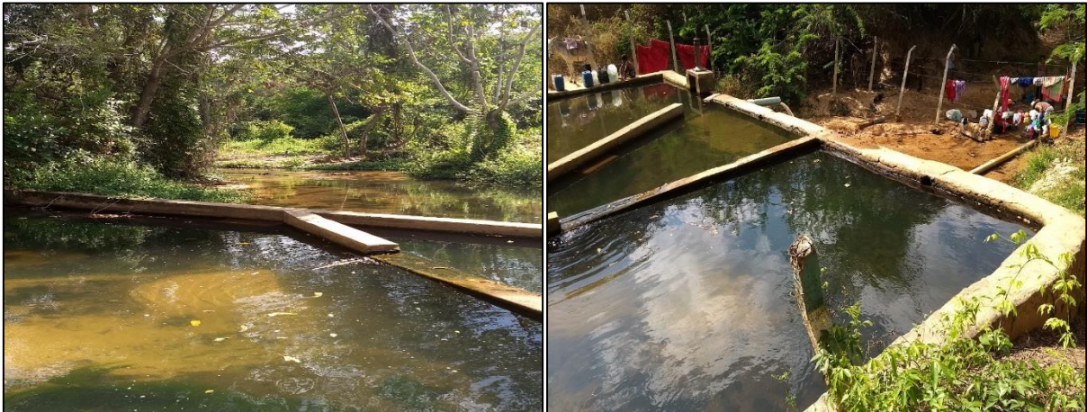
Figura 20 – Captação superficial do distrito Sede, no Rio Vermelho.
