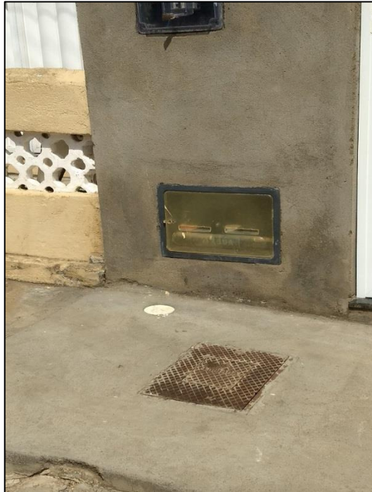
Figura 46 – Hidrômetros instalados no distrito Sede. Fonte: DRZ – Geotecnologia e Consultoria, 2017.
