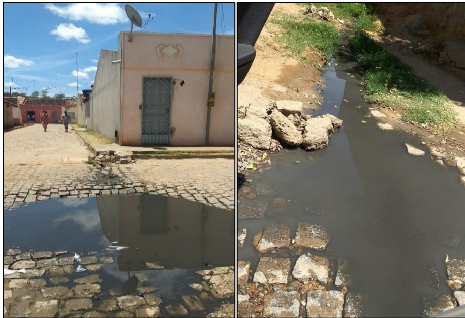
Figura 80 – Lançamento de esgoto em via pública na comunidade Água Branca. Fonte: DRZ – Geotecnia e Consultoria, 2017.
