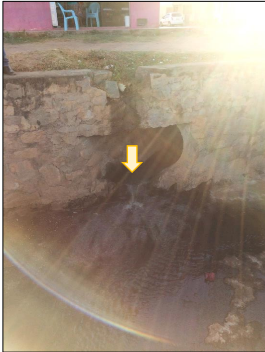
Figura 133 – Despejo irregular de esgoto na rede de drenagem. Fonte: DRZ – Geotecnologia e Consultoria, 2017.
