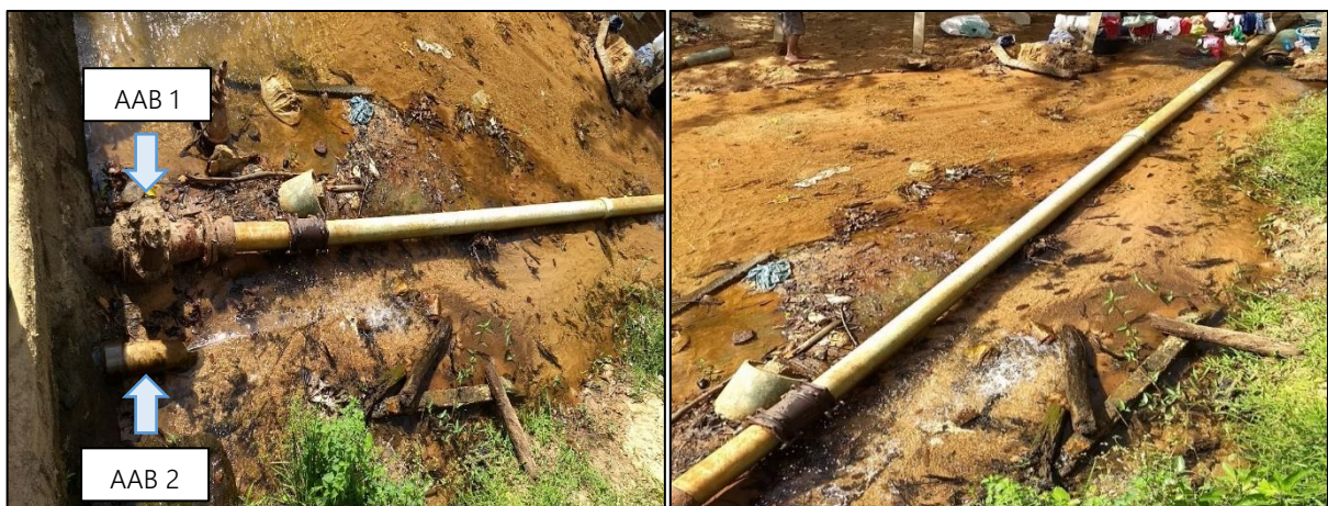
Figura 25 – Adutoras de água bruta da captação superficial.
