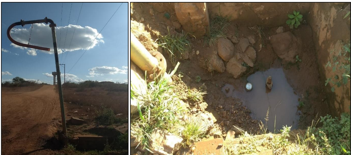
Figura 52 – Ponto de abastecimento dos caminhões-pipa, com destaque para o macromedidor. Fonte: DRZ – Geotecnia e Consultoria, 2017.
