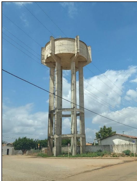
Figura 43 – Reservatório elevado (REL), 300 m 3 . Fonte: DRZ – Geotecnologia e Consultoria, 2017.
