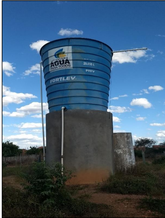
Figura 60 – Reservatório da comunidade Caritá. Fonte: DRZ – Geotecnologia e Consultoria, 2017.
