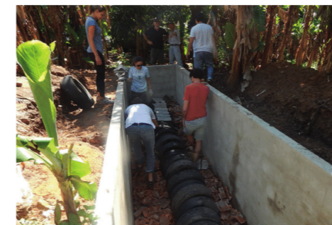
FIGURA 3. Construção da câmara de pneus e da camada de entulho (Foto: Bárbara Silva).
