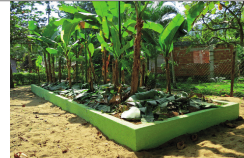
FIGURA 2. Fossa verde ou BET instalada na Praia do Sono, Paraty/RJ. Fonte: otss.org.br/saneamento-ecologico.
