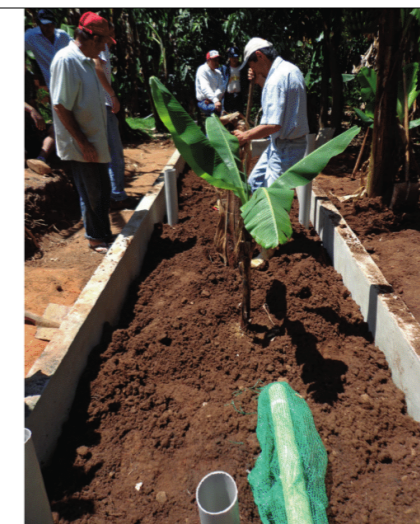
FIGURA 4. Preenchimento da camada de terra e plantio das bananeiras. Abaixo é possível ver o "ladrão" de tubo PVC perfurado e envolto por tela de mosquiteiro (Foto: Luana Cruz).
