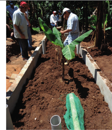
FIGURA 4. Preenchimento da camada de terra e plantio das bananeiras. Abaixo é possível ver o "ladrão" de tubo PVC perfurado e envolto por tela de mosquito (Foto: Luana Cruz).
