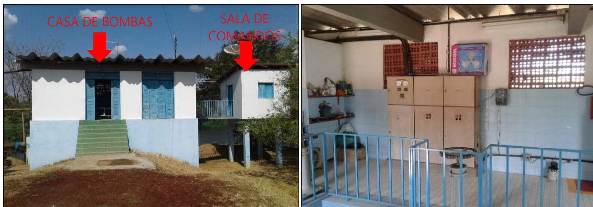
Figura 19 – Casa de bombas, sala de comando e seu painel de comando e controle manual das bombas.
