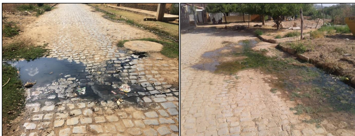
Figura 69 – Lançamento de esgoto em vias públicas.
