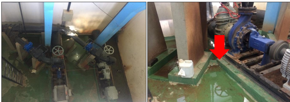
Figura 20 – Bombas de Captação e vazamento no local.
