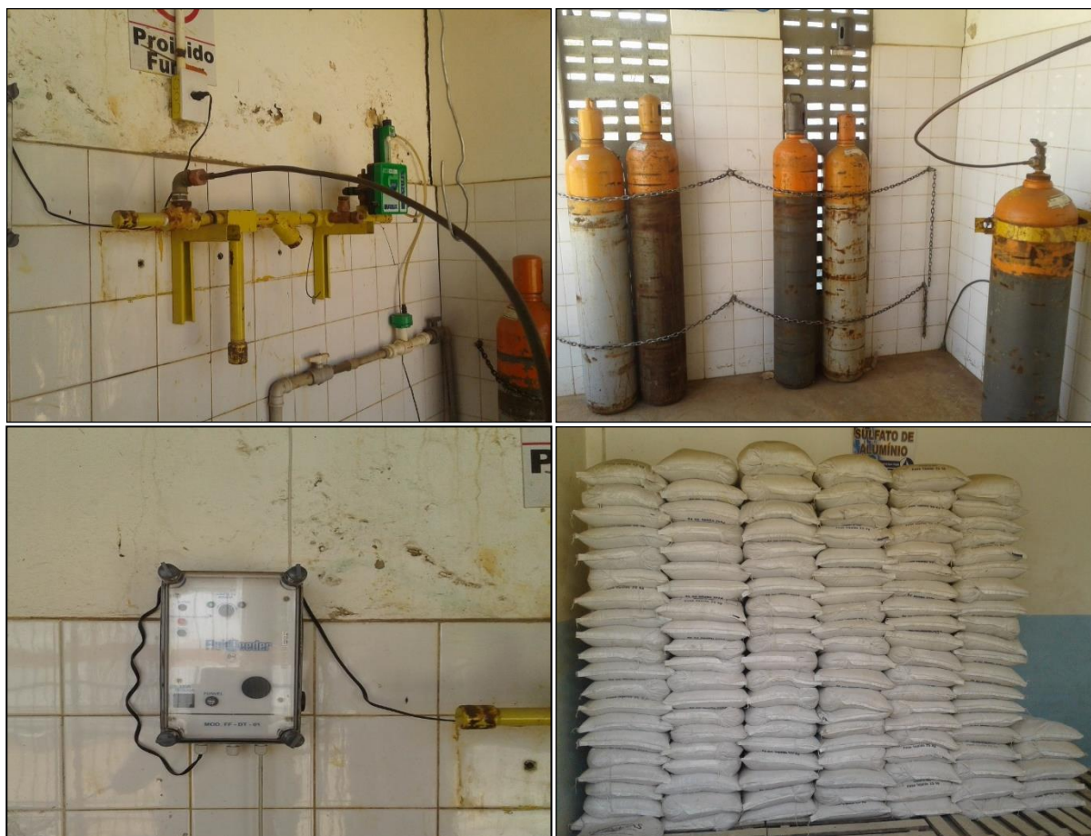
Figura 24 – Dosador de cloro gás. Fonte: DRZ – Geotecnologia e Consultoria, 2017.
