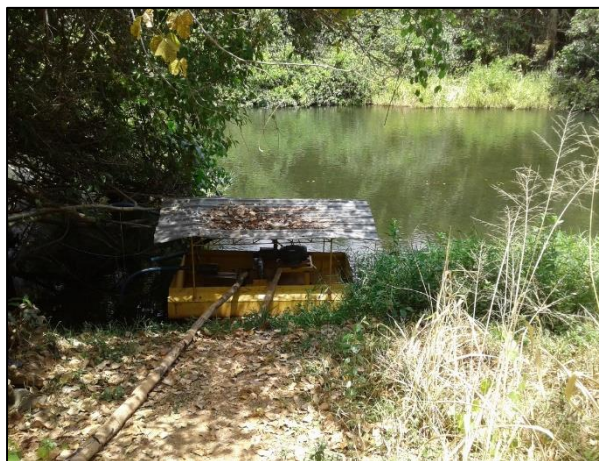
Figura 43 – Captação do povoado Caniveta. Fonte: DRZ – Geotecnologia e Consultoria, 2017.
