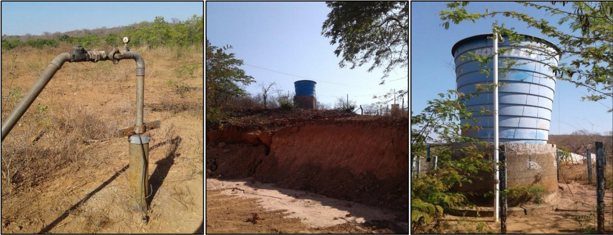
Figura 41 – Captação (4) de poço, REL 3 e REL 4 do povoado Água Quente. Fonte: DRZ – Geotecnologia e Consultoria, 2017.
