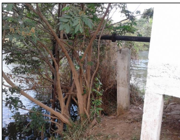
Figura 49 – Captação por bomba superficial do povoado de Montividinha, Caruaru e Currais. Fonte: DRZ – Geotecnologia e Consultoria, 2017.
