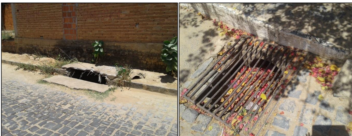
Figura 93 – Estruturas de captação de água pluvial no distrito Sede. Fonte: DRZ – Geotecnologia e Consultoria, 2017.
