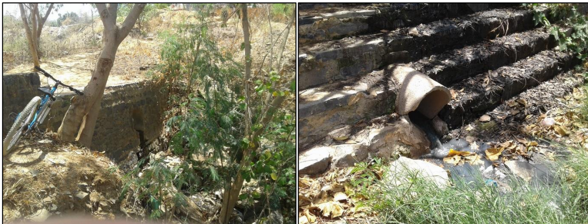
Figura 94 - Lançamento de efluente de esgoto doméstico em rede de drenagem.
