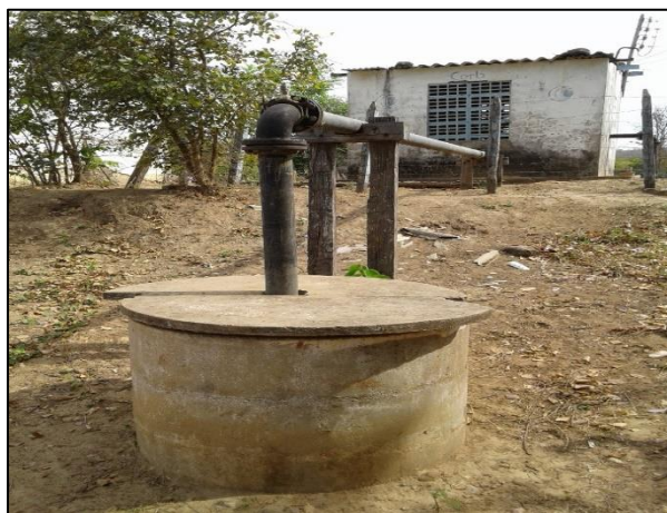
Figura 55 – Captação por bomba superficial do povoado de Nova Franca. Fonte: DRZ – Geotecnologia e Consultoria, 2017.
