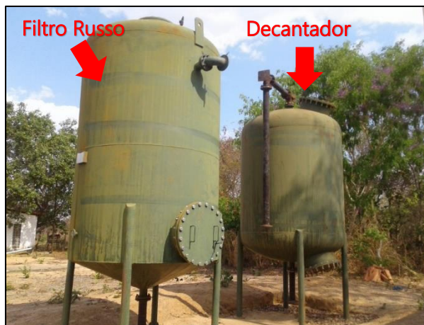
Figura 33 – Filtro Ruddo e Decantador desativado do distrito de Inhaúmas. Fonte: DRZ – Geotecnia e Consultoria, 2017.
