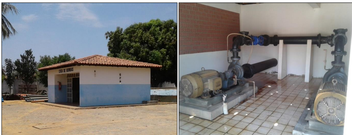
Figura 25 – Casa de bombas EEAT.
