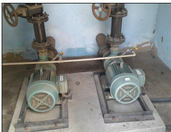
Figura 32 – Bombas de captação superficial do distrito de Inhaúmas. Fonte: DRZ – Geotecnologia e Consultoria, 2017.
