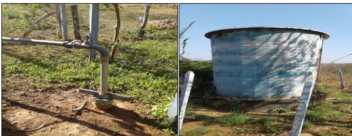
Figura 40 – Captação (3) de poço e RAP do povoado Água Quente – Poço 03. Fonte: DRZ – Geotecnologia e Consultoria, 2017.
