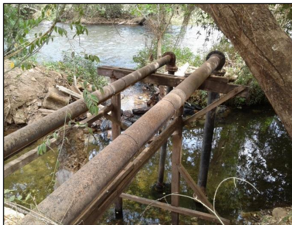
Figura 52 – Captação por bomba superficial do povoado Mucambo. Fonte: DRZ – Geotecnologia e Consultoria, 2017.
