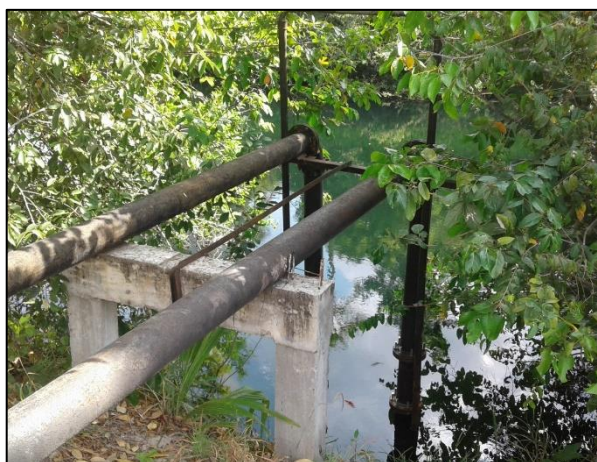
Figura 31 – Captação superficial do distrito de Inhaúmas. Fonte: DRZ – Geotecnologia e Consultoria, 2017.
