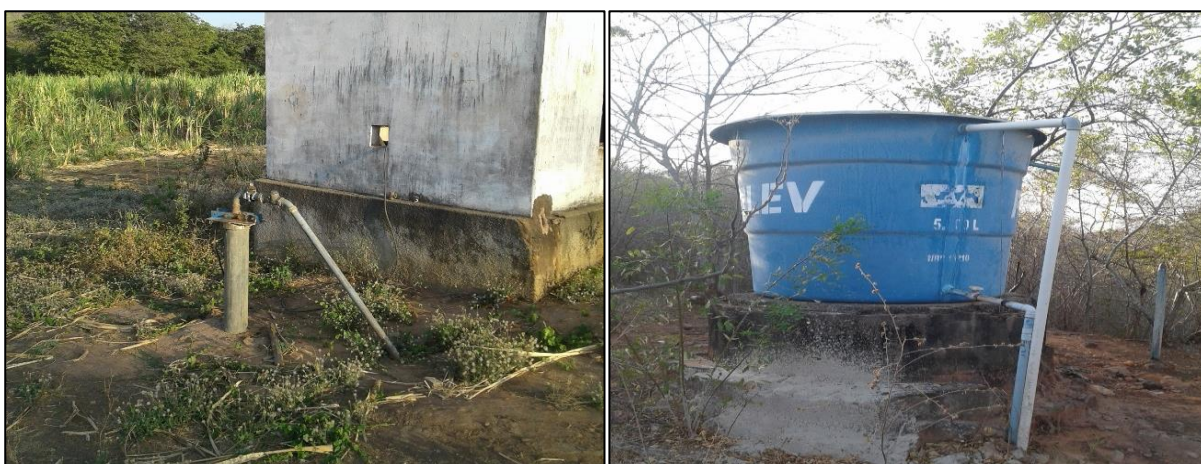
Figura 38 – Captação (1) de poço e REL 1 do povoado Água Quente – Poço 01.
