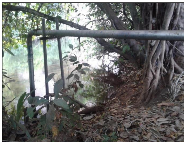
Figura 58 – Captação por bomba superficial do povoado de Ponte Velha. Fonte: DRZ – Geotecnologia e Consultoria, 2017.
