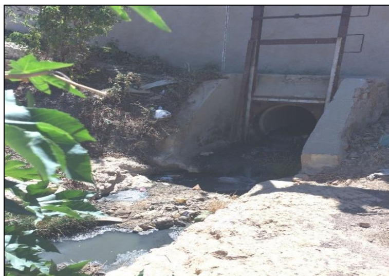
Figura 139 – Ponto de lançamento de drenagem em Xique-Xique.
