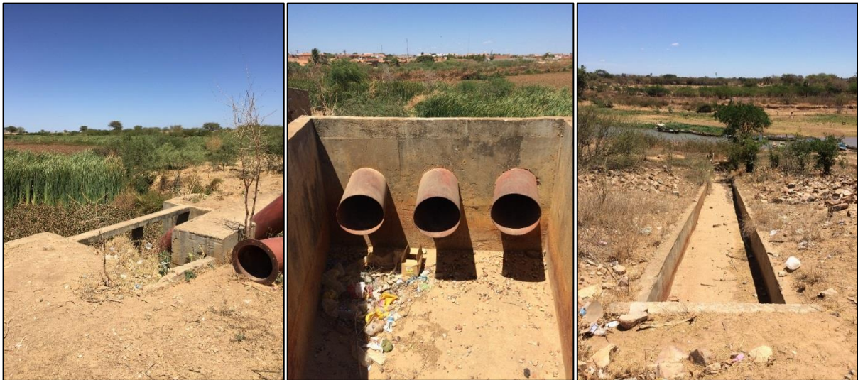
Figura 128 – Sistema de direcionamento das águas da lagoa de drenagem pluvial para o rio São Francisco.
