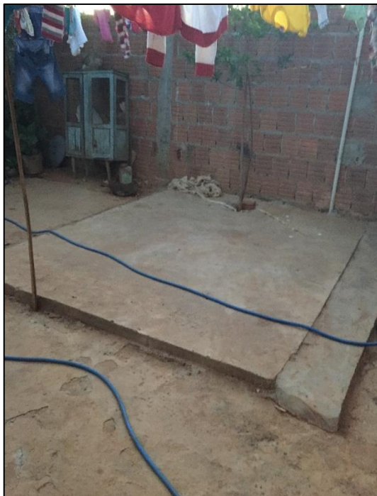
Figura 95 – Fossa rudimentar residencial no distrito Nova Iguaçu. Fonte: DRZ – Geotecnologia e Consultoria, 2017.
