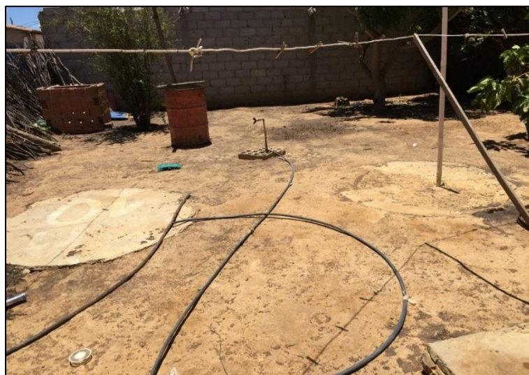
Figura 88 – Fossas sépticas instaladas no bairro Nair Barreto, distrito Sede.
