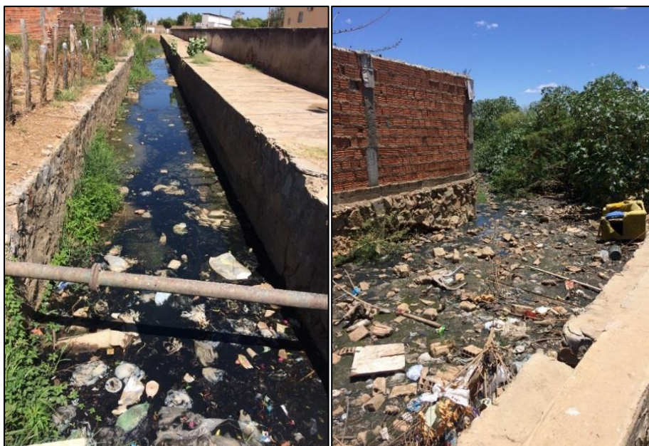
Figura 83 – Lançamento de esgoto e de resíduos sólidos nos canais de drenagem pluvial.
