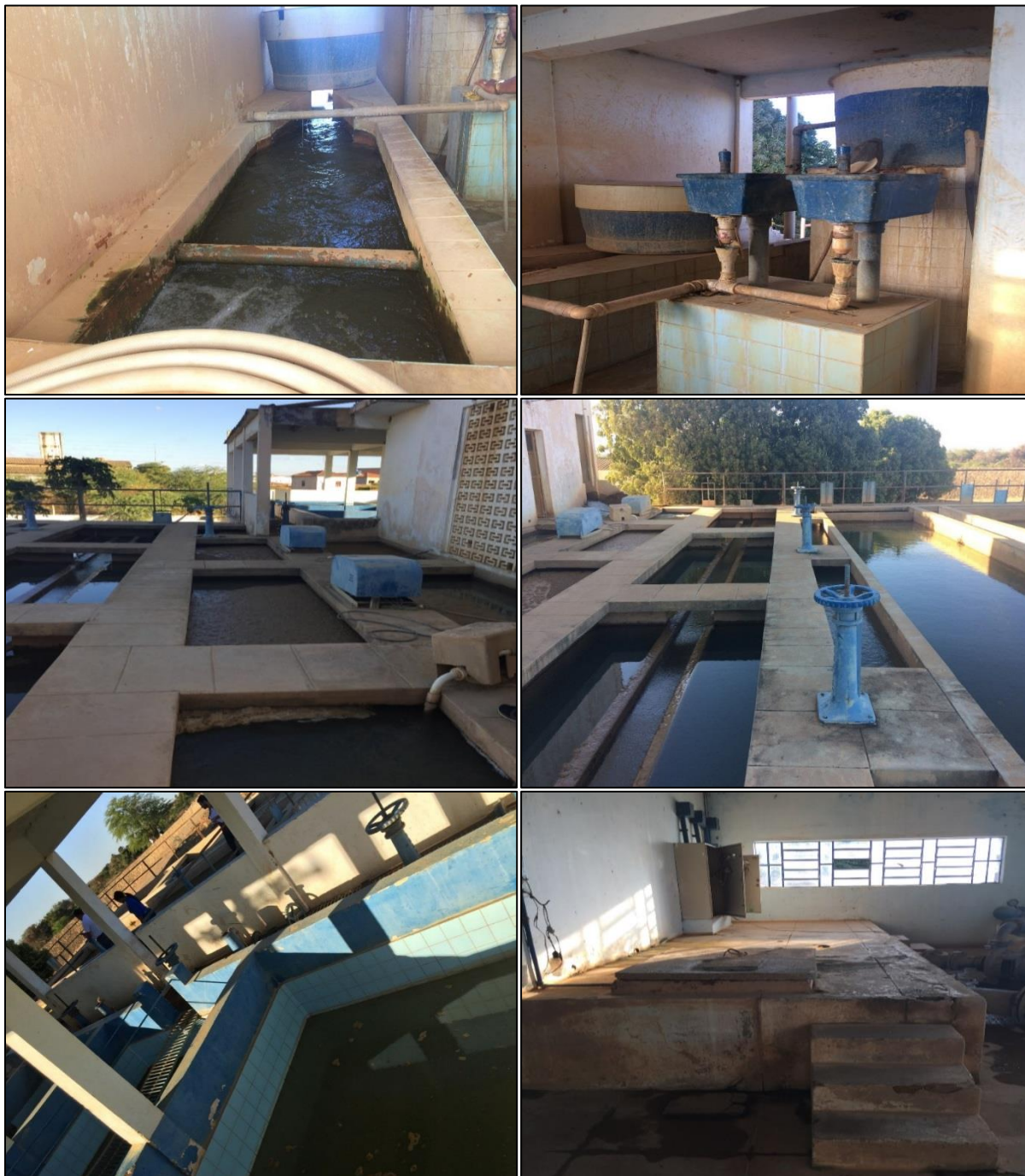
Figura 24 – Estruturas da ETA do distrito Sede. Fonte: DRZ – Geotecnologia e Consultoria, 2017.
