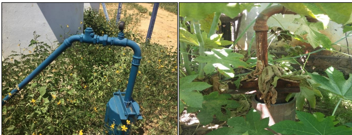
Figura 66 – Poços da comunidade Utinga. Fonte: DRZ – Geotecnologia e Consultoria, 2018.
