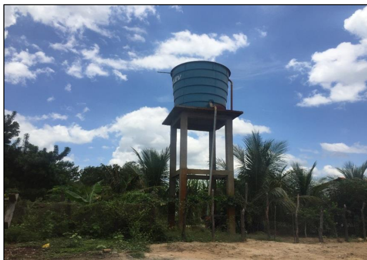
Figura 64 – Reservatório da comunidade Retiro da Picada.
