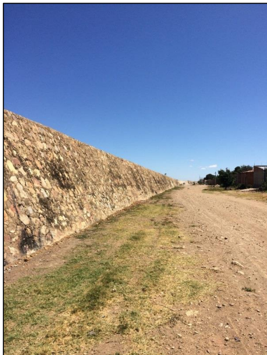
Figura 135 – Dique de proteção das cheias do Rio São Francisco. Fonte: DRZ – Geotecnologia e Consultoria, 2017.
