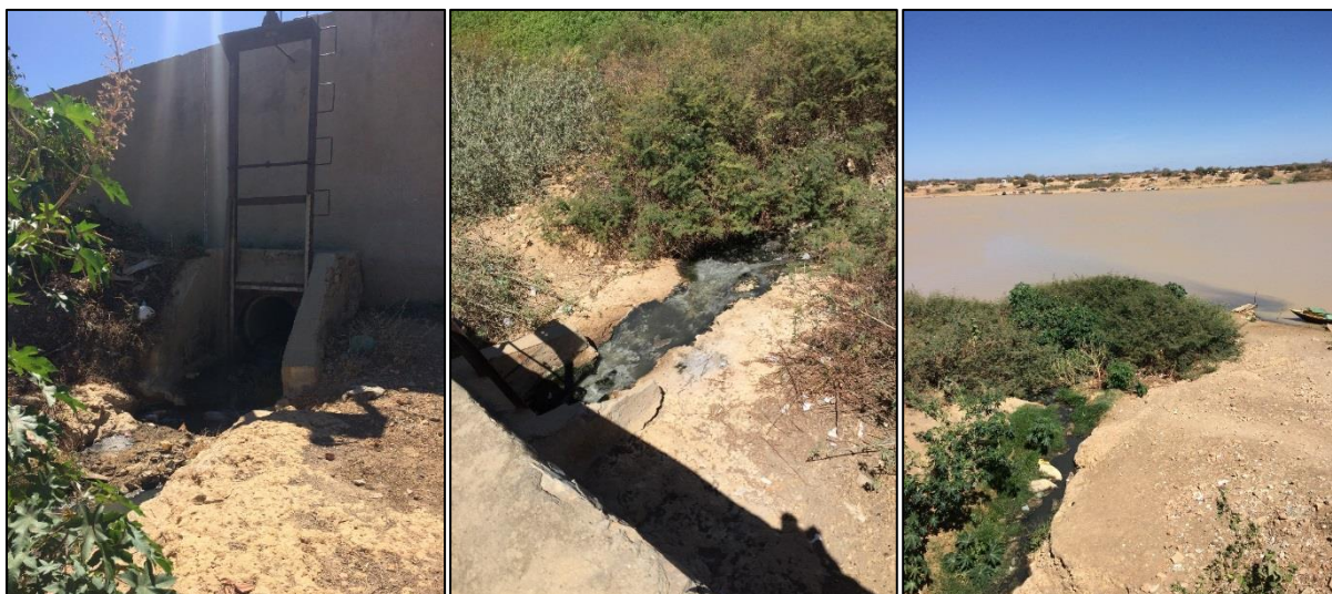
Figura 123 – Comporta instalada junto ao dique, e lançamento de esgoto pelas comportas de drenagem no rio São Francisco.
