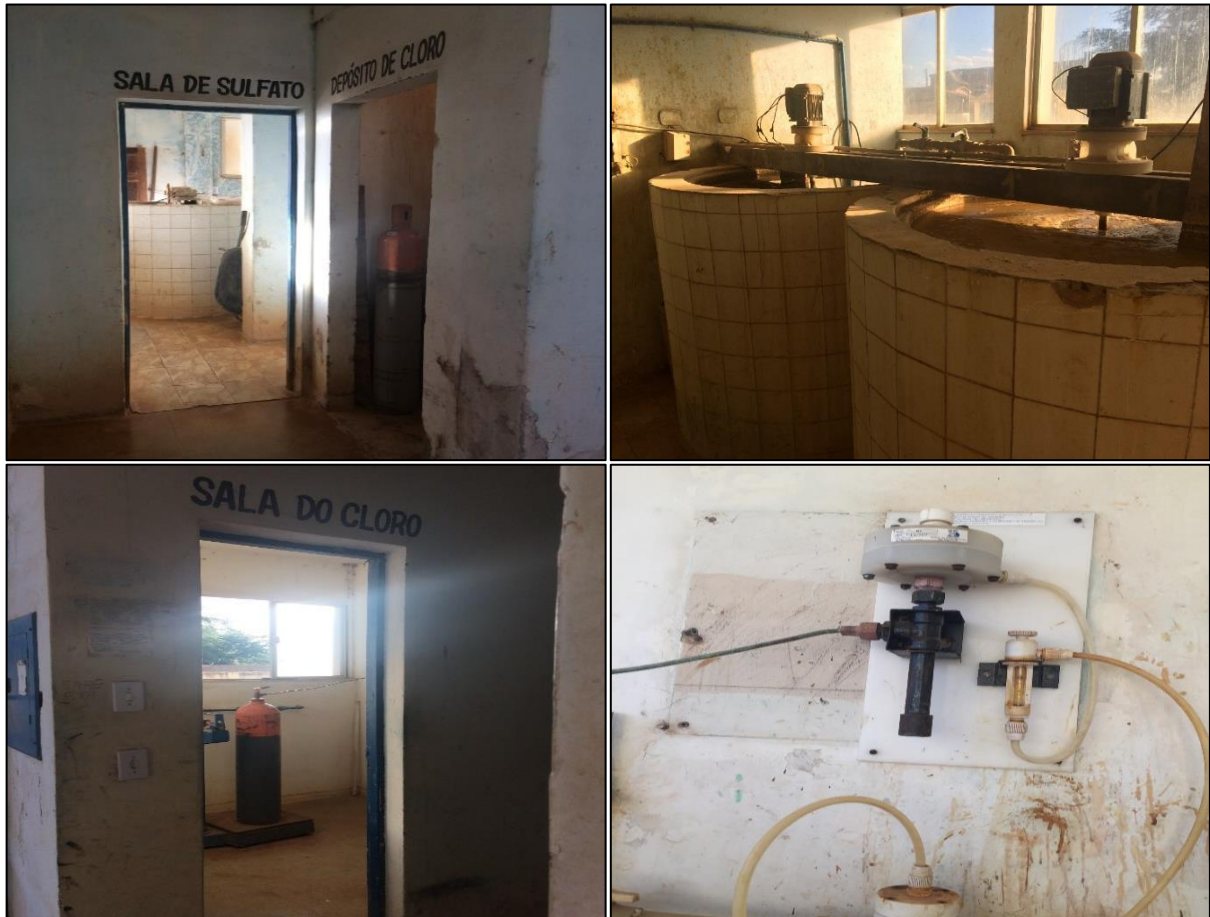
Figura 25 – Sala de sulfato e de cloro da ETA do distrito Sede. Fonte: DRZ – Geotecnologia e Consultoria, 2017.
