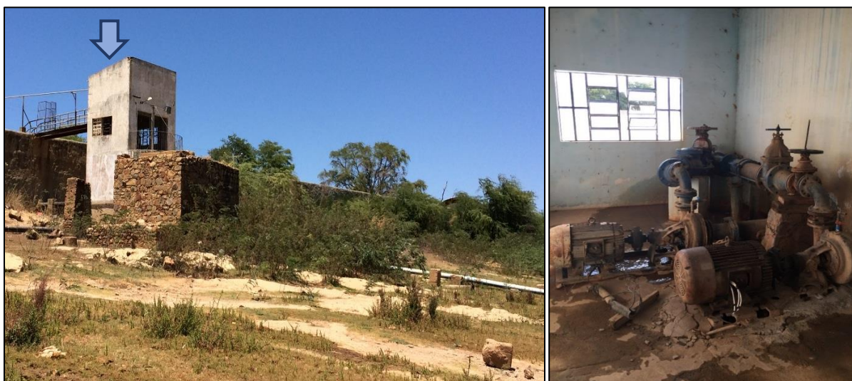
Figura 22 – Estação elevatória de água bruta e de água tratada do distrito Sede.
