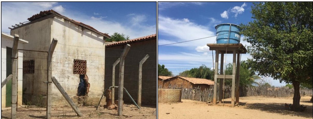
Figura 69 – Poço e reservatório da comunidade Besouro.
