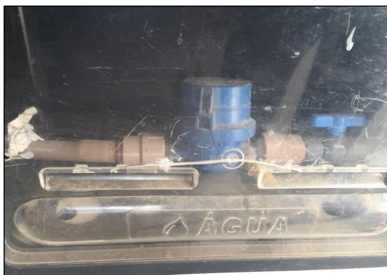
Figura 31 – Exemplos de hidrômetros instalados no distrito Sede.
