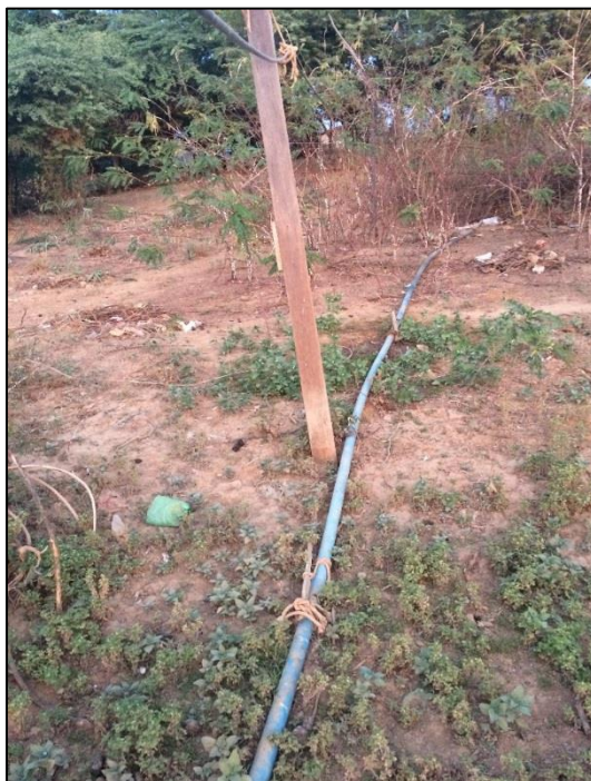
Figura 59 – Adutora de água bruta da comunidade Marreca Velha.
