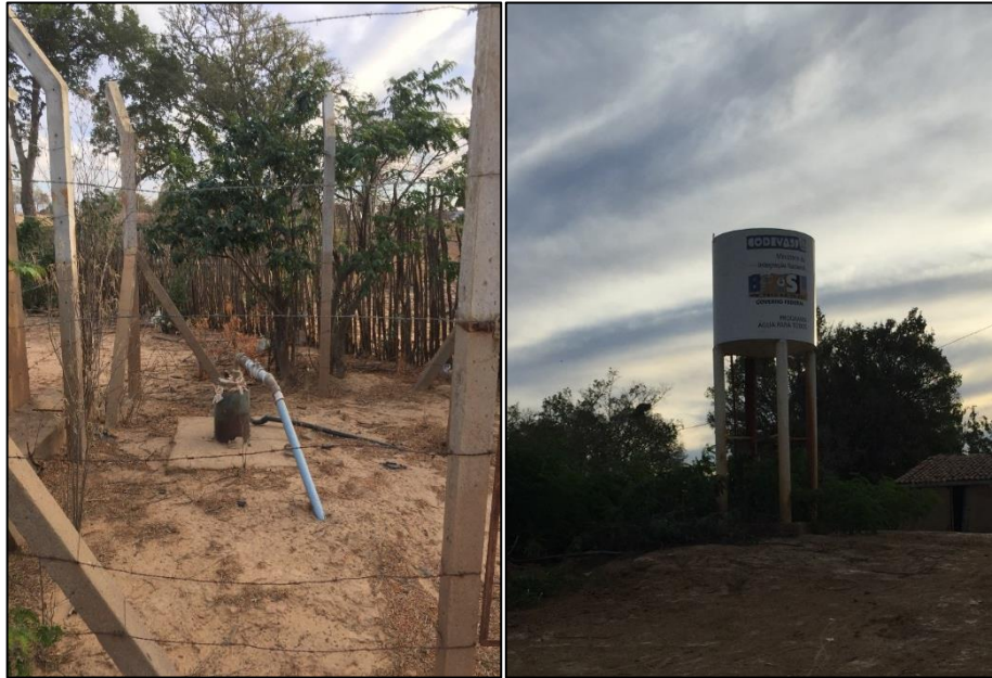
Figura 72 – Poço e reservatório da comunidade Juremal.
