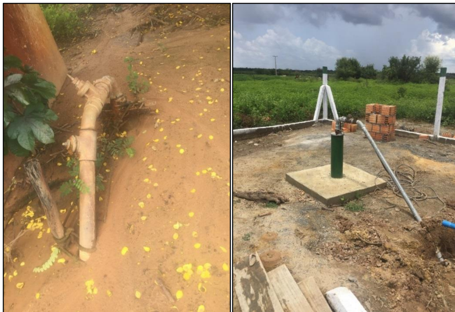
Figura 62 – Poço antigo e novo poço da comunidade Retiro da Picada.
