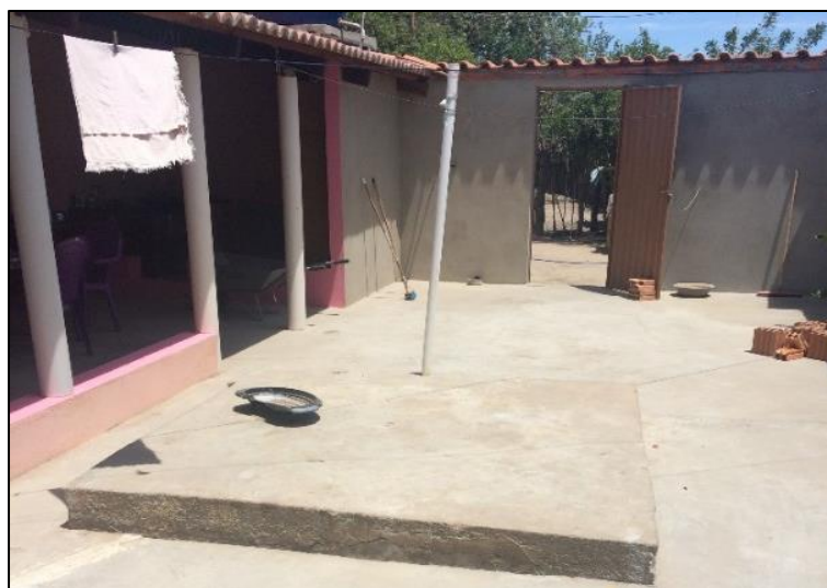
Figura 94 – Fossa rudimentar residencial no distrito Copixaba.
