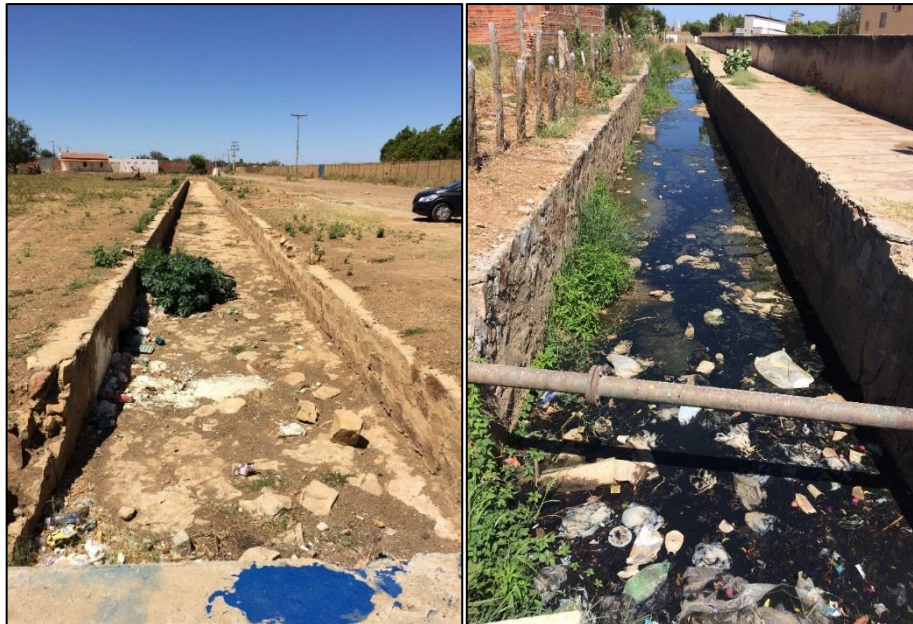
Figura 125 – Canal de drenagem pluvial com acúmulo de efluente doméstico.
