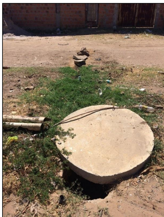
Figura 124 – Rede de drenagem utilizada irregularmente para lançamento de esgoto doméstico.
