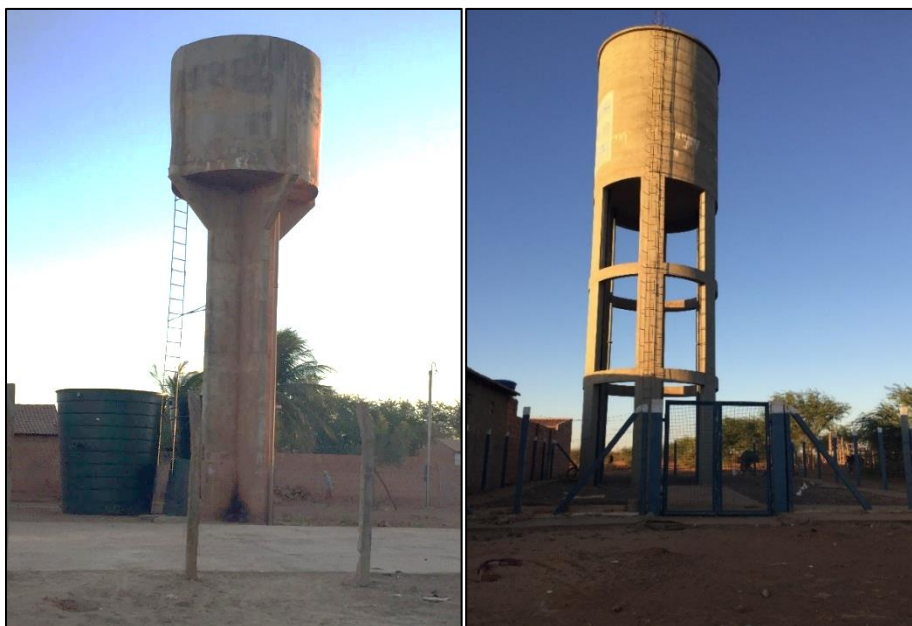
Figura 40 – Reservatórios do distrito Nova Iguaire, ativado (25 m 3 ) e desativado (100 m 3 ), respectivamente.
