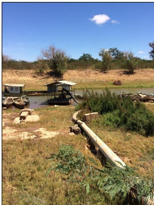
Figura 21 – Adutora de água bruta da captação superficial.
