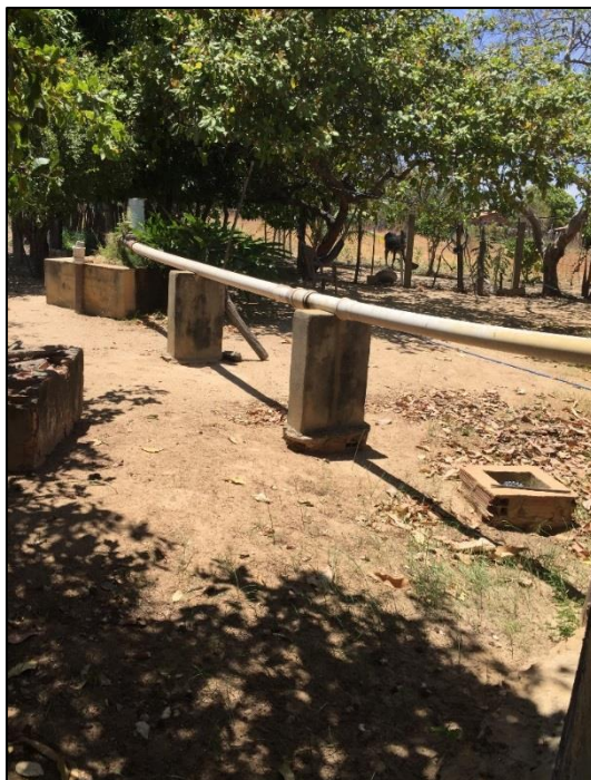
Figura 34 – Adutora de água bruta do distrito Copixaba. Fonte: DRZ – Geotecnologia e Consultoria, 2017.
