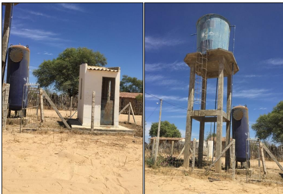
Figura 70 – Poço e reservatório da comunidade Brinco do Soim. Fonte: DRZ – Geotecnologia e Consultoria, 2017.
