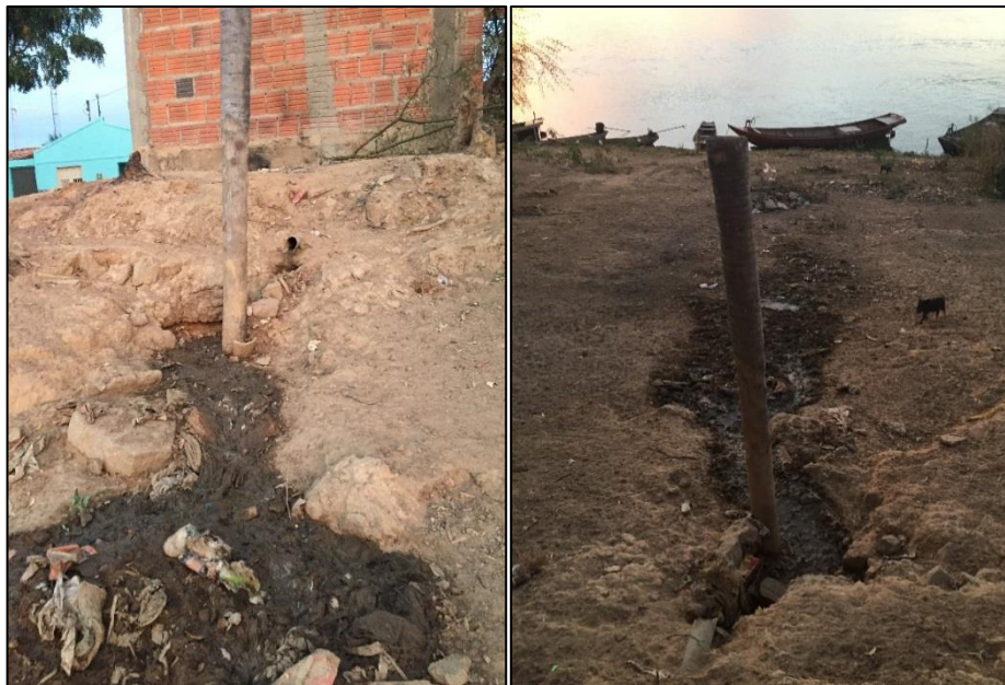
Figura 99 – Lançamento de esgoto no leito do rio São Francisco na comunidade Marreca Velha. Fonte: DRZ – Geotecnologia e Consultoria, 2017.
