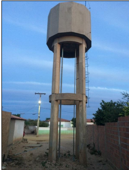
Figura 60 – Reservatório da comunidade Marreca Velha. Fonte: DRZ – Geotecnologia e Consultoria, 2017.
