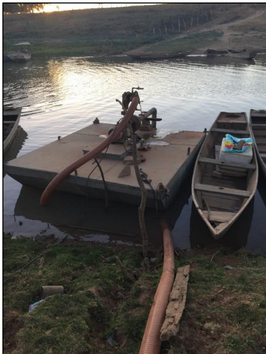
Figura 37 – Captação superficial do distrito Nova Iguaíra. Fonte: DRZ – Geotecnologia e Consultoria, 2017.
