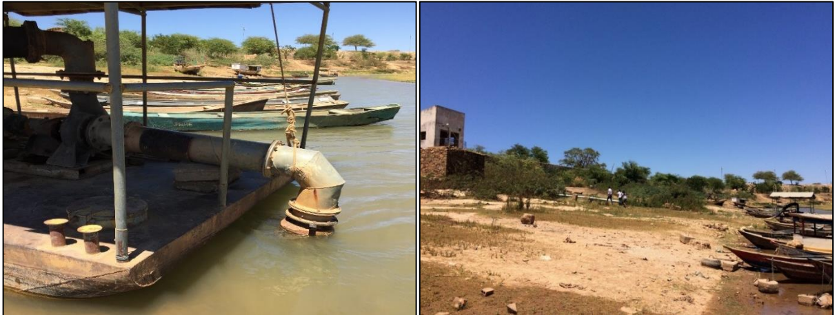
Figura 19 – Captação superficial no rio São Francisco e área ao entorno: distrito Sede. Fonte: DRZ – Geotecnologia e Consultoria, 2017.
