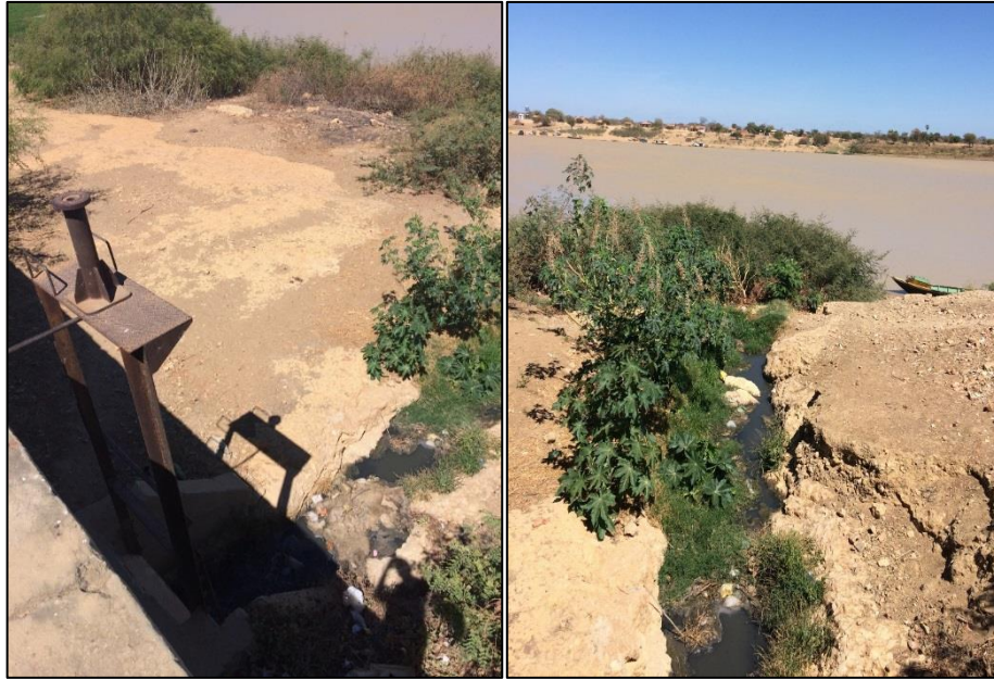
Figura 84 – Lançamento de esgoto diretamente no canal fluvial, braço do rio São Francisco. Fonte: DRZ – Geotecnologia e Consultoria, 2017.
