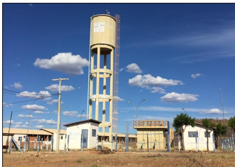
Figura 47 – Estação de tratamento de água da comunidade Boa Vista.
