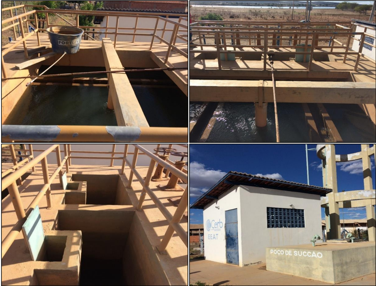
Figura 48 – Estruturas da ETA da comunidade Boa Vista. Fonte: DRZ – Geotecnologia e Consultoria, 2017.
