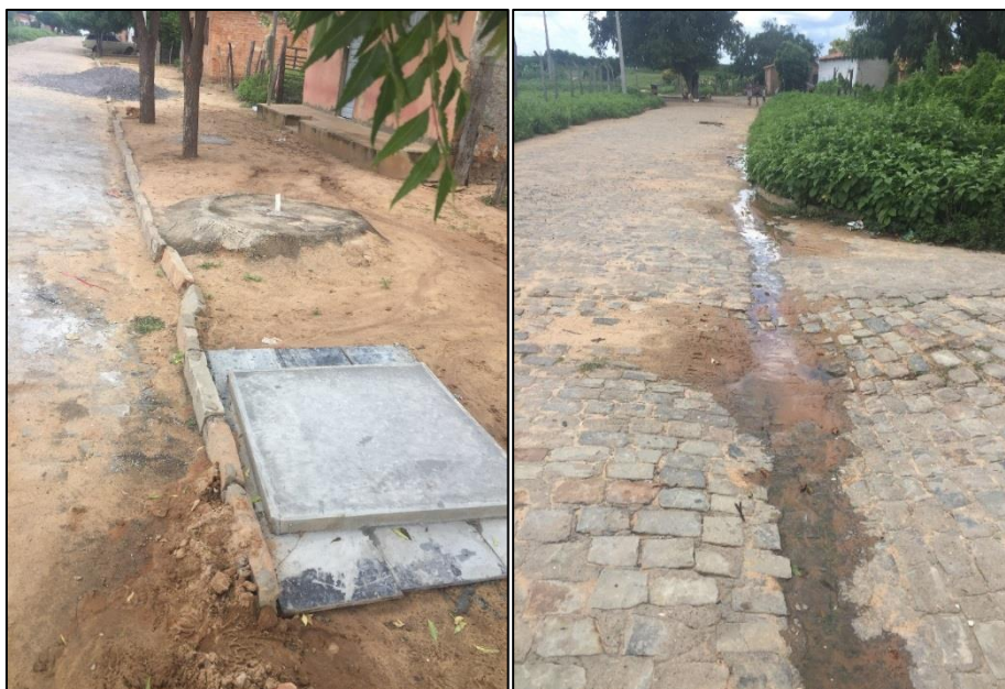
Figura 100 – Exemplo de fossa rudimentar e lançamento de esgoto em via pública na comunidade Retiro da Picada.
