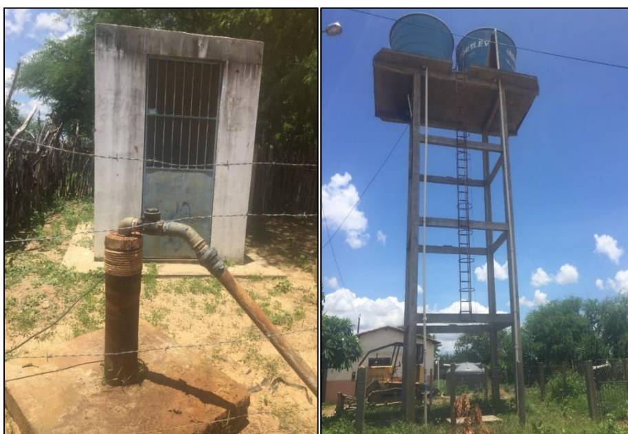
Figura 43 – Poço e reservatórios da comunidade Alto do Gonçalves. Fonte: DRZ – Geotecnologia e Consultoria, 2018.
