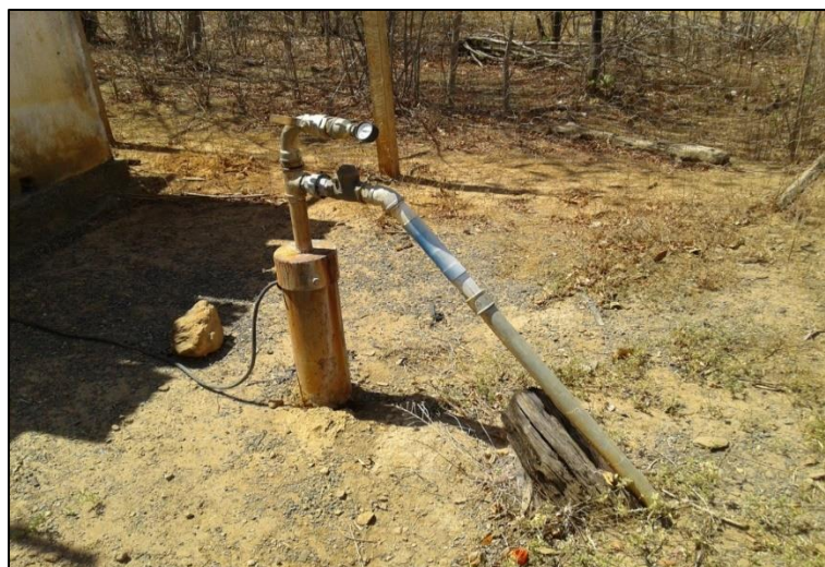
Figura 45 – Captação da comunidade Brejo do Mozondó. Fonte: DRZ – Geotecnologia e Consultoria, 2017.
