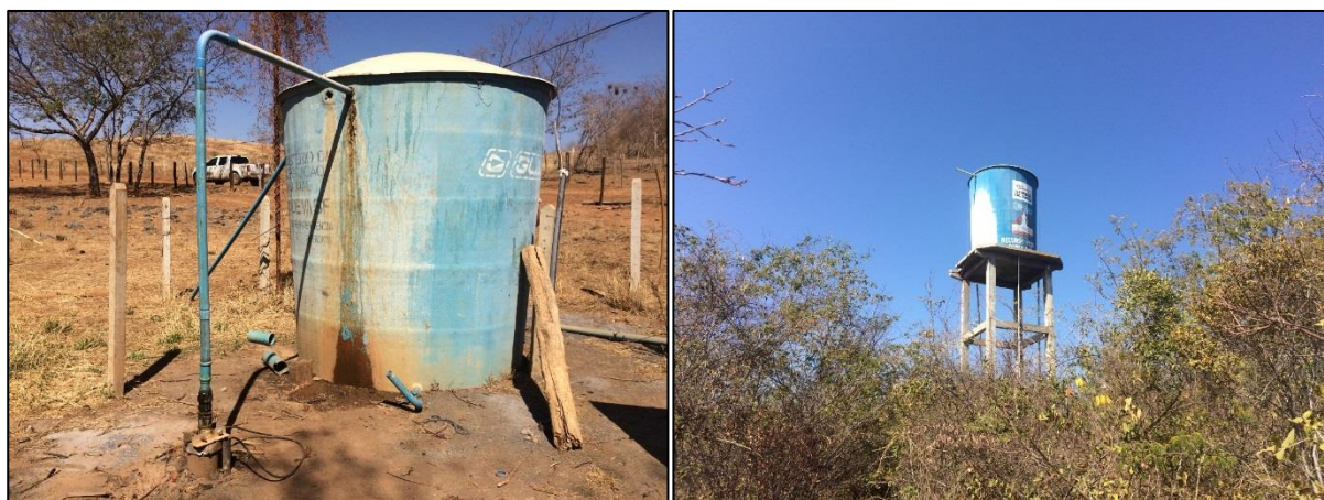
Figura 53 – Captação por poço e reservatórios da comunidade Rumo Novo.
