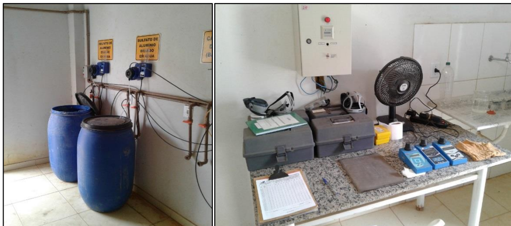
Figura 35 – Casa de química e laboratório da ETA de Entroncamento.
