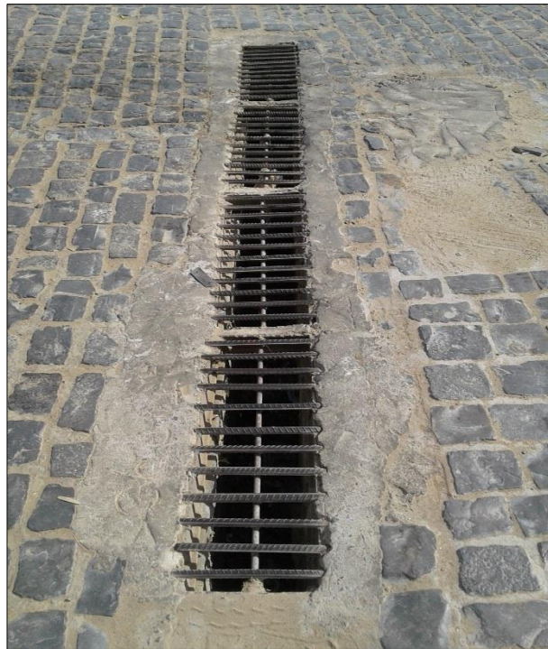
Figura 73 - Dispositivo de drenagem do distrito Sede. Fonte: DRZ – Geotecnologia e Consultoria, 2017.
