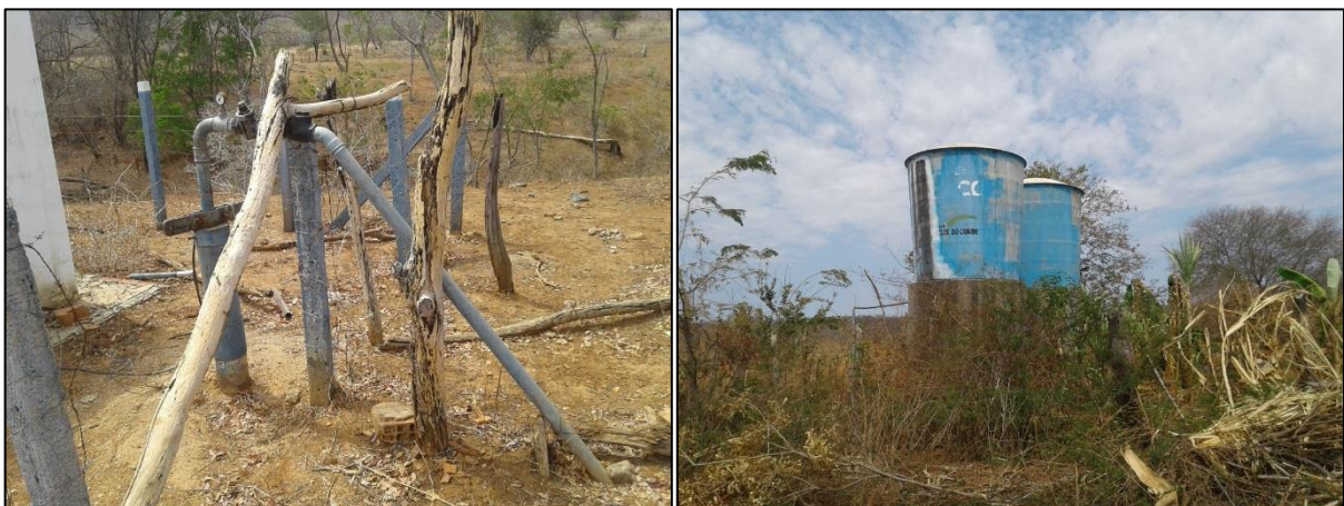
Figura 47 – Captação por poço e reservatórios elevados de fibra de vidro da comunidade de Caracol.
