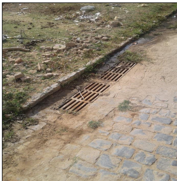
Figura 75 – Esgoto escoando pela boca de lobo.
