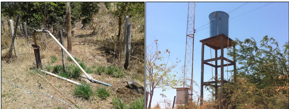
Figura 49 – Captação por poço e reservatório elevado da comunidade Monte Alegre.
