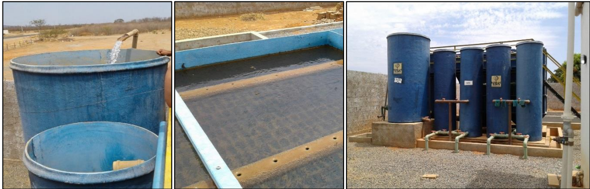
Figura 34 – Estação de tratamento de água da comunidade de Entroncamento.
