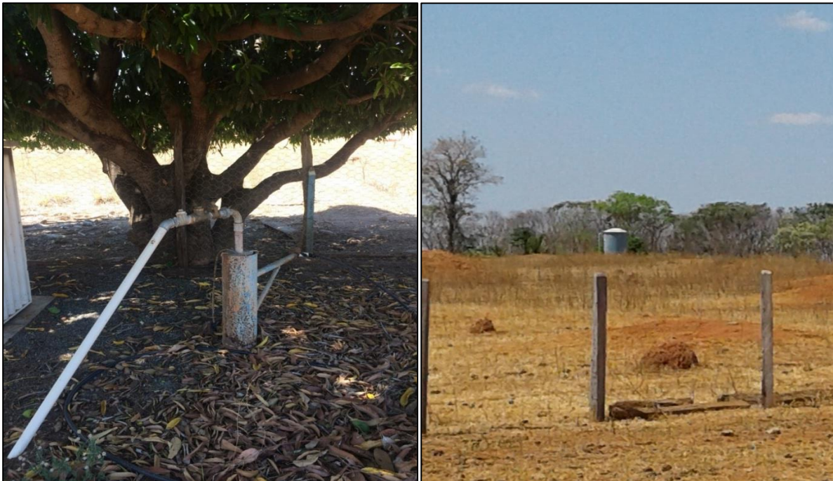
Figura 43 – Captação subterrânea e reservatório da Comunidade Baixa Verde. Fonte: DRZ – Geotecnologia e Consultoria, 2017.
