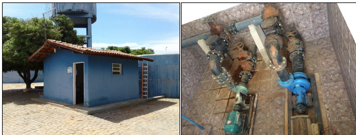
Figura 29 – Estação elevatória de água tratada do distrito Sede.
