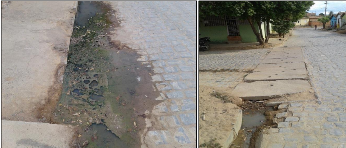
Figura 60 – Lançamento de esgoto na sarjeta. Fonte: DRZ - Geotecnologia e Consultoria, 2017.
