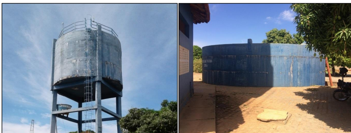
Figura 30 – Reservatórios do distrito Sede em operação: REL E RAP, respectivamente.
