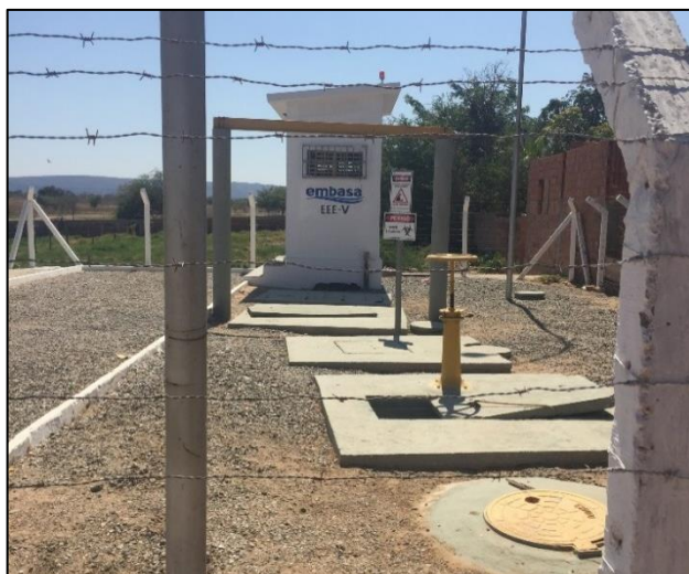
Figura 50 – EEE I, II, III, IV e V. Fonte: DRZ – Geotecnologia e Consultoria, 2017.
