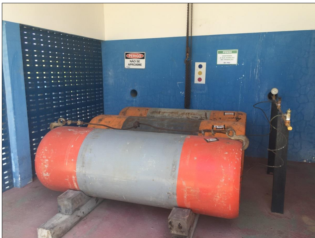
Figura 18 – Cilindro de cloro gás. Fonte: DRZ – Geotecnologia e Consultoria, 2017.
