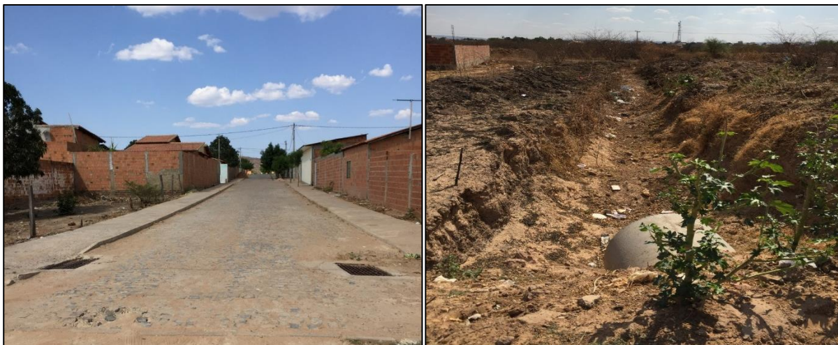
Figura 67 - Estrutura de captação do tipo grelha – distrito Sede. Fonte: DRZ – Geotecnologia e Consultoria, 2017.
