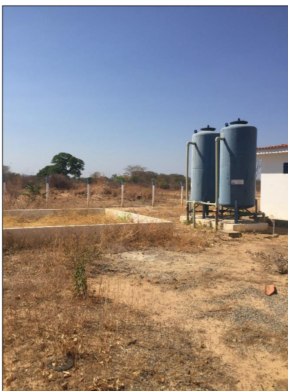
Figura 47 – Filtros de Tratamento – Comunidade Ilha Grande.
