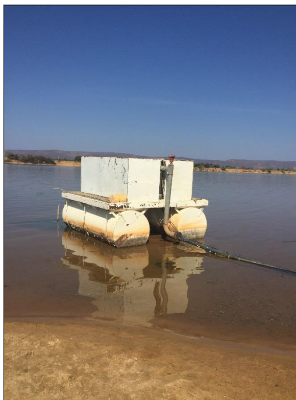
Figura 46 – Captação superficial – Comunidade Ilha Grande. Fonte: DRZ – Geotecnologia e Consultoria, 2017.
