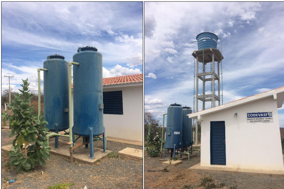
Figura 41 – Filtros de tratamento – Comunidade Novo Horizonte.
