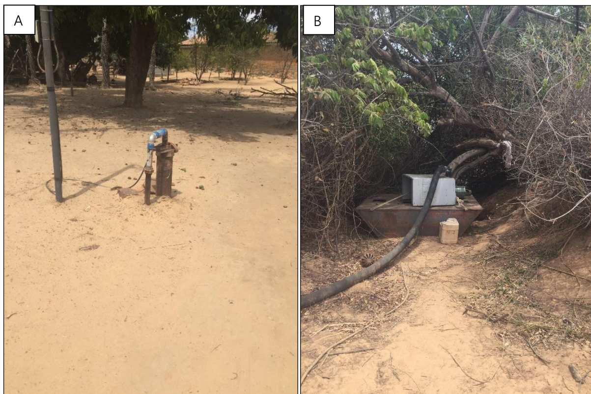
Figura 37 – Poço e Captação superficial – Comunidade de Caraíbas.
