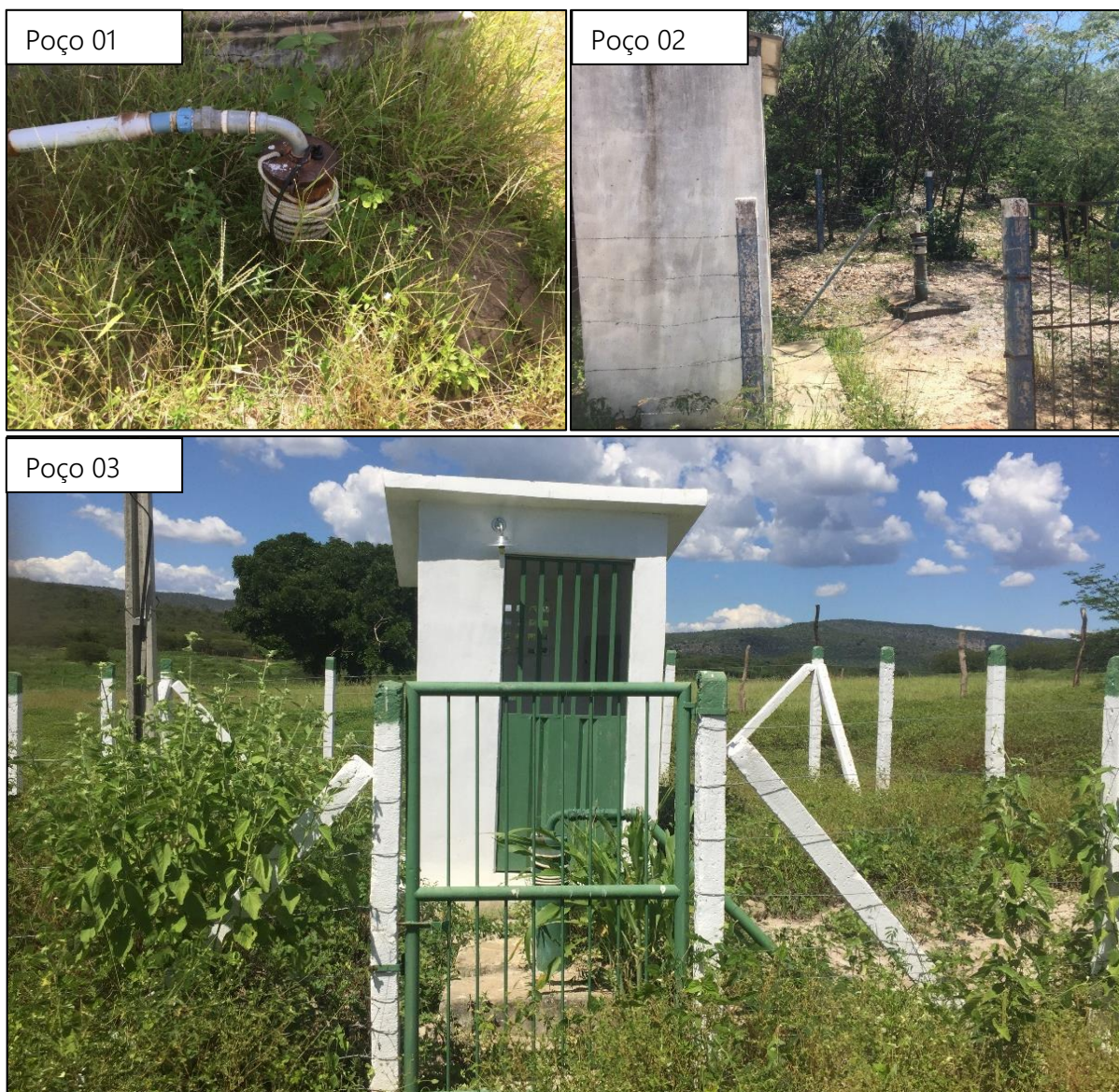
Figura 43 – Poços da Comunidade Olho D'água dos Tanques.
