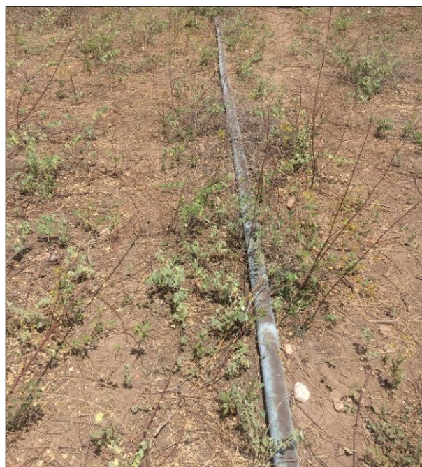
Figura 26 – Adutora de água.
