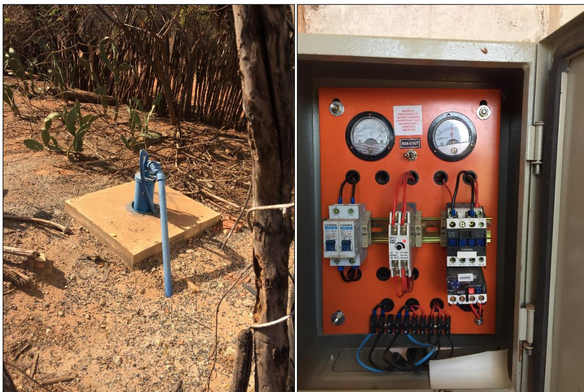
Figura 31 – Poço – Comunidade Boqueirão.
