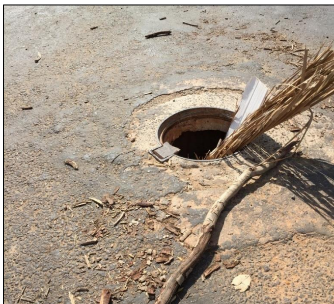
Figura 68 - Poço de visita da rede de drenagem. Fonte: DRZ – Geotecnologia e Consultoria, 2017.
