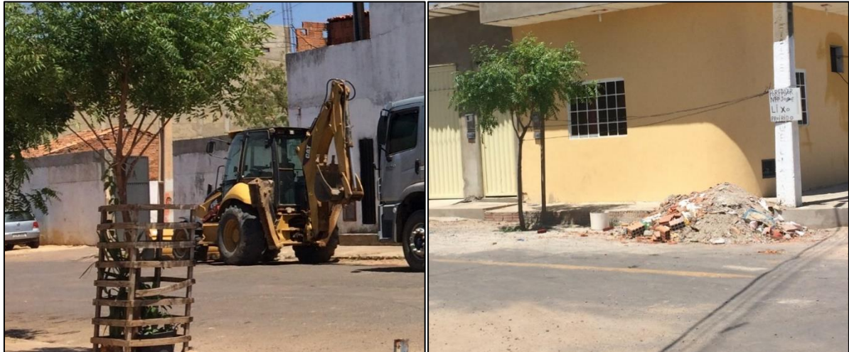
Figura 58 - Retroescavadeira da frota municipal e resíduos de construção civil acumulados em via pública.
