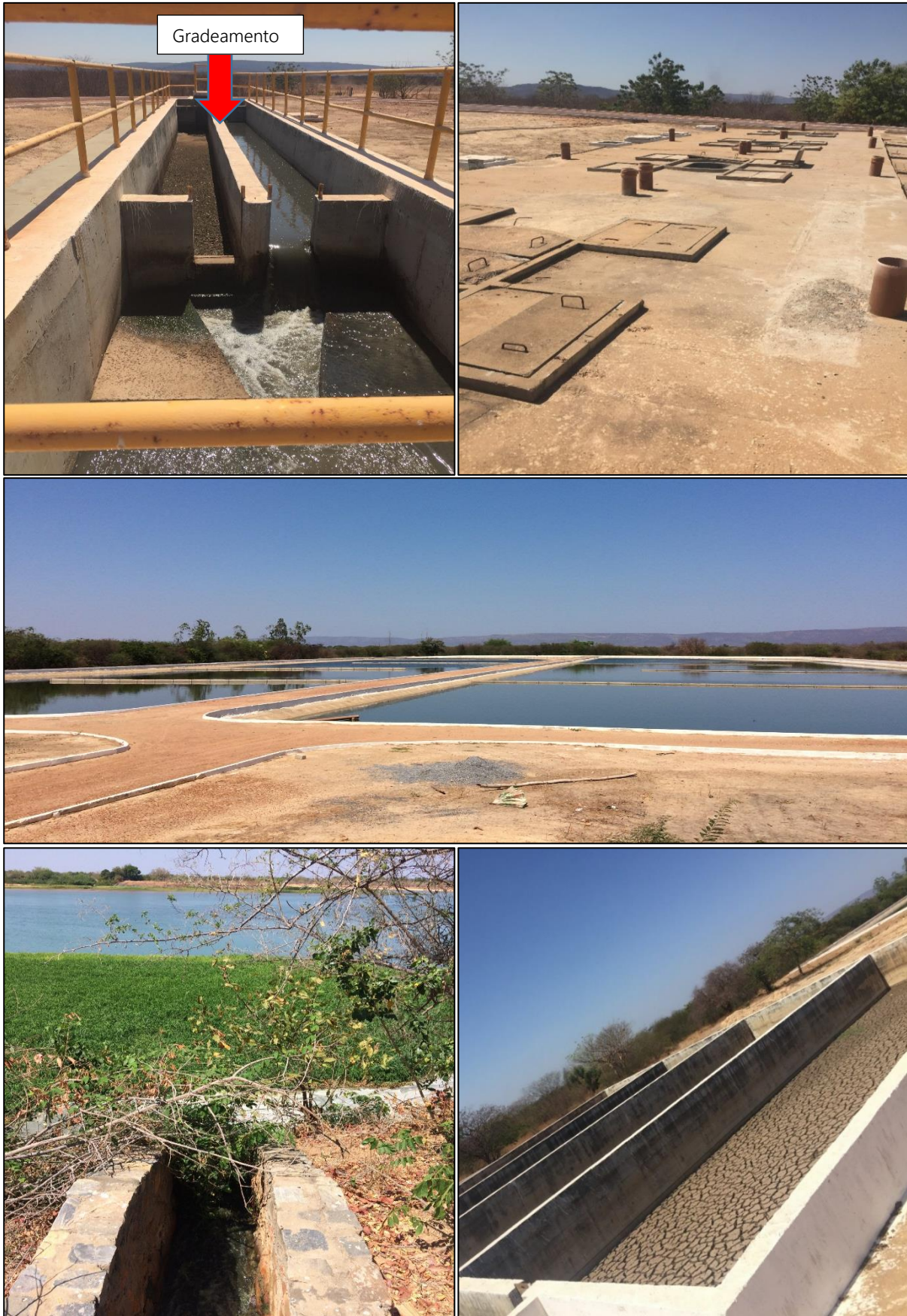
Figura 52 – Calha Parshall e gradeamento (em destaque). Fonte: DRZ – Geotecnologia e Consultoria, 2017.
