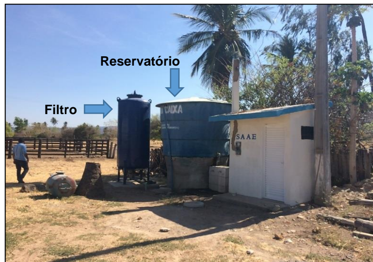
Figura 38 – Sistema de tratamento (filtro) do distrito Favelândia. Fonte: DRZ – Geotecnologia e Consultoria, 2017.
