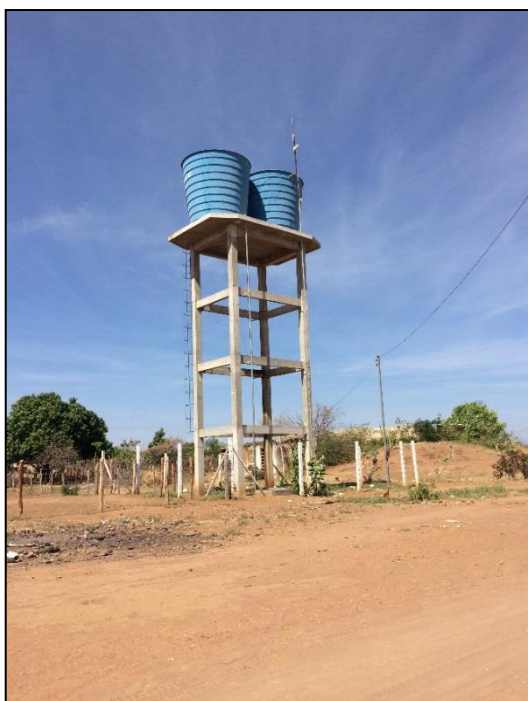
Figura 75 – Reservatórios da comunidade Renascer. Fonte: DRZ – Geotecnologia e Consultoria, 2017.
