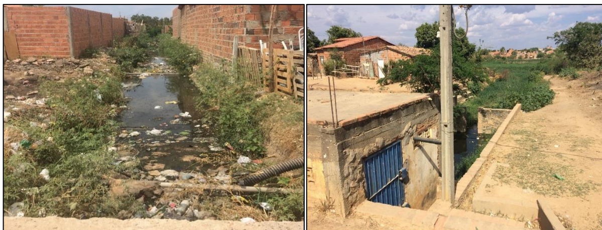
Figura 105 – Canaleta de drenagem e lagoa de contenção de drenagem com acúmulo de efluente de esgoto doméstico.
