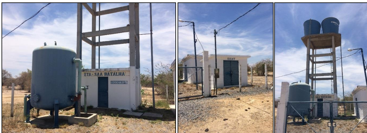
Figura 66 – Filtro, EEAT e reservatórios do assentamento Batalha Sede.
