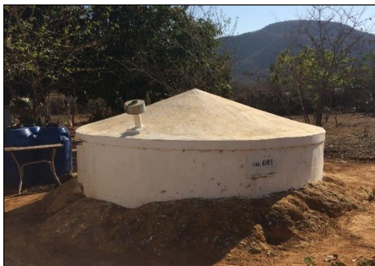
Figura 47 – Cisterna da comunidade Chapada Grande.
