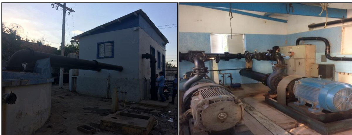
Figura 33 – Estação elevatória de água tratada do distrito Sede. Fonte: DRZ – Geotecnologia e Consultoria, 2017.
