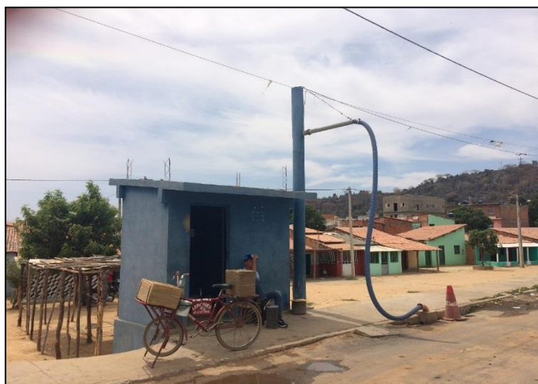
Figura 46 – Ponto de abastecimento de água dos caminhões pipa. Fonte: DRZ – Geotecnologia e Consultoria, 2017.
