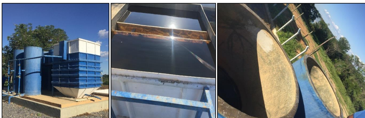
Figura 57 – Estação de tratamento de água da comunidade Piranhas. Fonte: DRZ – Geotecnologia e Consultoria, 2017.
