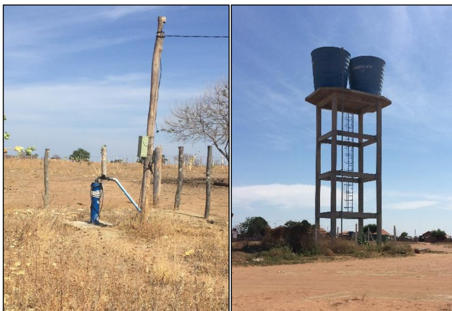
Figura 70 – Poço e reservatório do assentamento Fruticultura. Fonte: DRZ – Geotecnologia e Consultoria, 2017.
