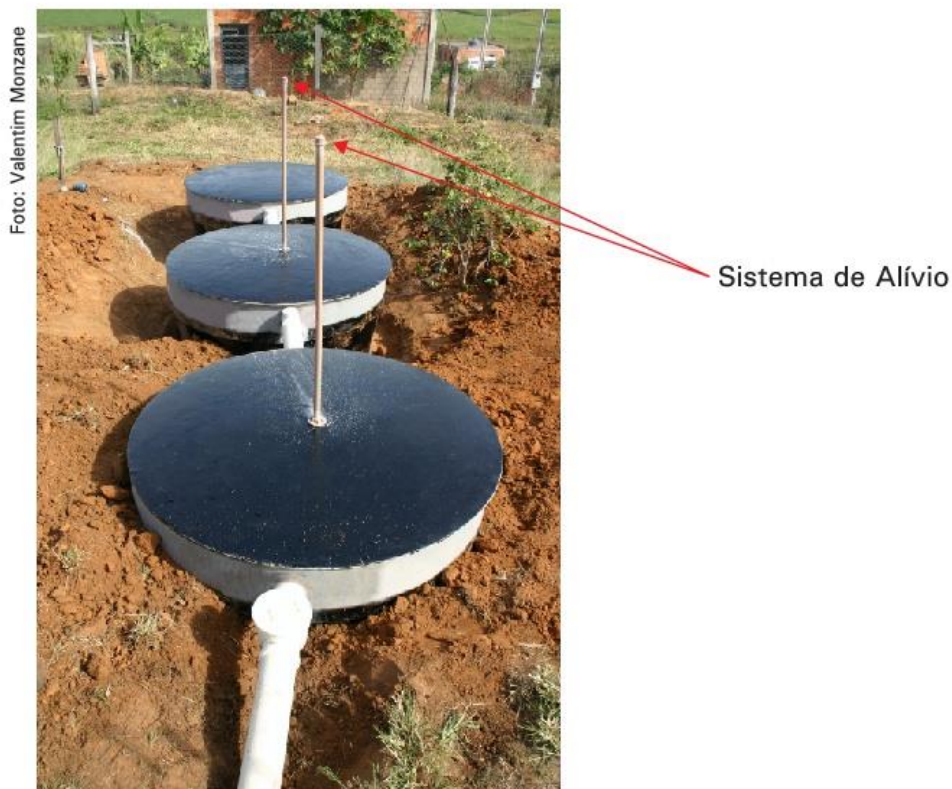
Figura 6. Fossa Séptica Biodigestora com destaque para sistema de alívio de gases.
