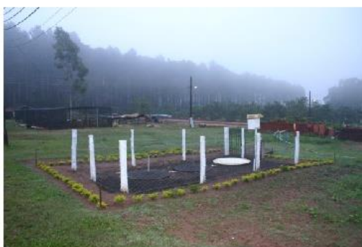
Figura 1. Fossa Séptica Biodigestora Instalada na ETEC Astor de Mattos Carvalho, em Cabrália Paulista, SP.
