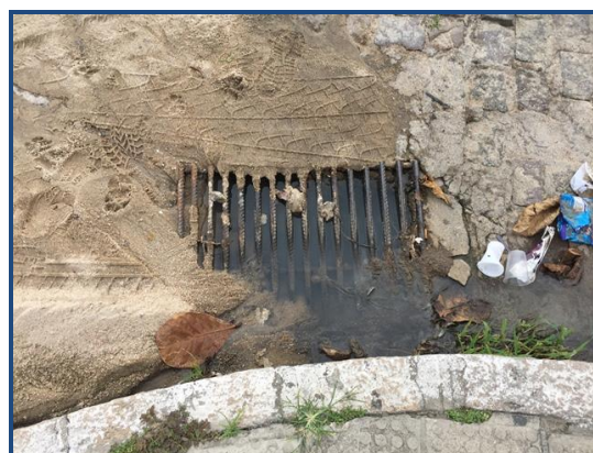
Figura 13 - Boca-de-lobo totalmente entupida (presença de lixo) Fonte: Premier Engenharia, 2018.
