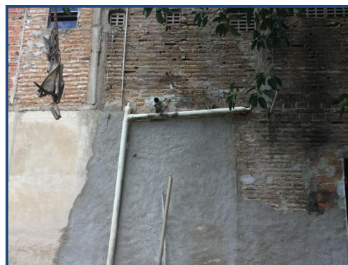
Figura 6 - Ponto de lançamento de esgoto a céu aberto localizado na Rua São Paulo
