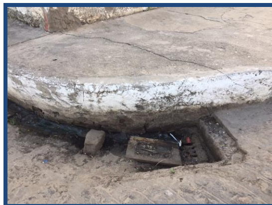
Figura 14 – Boca-de-lobo com grelha de concreto (com excesso de areia em sua superfície)
