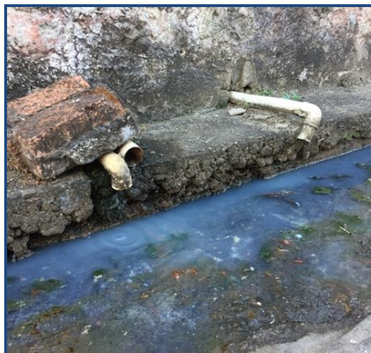
Figura 8 - Ponto de lançamento de esgoto a céu aberto no distrito Pontal do Peba
