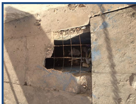
Figura 15 - Dispositivo em mal estado de conservação (com presença de resíduos sólidos no seu interior)
