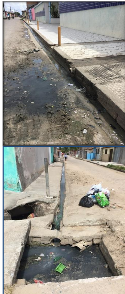
Figura 5- Ponto de lançamento de esgoto a céu aberto.
