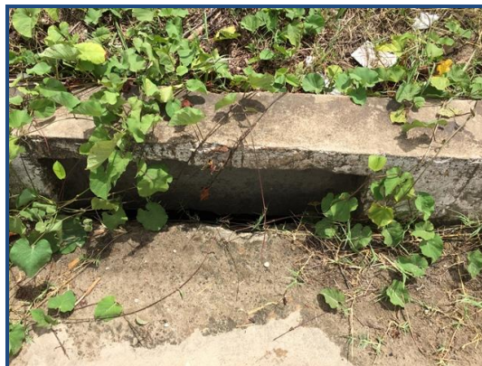
Figura 15 - Entrada da boca-de-lobo com excesso de areia e vegetação
