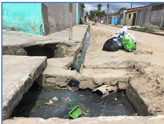
Figura 13 - Dispositivo de captação de água pluvial sem qualquer proteção e sem manutenção
