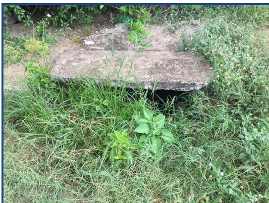
Figura 14 - Excesso de vegetação prejudicando o escoamento das águas pluviais
