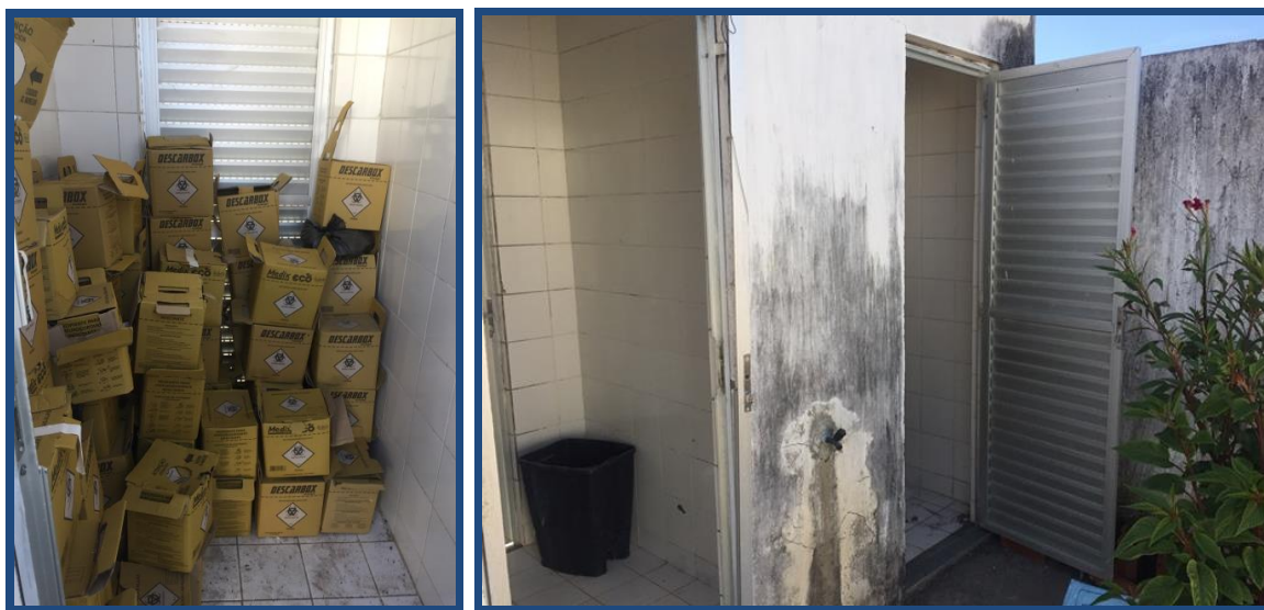
Figura 11 - Local de armazenamento da CSF do Centro Fonte: Premier Engenharia, 2018.
