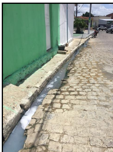
Figura 6- Ponto de lançamento de esgoto a céu aberto.
