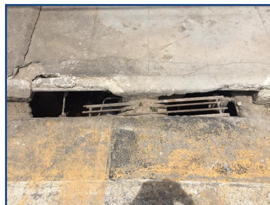
Figura 13 - Boca-de-lobo em mau estado de conservação
