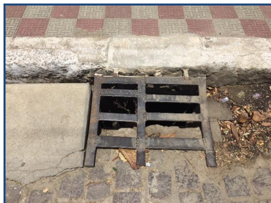
Figura 12 - Boca-de-lobo com grelha de ferro (presença de lixo envolta) Fonte: Premier Engenharia, 2018.
