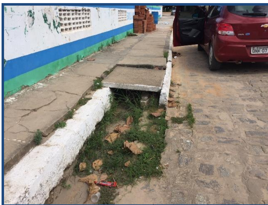
Figura 13 - Captação de água pluvial na Rua Domingos André Fonte: Premier Engenharia, 2018.
