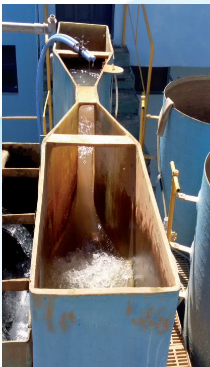
Figura 33 – Calha Parshall Fonte: GESOIS, 2017
