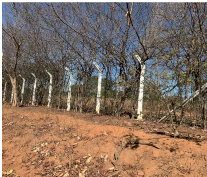
Figura 46 – Cercamento na Área da ETE em São Romão Fonte: GESOIS, 2017
