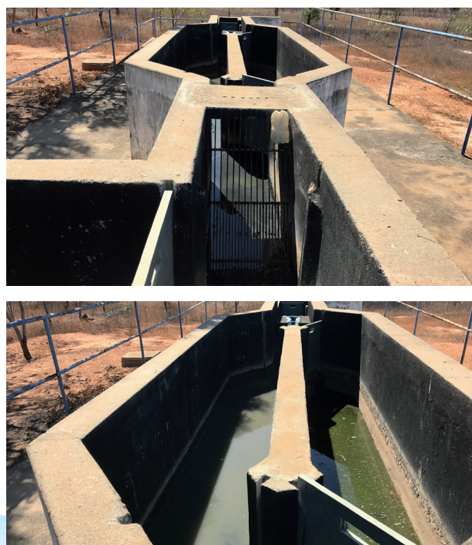
Figura 42 – Tratamento Primário (Canal de Chegada e Calha Parshall) em São Romão Fonte: GESOIS, 2017
