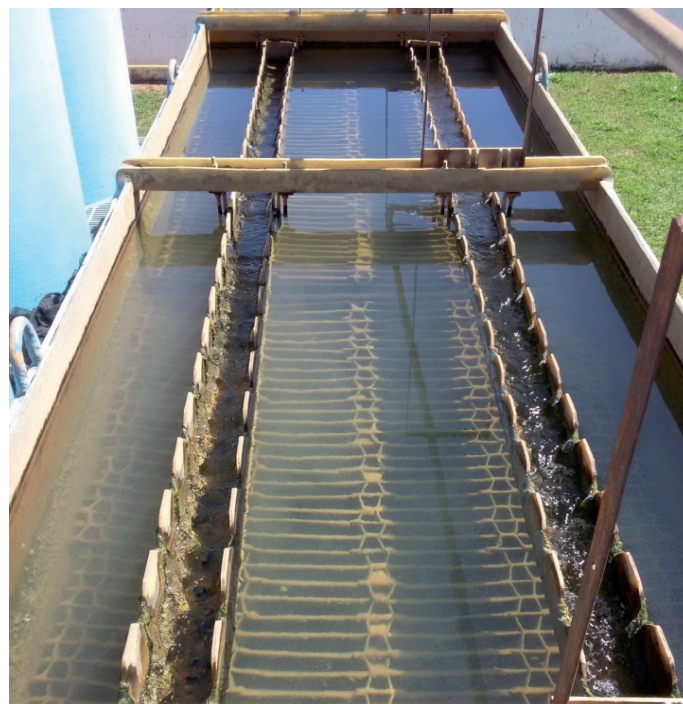
Figura 34 – Flocculadores Fonte: GESOIS, 2017
