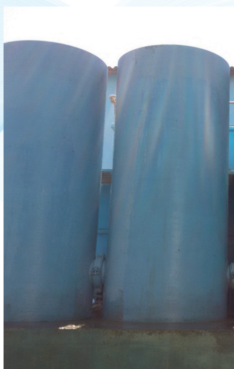
Figura 36 – Filtros de Água Fonte: GESOIS, 2017
