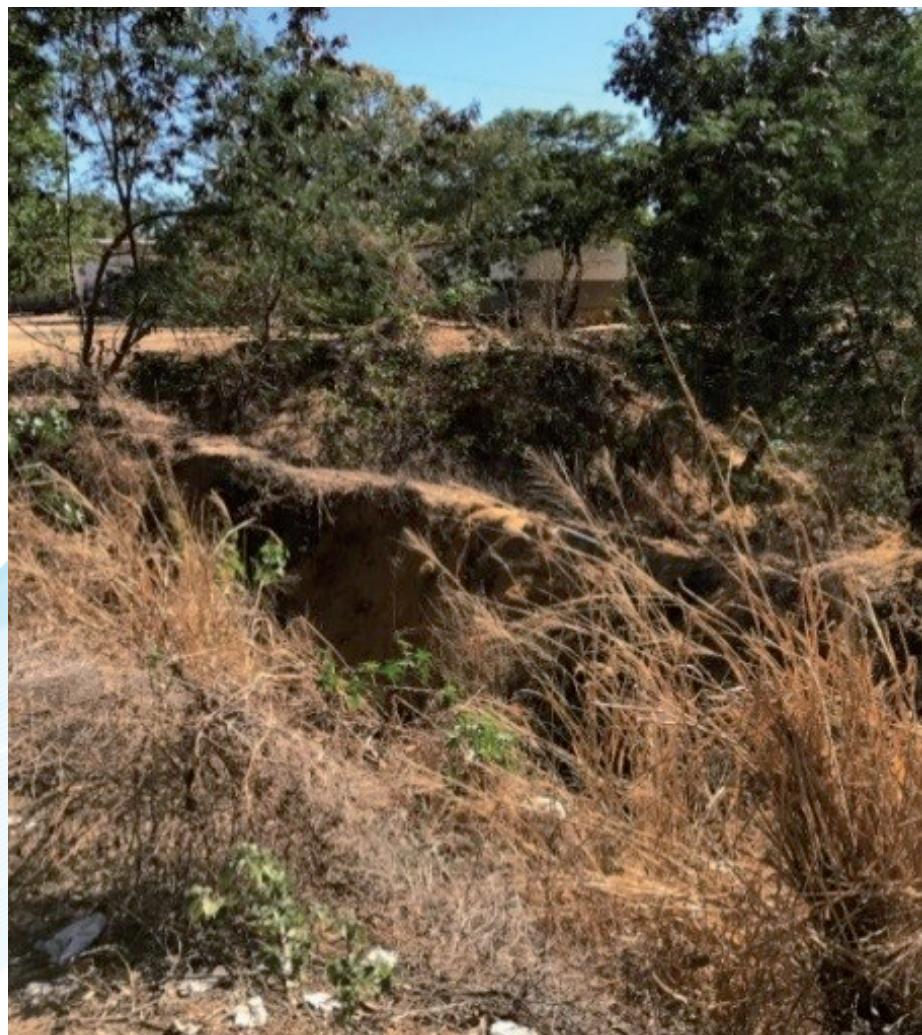
Figura 65 – Erosão às Margens do Rio São Francisco Provocado por Águas Pluviais no Distrito Ribanceira (quilombola)
