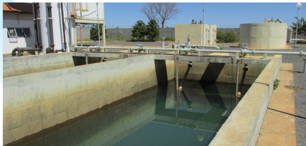
Figura 36 – Dispositivos de Limpeza de Filtro em Jaíba Fonte: GESOIS, 2017
