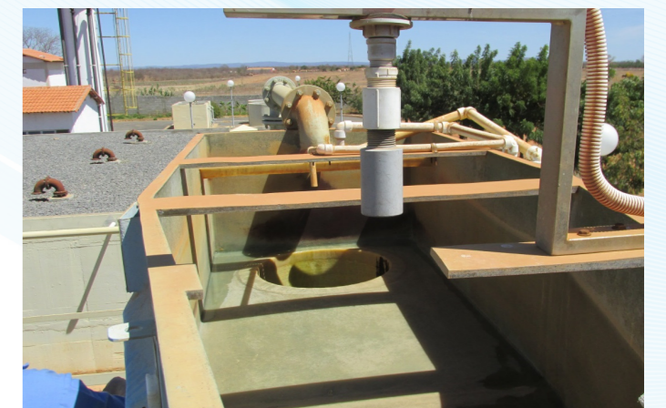
Figura 33 – Estação de Tratamento d'Água – Chegada de Água Bruta em Jaíba Fonte: GESOIS, 2017
