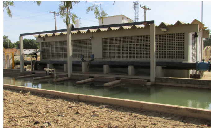
Figura 50 – Estação de Bombeamento - EB 4F em Perímetro de Irrigação Jaíba Fonte: GESOIS, 2017.
