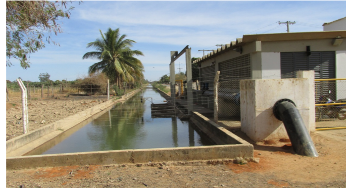
Figura 49 – Estação de Bombeamento - EB 4F em Perímetro de Irrigação Jaíba Fonte: GESOIS, 2017
