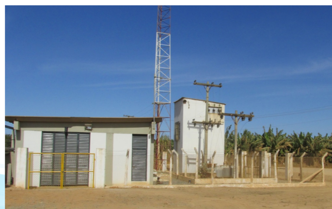
Figura 53 – Estação de Bombeamento - EB 3F em Perímetro de Irrigação Jaíba Fonte: GESOIS, 2017
