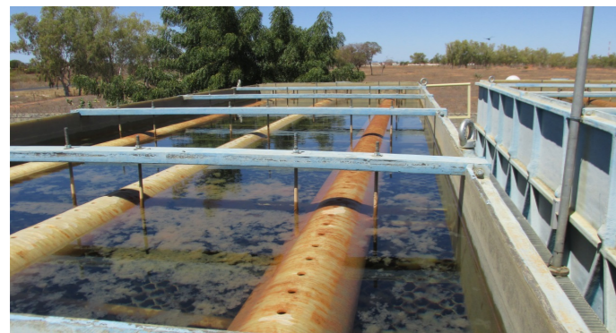
Figura 35 – Estação de Tratamento d'Água – Decantadores em Jaíba Fonte: GESOIS, 2017
