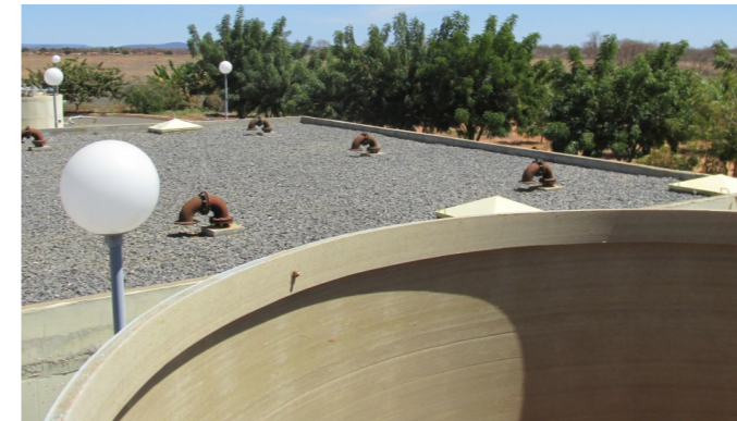
Figura 38 – Reservatório Apoiado (RAP) em Jaíba Fonte: GESOIS, 2017
