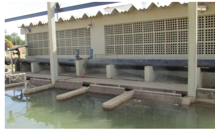
Figura 51 – Estação de Bombeamento - EB 4F em Perímetro de Irrigação Jaíba Fonte: GESOIS, 2017
