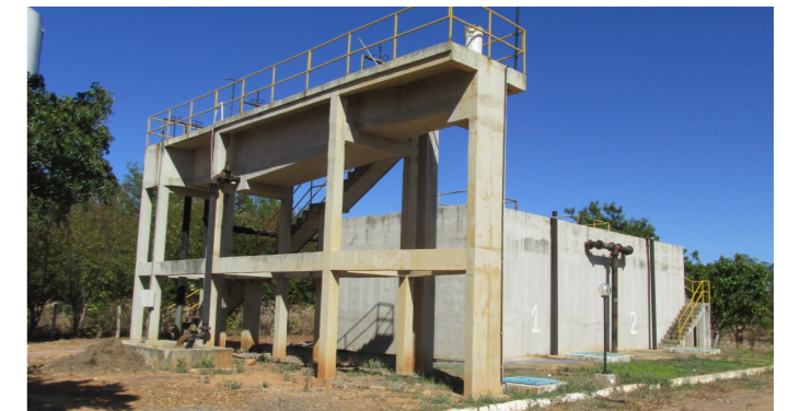
Figura 62 – Estrutura de Chegada e RAFA em Jaíba Fonte: GESOIS, 2017
