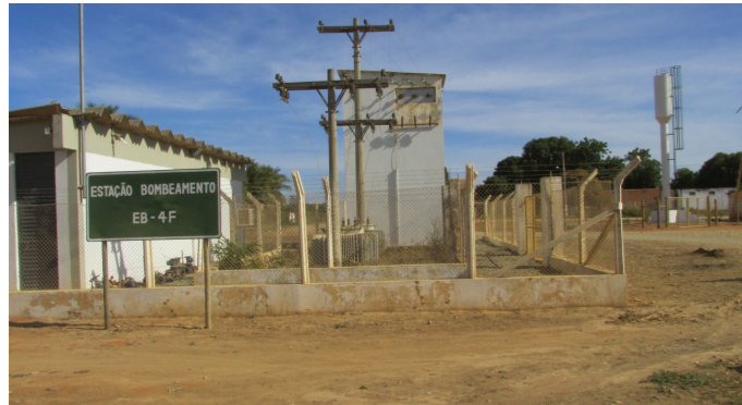
Figura 48 – Estação de Bombeamento - EB 4F em Perímetro de Irrigação Jaíba Fonte: GESOIS, 2017
