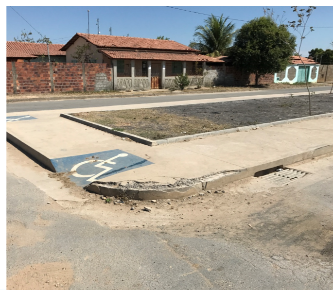
Figura 56 – Aspectos de Assentamento das Poucas Bocas de Lobo em Ponto Chique Fonte: GESOIS, 2017
