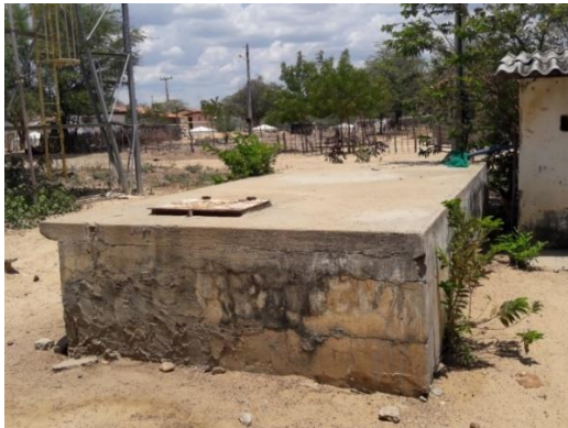
Figura 37- Reservatório de água tratada na localidade de Vila Aparecida
