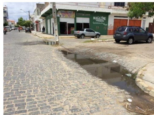
Figura 88 - Ponto de alagamento na Rua Dr. Severino F. dos Santos, ao lado da Secretaria de Educação
