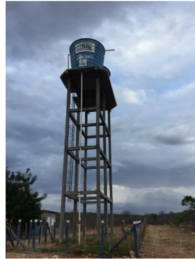
Figura 35- Reservatórios na área elevada da localidade de Tamboril
