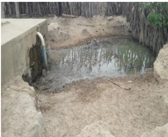
Figura 31- Evidências de vazamento no reservatório de água
