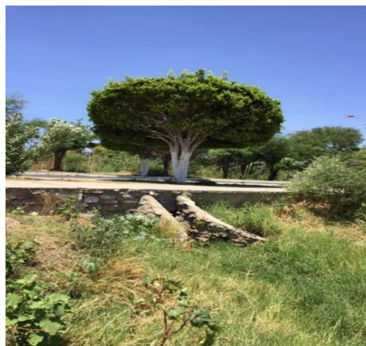
Figura 78 - Bueiros para passagem de água – Sede
