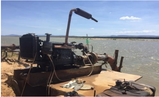
Figura 30- Bomba da captação, com destaque em vermelho a ponto de vazamento e em amarelo a adutora de água bruta
