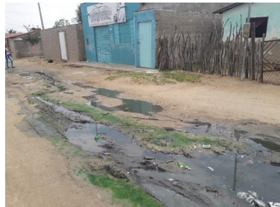
Figura 46 - Esgoto a céu aberto em Vila Matilde
