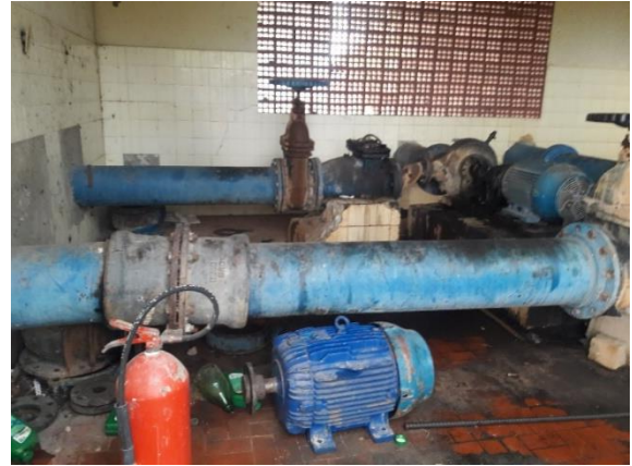
Figura 25 - Estação elevatória de água tratada na ETA
