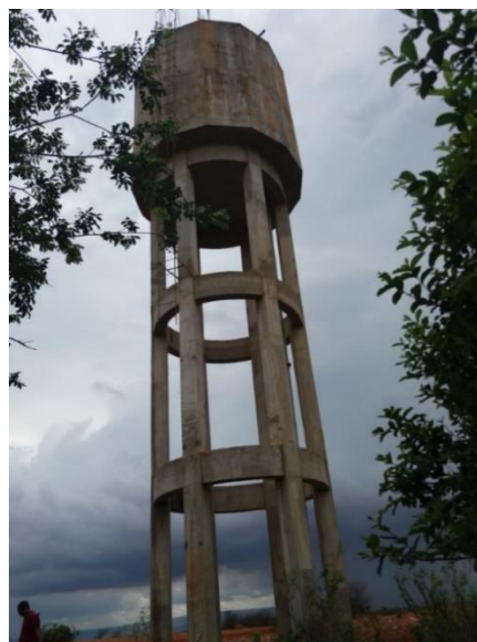
Figura 23 – Reservatório de Sapecado Fonte: Projeta Engenharia (2017)
