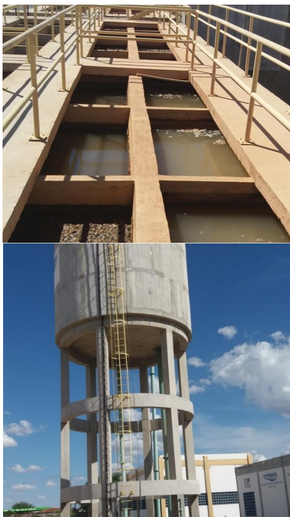
Figura 21 – Câmaras de floculação e reservatório de uso geral na ETA Rio Verde
