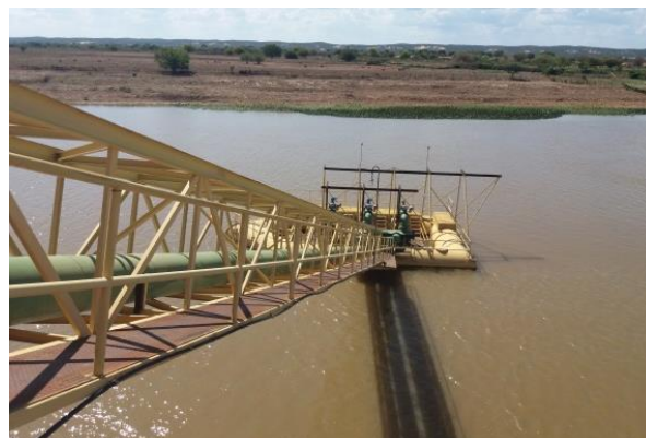
Figura 20 – Entrada do local de captação e adutora de água bruta; Balsa flutuante da captação no Rio São Francisco
