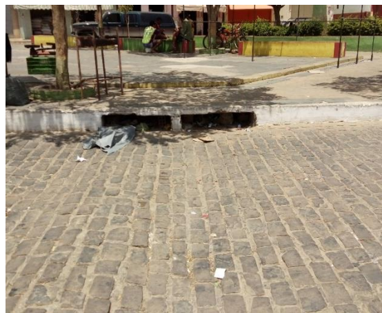
Figura 69 - Boca de Lobo situada na praça do Comércio que faz a interceptação das águas pluviais e a direciona para a Lagoa do Ferreira
