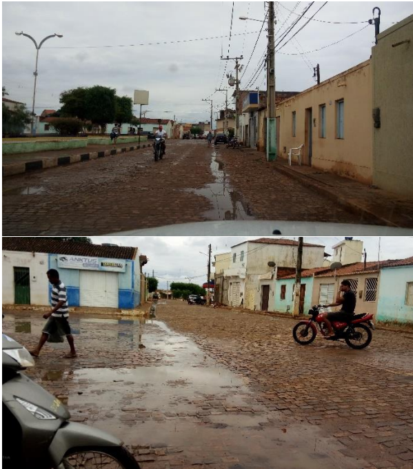
Figura 80 – Ponto de alagamento na Sede Municipal
