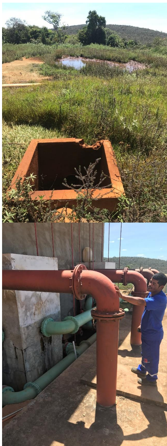
Figura 26 – Tubulação e leito de secagem do lodo – ETA Mulungu e Souto Soares
