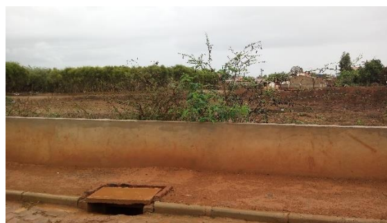
Figura 78 – Boca de lobo na Sede do município
