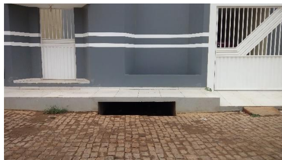
Figura 79 – Boca de lobo na Sede do município
