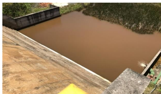
Figura 42 – Água de escape da Barragem Rio Tijuco – Juliana/Mulungu
