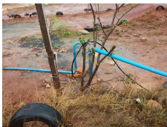
Figura 24 – Poço artesiano do Parque da Cidade (Profundidade: 150 m; Vazão: 20 m 3 /h; Potência da bomba: 6 CV)
