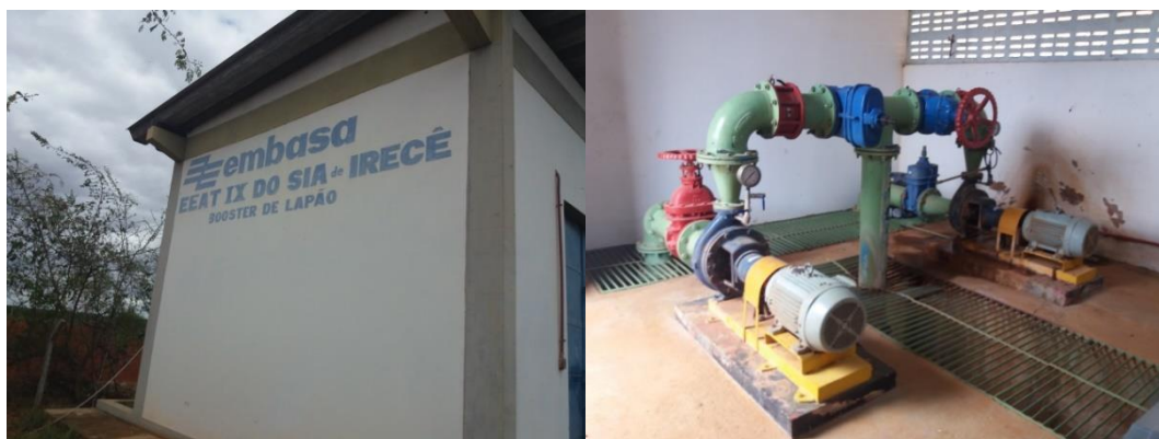
Figura 23 – Estação Elevatória de Tanquinho e conjunto moto-bomba
