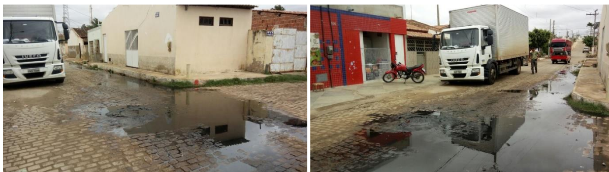
Figura 31 – Vazamentos de esgoto sanitário na Rua José Vilela, na sede de Lapão
