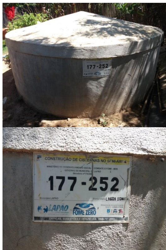
Figura 28 – Cisterna construída pelo Programa Cisternas e placa de identificação, em Lagoa Bonita
