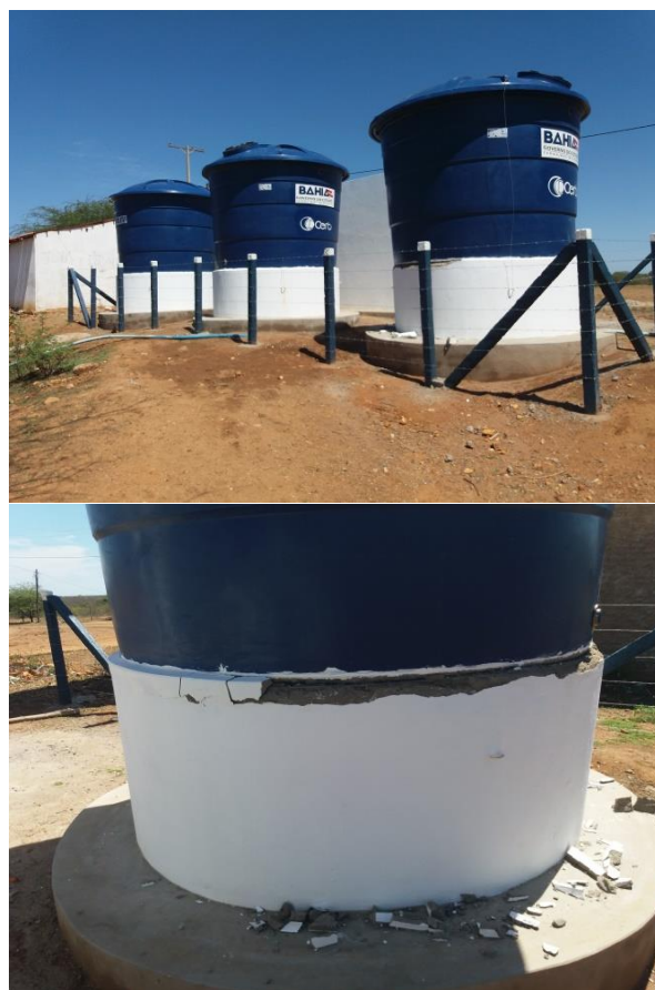
Figura 26 – Estação de Dessalinização em Lagedinho
