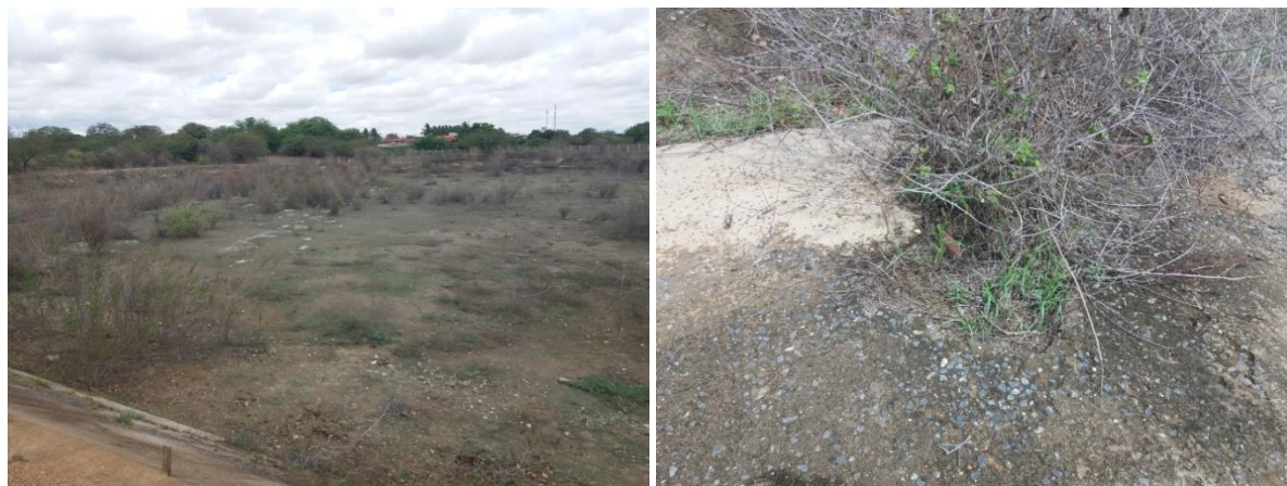
Figura 35 – Lagoa de Maturação 1 (a) e canal de passagem da Lagoa de Maturação 2 (b), na ETE da sede de Lapão
