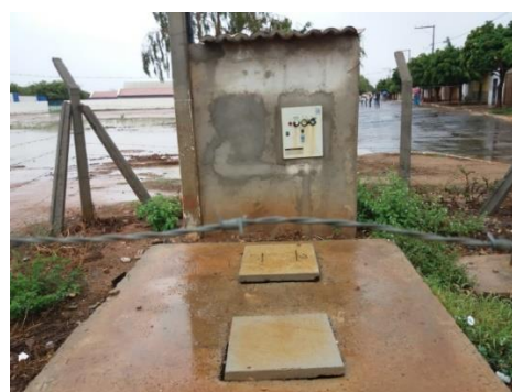
Figura 32 – Estação Elevatória de Esgoto na Rua do Hospital, na sede de Lapão
