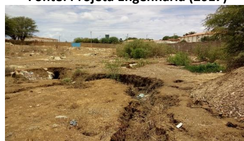
Figura 77 – Área identificada com processo erosivo, na sede municipal Projeta Engenharia (2017)
