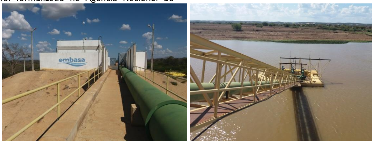
Figura 5-5 – Entrada do local de captação e adutora de água bruta (à esquerda); balsa flutuante da captação no Rio São Francisco (à direita)
