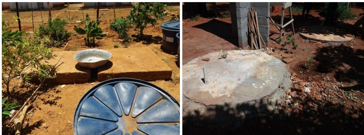
Figura 5-21 – Fossa rudimentar, em uma Agrovila em Mundinho (à esquerda); fossa rudimentar e sumidouro em uma casa construída pelo programa Minha Casa Minha Vida, em Bebedouro de Barreiros (à direita)
