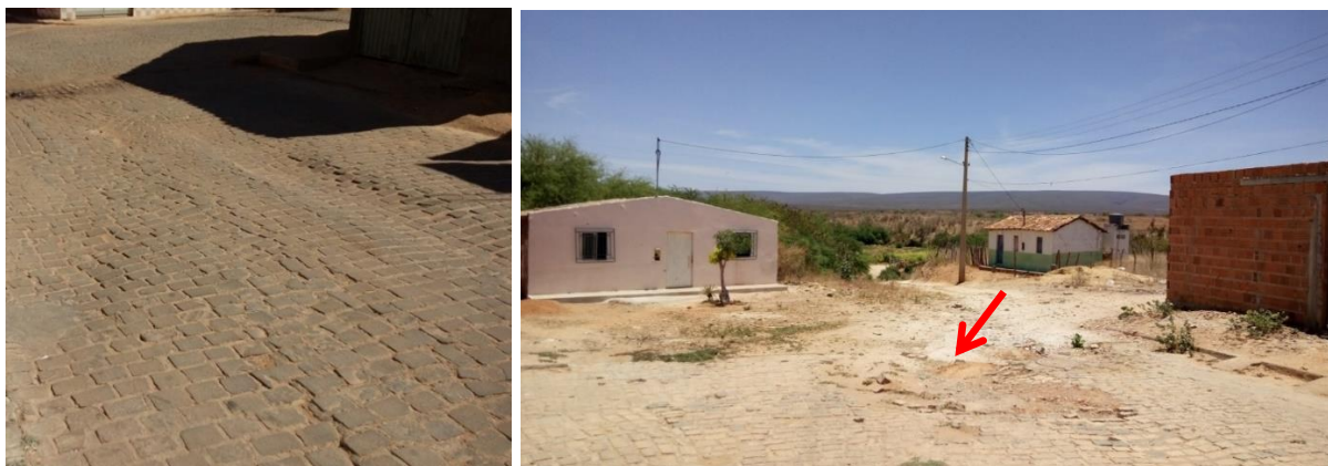
Figura 5-47 - Tipo de Pavimentação (à esquerda); Encontro de via pavimentada com via não pavimentada na sede e área com buraco na rua Rui Barbosa (à direita), no município de Itaguaçu da Bahia
