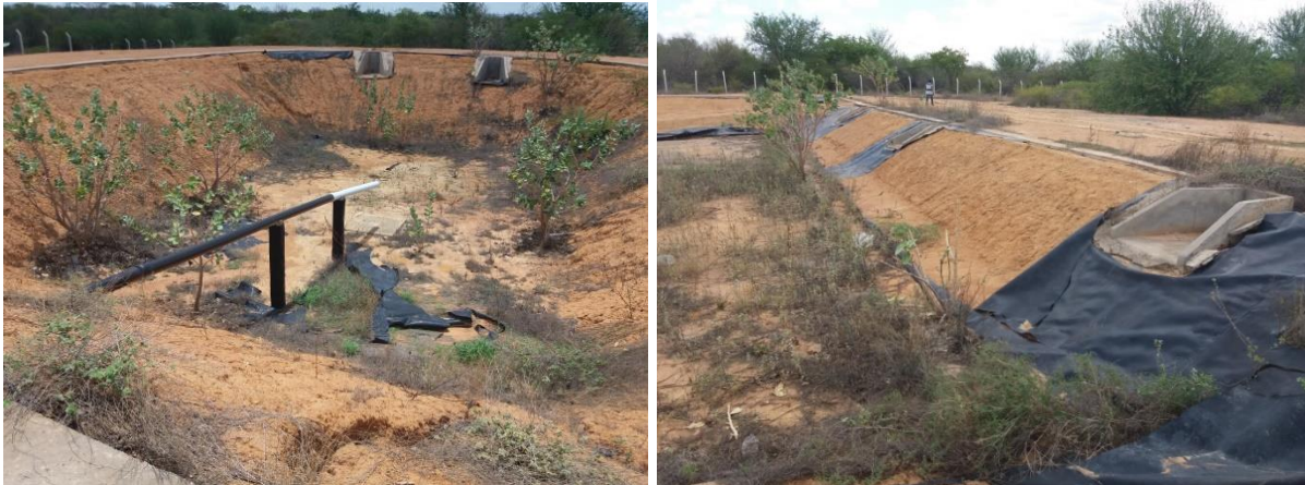
Figura 5-20 – Lagoa anaeróbia (à esquerda) e lagoa facultativa (à direita) do SES, na sede de Itaguaçu da Bahia
