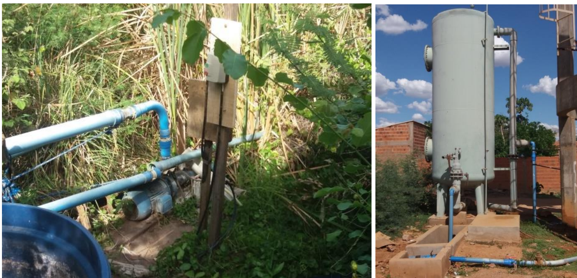
Figura 5-9 – Ponto de captação no Rio Verde (à esquerda); Filtro de tratamento (à direita). Fonte: Projeta Engenharia (2017)
