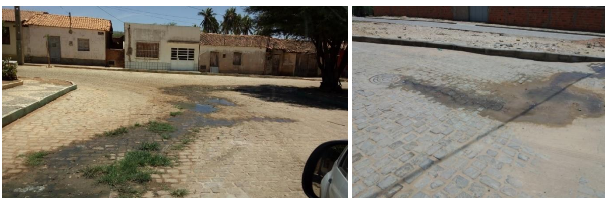
Figura 5-17 – Vazamento de esgoto na Rua Clovis Peregrino (à esquerda) e do poço de visita na Rua José Búzio de Carvalho (à direita), na sede de Itaguaçu da Bahia.
