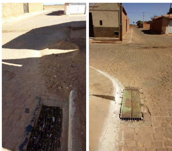
Figura 5-53 - Entupimento de boca de lobo próximo à Prefeitura (à esquerda); Boca de lobo com chapa de metal próximo à Prefeitura (à direita) na sede municipal
