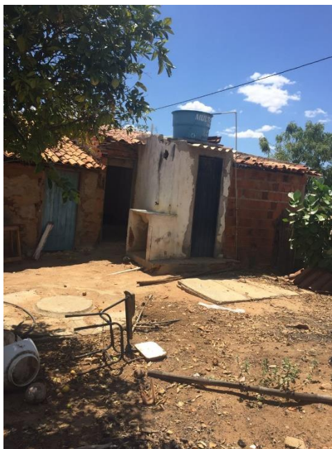
Figura 5-22 – Banheiro, tanque séptico e sumidouro instalados pela Funasa, em Maravilhas.
