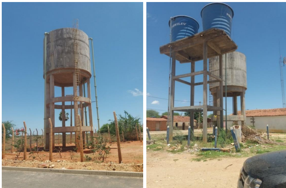
Figura 5-7 – Reservatório da sede de Itaguaçu da Bahia (à esquerda); Reservatórios (de fibra) da localidade de Rio Verde I (à direita).
