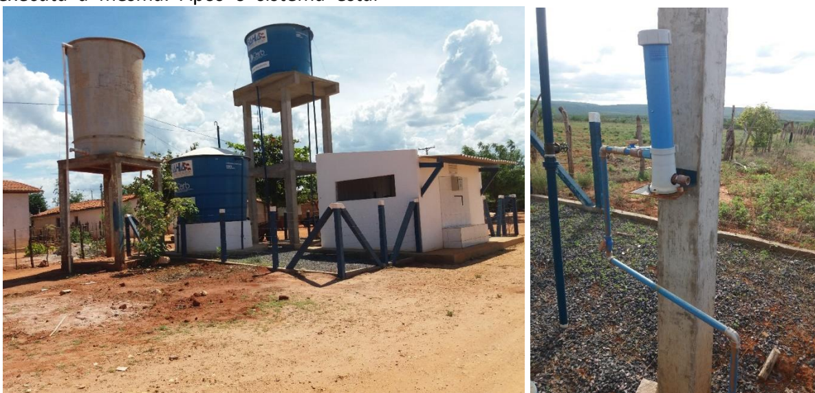
Figura 5-10 – Estação de Dessalinização em Bebedouro de Barreiros (à esquerda); Sistema Simplificado com cloro em pastilha em Estrada do Poço (à direita) Fonte: Projeta Engenharia (2017)
