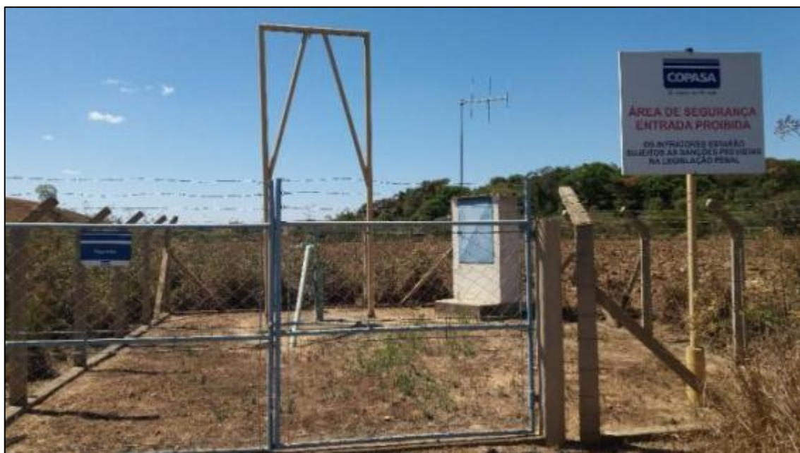
Figura 51: Poço de captação - água bruta
