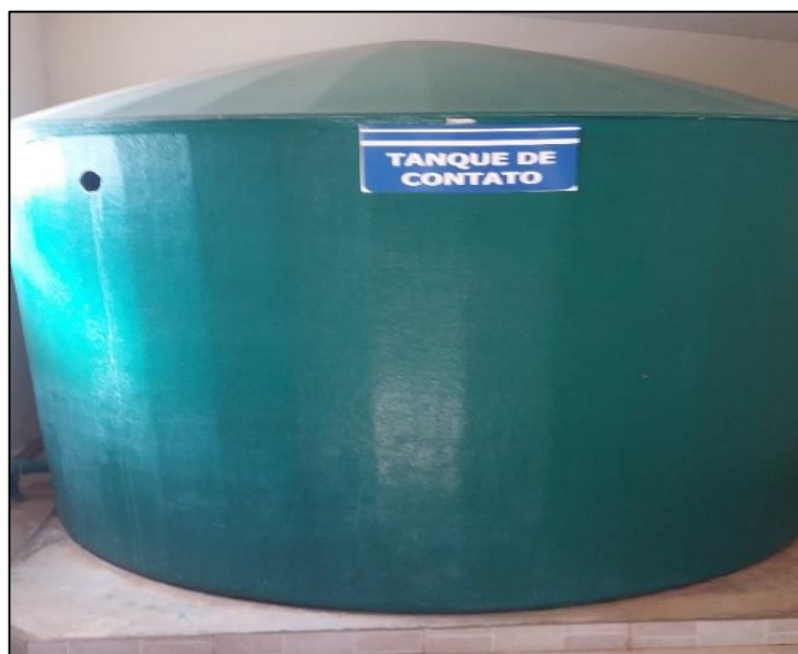
Figura 57: Tanque de contato
