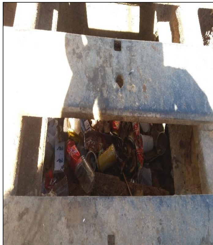
Figura 109: Elemento de microdrenagem - 4 Fonte: PRO BRAS, 2017
