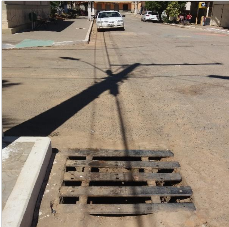
Figura 106: Elemento de microdrenagem - 1 Fonte: PRO BRAS, 2017
