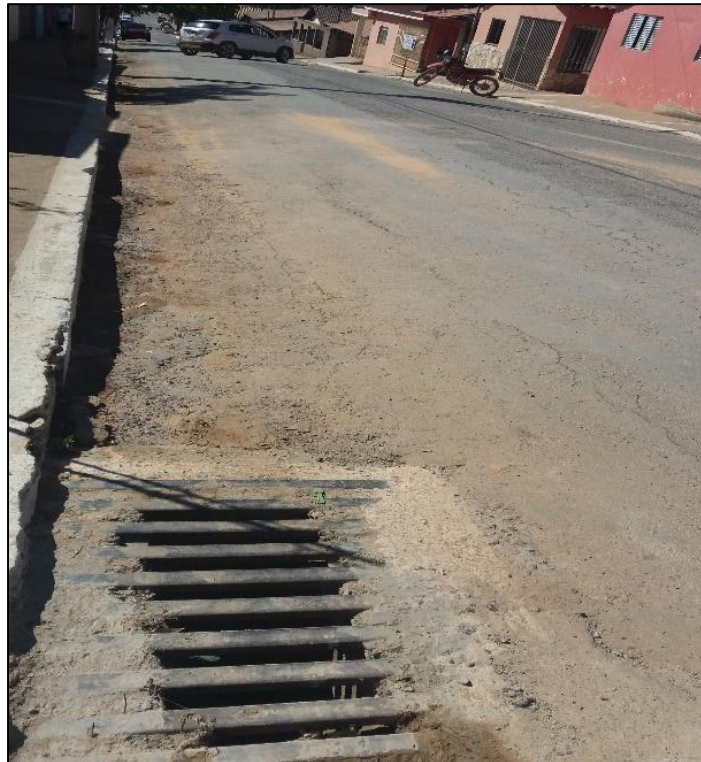
Figura 108: Elemento de microdrenagem - 3 Fonte: PRO BRAS, 2017
