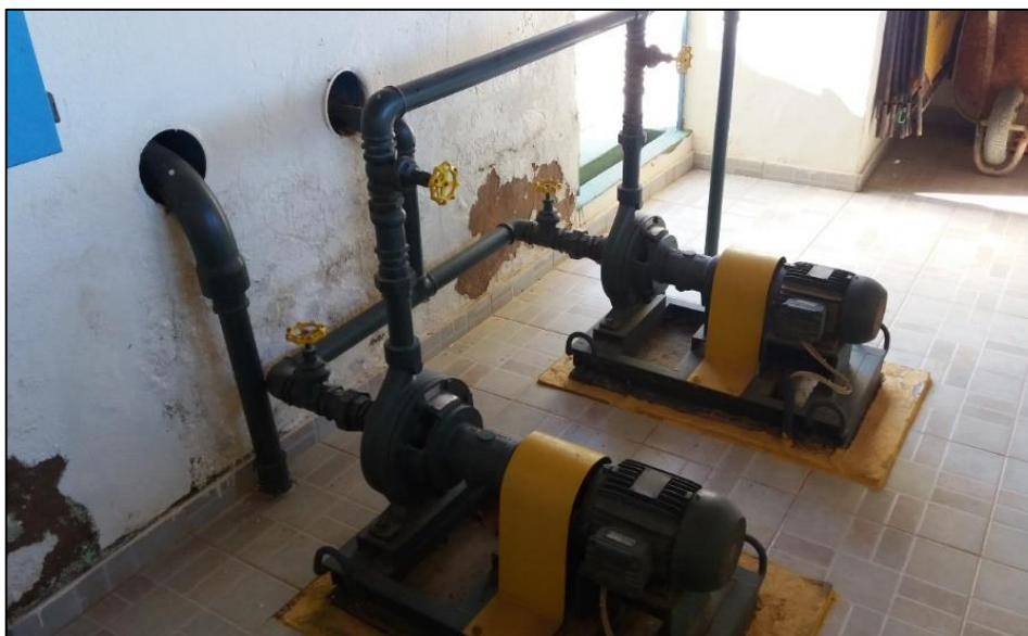
Figura 60: Conjunto moto bomba na ETA
