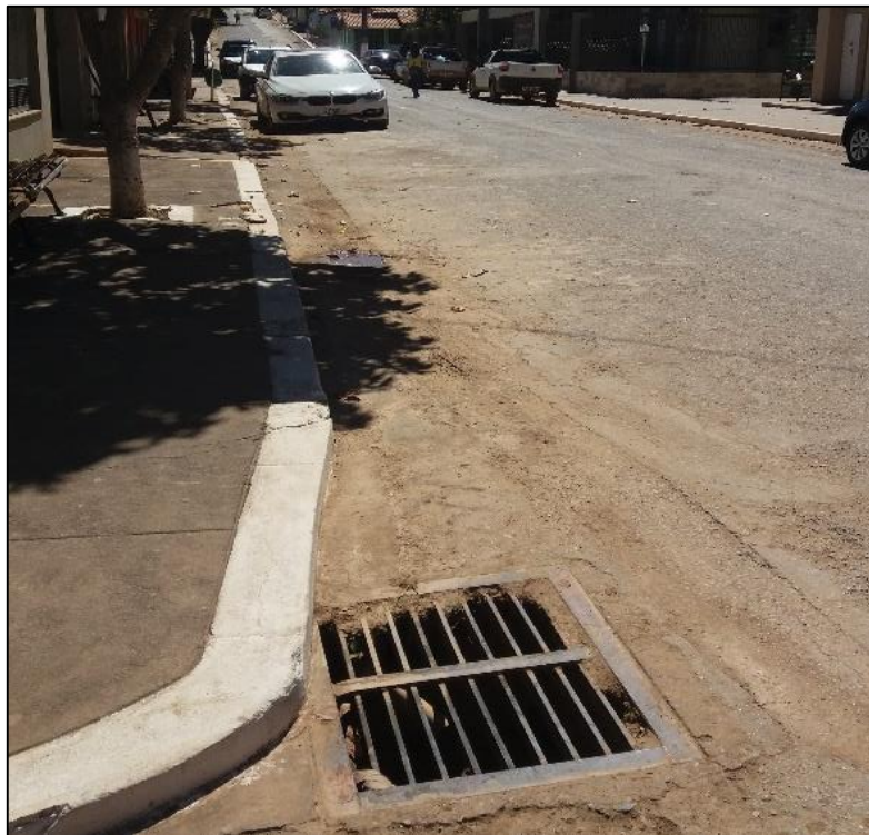
Figura 107: Elemento de microdrenagem - 2 Fonte: PRO BRAS, 2017
