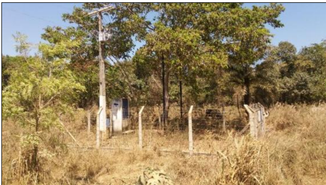
Figura 52: Poço reserva para captação de água bruta
