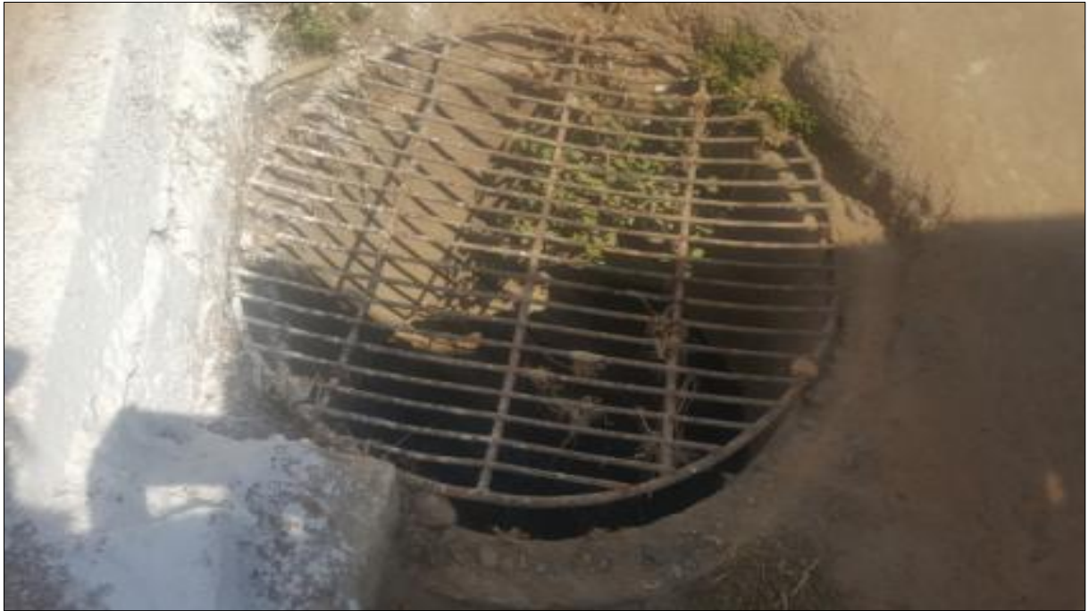
Figura 178: Estrutura da rede de drenagem pluvial - rua Joaquim Pinto Lara
