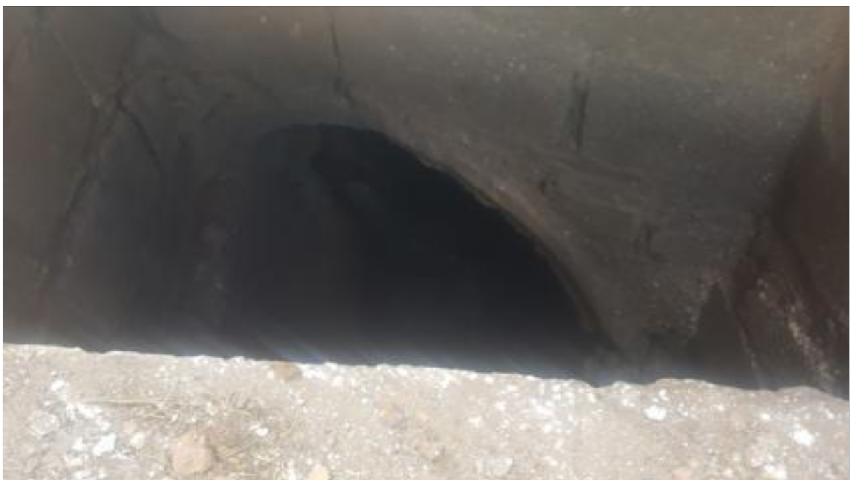
Figura 177: Estrutura da rede de drenagem pluvial - rua Joaquim Pinto Lara
