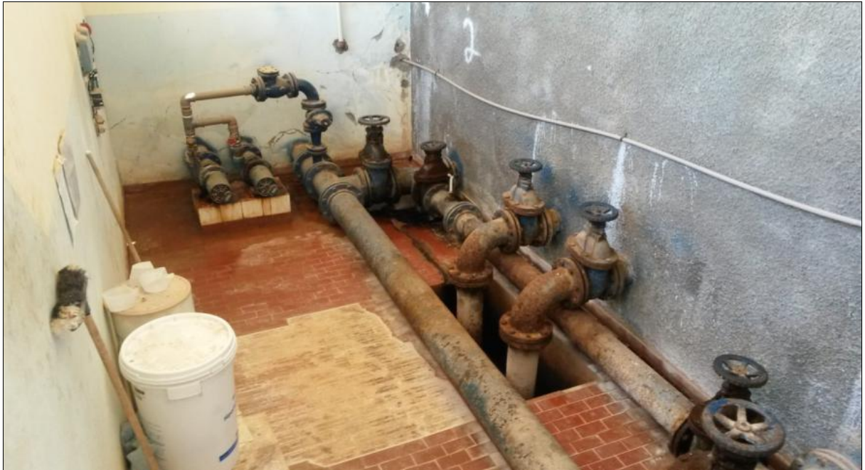
Figura 80: Conjunto moto bombas na ETA
