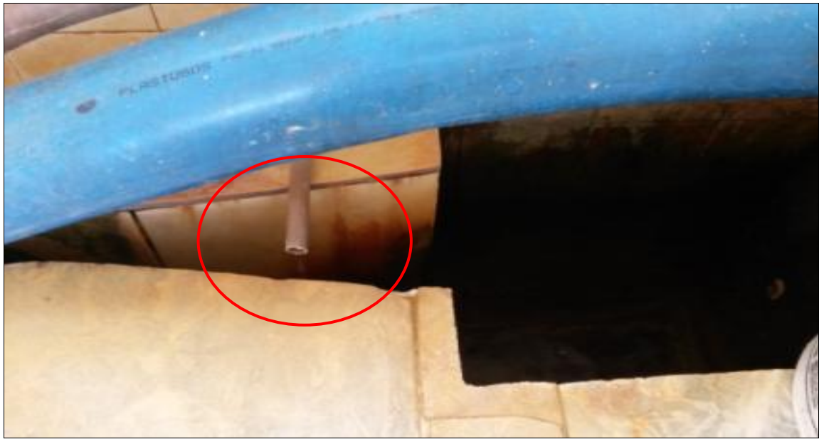
Figura 75: Chegada da água bruta na ETA – captação córrego Lage
