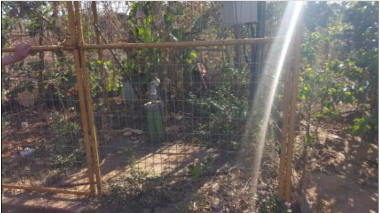
Figura 103: Captação subterrânea – comunidade Quilombo
