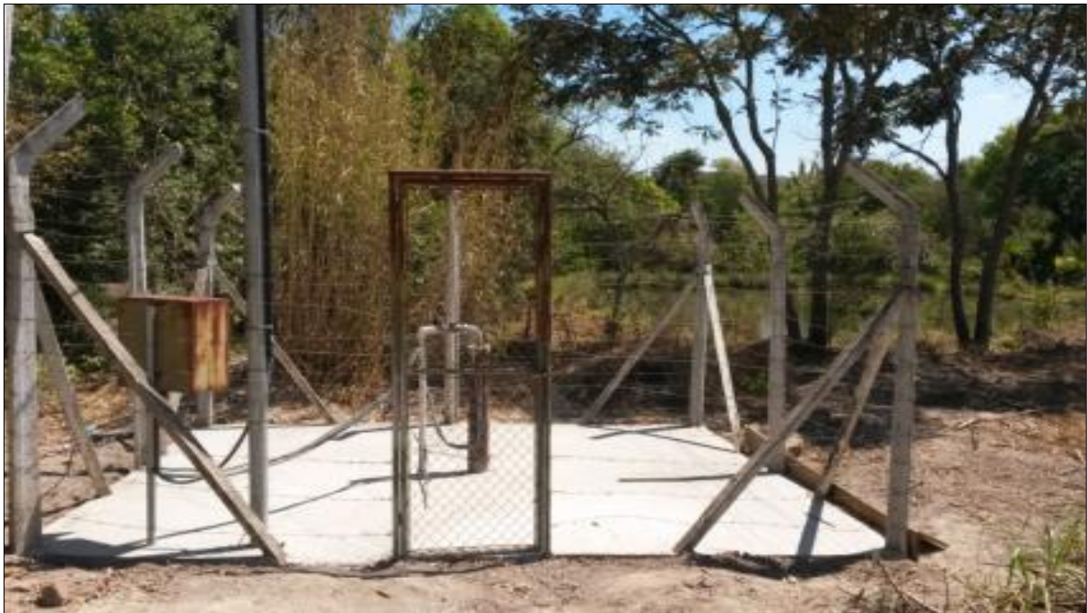
Figura 90: Captação de água subterrânea – comunidade Aguada
