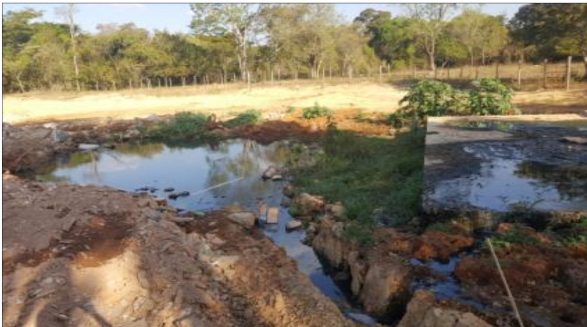
Figura 117: Fossa séptica coletiva
