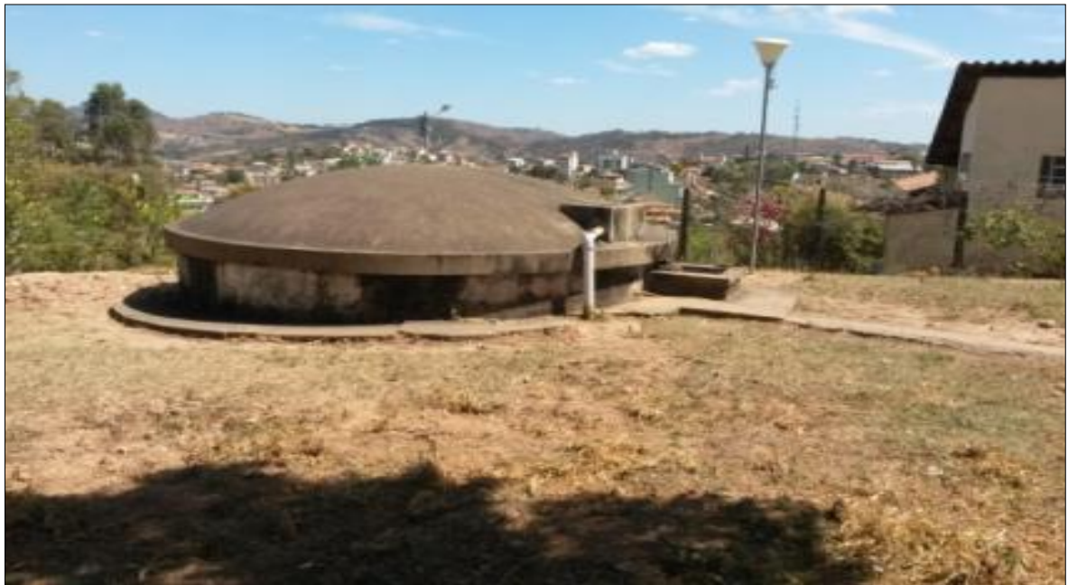
Figura 81: Reservatório na ETA – semi-enterrado
