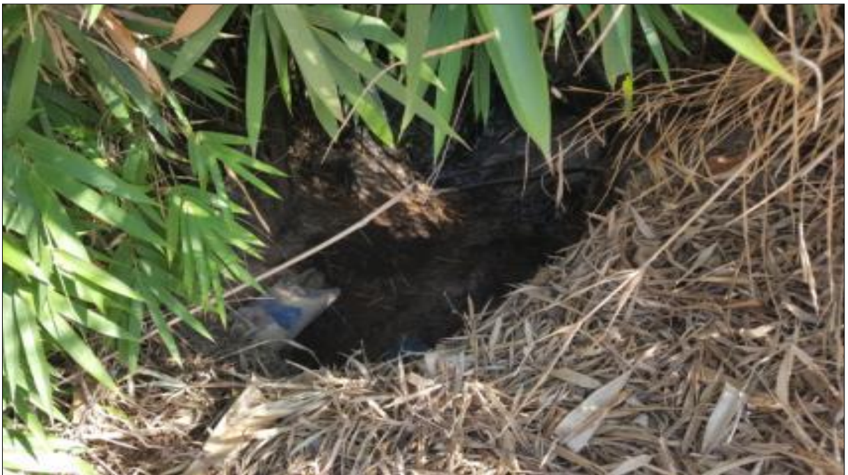
Figura 119: Lançamento de esgoto na rua Almando de Moraes
