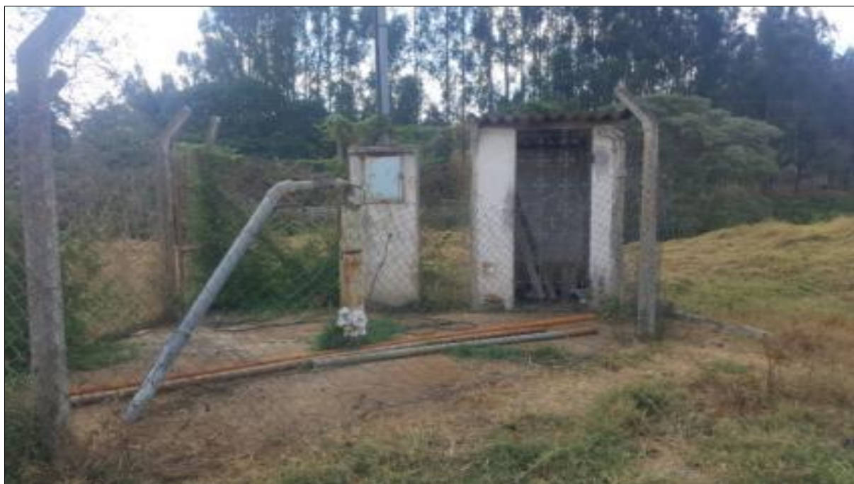
Figura 68: Captação subterrânea Manuel Sampaio
