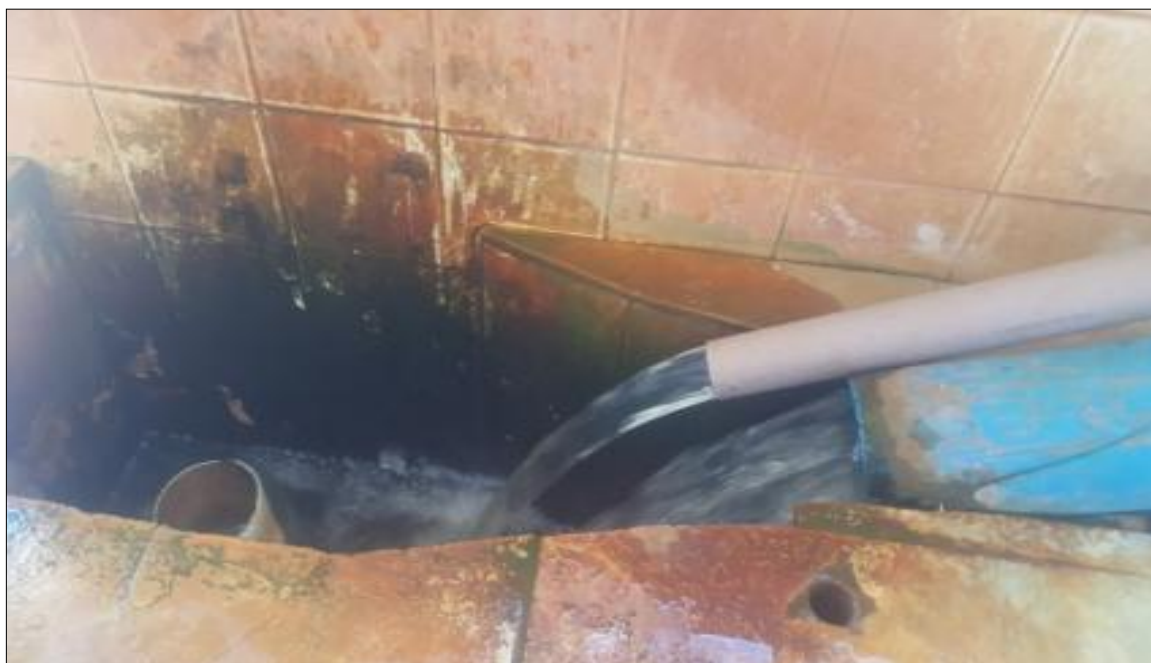
Figura 74: Chegada da água bruta na ETA – Captação ribeirão das Chácaras
