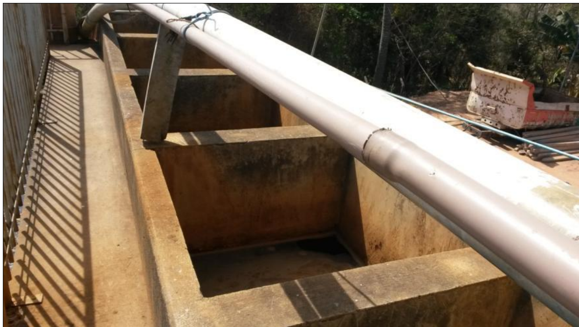
Figura 76: Floculadores na ETA
