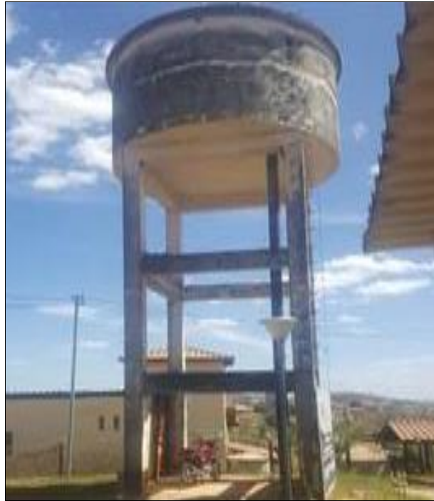
Figura 82: Reservatórios na ETA - elevado
