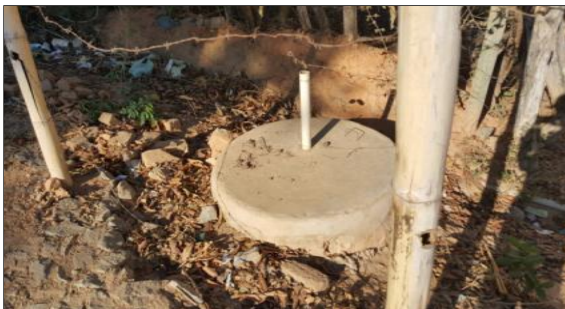
Figura 123: Fossa negra comunidade Joaquim Rodrigues
