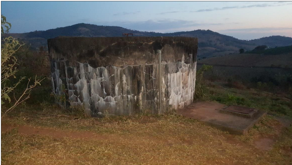
Figura 102: Reservatório de água - comunidade Morro Verde
