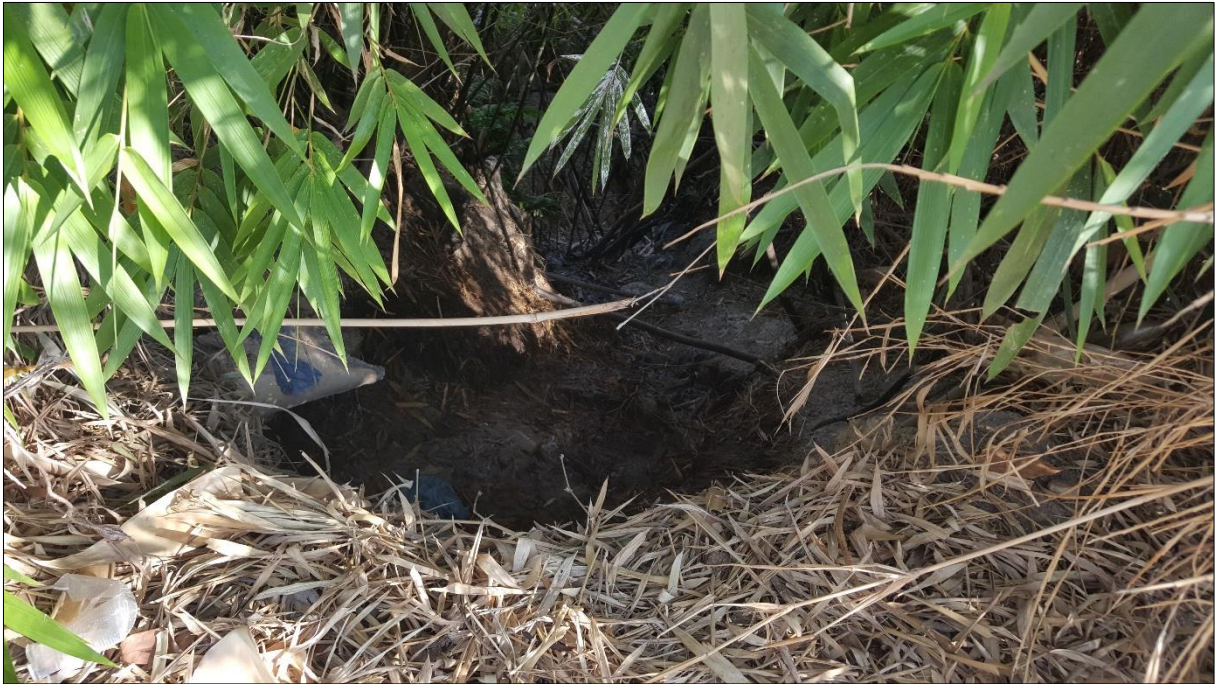
Figura 118: Lançamento de esgoto na rua Almando de Moraes
