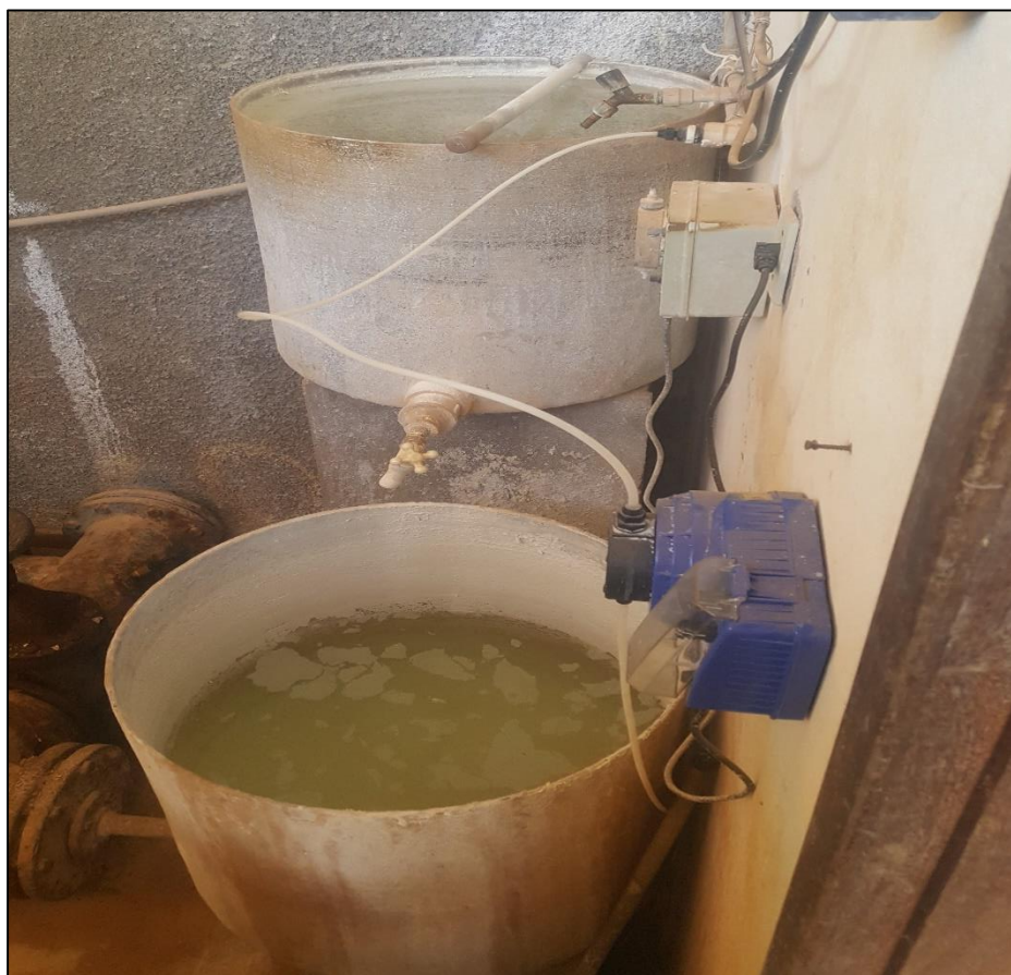
Figura 83: Produtos químicos estocados na ETA
