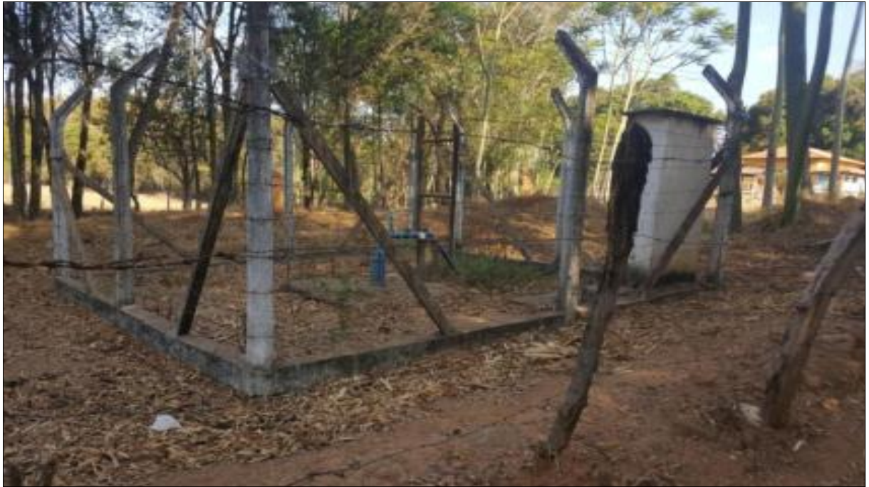
Figura 69: Captação do bairro Castros e Laranjeiras
