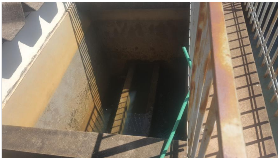
Figura 78: Filtros na ETA
