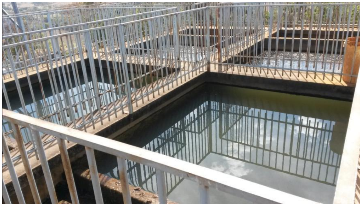
Figura 77: Decantadores na ETA
