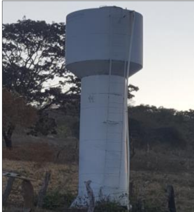
Figura 101: Reservatório - comunidade Laje
