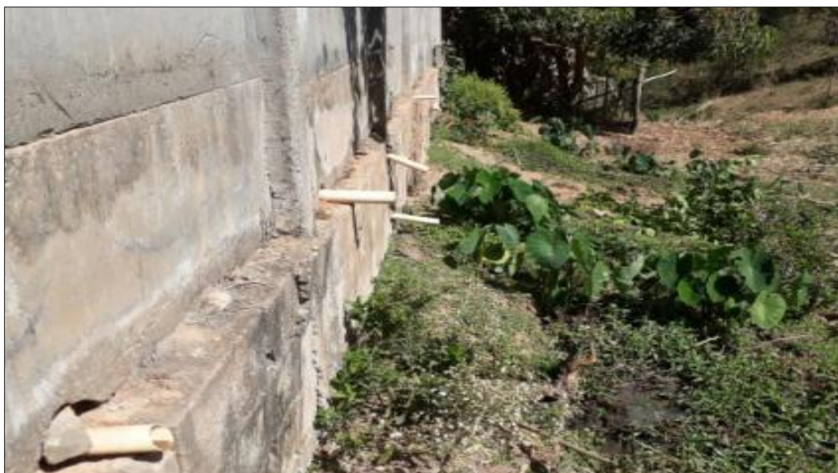
Figura 112: Lançamento de esgoto a céu aberto – bairro Fonte das Pedras
