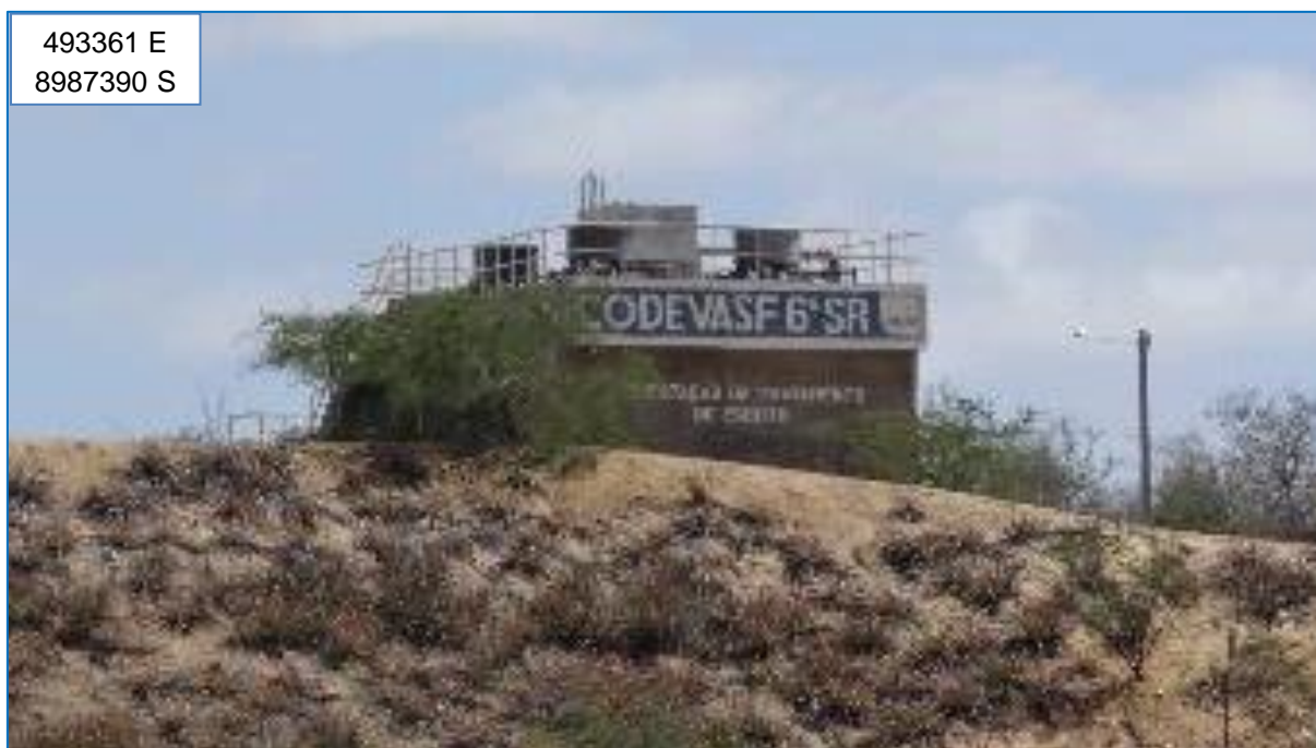
Figura 73 – Reator anaeróbio pertencente à estação de tratamento de esgoto.
