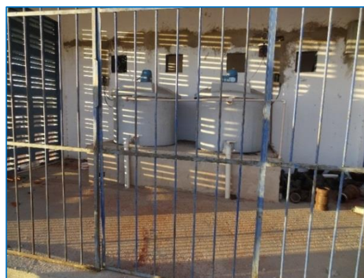
Sistema de desinfecção.
