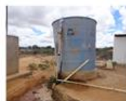
Reservatório 10m³ (reserva poço)
