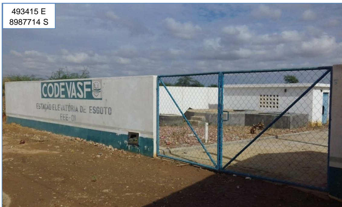
Figura 74 – Estação elevatória de esgoto (EEE-01).
