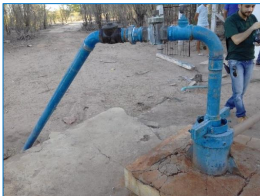
Poço (captação da água subterrânea).
