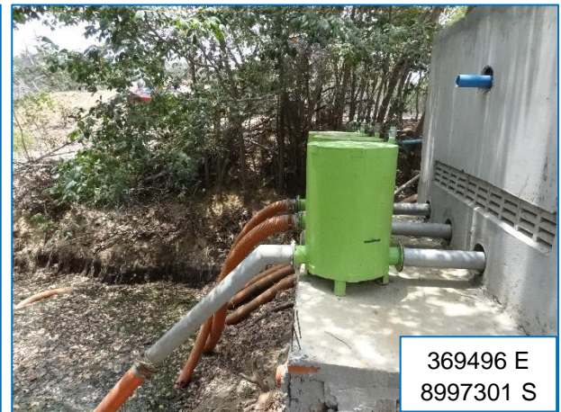
Bombas para captação de água
