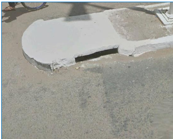
Figura 105 – Boca de lobo observada na sede municipal. Fonte: EnvEx Engenharia e Consultoria, 2017.
