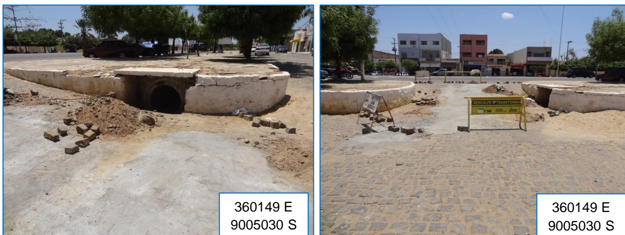
Figura 106 – Galeria de águas pluviais na sede municipal. Fonte: EnvEx Engenharia e Consultoria, 2017.
