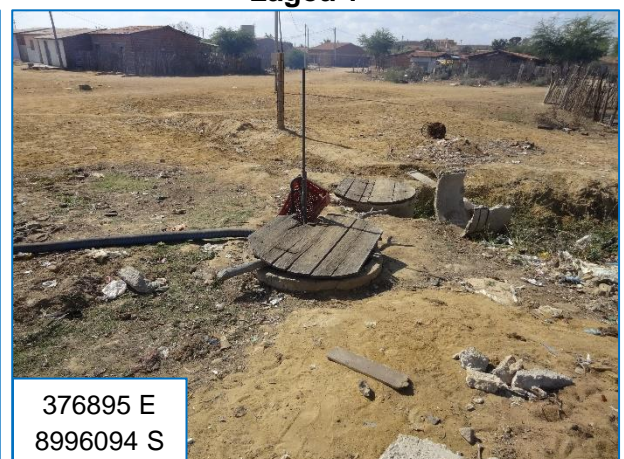
Estação elevatória de esgoto
