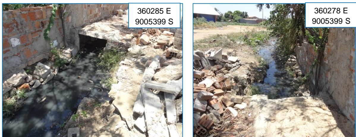
Figura 107 – Lançamento de esgoto em canal de drenagem.
