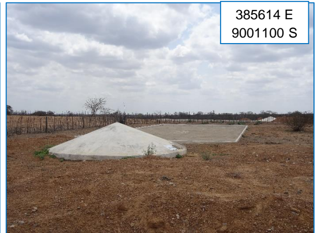
Cisterna de terraço – PA Malhada Real
