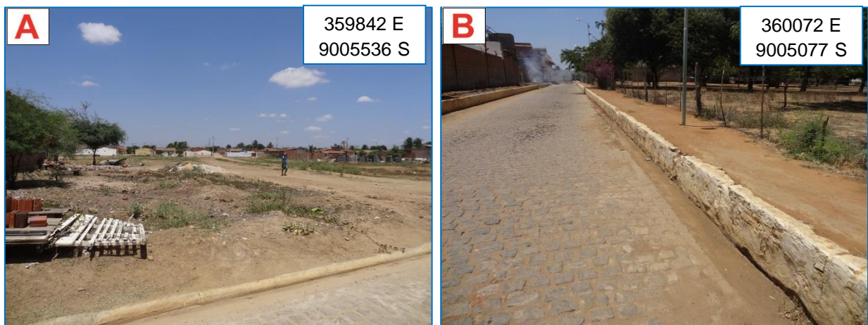
Figura 104 – Meios fios e sarjetas encontrados na sede municipal. Avenida Hélio Ferreira Lima (A) e rua Agamenon Magalhães (B).
