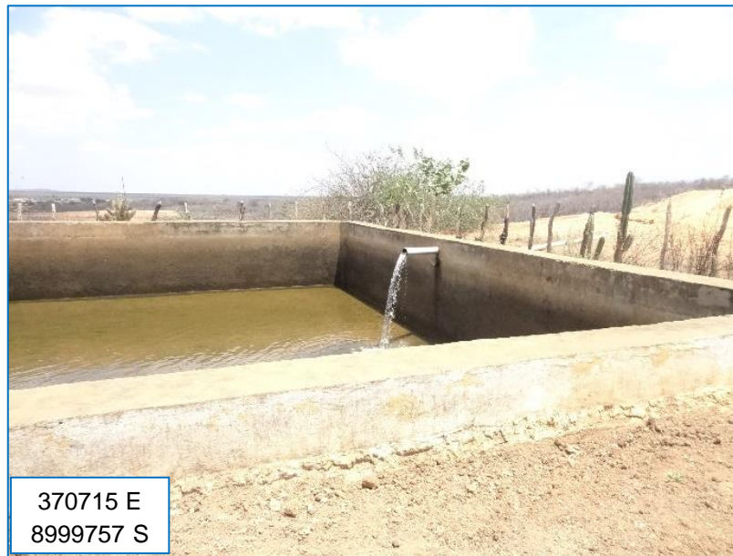
Figura 71 – Sistema de abastecimento existente na comunidade Martins. Fonte: EnvEx Engenharia e Consultoria, 2017.
