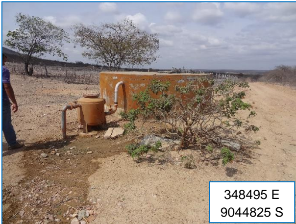
Reservatório com bomba
