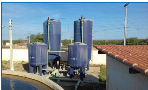
Filtros e floco decantadores
