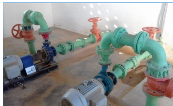
Elevatórias para os reservatórios do distrito e sede
