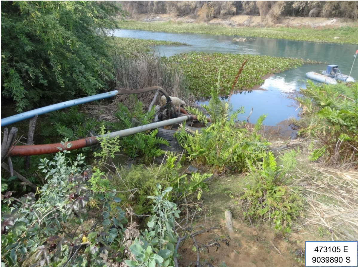
Figura 77 - Captação no rio São Francisco, com bomba equipada com mangote (ao lado da captação do PA Antonio Conselheiro). Fonte: Elaborado por EnvEx Engenharia e Consultoria, 2018.
