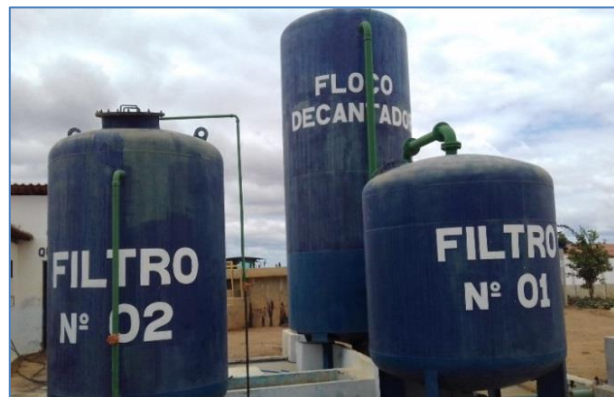
ETA – filtros nº 1 e 2 e floco decantador Figura 66 – Componentes do tratamento de água na sede do município. Nota: Coordenadas 487570 E / 9035548 S Fonte: EnvEx Engenharia e Consultoria, 2017.
