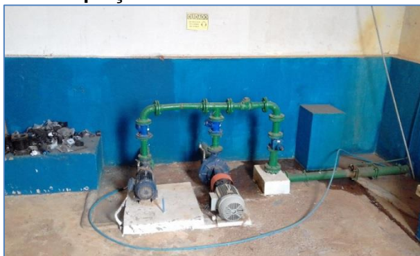
Elevação de água bruta
