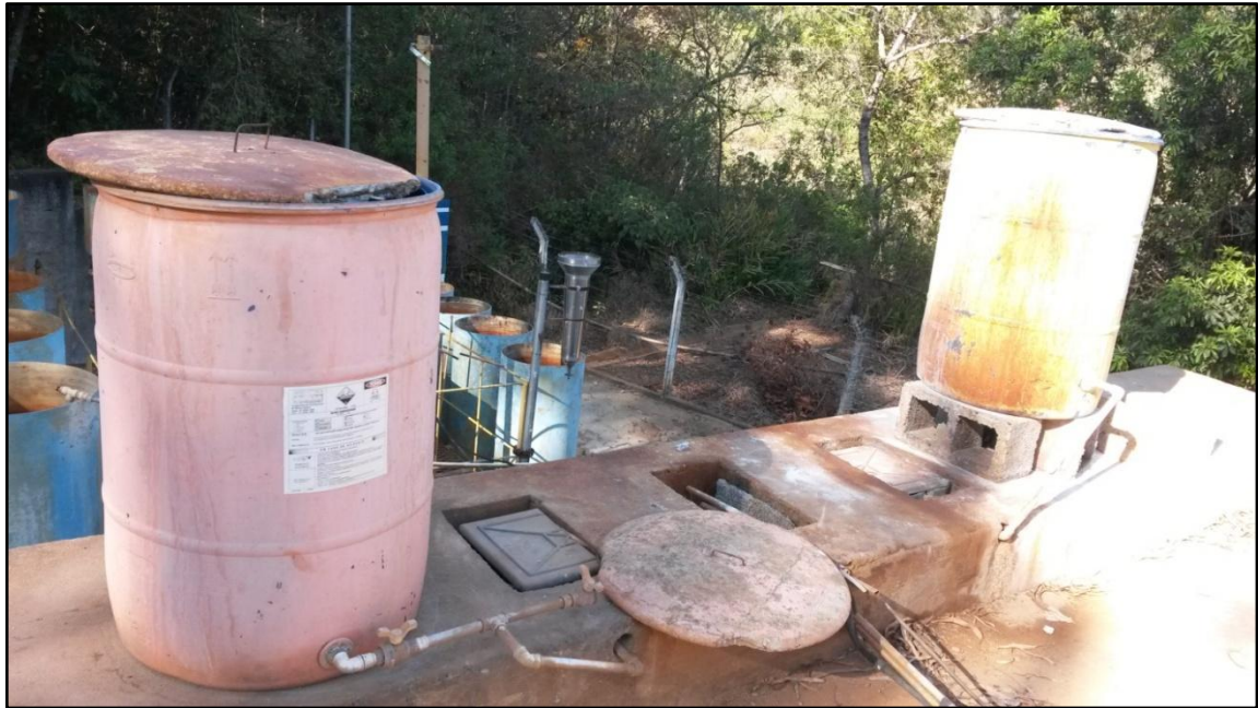
Figura 76: Armazenamento dos produtos químicos na ETA
