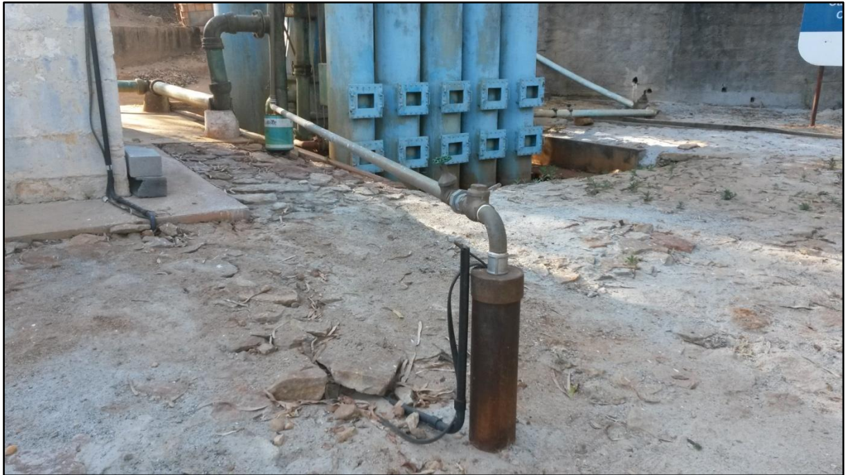
Figura 62: Poço C-07 na ETA
