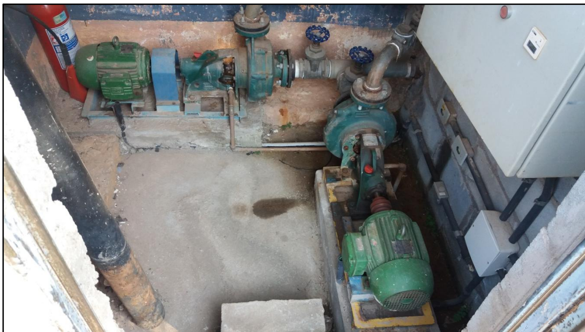
Figura 81: Conjunto moto bomba
