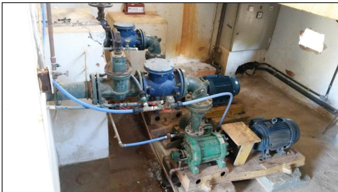
Figura 74: Conjunto moto bombas na ETA
