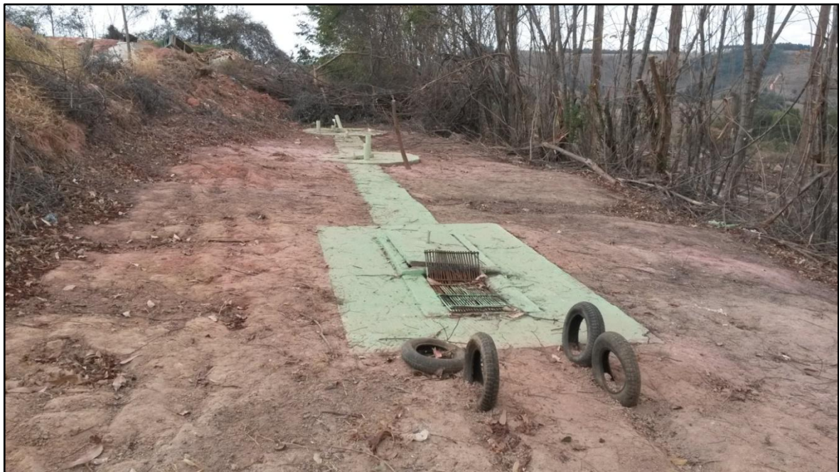
Figura 153: Fossa séptica na UTC
