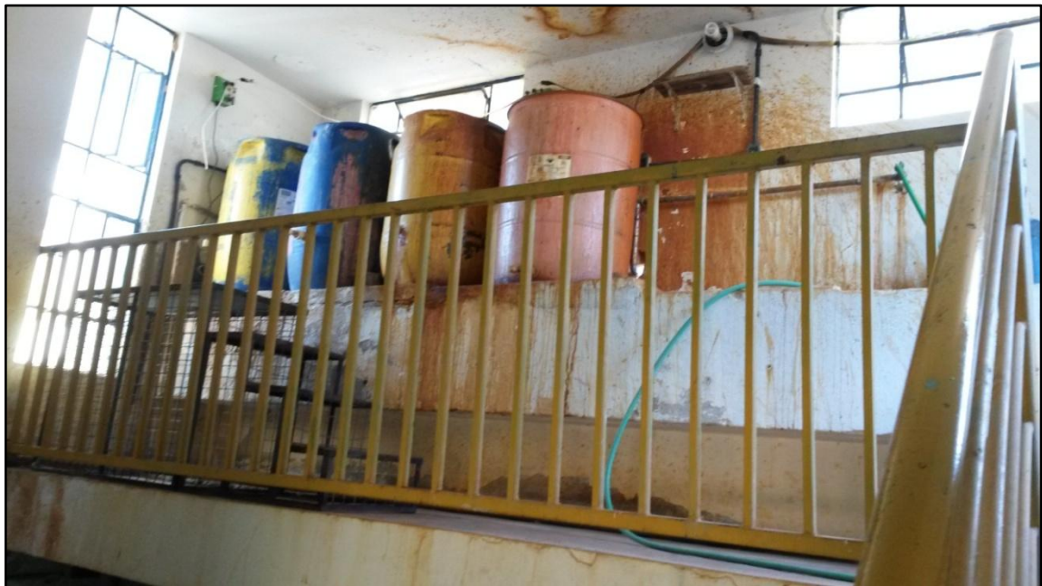
Figura 77: Produtos químicos estocados na ETA
