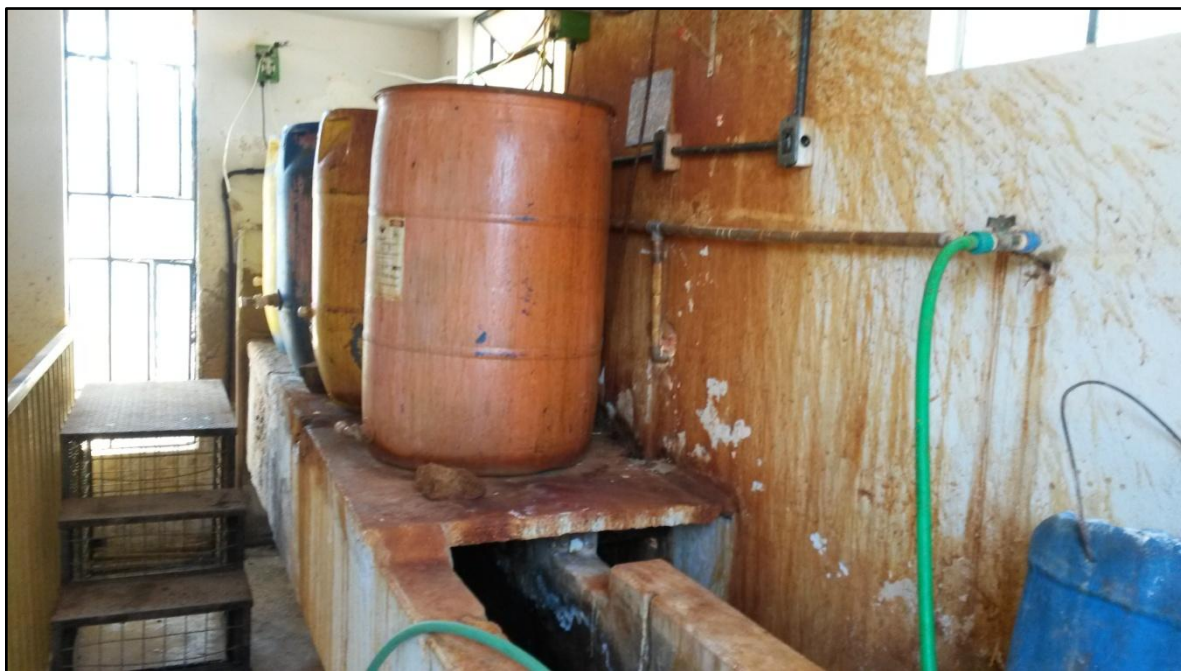
Figura 78: Bombonas com produtos químicos estocados na ETA
