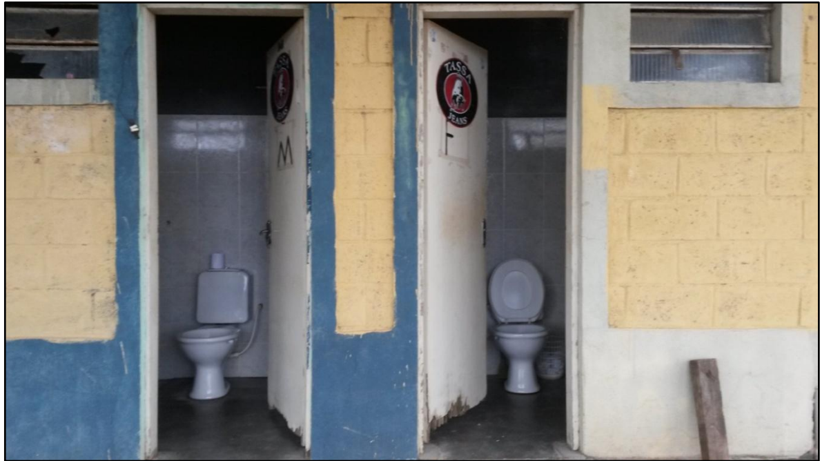
Figura 152: Banheiros da UTC
