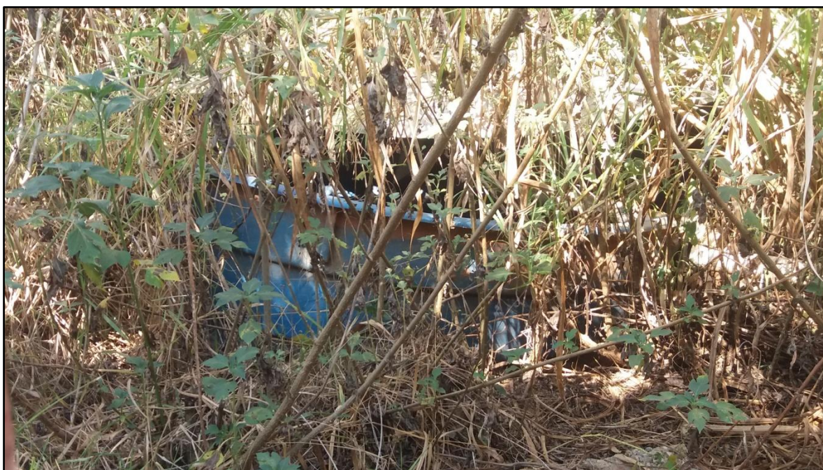
Figura 111: Fossa séptica comunidade do Vale
