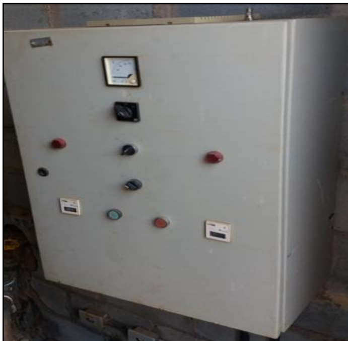
Figura 65: Booster na ETA
