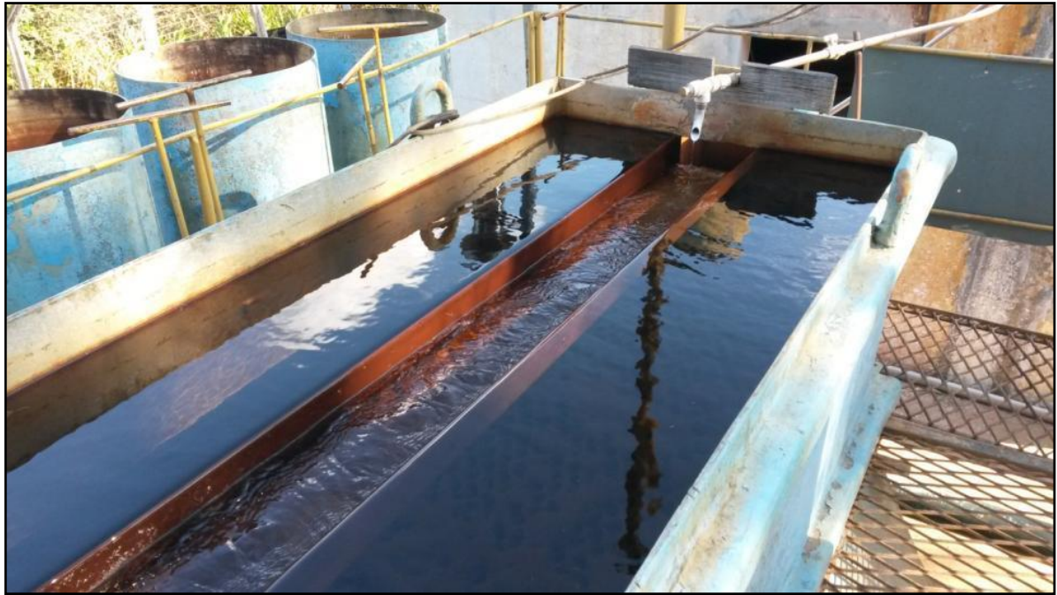
Figura 72: Decantadores na ETA
