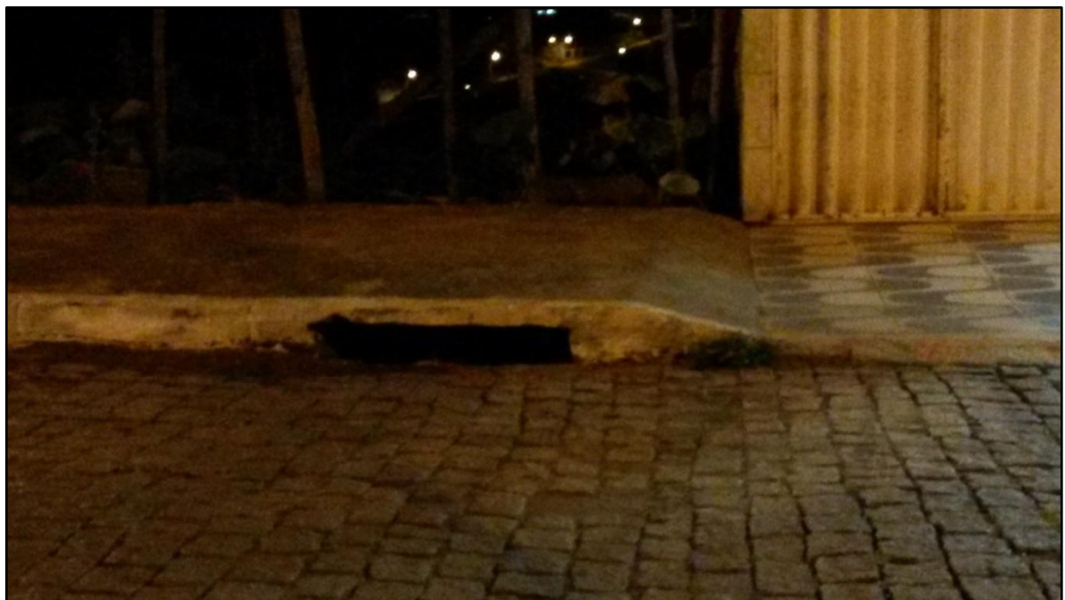
Figura 176: Boca de lobo
