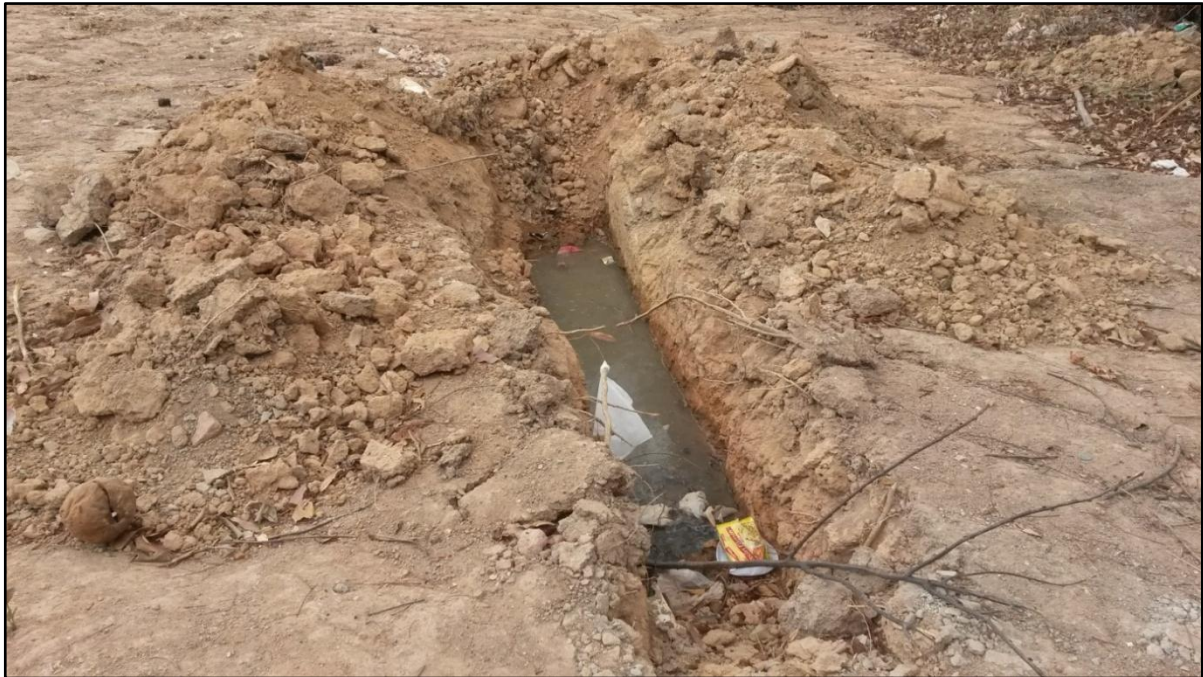
Figura 154: Encanamento obstruído da fossa séptica
