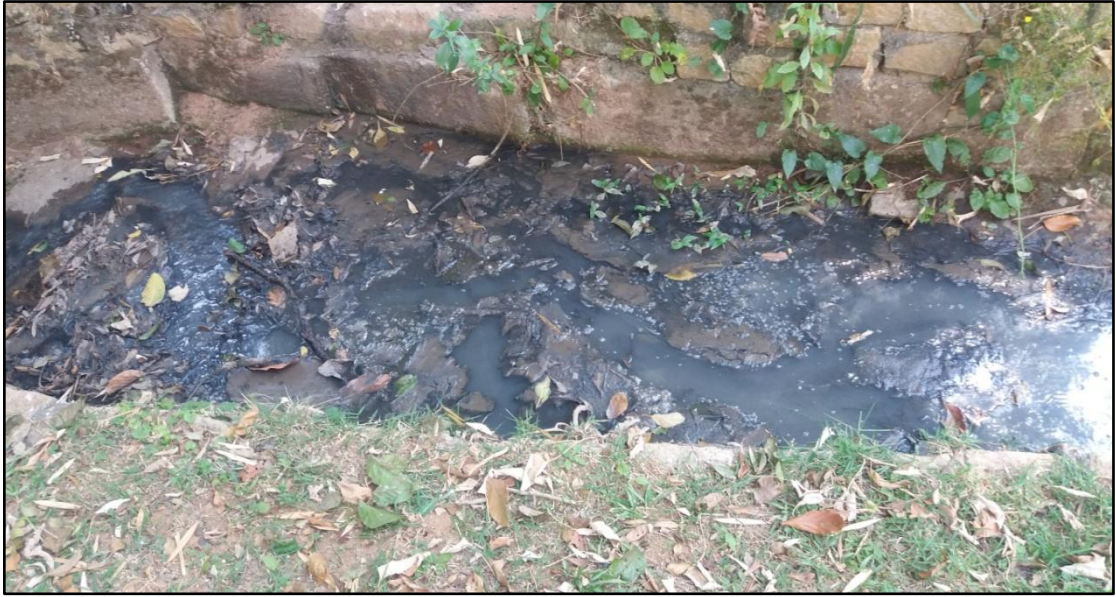
Figura 100: Esgoto a céu aberto no Horto
