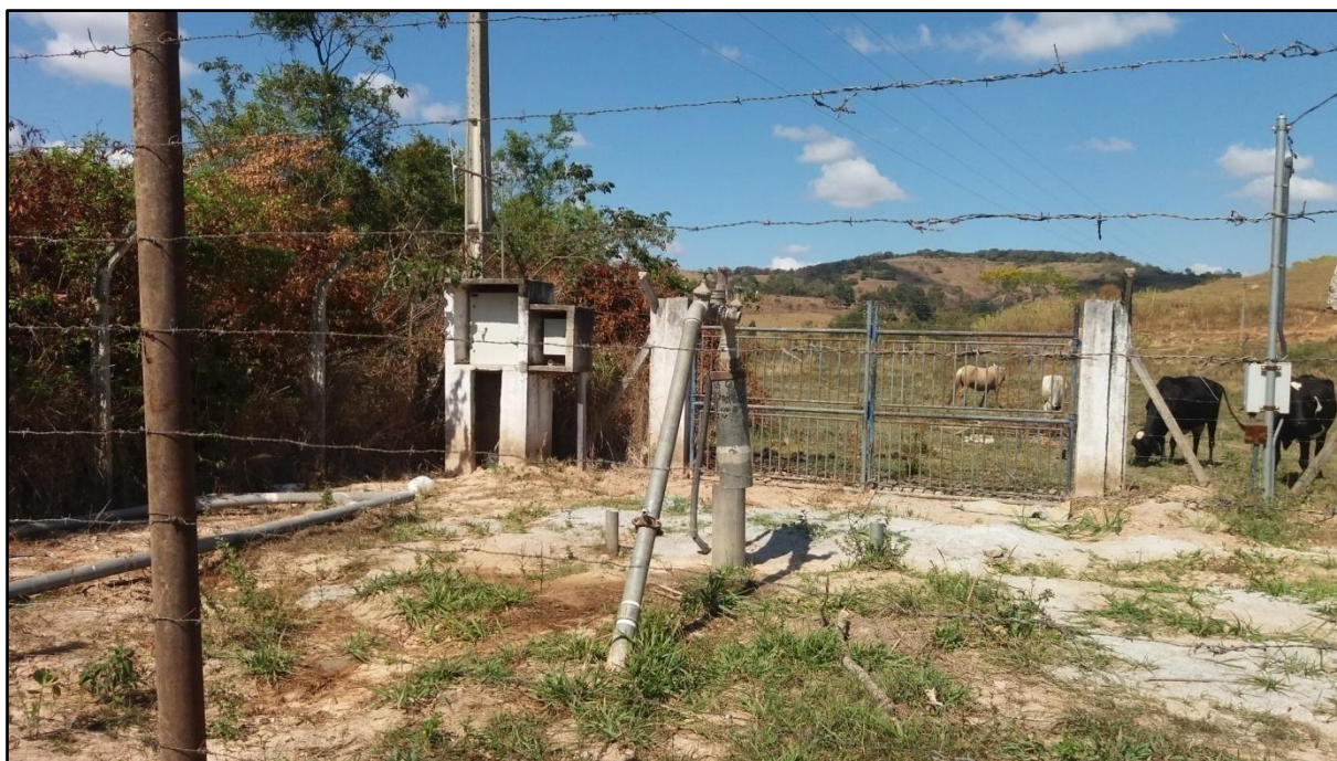
Figura 60: Poço de captação C-03 no rio Macaúbas
