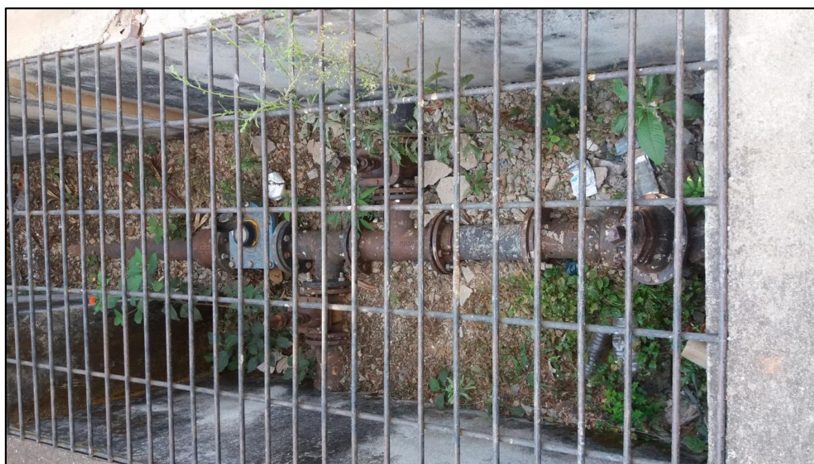
Figura 80: Chegada da água da captação subterrânea
