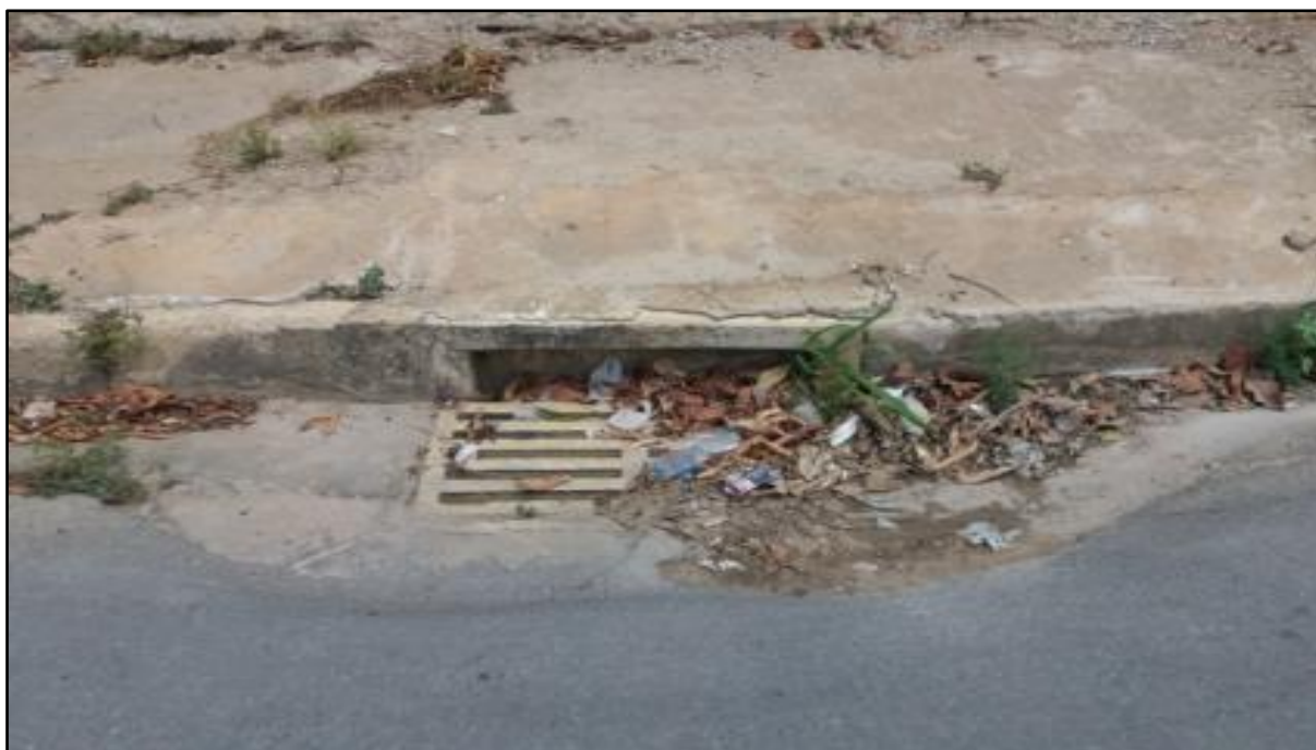
Figura 168: Estado de conservação dos bueiros e bocas-de-lobos
