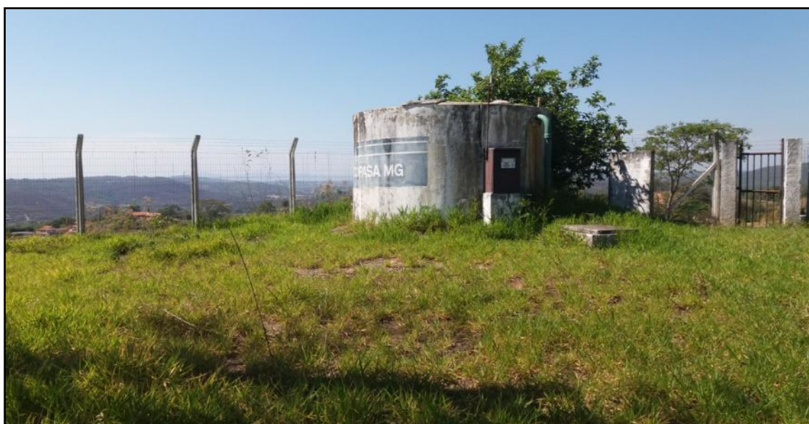
Figura 86: Reservatório para atender o bairro Inácia de Carvalho - II
