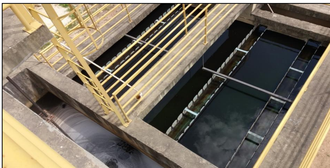
Figura110: Decantador da ETE de Maravilhas e Inácia de Carvalho
