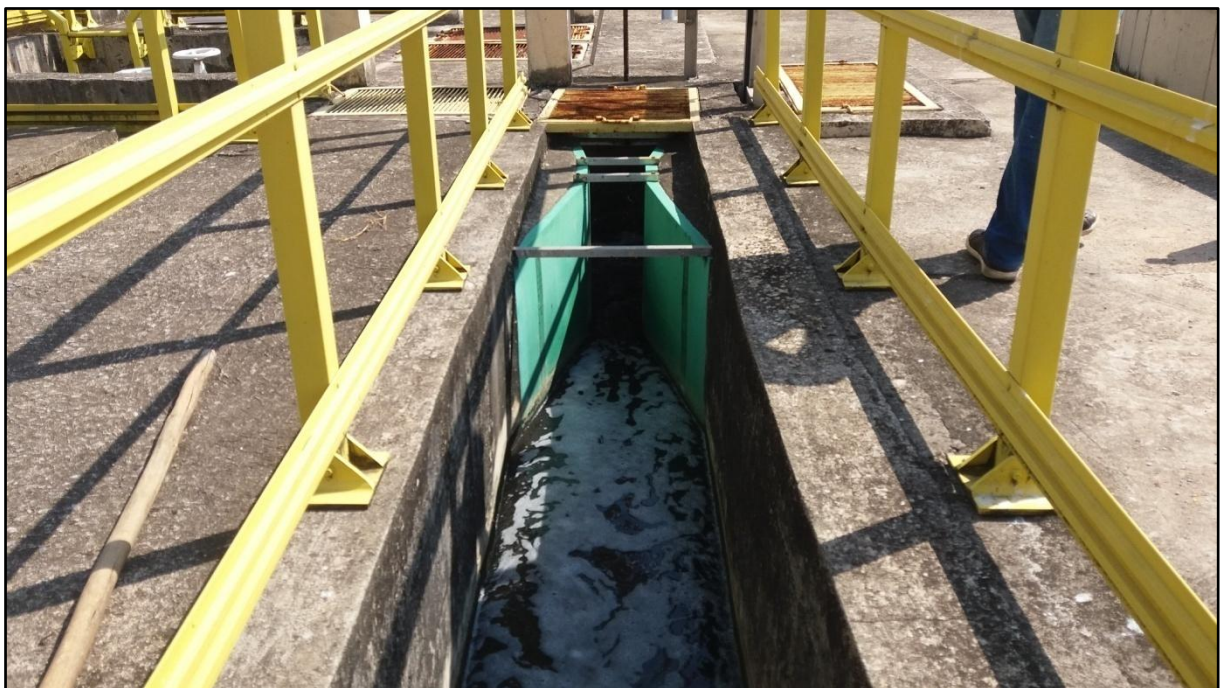
Figura 96: Tratamento preliminar ETE da sede
