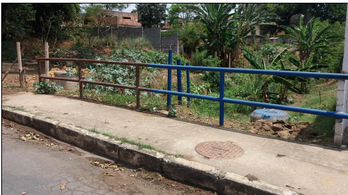
Figura 94: Poços de visitas
