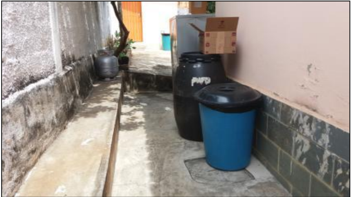
Figura 139: Acondicionamento dos RSS nas UBS
