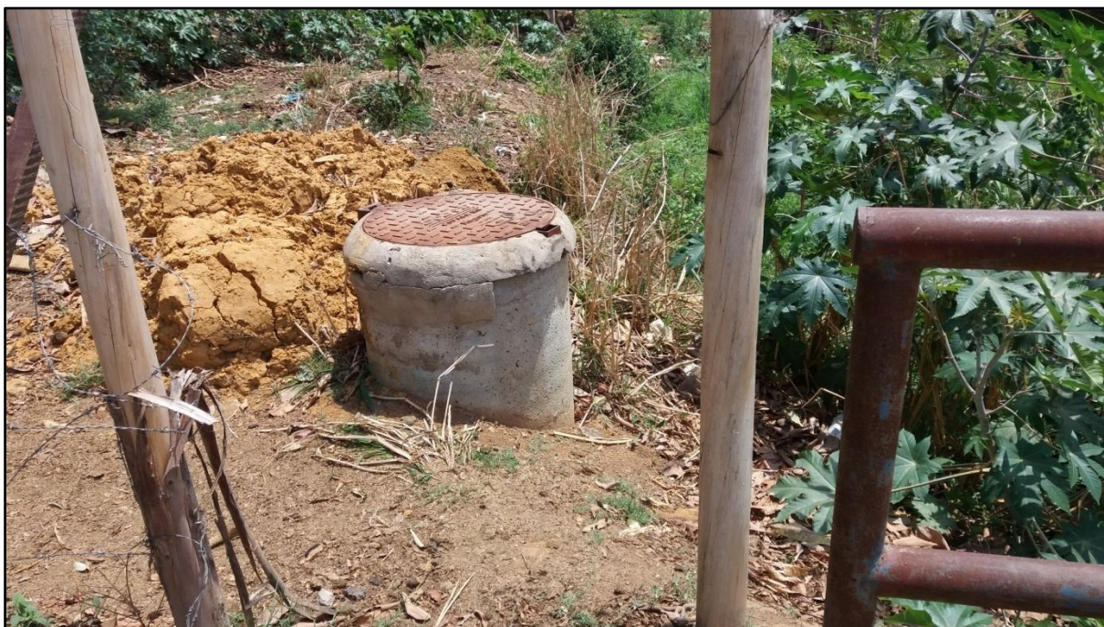
Figura 93: Poços de visitas
