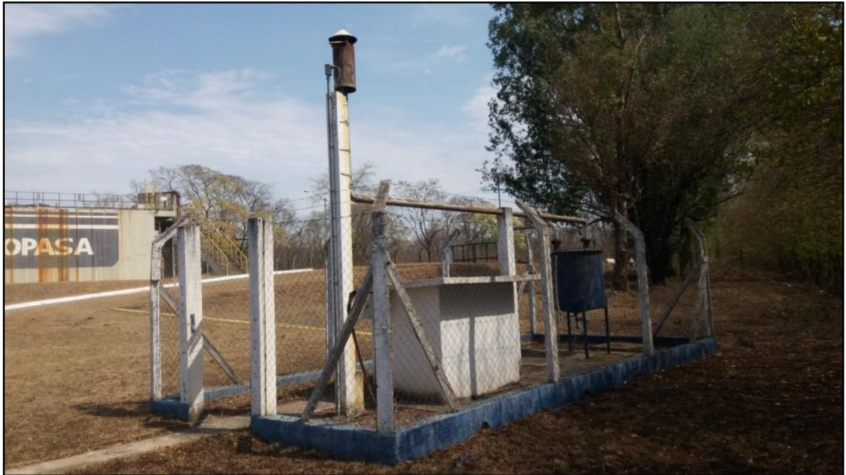
Figura 105: Queimador de gás da ETE da sede
