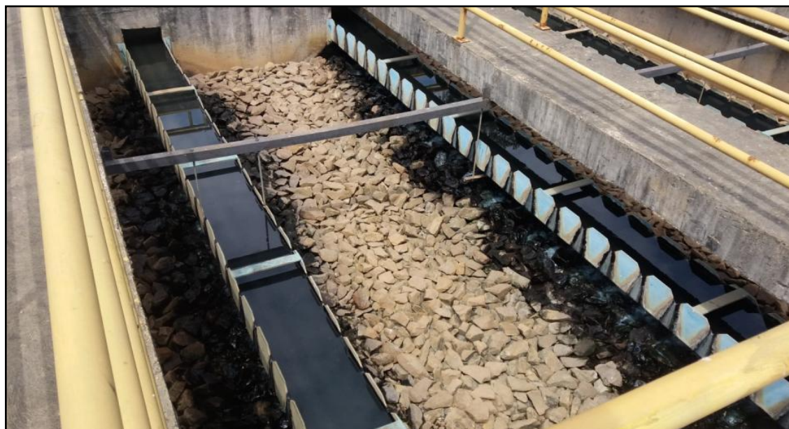
Figura 109: Filtro biológico percolador da ETE de Maravilhas e Inácia de Carvalho
