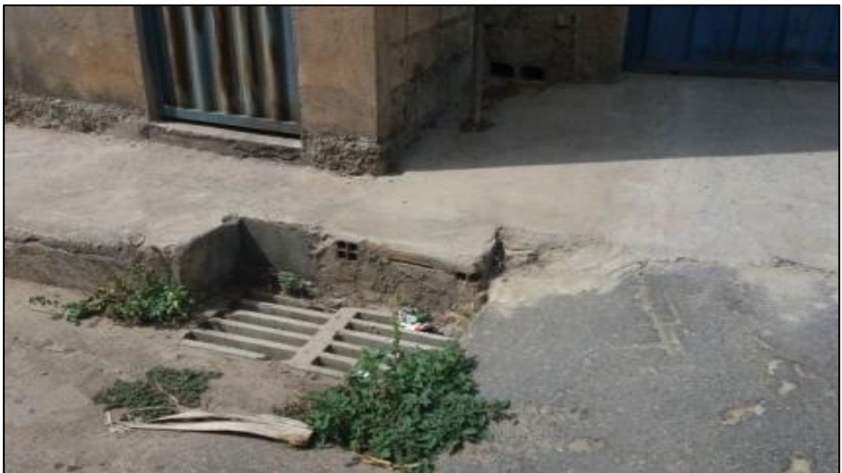
Figura 170: Estado de conservação dos cueiros e bocas-de-lobos
