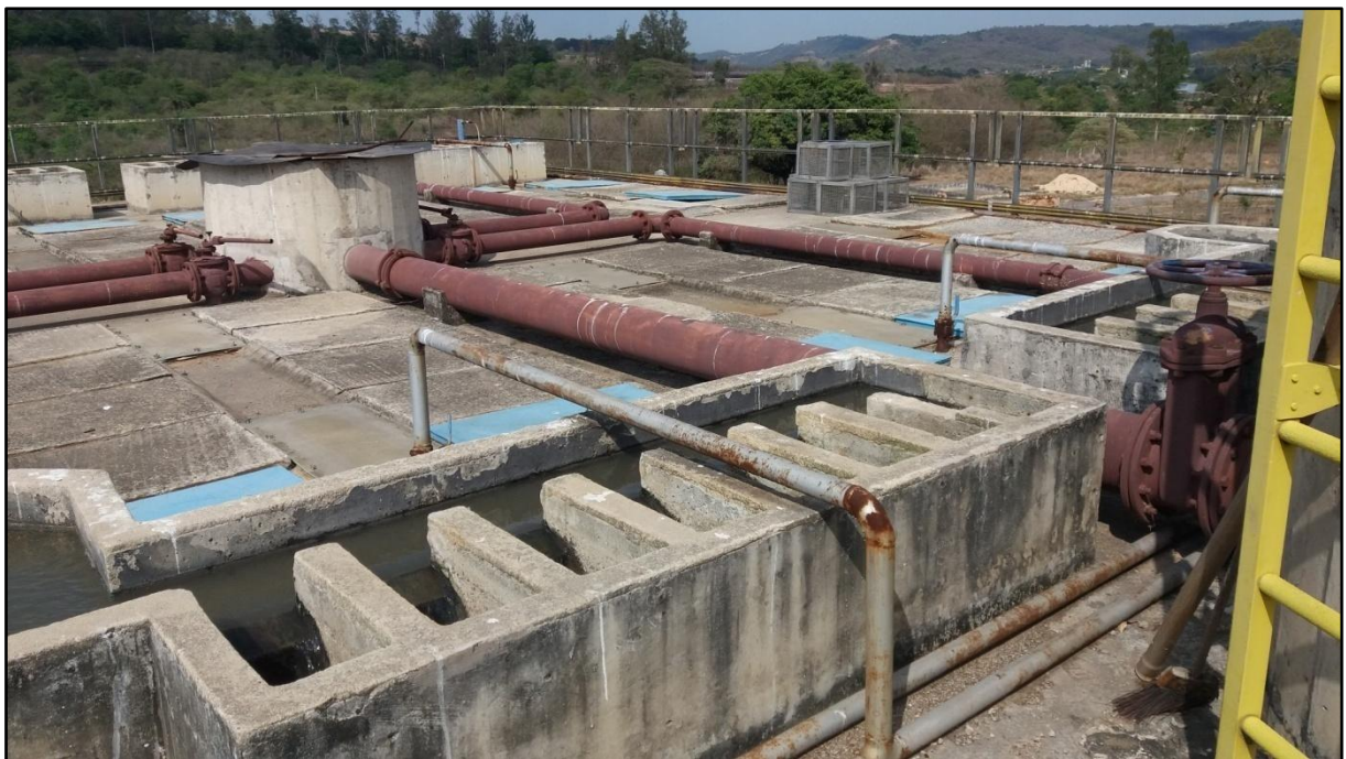
Figura 99: Reator UASB, tratamento primário da ETE da sede
