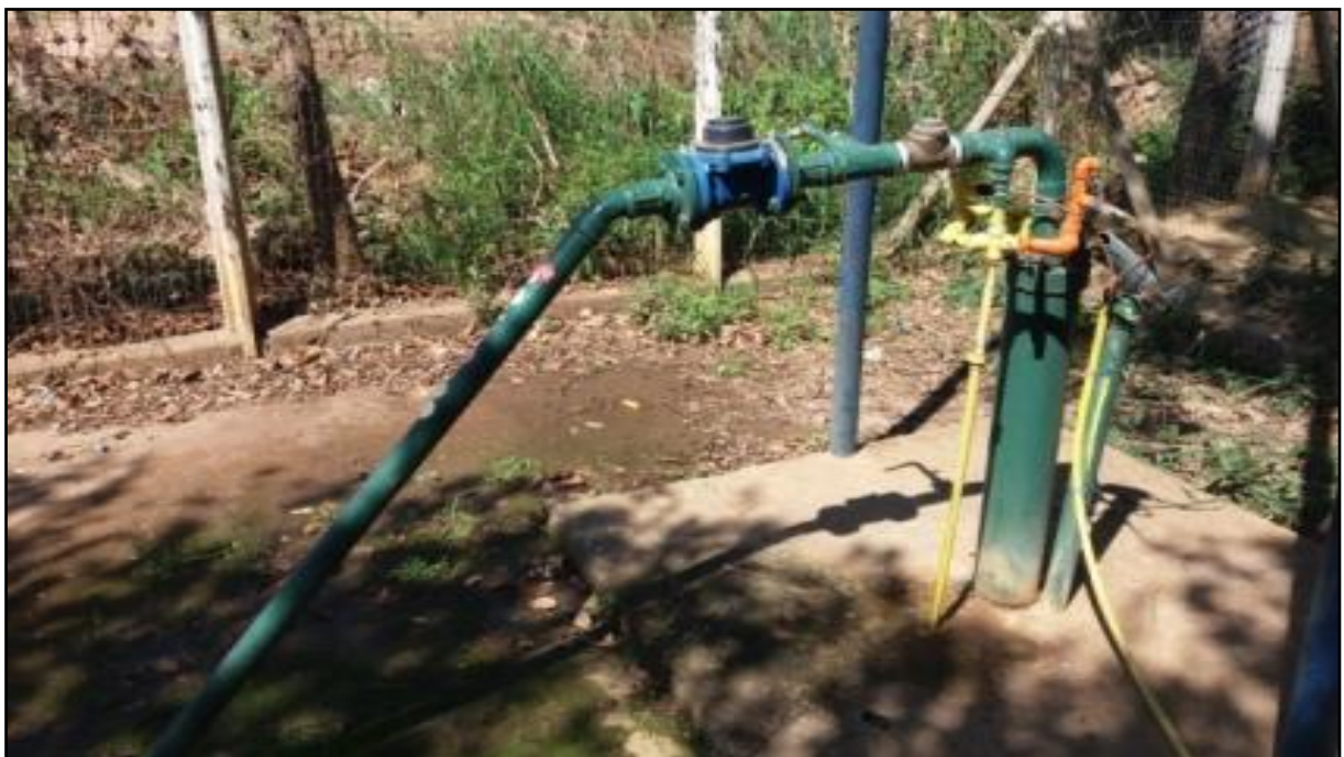
Figura 73: Poço C-01 bairro Inácia de Carvalho
