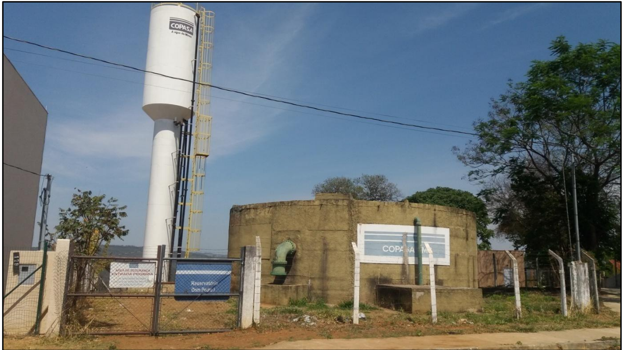
Figura 82: Reservatórios para atender a sede e bairro Dom Pedro I
