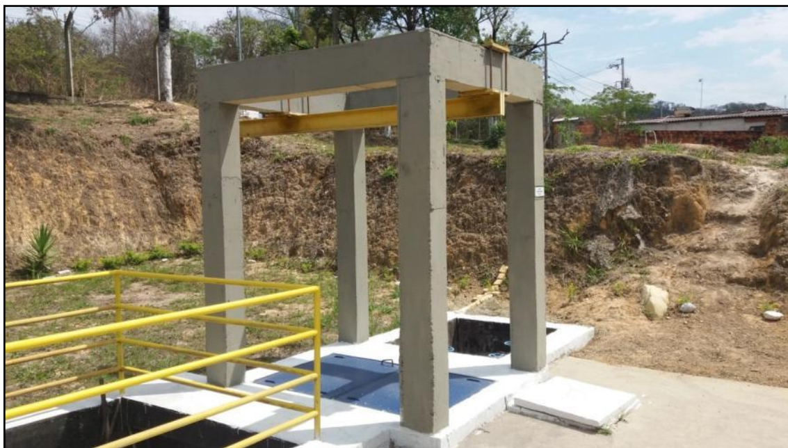
Figura 107: Estação elevatória na ETE de Maravilhas e Inácia de Carvalho
