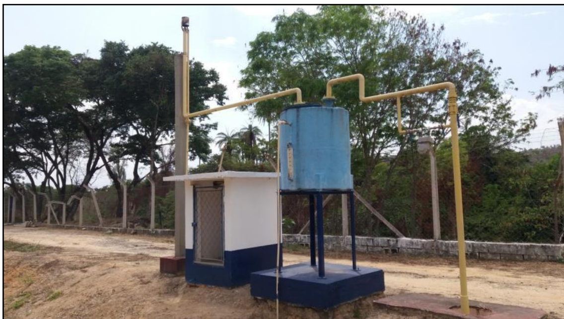
Figura 112: Queimador de gás da ETE de Maravilhas e Inácia de Carvalho
