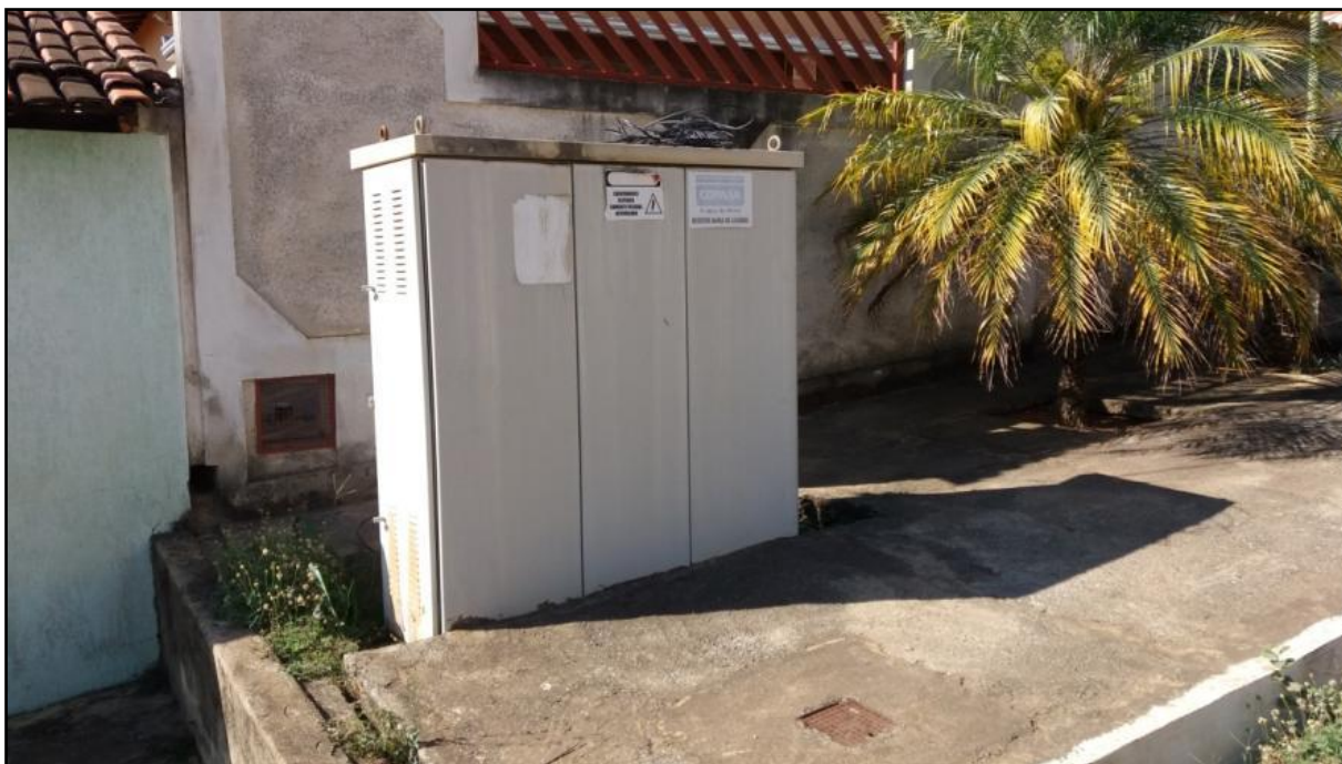
Figura 67: Booster no centro urbano
