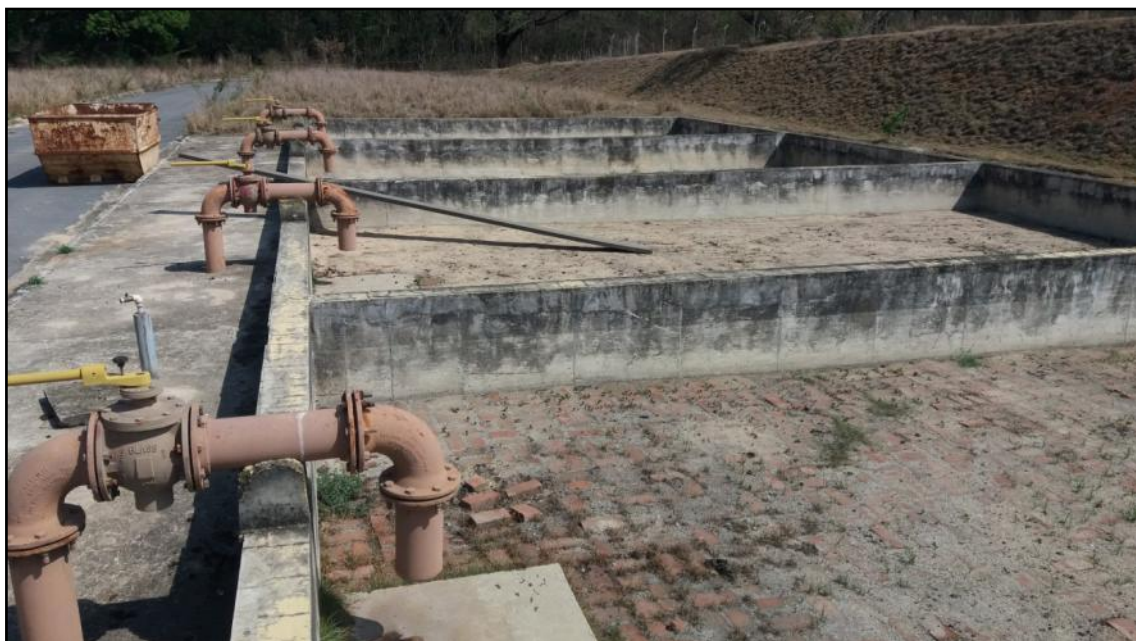
Figura 104: Leitos de secagem da ETE da sede
