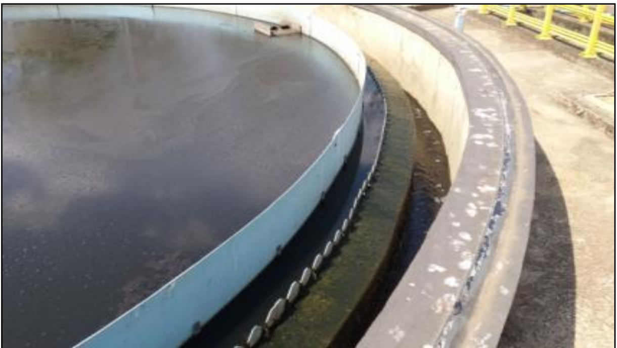
Figura 103: Decantador, tratamento terciário da ETE da sede
