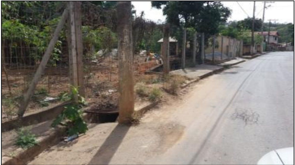
Figura 169: Estado de conservação dos bueiros e bocas-de-lobos
