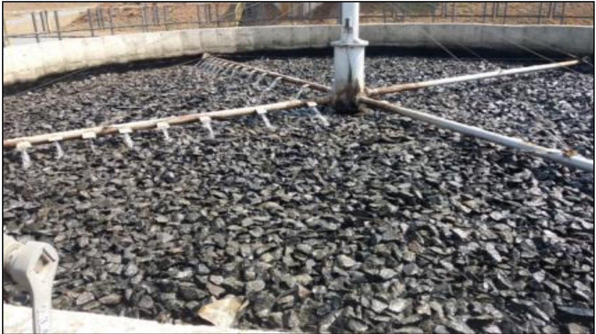
Figura 101: Filtro biológico percolador, tratamento secundário da ETE da sede
