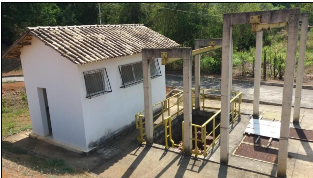
Figura 97: Estação elevatória na ETE da sede
