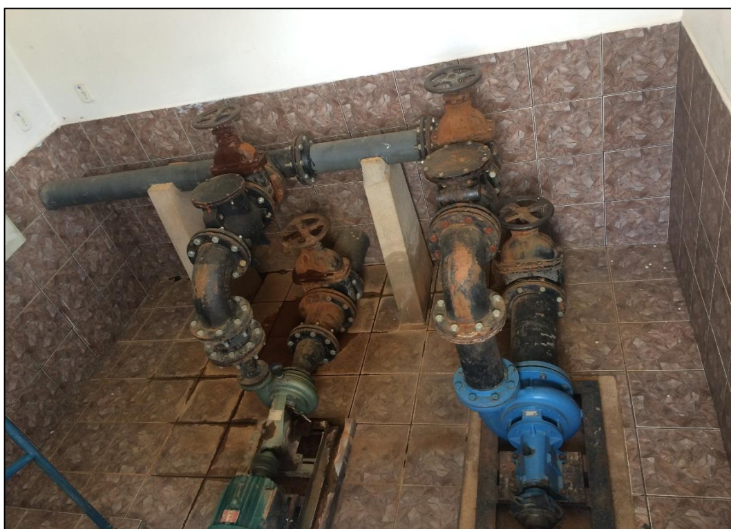
Figura 36 – Bombas da EEAT.
