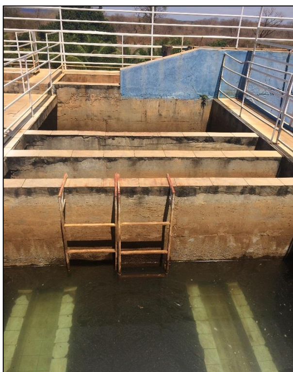
Figura 42 – Filtros ETA – distrito Sede. Fonte: DRZ - Geotecnologia e Consultoria, 2017.
