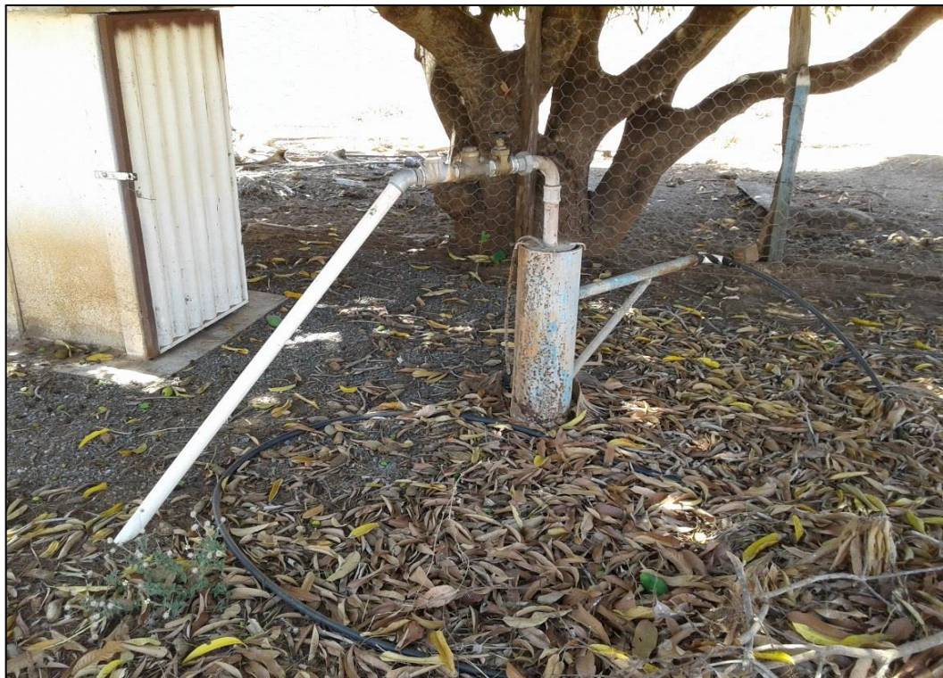
Figura 104 – Captação por poço na comunidade Vera Cruz. Fonte: DRZ – Geotecnologia e Consultoria, 2017.
