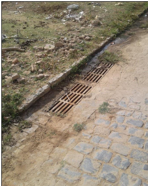
Figura 138 – Esgoto escoando pela boca de lobo. Fonte: DRZ - Geotecnologia e Consultoria, 2017.
