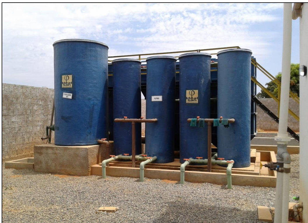
Figura 68 – Filtros da ETA – Entroncamento. Fonte: DRZ - Geotecnologia e Consultoria, 2017.
