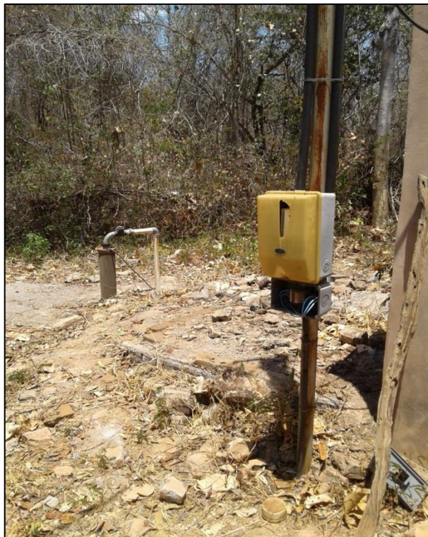
Figura 81 – Captação do Assentamento Águas Claras. Fonte: DRZ – Geotecnologia e Consultoria, 2017.
