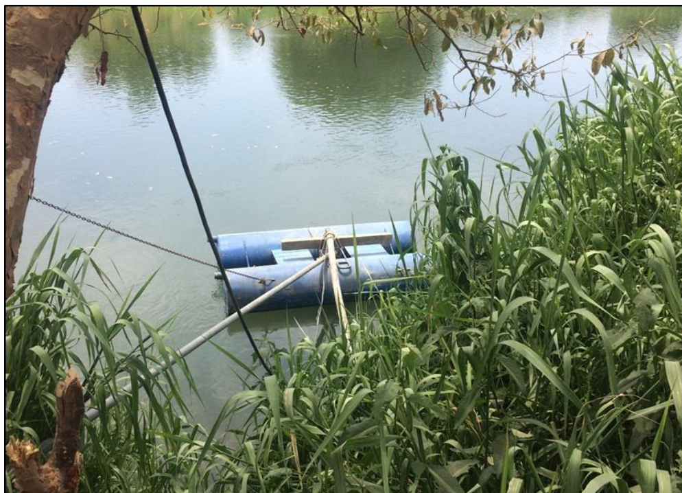
Figura 61 – Captação Superficial – Povoado Entroncamento. Fonte: DRZ - Geotecnologia e Consultoria, 2017.
