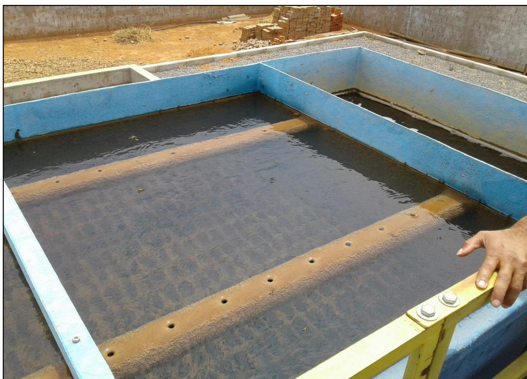
Figura 67 – Decantadores ETA – Entroncamento. Fonte: DRZ - Geotecnologia e Consultoria, 2017.
