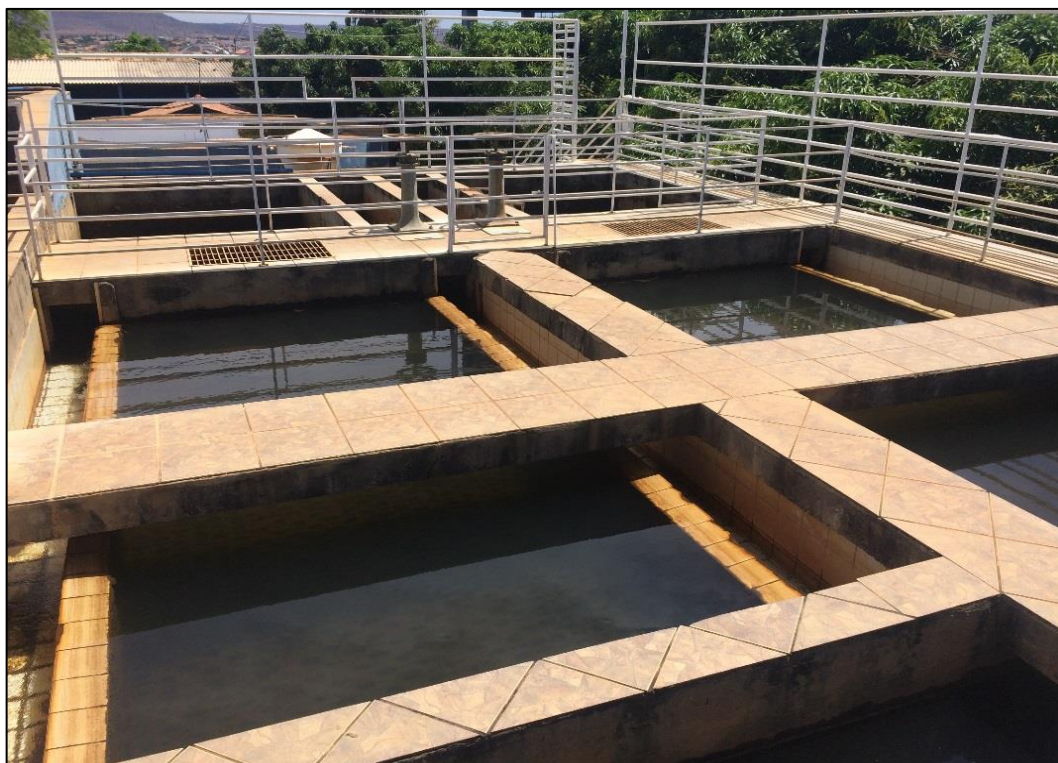
Figura 41 – Decantadores ETA – distrito Sede Fonte: DRZ - Geotecnologia e Consultoria, 2017.
