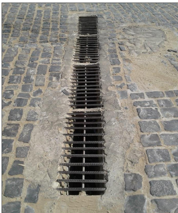
Figura 136 - Dispositivo de drenagem do distrito Sede. Fonte: DRZ – Geotecnologia e Consultoria, 2017.
