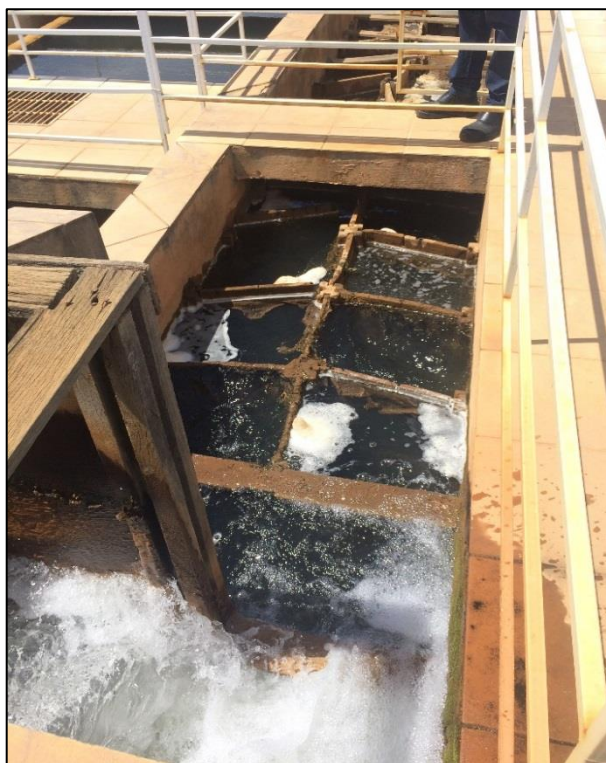
Figura 40 – Flocculadores da ETA – distrito Sede. Fonte: DRZ - Geotecnologia e Consultoria, 2017.
