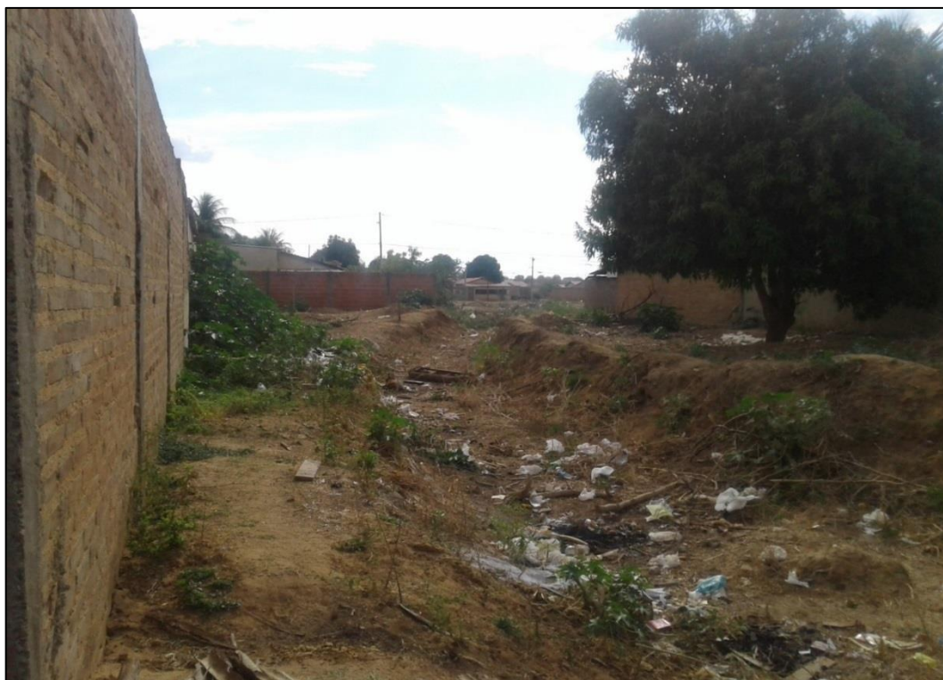
Figura 139 - Ponto com erosão causado pelo escoamento das águas pluviais. Fonte: DRZ – Geotecnologia e Consultoria, 2017.
