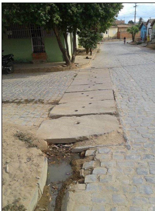
Figura 108 – Lançamento de esgoto na boca de lobo. Fonte: DRZ - Geotecnologia e Consultoria, 2017.
