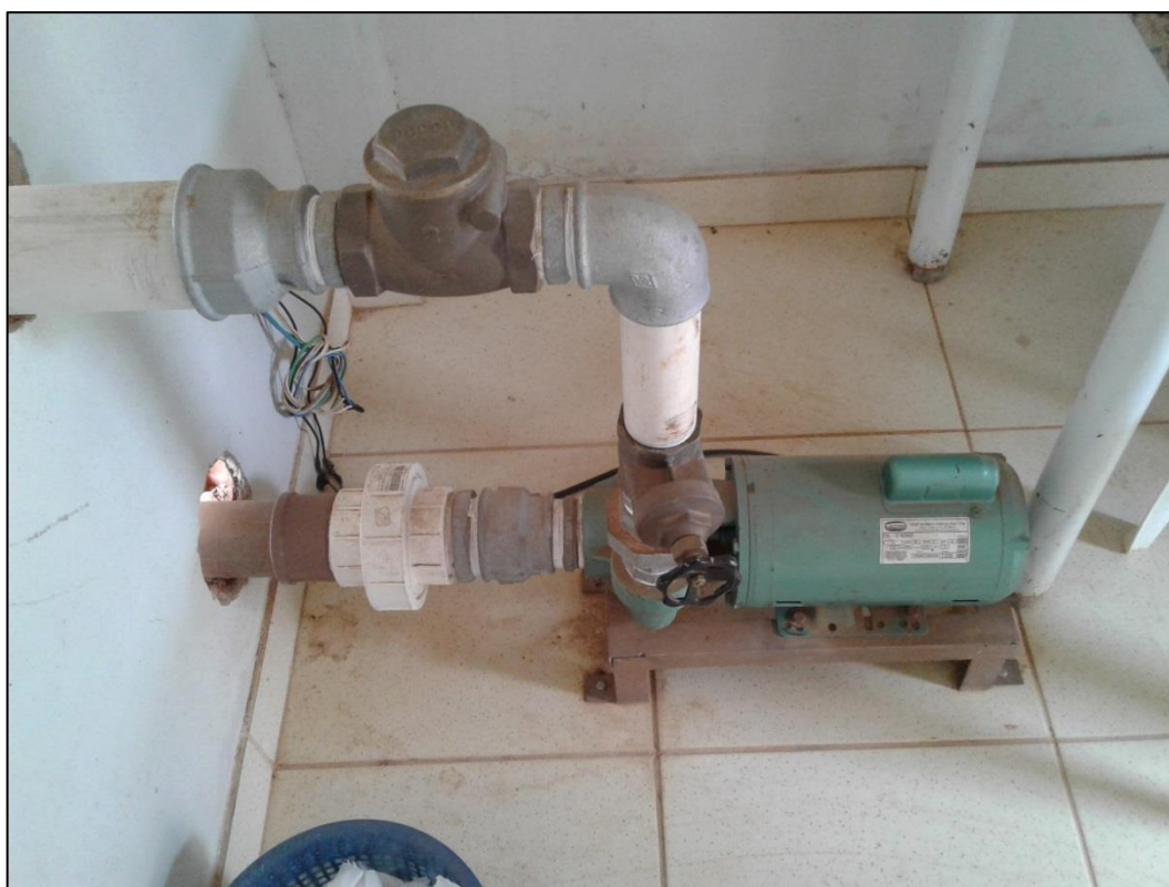
Figura 64 – EEAT – ETA Entroncamento. Fonte: DRZ - Geotecnologia e Consultoria, 2017.
