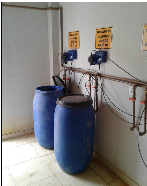
Figura 70 – Dosagem dos produtos químicos por bombas – Entroncamento. Fonte: DRZ - Geotecnologia e Consultoria, 2017.
