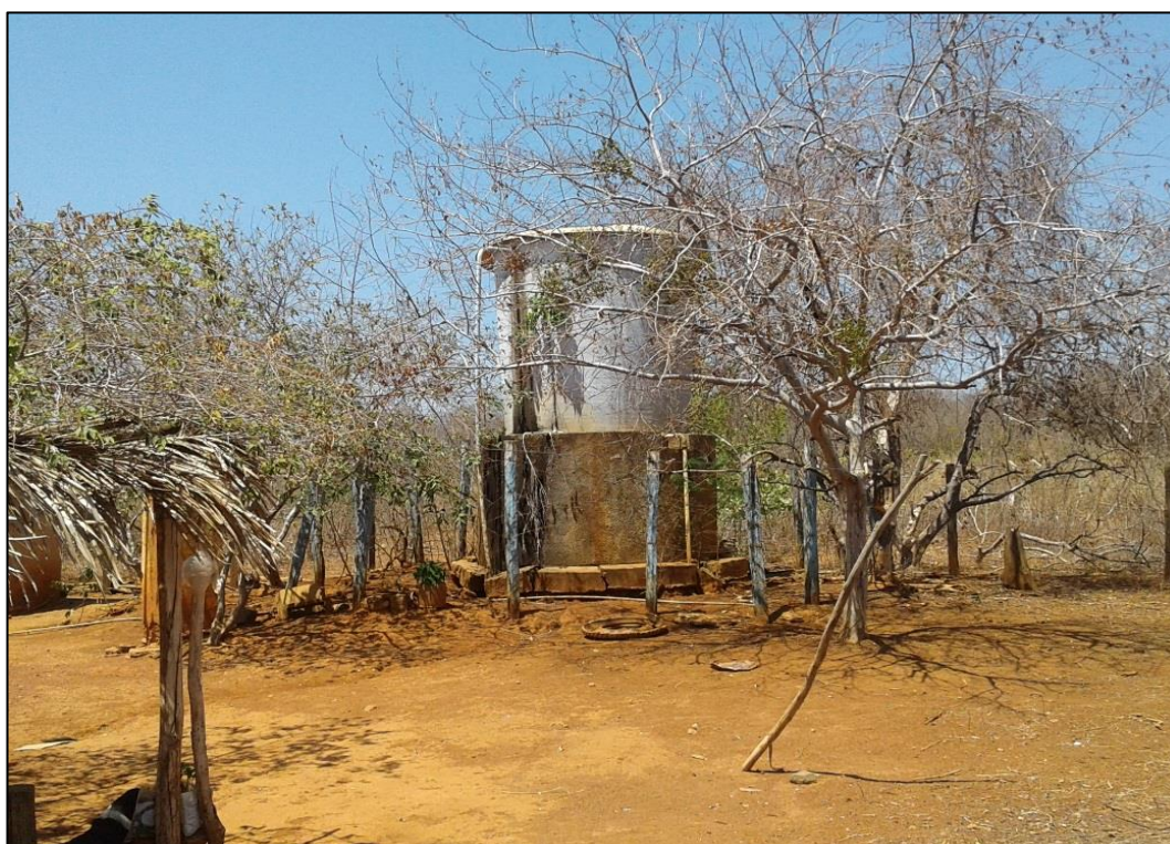
Figura 79 – REL 2 de fibra de vidro e 10 m 3 da comunidade Alagoinha. Fonte: DRZ – Geotecnologia e Consultoria, 2017.
