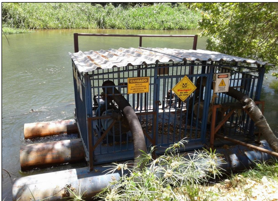
Figura 32 - Captação superficial no rio Corrente – distrito Sede. Fonte: DRZ - Geotecnia e Consultoria, 2017.
