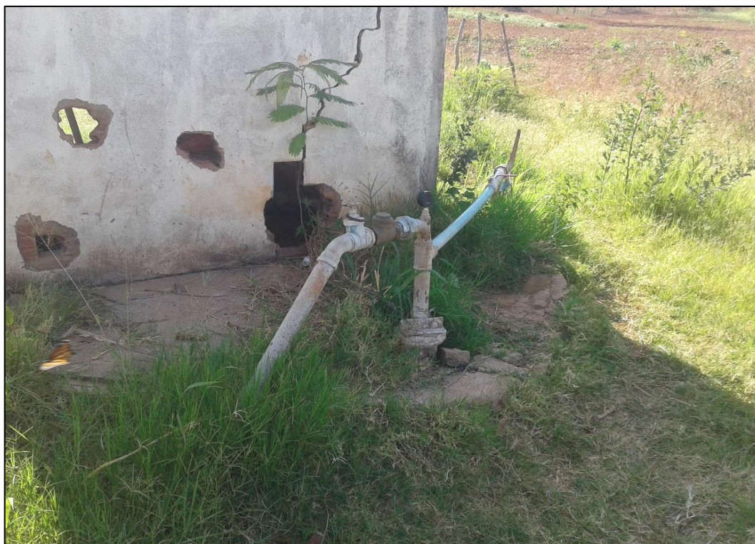
Figura 101 – Captação por poço da comunidade Tabuleiro. Fonte: DRZ – Geotecnologia e Consultoria, 2017.
