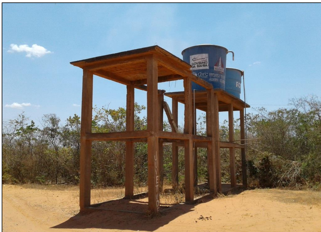
Figura 82 – 2 REL de fibra de vidro de 10 m 3 cada, do Assentamento Águas Claras.
