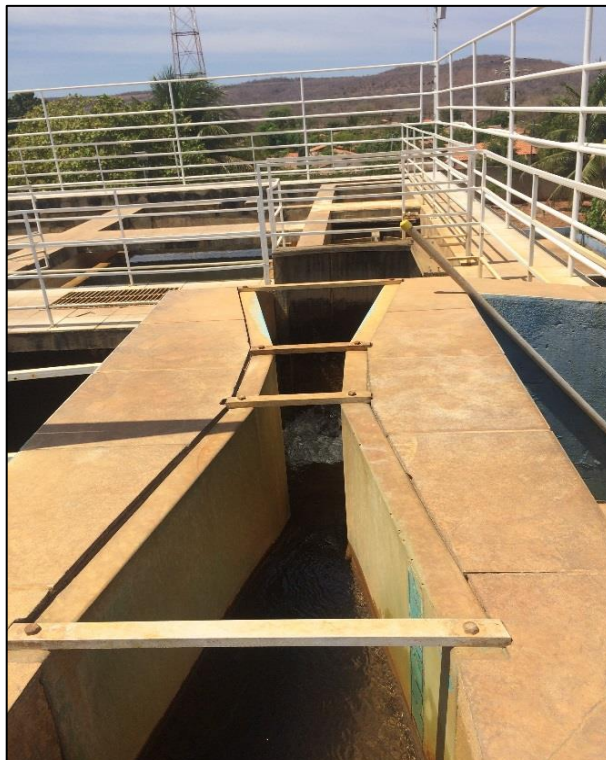
Figura 39 – Calha Parshall da ETA – distrito Sede. Fonte: DRZ - Geotecnologia e Consultoria, 2017.
