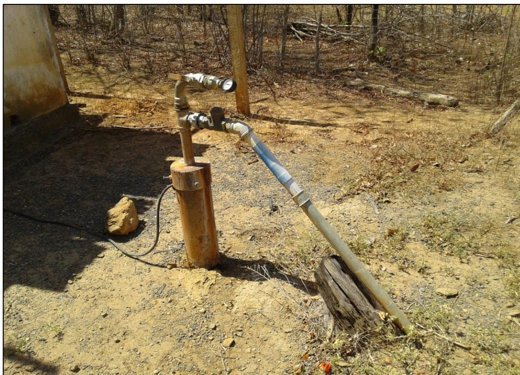
Figura 87 – Captação por poço na comunidade Brejo do Mozondó. Fonte: DRZ – Geotecnologia e Consultoria, 2017.
