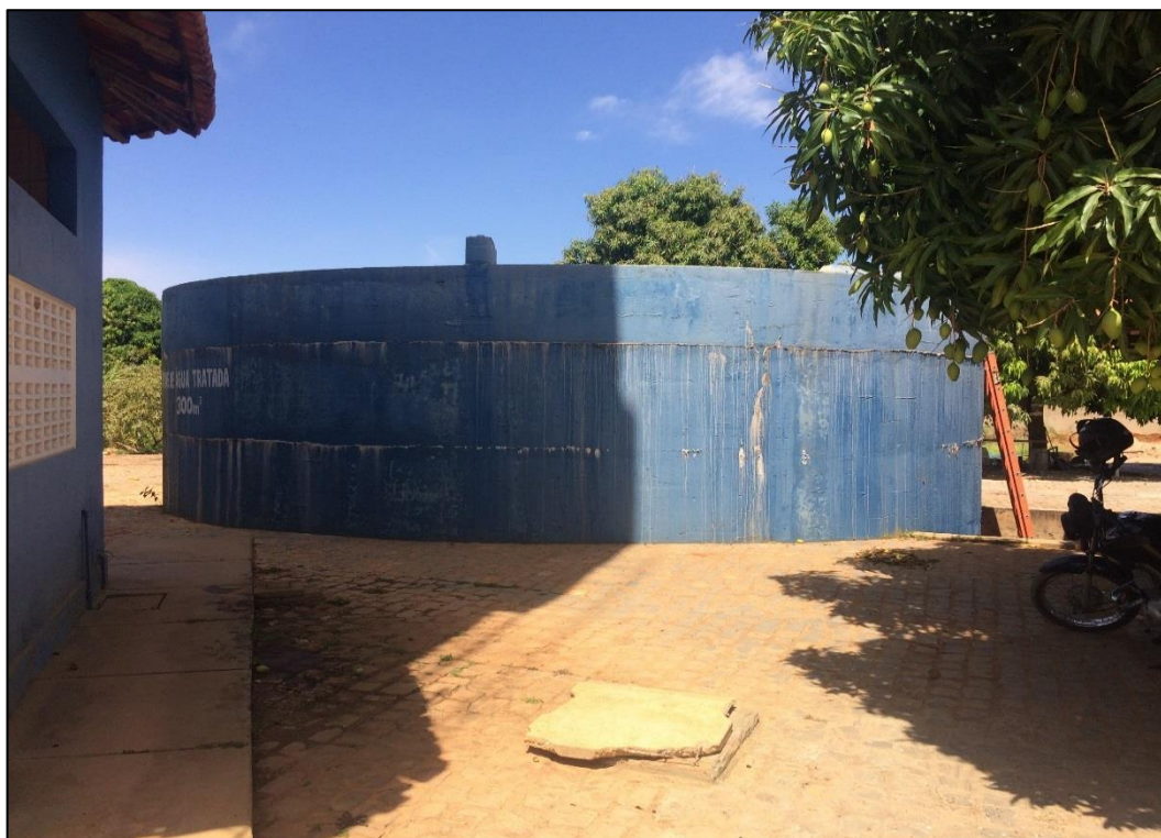
Figura 55 – Reservatório apoiado - RAP – distrito Sede.
