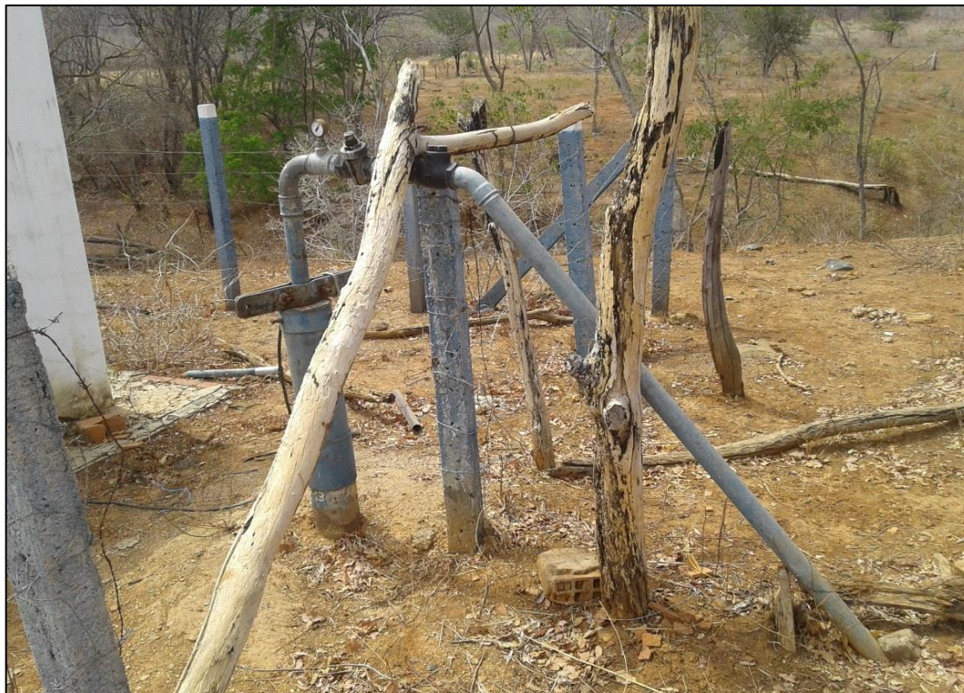
Figura 89 – Captação por poço na comunidade Caracol. Fonte: DRZ – Geotecnia e Consultoria, 2017.
