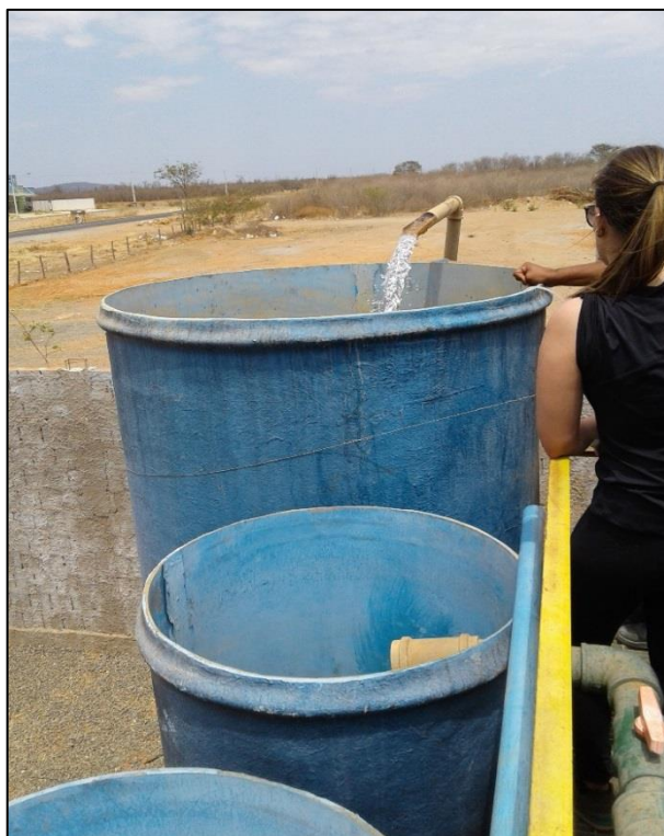
Figura 66 – Flocculadores da ETA – Entroncamento. Fonte: DRZ - Geotecnologia e Consultoria, 2017.
