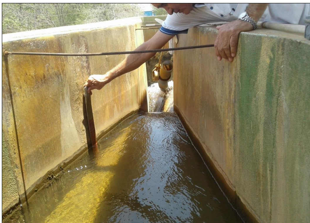
Figura 55 – Calha parshall e adição de sulfato de alumínio: Distrito Sede. Fonte: DRZ – Geotecnologia e Consultoria, 2017.
