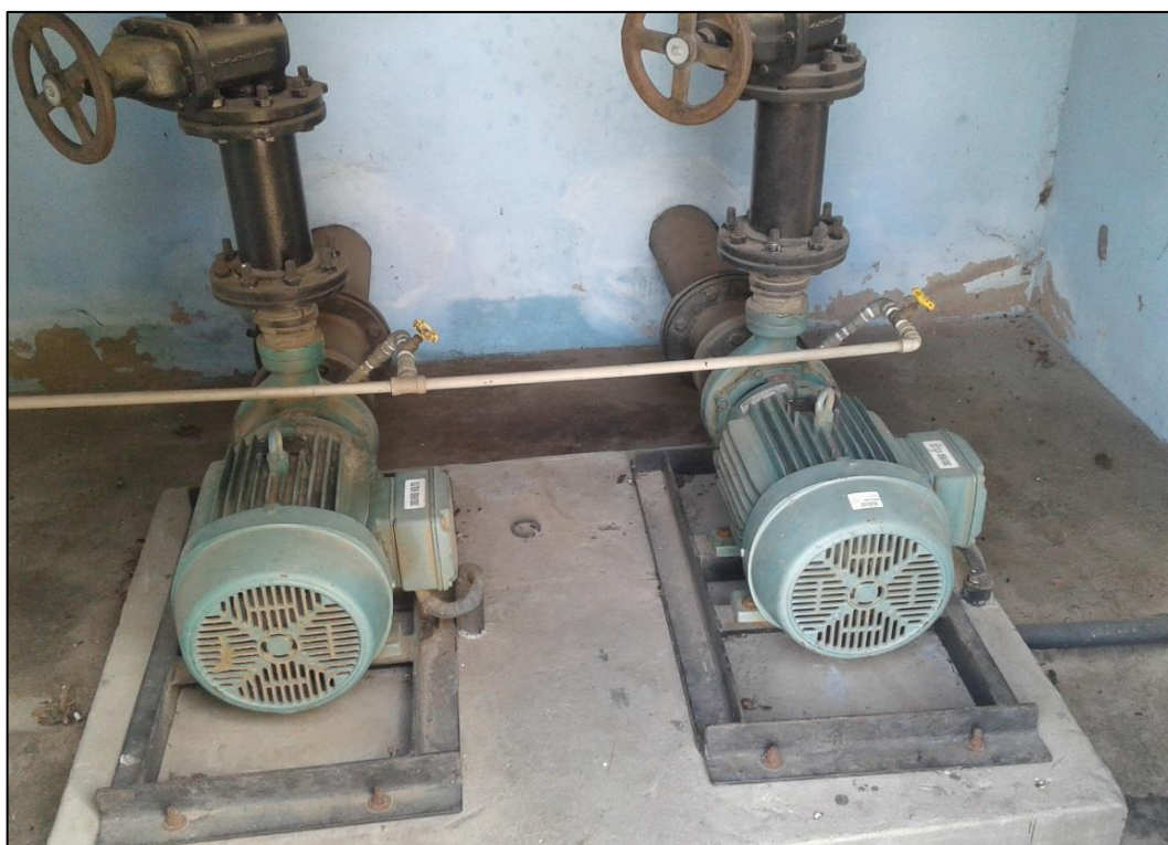
Figura 77 – Bombas de captação superficial do distrito de Inhaúmas. Fonte: DRZ – Geotecnologia e Consultoria, 2017.
