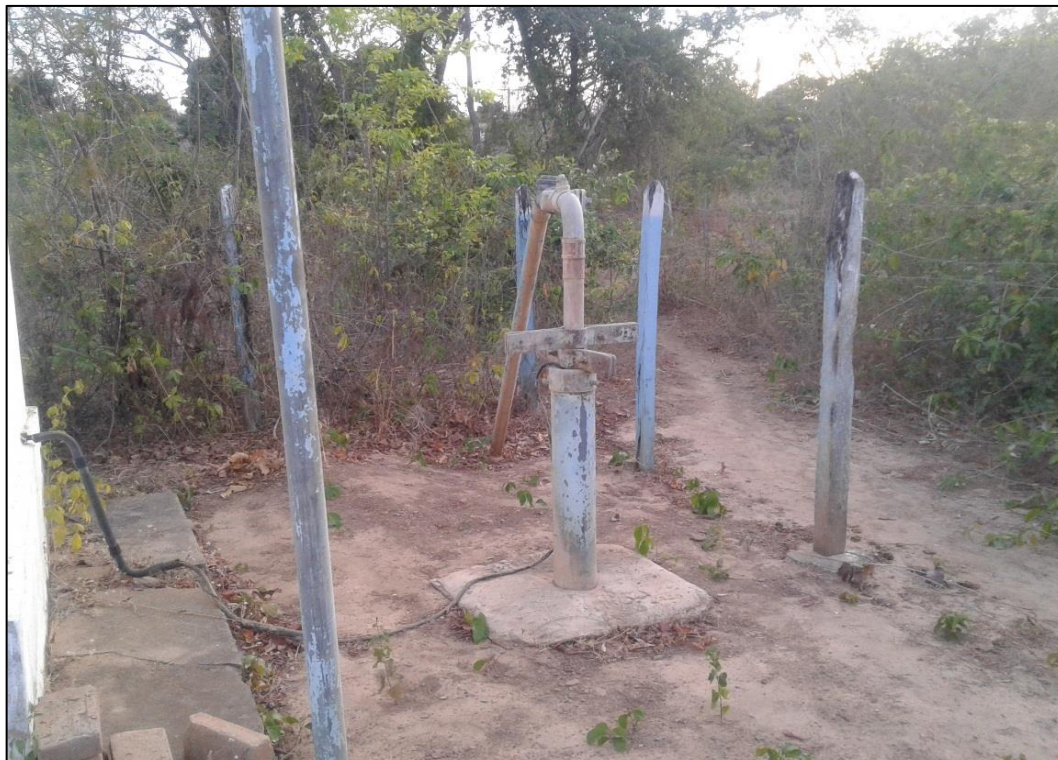
Figura 73 – Captação de poço do distrito de Açudina.
