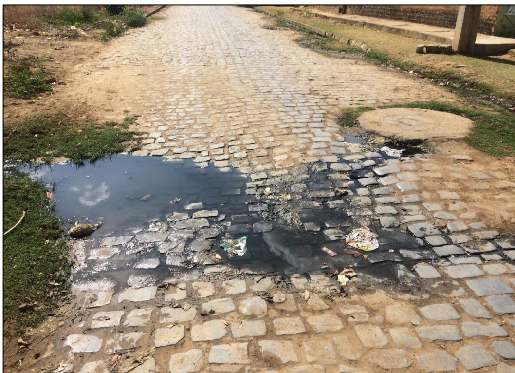
Figura 131 – Lançamento de esgoto em vias públicas. Fonte: DRZ Geotecnologia e Consultoria, 2017.
