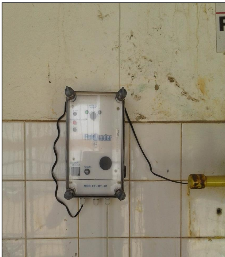
Figura 63 – Detector de vazamento de cloro gás. Fonte: DRZ – Geotecnologia e Consultoria, 2017.
