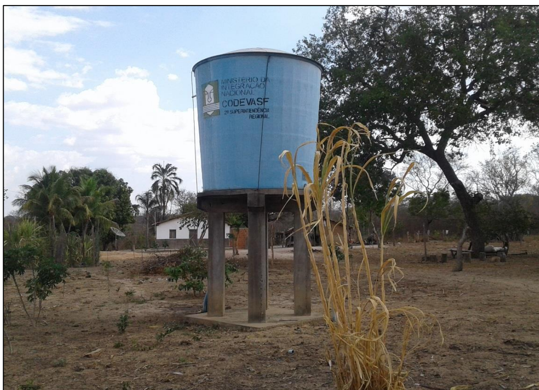
Figura 83 – REL 2 de fibra de vidro do distrito de Inhaúmas. Fonte: DRZ – Geotecnologia e Consultoria, 2017.
