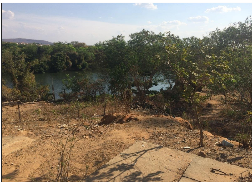
Figura 184 - Erosão do Bairro Sambaiba. Fonte: DRZ – Geotecnologia e Consultoria, 2017.
