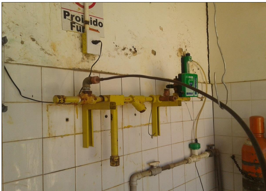
Figura 61 – Dosador de cloro gás. Fonte: DRZ – Geotecnologia e Consultoria, 2017.
