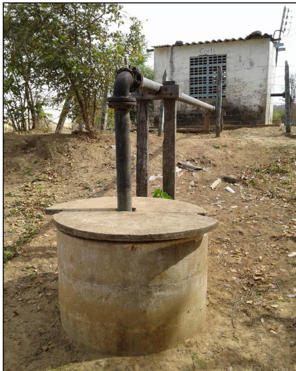
Figura 113 – Captação por bomba superficial do povoado de Nova Franca. Fonte: DRZ – Geotecnologia e Consultoria, 2017.
