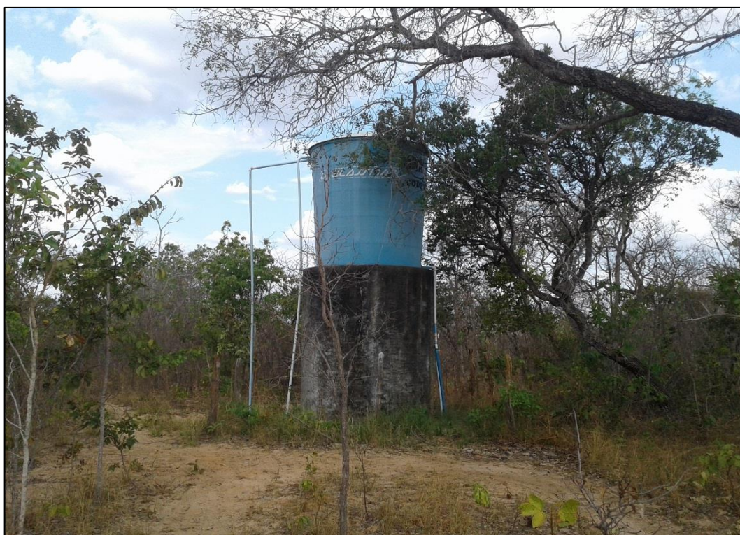
Figura 85 – REL 4 de fibra de vidro do distrito de Inhaúmas. Fonte: DRZ – Geotecnologia e Consultoria, 2017.
