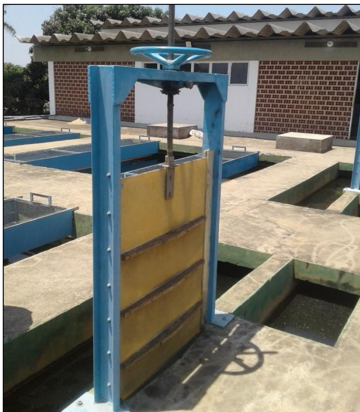
Figura 58 – Comportas para setorização do sistema. Fonte: DRZ – Geotecnologia e Consultoria, 2017.
