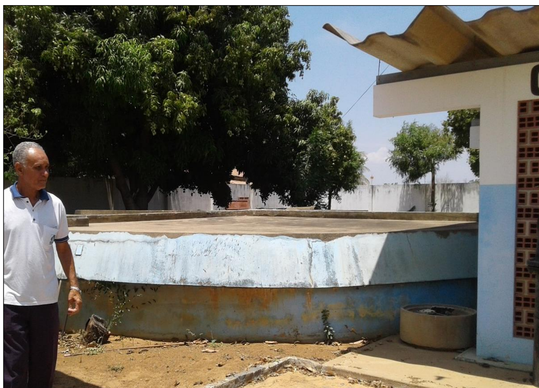
Figura 69 – Reservatório Enterrado. Fonte: DRZ – Geotecnologia e Consultoria, 2017.
