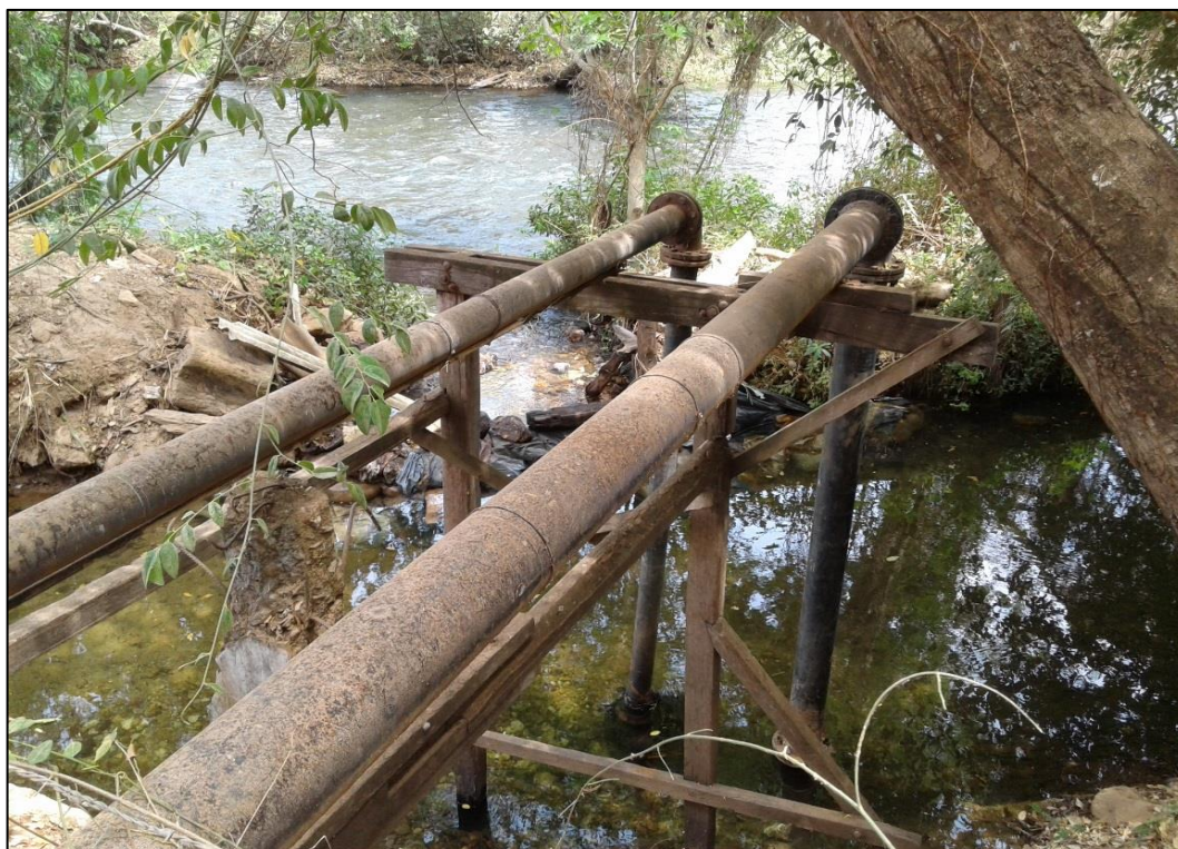
Figura 110 – Captação por bomba superficial do povoado Mucambo. Fonte: DRZ – Geotecnologia e Consultoria, 2017.
