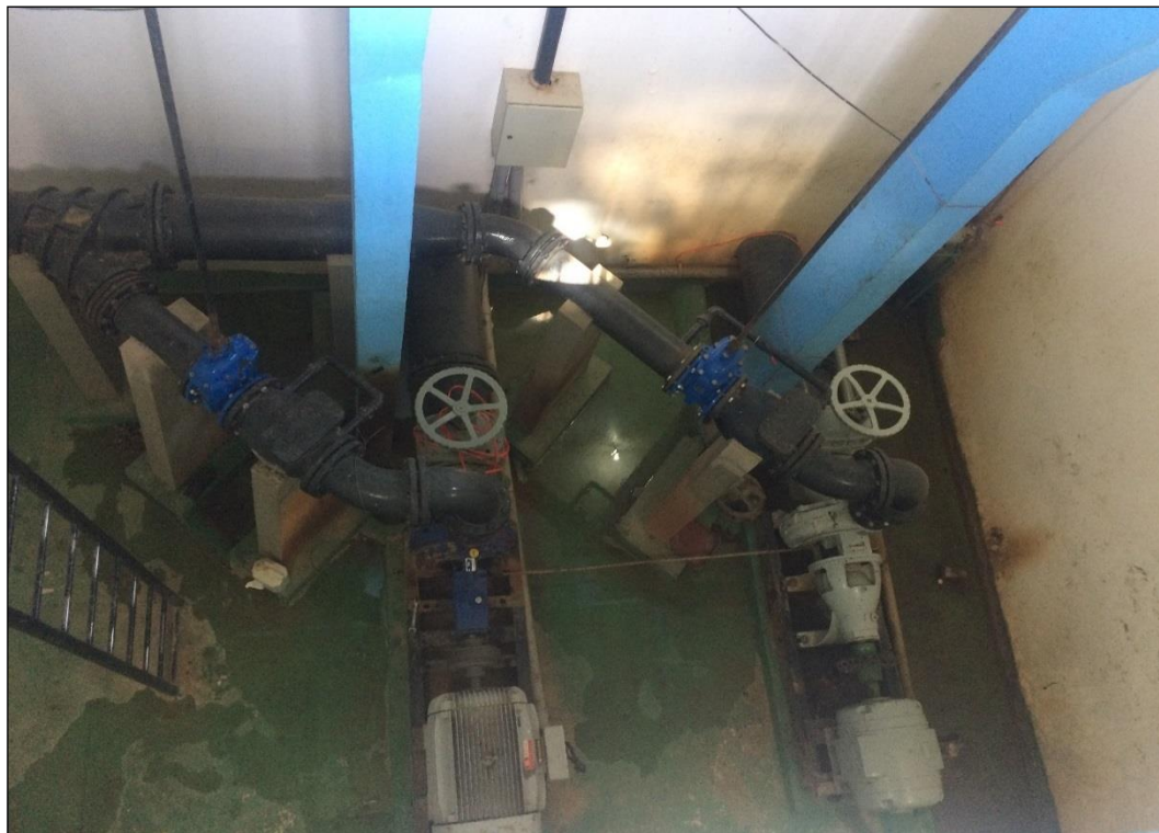
Figura 45 – Bombas de Captação. Fonte: DRZ – Geotecnologia e Consultoria, 2017.
