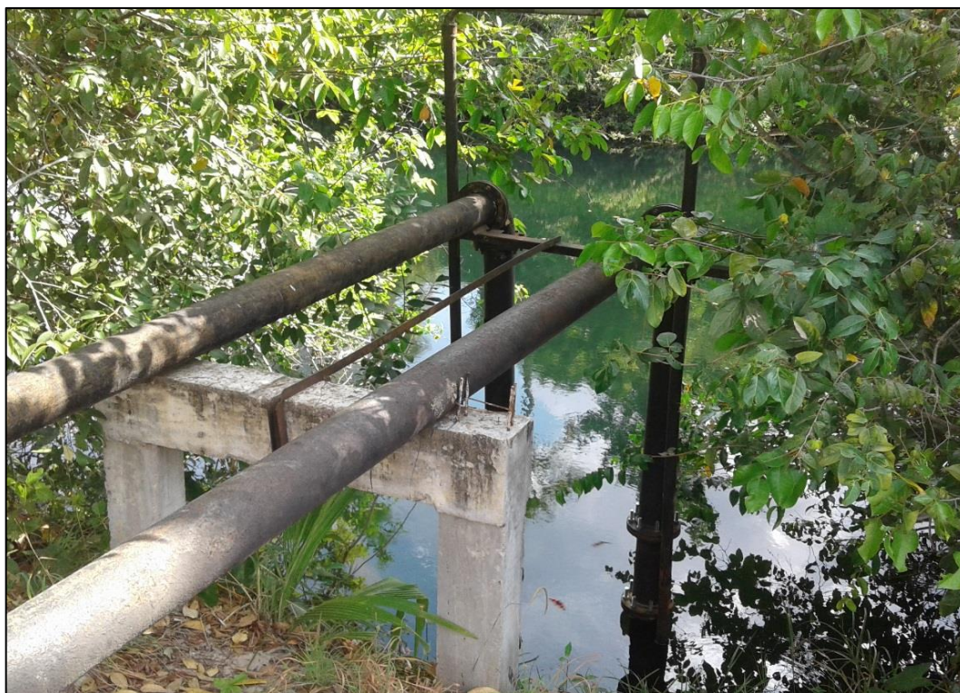
Figura 76 – Captação superficial do distrito de Inhaúmas. Fonte: DRZ – Geotecnologia e Consultoria, 2017.
