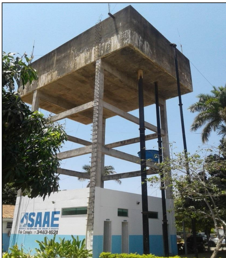
Figura 68 – R1 – Reservatório Elevado. Fonte: DRZ – Geotecnologia e Consultoria, 2017.
