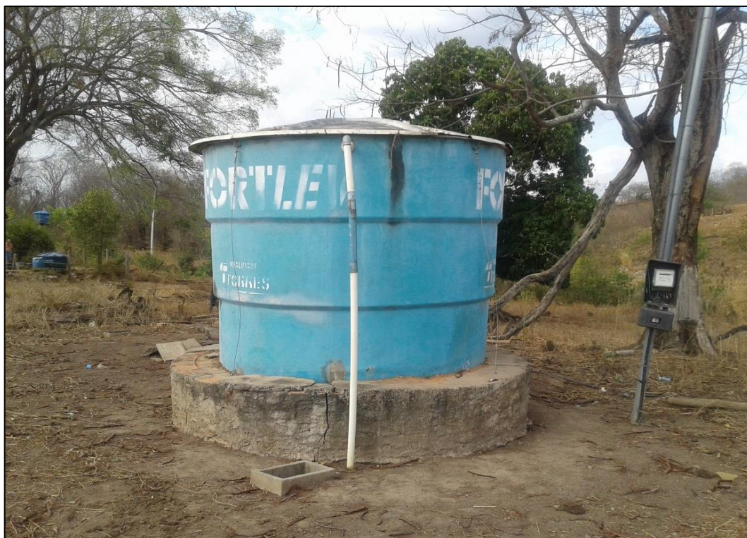
Figura 119 – RAP 1 de fibra de vidro do povoado Ponte Velha. Fonte: DRZ – Geotecnia e Consultoria, 2017.
