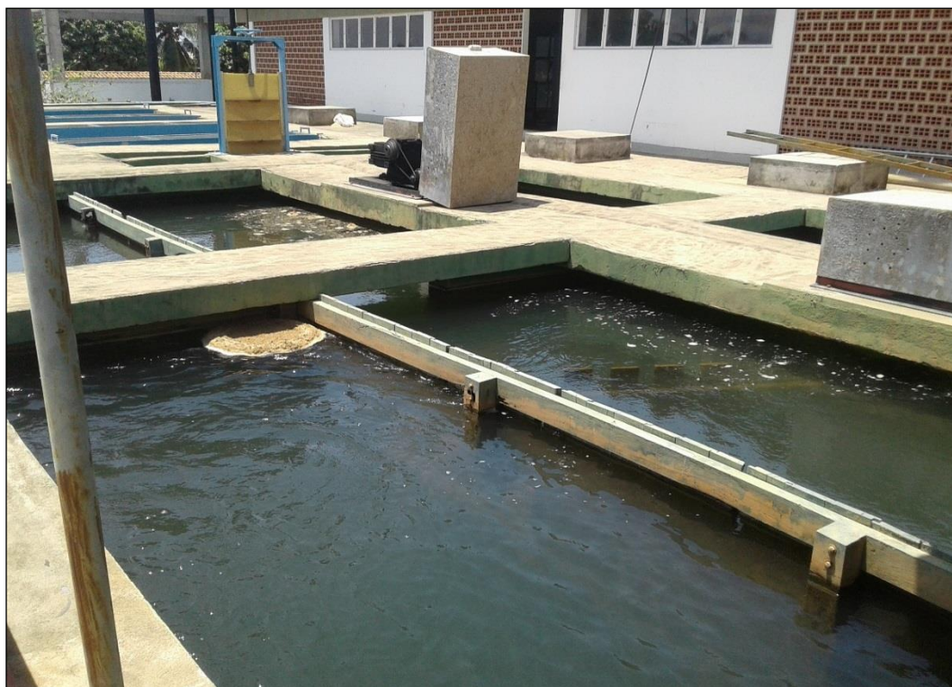
Figura 56 – Floculadores da ETA: Distrito Sede. Fonte: DRZ – Geotecnologia e Consultoria, 2017.
