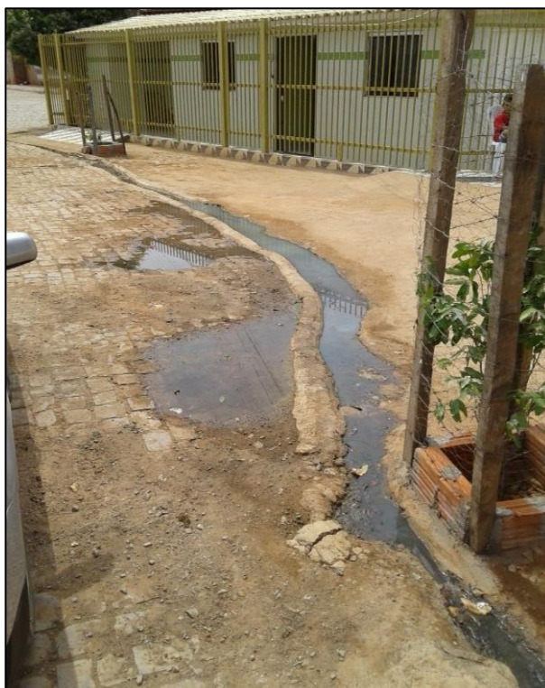
Figura 138 – Lançamento de esgoto em via pública – Comunidade de Mucambo Fonte: DRZ Geotecnologia e Consultoria, 2017
