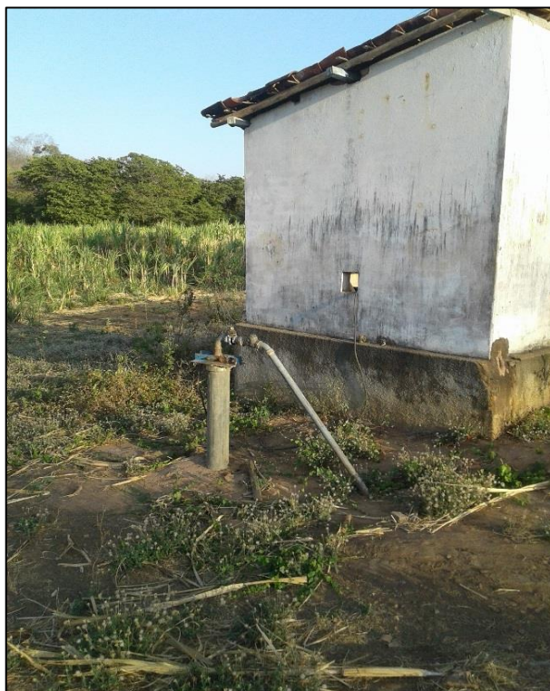
Figura 87 – Captação de poço do povoado Água Quente – Poço 01. Fonte: DRZ – Geotecnologia e Consultoria, 2017.
