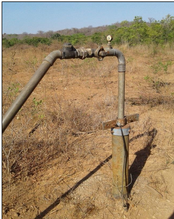
Figura 93 – Captação de poço do povoado Água Quente – Poço 04. Fonte: DRZ – Geotecnologia e Consultoria, 2017.
