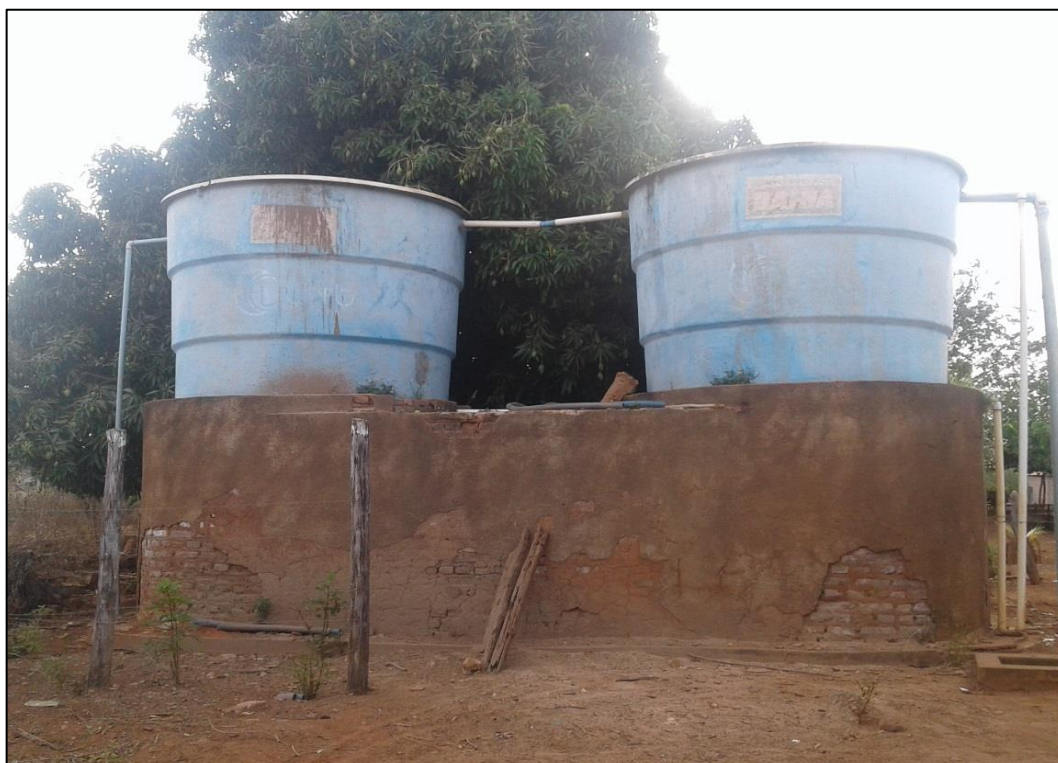
Figura 118 – REL 3 e REL 4 de fibra de vidro do povoado Ponte Velha. Fonte: DRZ – Geotecnologia e Consultoria, 2017.
