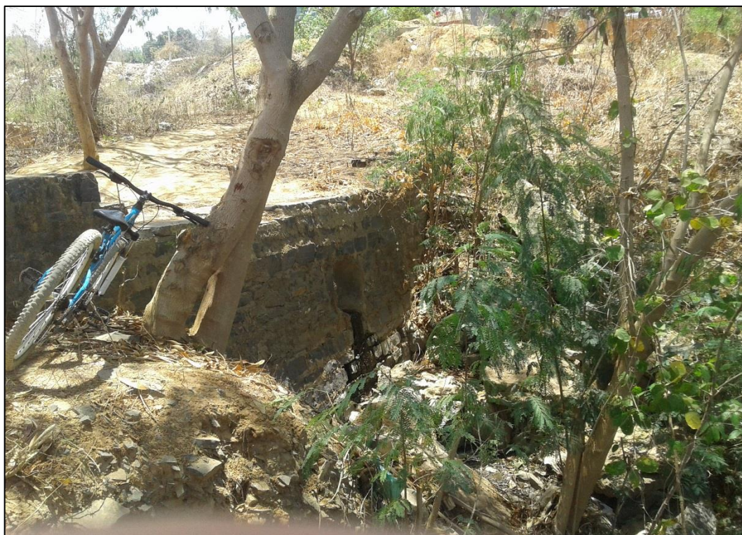
Figura 168 - Lançamento de efluente de esgoto doméstico em rede de drenagem.
