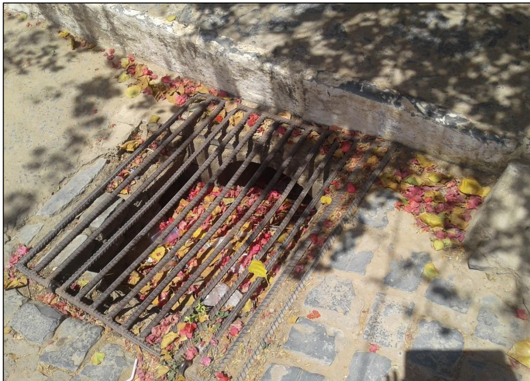
Figura 167 - Estrutura de captação do tipo grelha – Distrito Sede. Fonte: DRZ – Geotecnologia e Consultoria, 2017.
