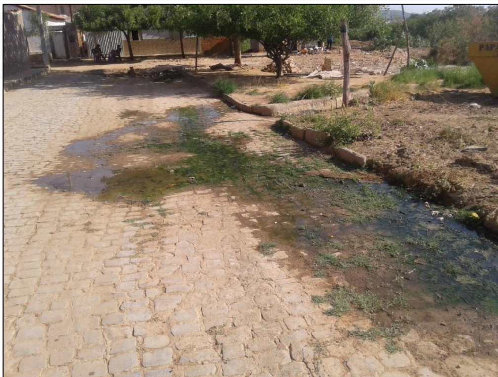
Figura 132 – Lançamento irregular de esgoto em via pública. Fonte: DRZ Geotecnologia e Consultoria, 2017.
