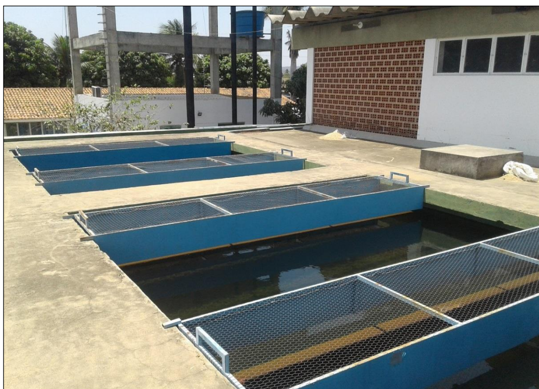
Figura 57 – Decantadores da ETA: Distrito Sede. Fonte: DRZ – Geotecnologia e Consultoria, 2017.
