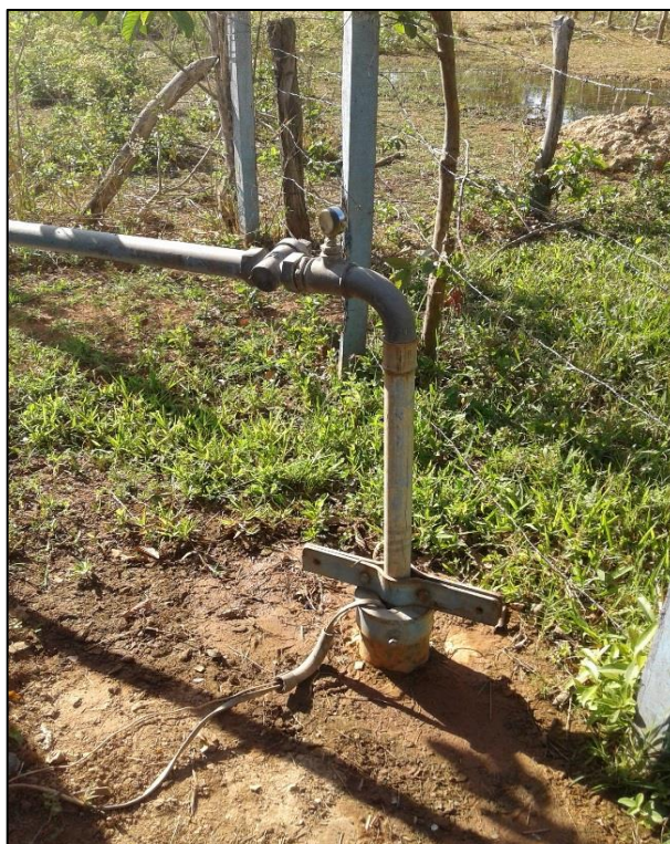
Figura 91 – Captação de poço do povoado Água Quente – Poço 03. Fonte: DRZ – Geotecnologia e Consultoria, 2017.
