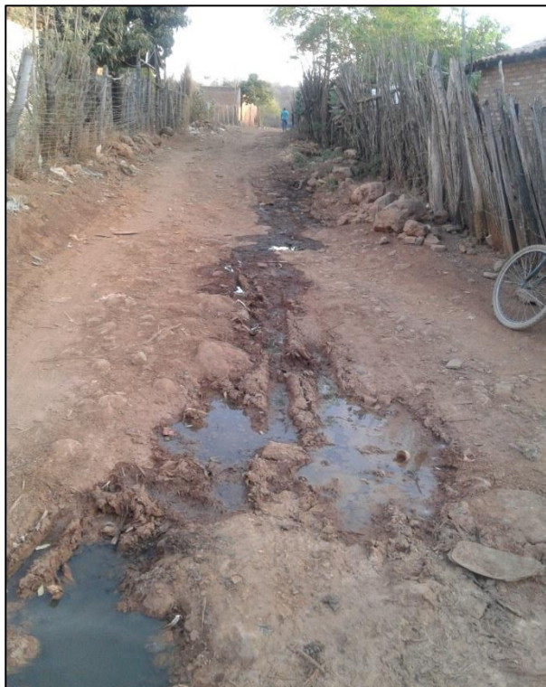
Figura 136 – Lançamento de esgoto em via pública. Fonte: DRZ Geotecnologia e Consultoria, 2017.
