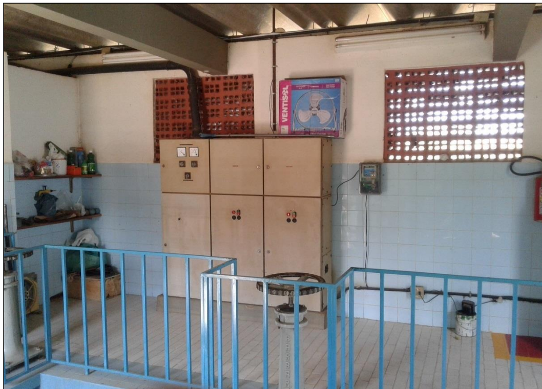
Figura 44 – Painel de comando e controle manual das bombas. Fonte: DRZ – Geotecnologia e Consultoria, 2017.
