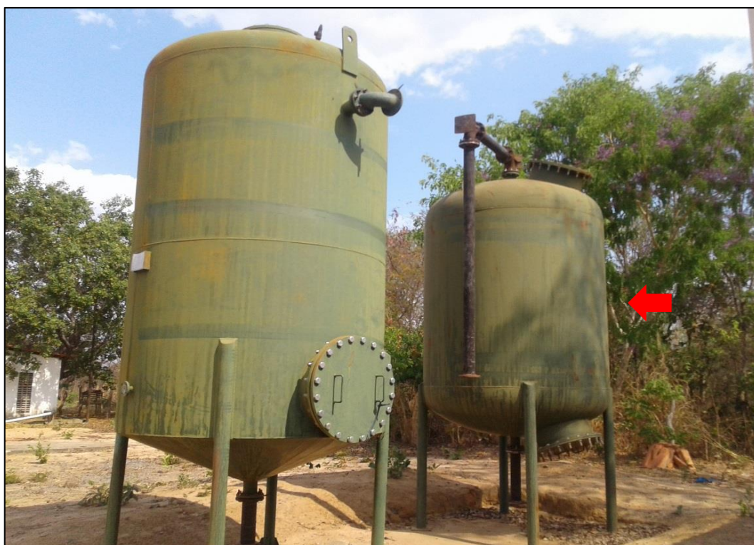
Figura 79 – Decantador desativado do distrito de Inhaúmas. Fonte: DRZ – Geotecnologia e Consultoria, 2017.
