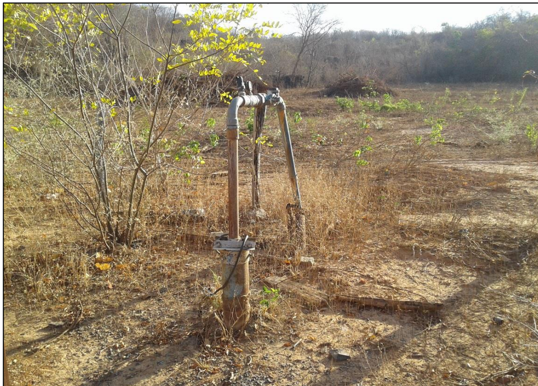
Figura 89 – Captação de poço do povoado Água Quente – Poço 02. Fonte: DRZ – Geotecnologia e Consultoria, 2017.
