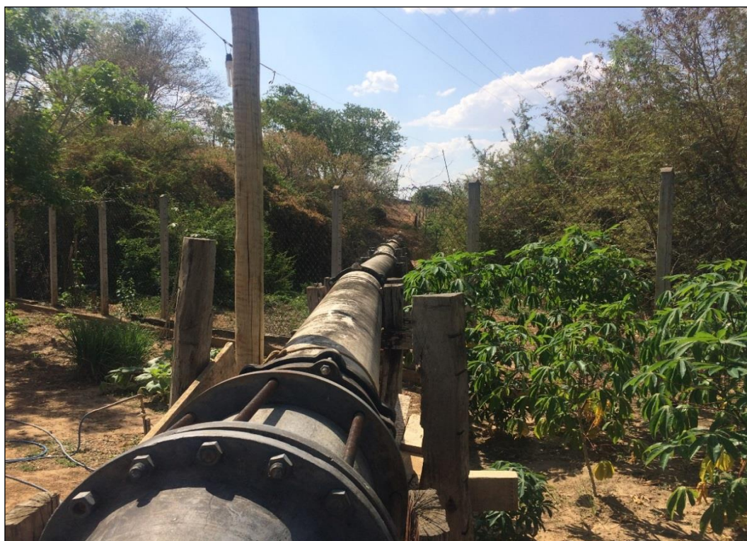
Figura 49 – Adutora de Água Bruta. Fonte: DRZ – Geotecnologia e Consultoria, 2017.
