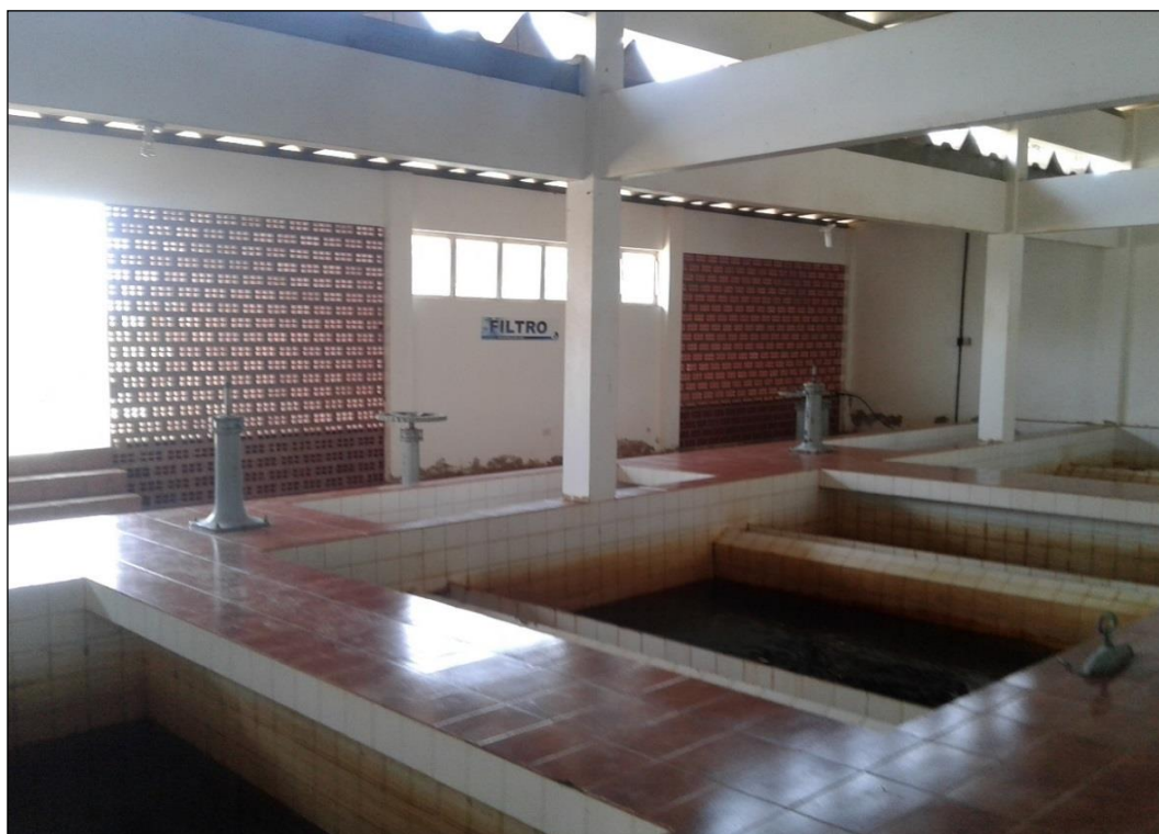
Figura 59 – Filtros da ETA: Distrito Sede. Fonte: DRZ – Geotecnologia e Consultoria, 2017.
