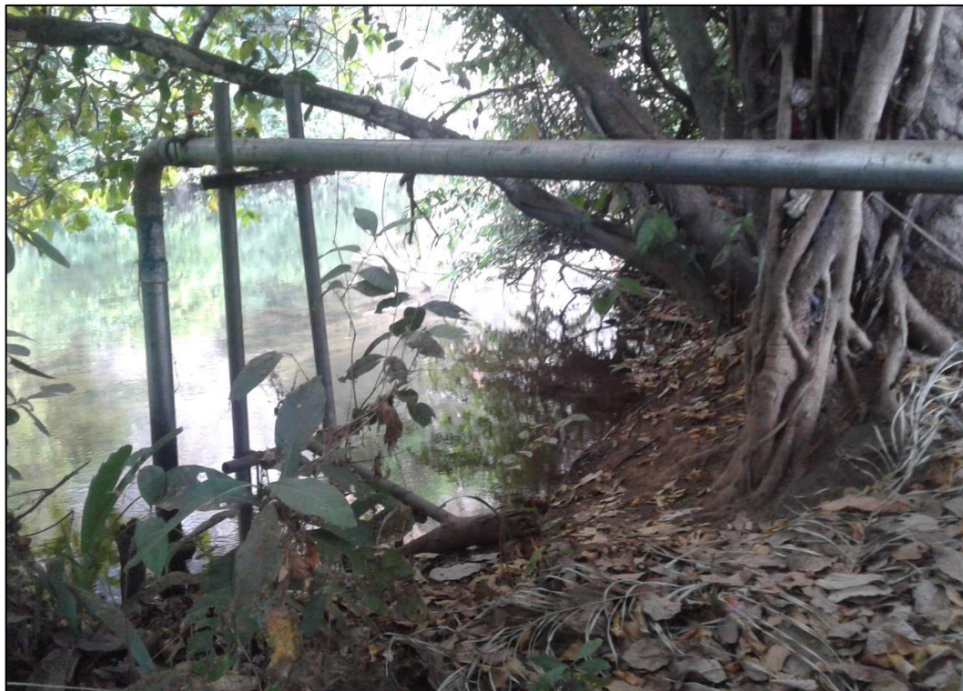
Figura 116 – Captação por bomba superficial do povoado de Ponte Velha. Fonte: DRZ – Geotecnologia e Consultoria, 2017.
