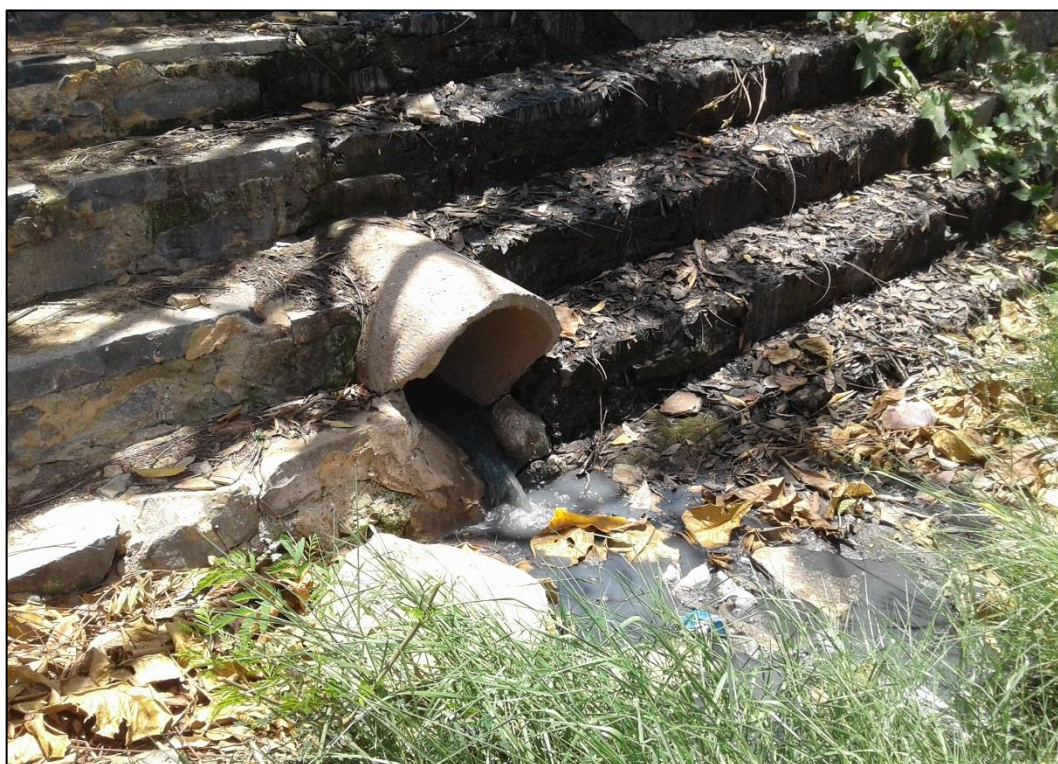
Figura 169 - Lançamento de efluente de esgoto doméstico em rede de drenagem.
