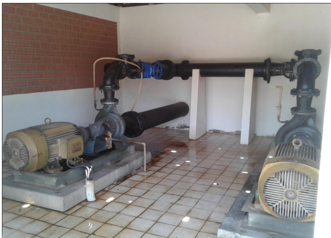
Figura 52 – Estação Elevatória de Água Tratada. Fonte: DRZ – Geotecnologia e Consultoria, 2017.
