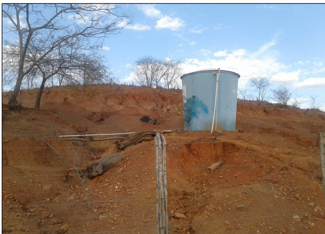
Figura 120 – RAP 2 de fibra de vidro do povoado Ponte Velha. Fonte: DRZ – Geotecnia e Consultoria, 2017.
