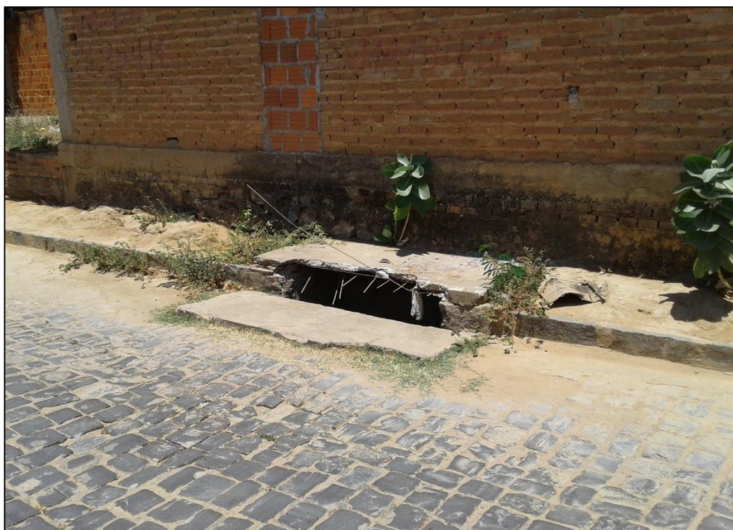
Figura 166 - Estrutura de captação do tipo lateral – Distrito Sede. Fonte: DRZ – Geotecnologia e Consultoria, 2017.
