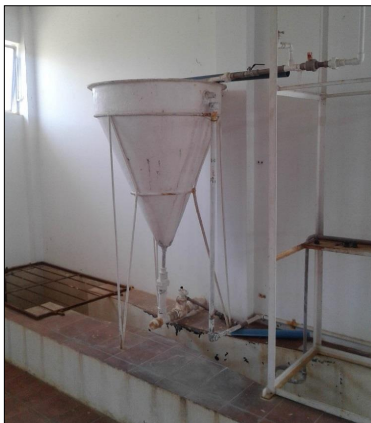
Figura 66 – Adição de flúor e medição de vazão na saída da ETA. Fonte: DRZ – Geotecnologia e Consultoria, 2017.
