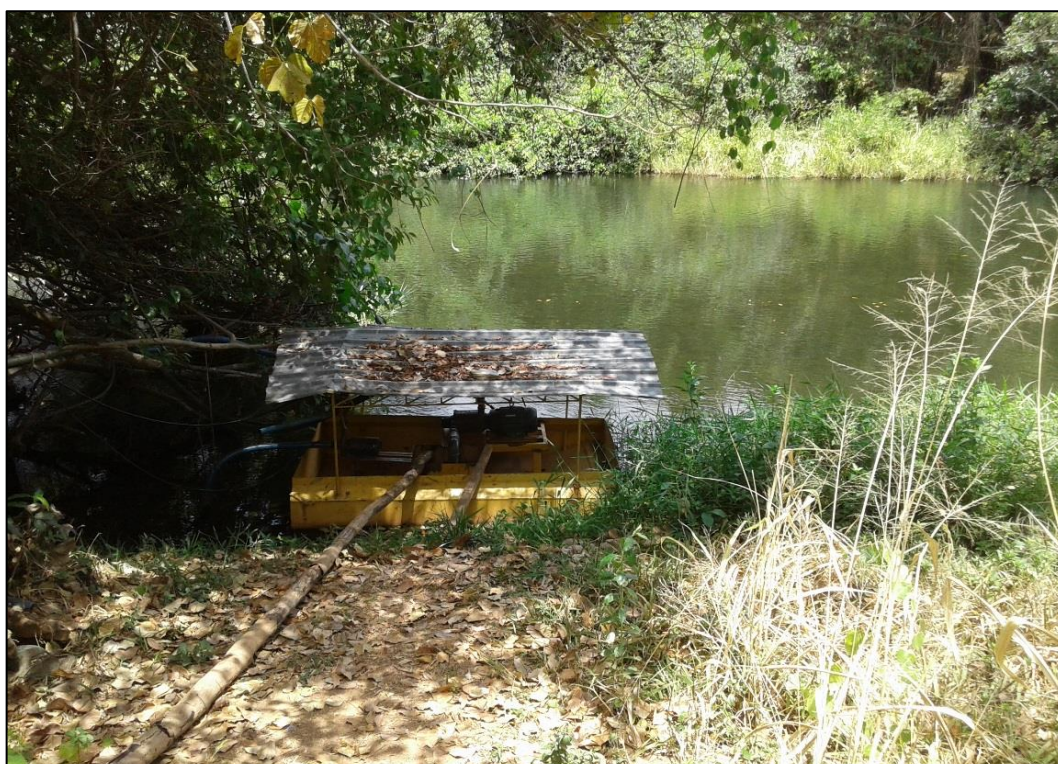
Figura 97 – Captação do povoado Caniveta. Fonte: DRZ – Geotecnologia e Consultoria, 2017.
