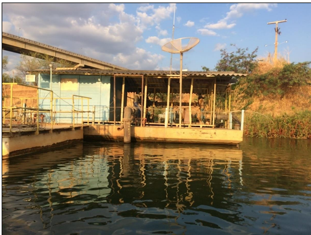
Figura 34 – Captação superficial no Rio São Francisco – Distrito Sede.
