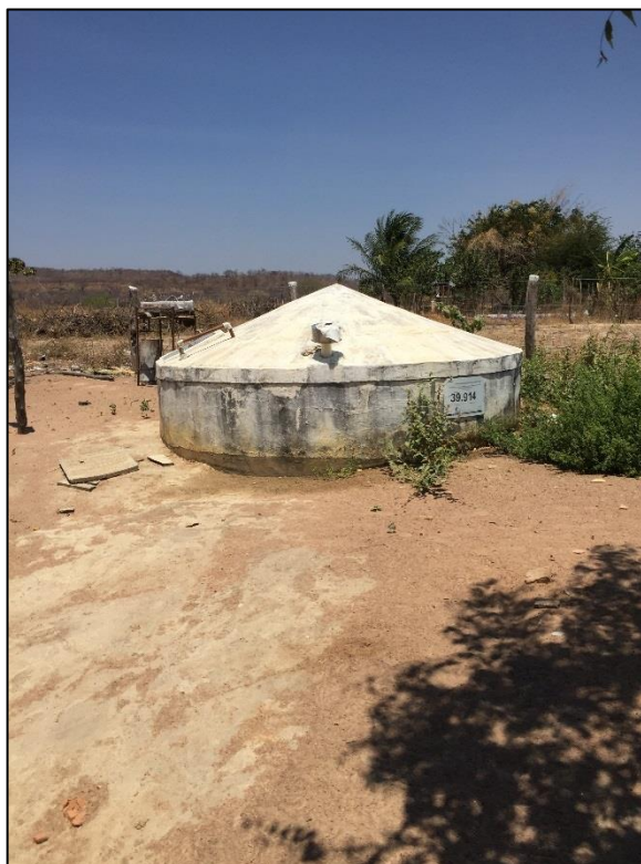
Figura 86 – Cisterna do controlador – Comunidade Silvestre. Fonte: DRZ – Geotecnologia e Consultoria, 2017.
