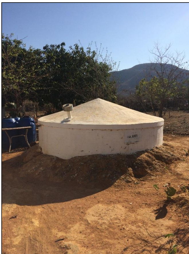
Figura 80 – Cisterna e ponto de controle – Comunidade Chapada Grande. Fonte: DRZ – Geotecnologia e Consultoria, 2017.
