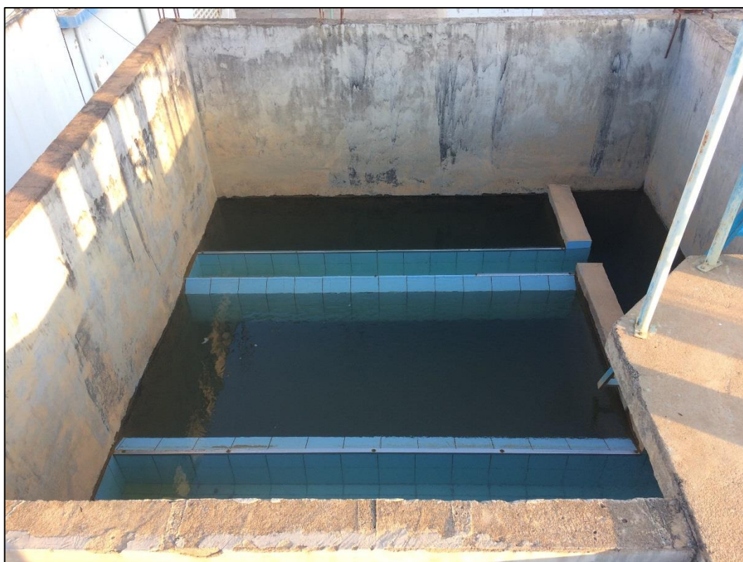
Figura 48 – Filtros ETA nova – Distrito Sede. Fonte: DRZ – Geotecnologia e Consultoria, 2017.
