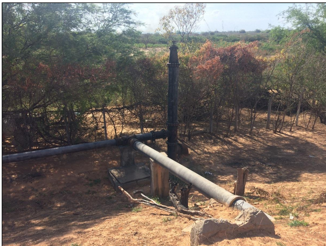
Figura 156 – Emissário - ETE. Fonte: DRZ – Geotecnologia e Consultoria, 2017.
