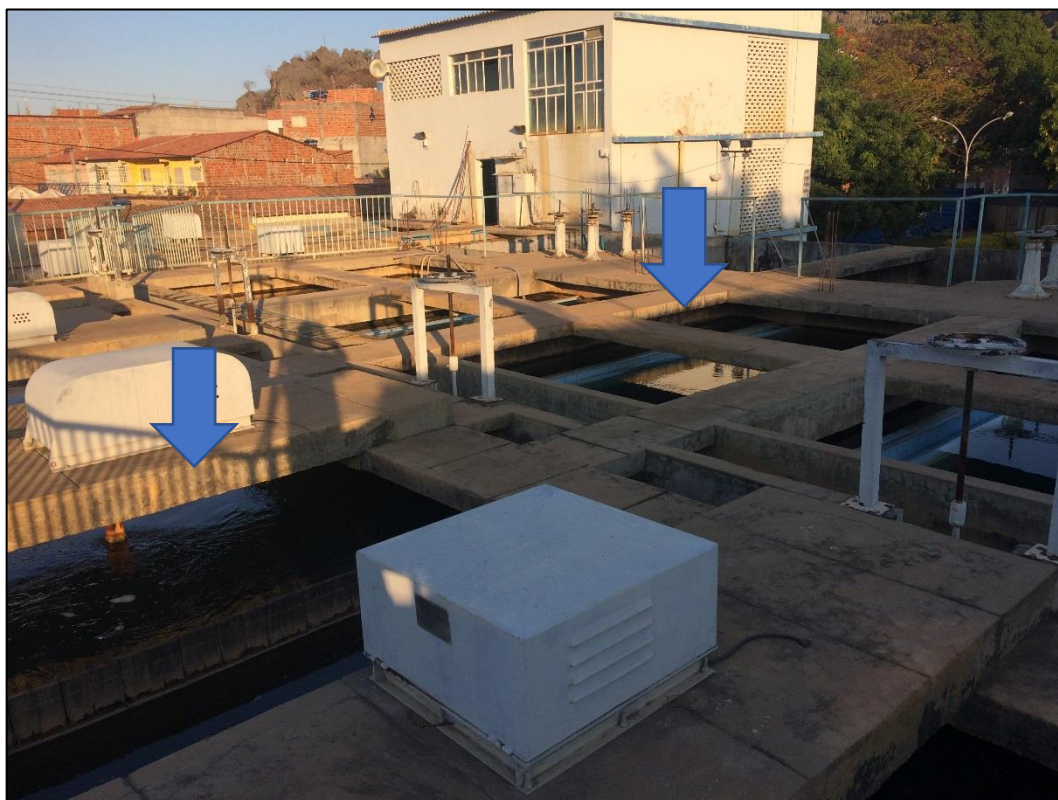
Figura 47 – Floculadores e decantadores ETA nova – Distrito Sede. Fonte: DRZ – Geotecnologia e Consultoria, 2017.
