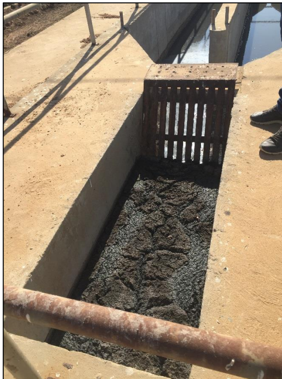
Figura 152 – Gradeamento - ETE. Fonte: DRZ – Geotecnologia e Consultoria, 2017.
