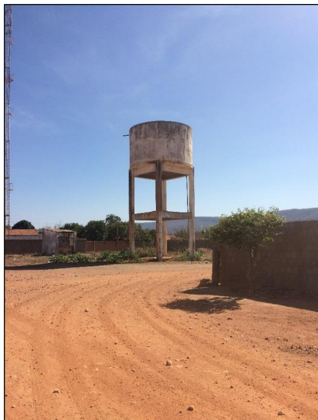
Figura 76 – REL 50m 3 – Distrito de Favelândia. Fonte: DRZ – Geotecnologia e Consultoria, 2017.
