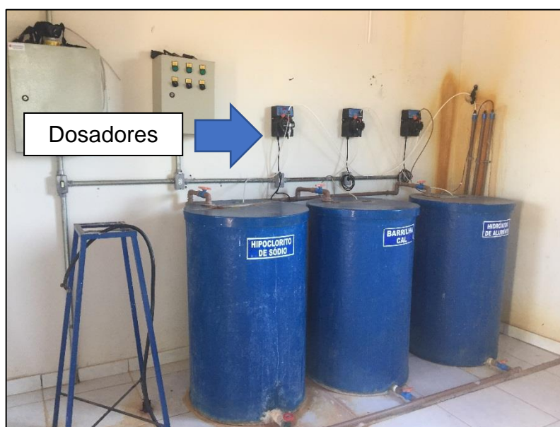
Figura 128 – Adição de produtos químicos e dosadores. Fonte: DRZ – Geotecnologia e Consultoria, 2017
