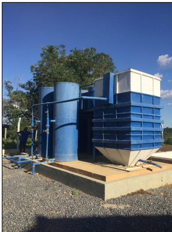
Figura 124 – ETA Compacta – Comunidade de Piranhas. Fonte: DRZ – Geotecnologia e Consultoria, 2017.
