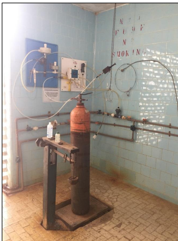
Figura 51 – Dosador de cloro gás. Fonte: DRZ – Geotecnologia e Consultoria, 2017.
