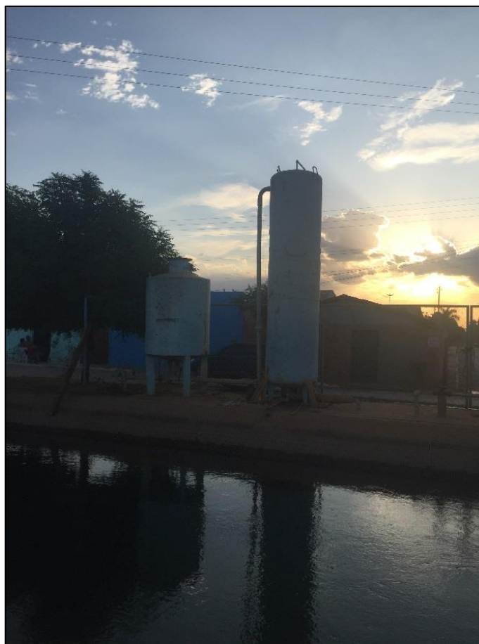
Figura 132 – Filtro de tratamento. Fonte: DRZ – Geotecnologia e Consultoria, 2017.
