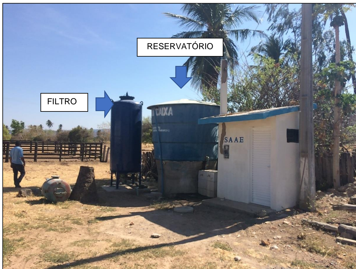
Figura 75 – Sistema de filtros – Distrito de Favelândia.
