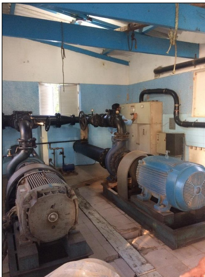
Figura 38 – Bombas da EEAT. Fonte: DRZ – Geotecnologia e Consultoria, 2017.
