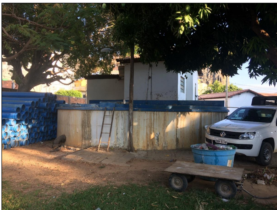
Figura 64 – R2 – Reservatório ETA. Fonte: DRZ – Geotecnologia e Consultoria, 2017.
