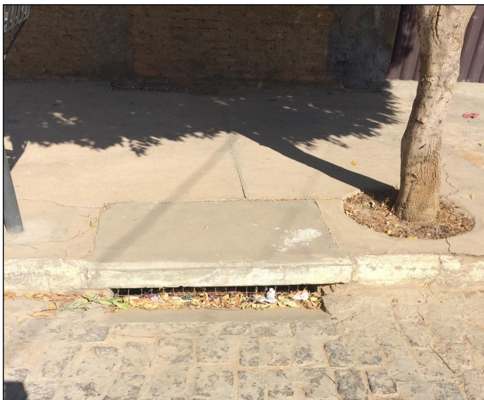
Figura 201 – Estrutura de captação do tipo lateral – Distrito Sede. Fonte: DRZ – Geotecnologia e Consultoria, 2017.
