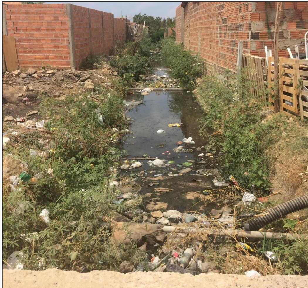
Figura 202 – Canaleta de drenagem com acúmulo de efluente de esgoto doméstico.
