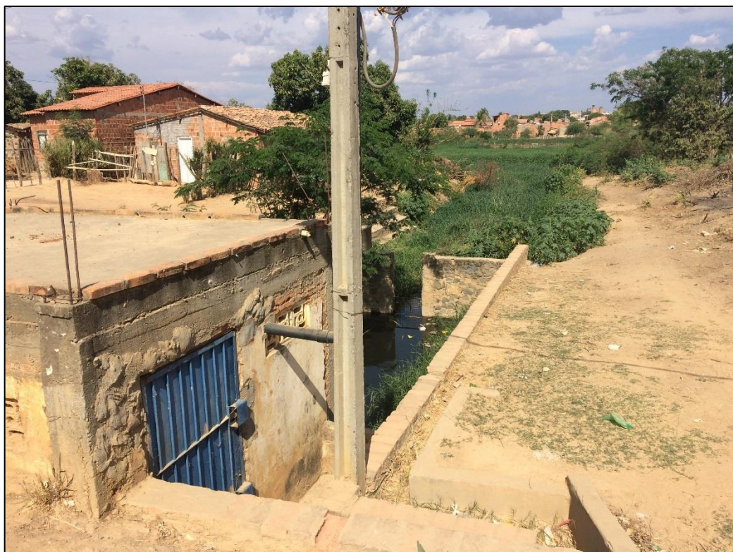
Figura 203 – Lagoa de contenção de drenagem com acúmulo de efluente de esgoto doméstico.
