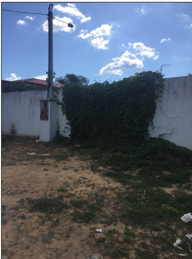
Figura 149 – EEE – Sem denominação Bairro Cavahada Fonte: DRZ – Geotecnologia e Consultoria, 2017.
