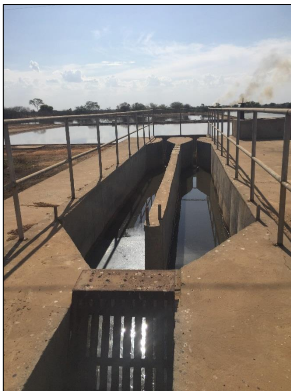
Figura 154 – Gradeamento e Calha Parshall - ETE. Fonte: DRZ – Geotecnologia e Consultoria, 2017.
