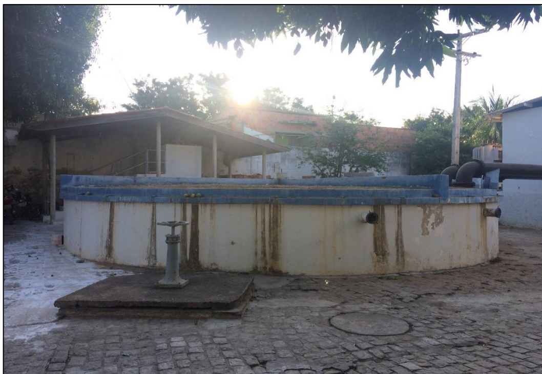
Figura 63 – R1 – Reservatório ETA. Fonte: DRZ – Geotecnologia e Consultoria, 2017.
