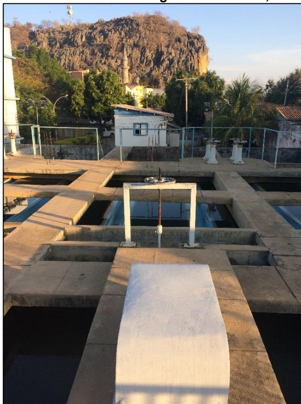
Figura 44 – Filtros ETA antiga – Distrito Sede. Fonte: DRZ – Geotecnologia e Consultoria, 2017.
