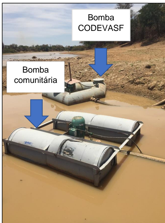
Figura 100 – Captação superficial – Assentamento Batalha Sede. Fonte: DRZ – Geotecnologia e Consultoria, 2017.
