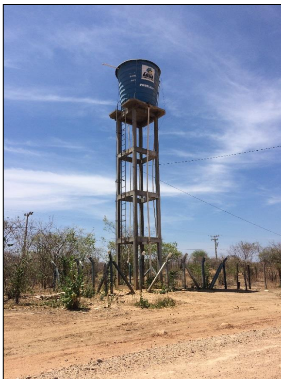
Figura 112 – REL 20 m 3 – Nova Batalhinha. Fonte: DRZ – Geotecnologia e Consultoria, 2017.
