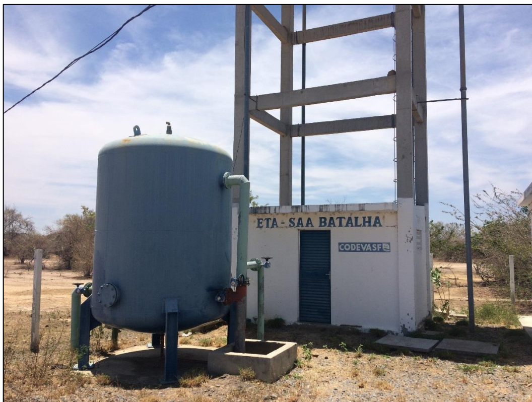
Figura 101 – Filtro de tratamento – Assentamento Batalha Sede. Fonte: DRZ – Geotecnologia e Consultoria, 2017.
