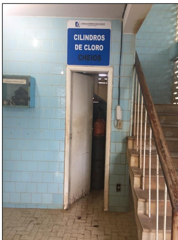
Figura 54 – Depósito de cilindros de cloro gás. Fonte: DRZ – Geotecnologia e Consultoria, 2017.
