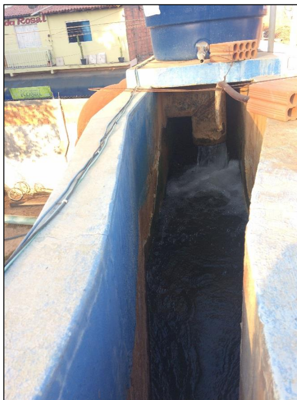
Figura 45 – Calha Parshall da ETA nova – Distrito Sede. Fonte: DRZ – Geotecnologia e Consultoria, 2017.
