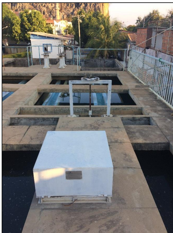
Figura 46 – Floculador ETA nova – Distrito Sede. Fonte: DRZ – Geotecnologia e Consultoria, 2017.
