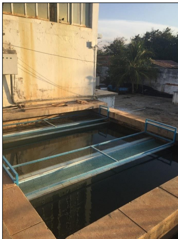
Figura 43 – Decantadores ETA antiga – Distrito Sede. Fonte: DRZ – Geotecnologia e Consultoria, 2017.
