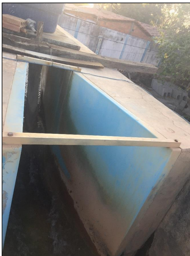
Figura 41 – Calha Parshall da ETA Antiga – Distrito Sede. Fonte: DRZ – Geotecnologia e Consultoria, 2017.
