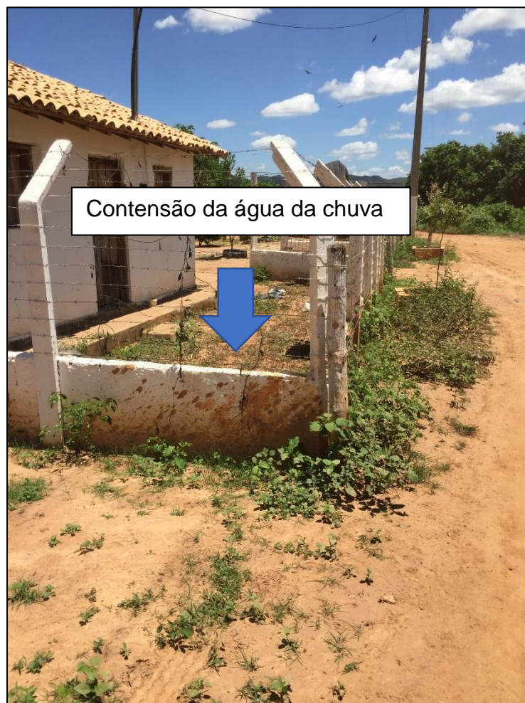
Figura 212 – Contensão em residência para água da chuva. Fonte: DRZ – Geotecnologia e Consultoria, 2018
