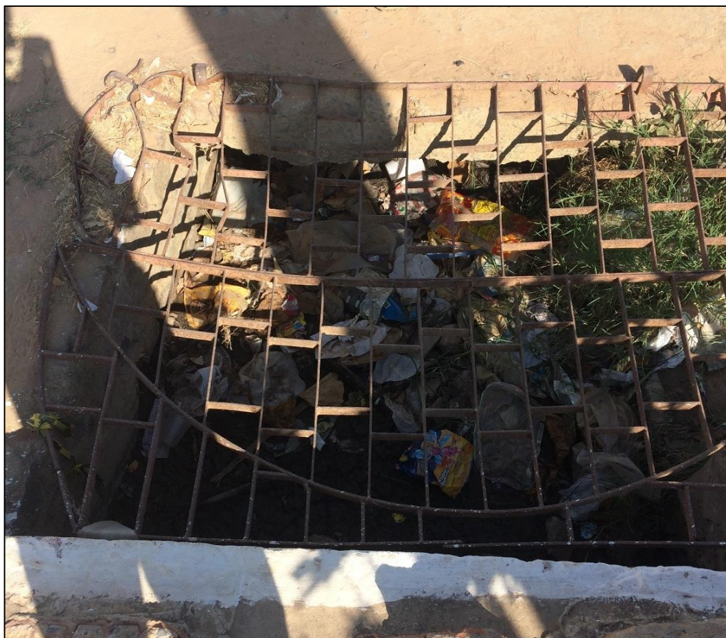
Figura 215 – Estrutura de captação de água pluvial sem manutenção. Fonte: DRZ – Geotecnologia e Consultoria, 2017.
