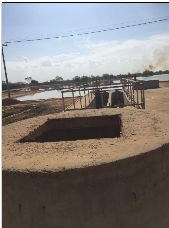
Figura 153 – Calha Parshall - ETE. Fonte: DRZ – Geotecnologia e Consultoria, 2017.
