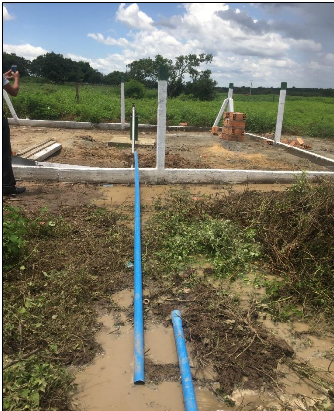
Figura 108 – Adutora de água bruta do novo poço de Retiro da Picada. Fonte: DRZ – Geotecnologia e Consultoria, 2018.
