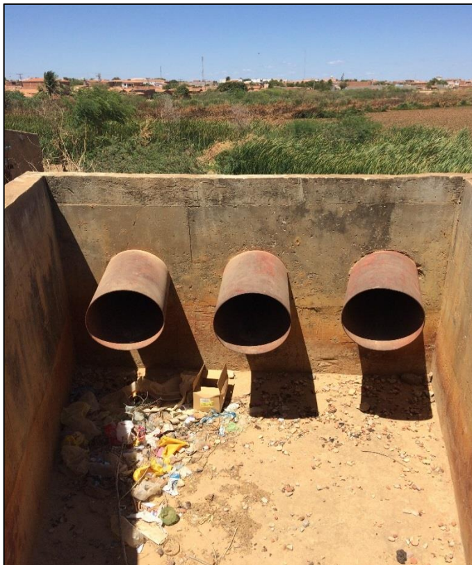
Figura 226 – Sistema de direcionamento das águas da lagoa de contenção. Fonte: DRZ – Geotecnologia e Consultoria, 2017.
