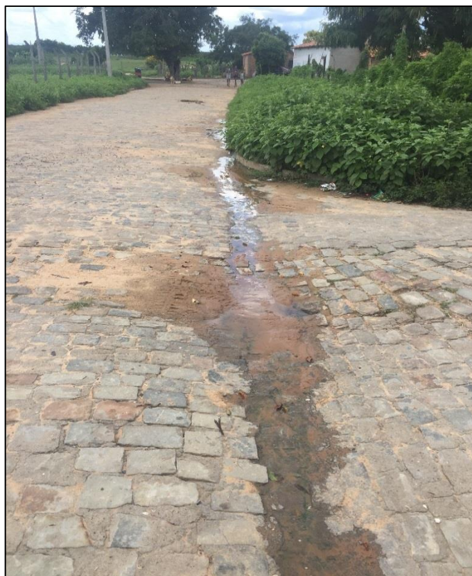
Figura 172 – Lançamento de esgoto nas ruas: comunidade Retiro da Picada. Fonte: DRZ – Geotecnologia e Consultoria, 2018.
