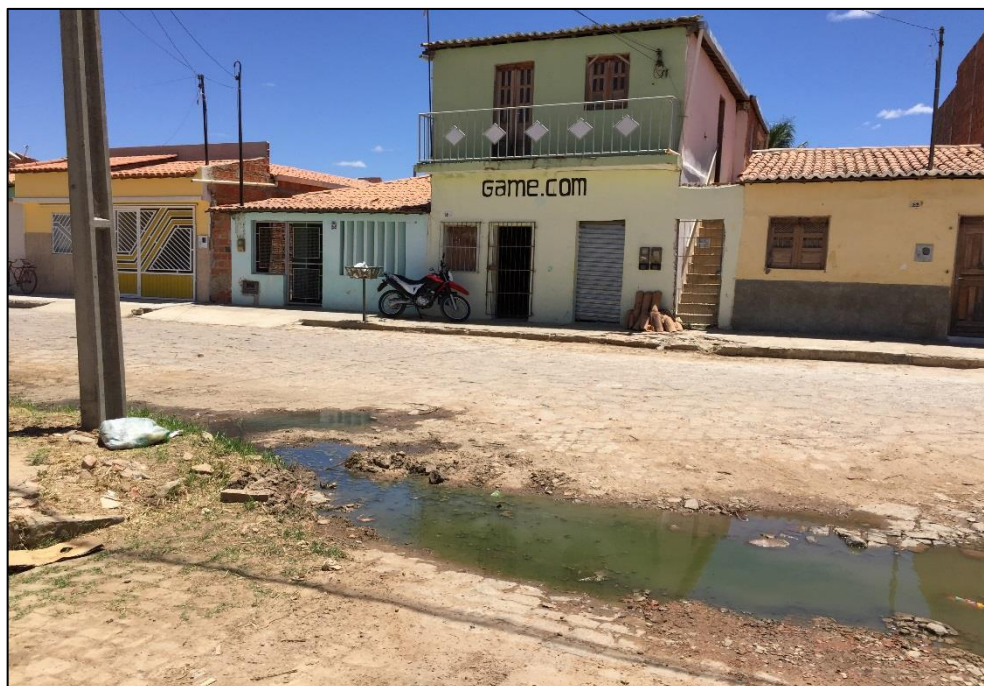
Figura 152 – Lançamento de esgoto à céu aberto do distrito Sede. Fonte: DRZ – Geotecnologia e Consultoria, 2017.
