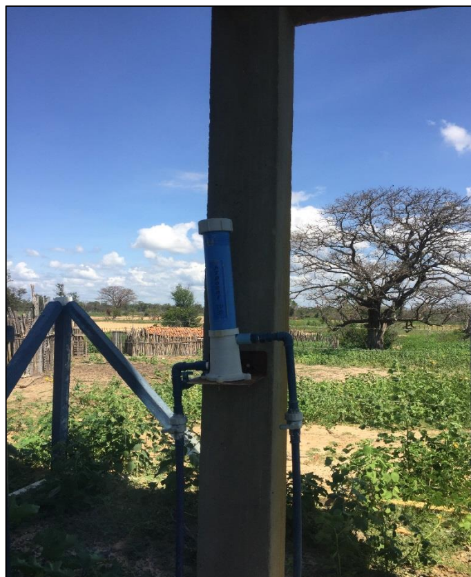
Figura 116 – Dosador de cloro da comunidade Utinga. Fonte: DRZ – Geotecnologia e Consultoria, 2018.
