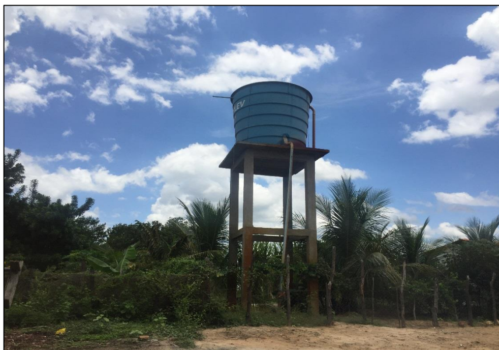
Figura 110 – Reservatório Elevado (REL) de 15 m 3 da comunidade Retiro da Picada.
