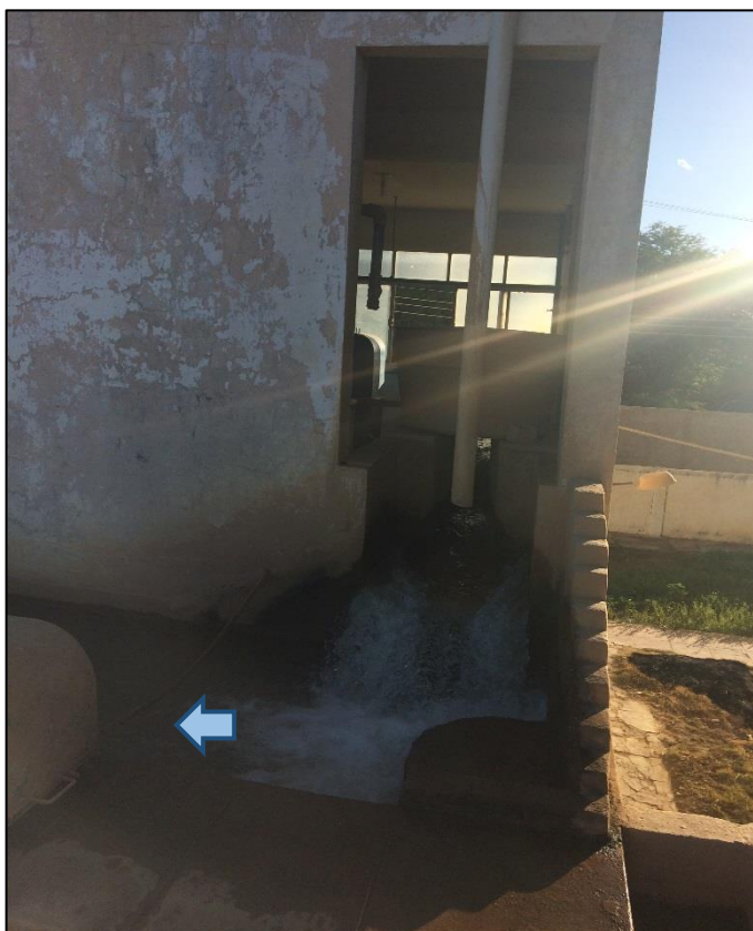
Figura 42 – Saída da calha parshall para os floculadores. Fonte: DRZ – Geotecnologia e Consultoria, 2017.
