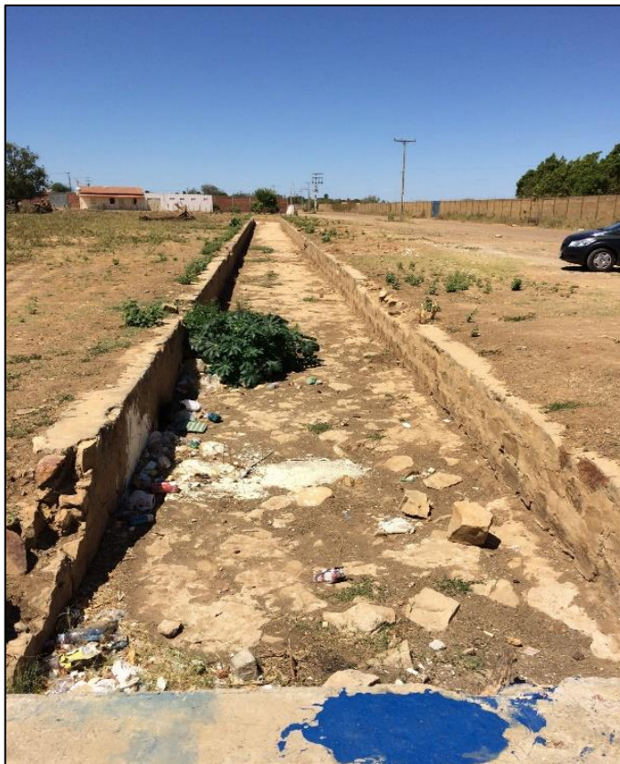
Figura 220 – Canal de drenagem pluvial no município de Xique-Xique. Fonte: DRZ – Geotecnologia e Consultoria, 2017.
