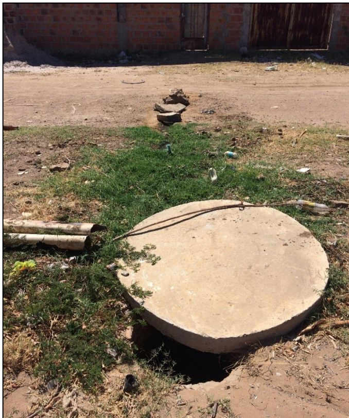
Figura 219 – Rede de drenagem utilizada irregularmente para lançamento de esgoto doméstico.
