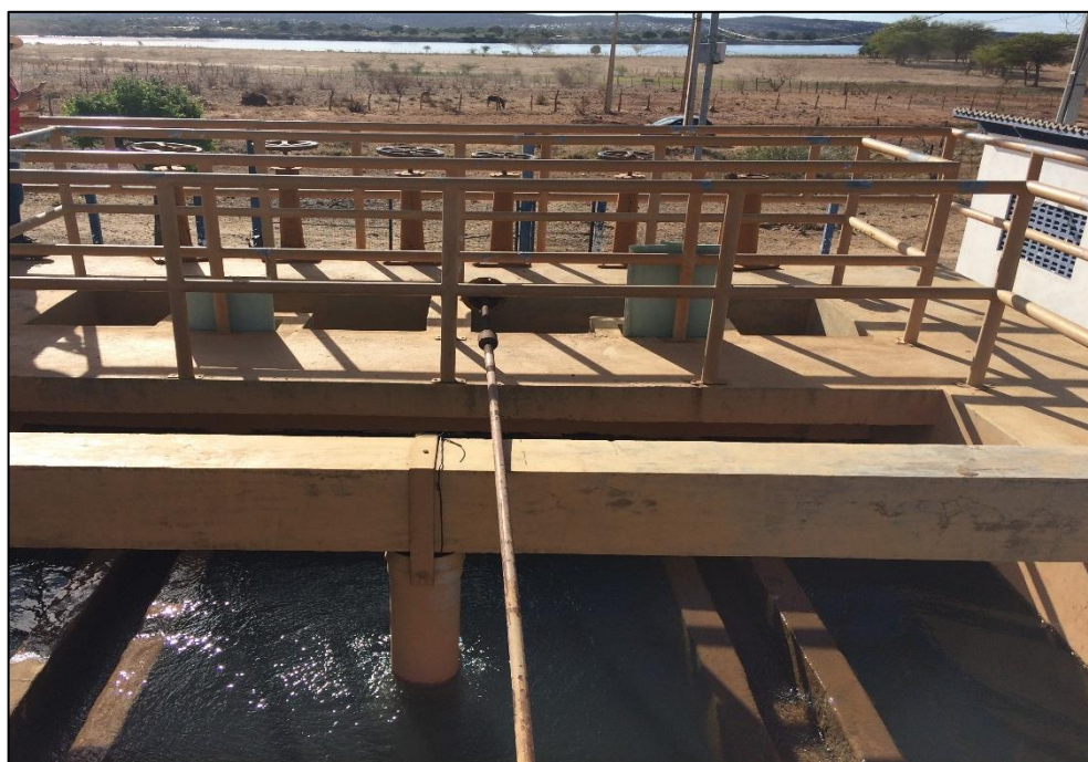
Figura 86 – Floco-decantadores da ETA da comunidade Boa Vista. Fonte: DRZ – Geotecnologia e Consultoria, 2017.
