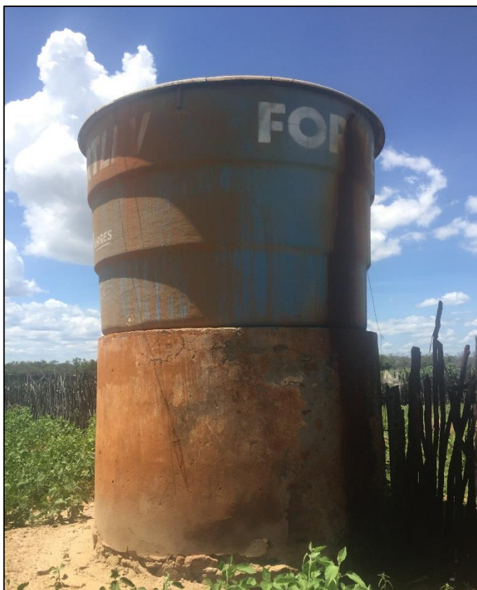
Figura 100 – Reservatório Elevado (REL) da comunidade Furquilha. Fonte: DRZ – Geotecnologia e Consultoria, 2018.
