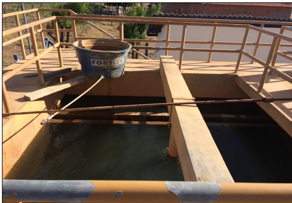
Figura 85 – Adição de sulfato, ETA da comunidade Boa Vista. Fonte: DRZ – Geotecnologia e Consultoria, 2017.
