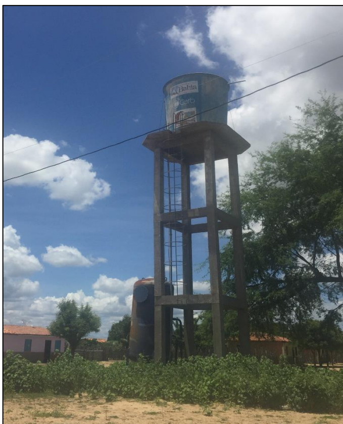
Figura 94 – REL de 10 m 3 , com filtro, da comunidade Capão do Martinho. Fonte: DRZ – Geotecnologia e Consultoria, 2018.
