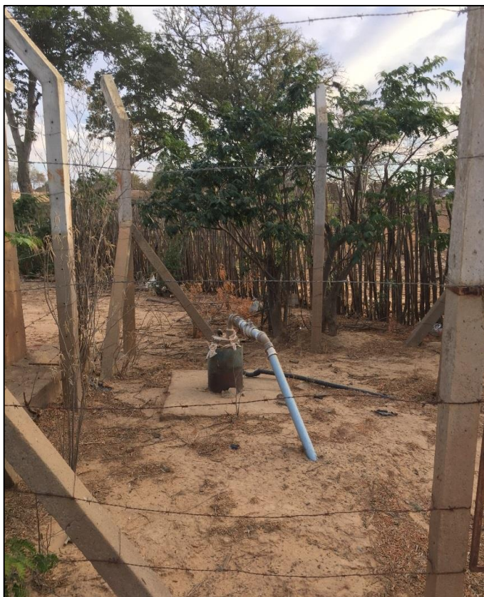
Figura 127 – Poço de captação subterrânea: comunidade Juremal. Fonte: DRZ – Geotecnologia e Consultoria, 2017.
