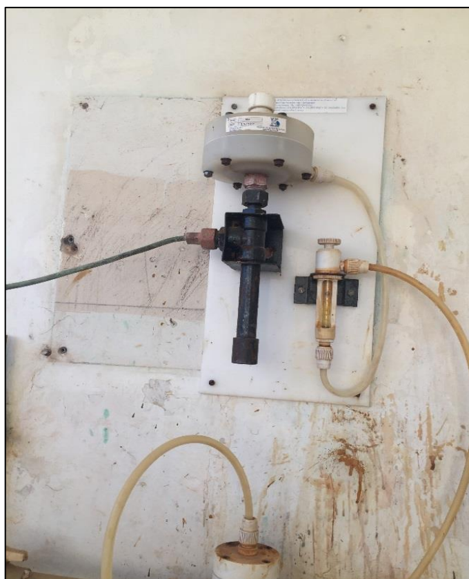
Figura 50 – Dosador de cloro gás. Fonte: DRZ – Geotecnologia e Consultoria, 2017.
