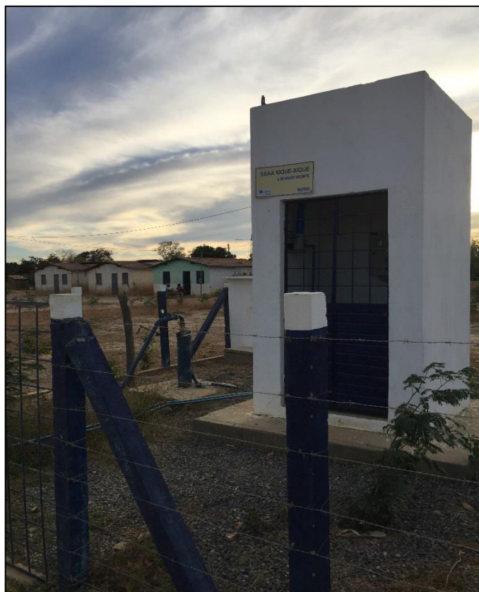
Figura 135 – Poço de captação subterrânea 01: comunidade Vicentes. Fonte: DRZ – Geotecnologia e Consultoria, 2017.
