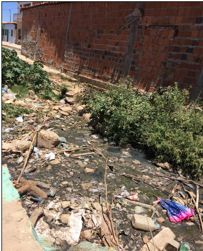
Figura 246 – Canaleta entupida de resíduos sólidos e esgoto doméstico. Fonte: DRZ – Geotecnologia e Consultoria, 2017.
