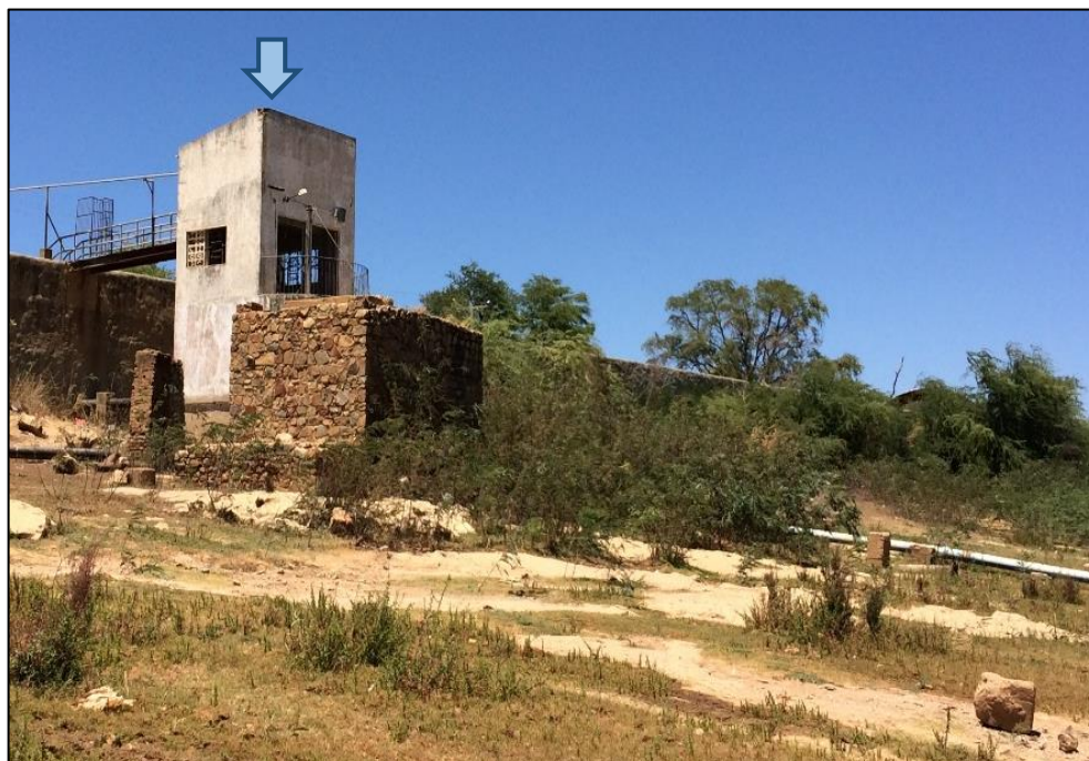
Figura 36 – Estação elevatória de água bruta do distrito Sede. Fonte: DRZ – Geotecnologia e Consultoria, 2017.
