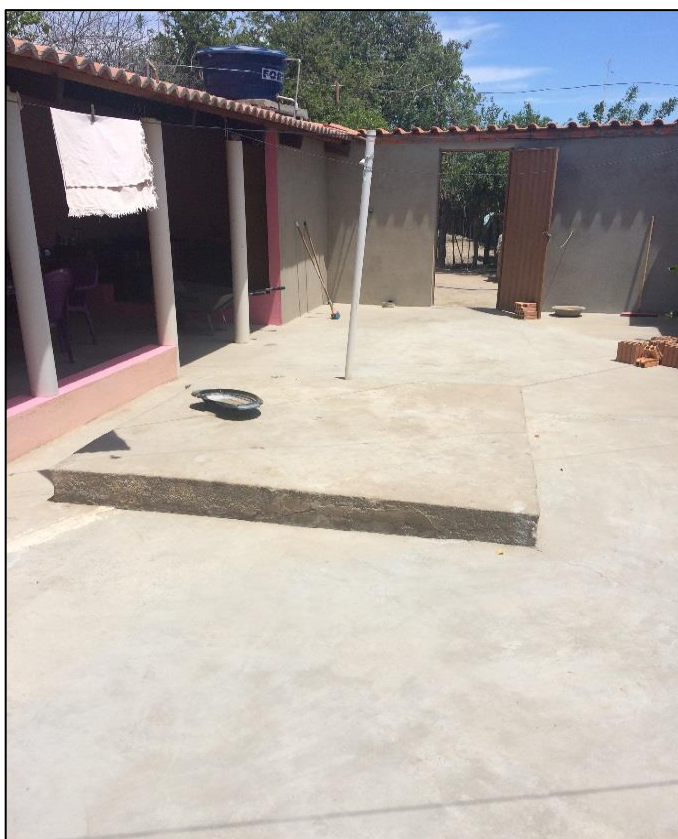
Figura 161 – Fossa rudimentar residencial no distrito Copixaba. Fonte: DRZ – Geotecnologia e Consultoria, 2017.
