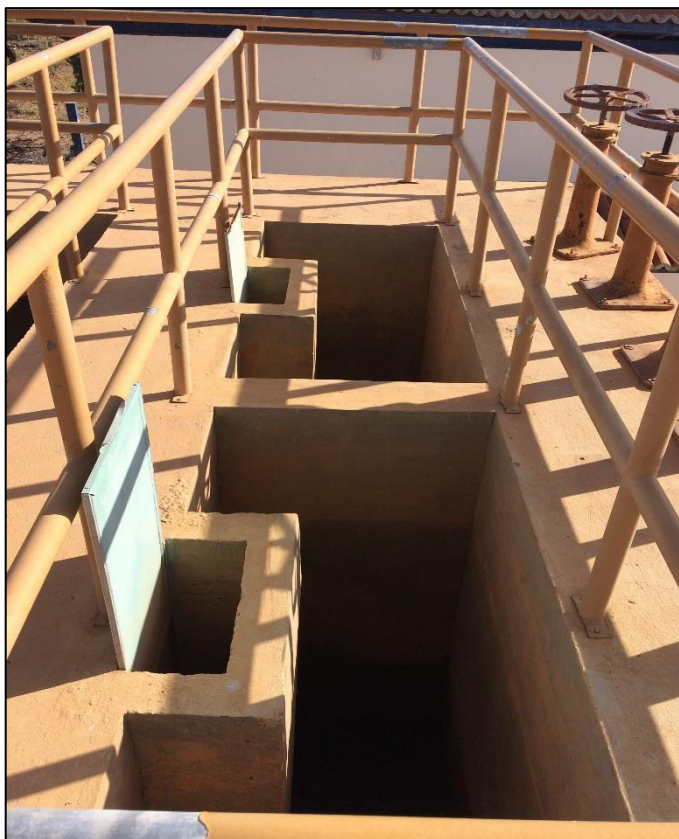
Figura 87 – Filtros da ETA da comunidade Boa Vista. Fonte: DRZ – Geotecnologia e Consultoria, 2017.
