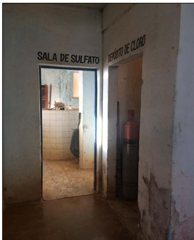
Figura 47 – Sala de sulfato da ETA do distrito Sede. Fonte: DRZ – Geotecnologia e Consultoria, 2017.
