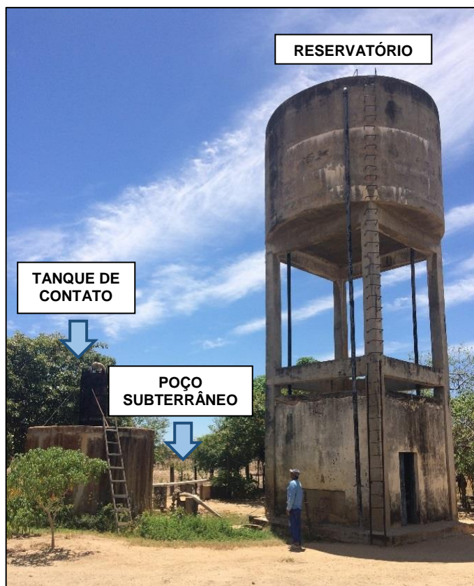
Figura 69 – Sistema de tratamento da água do distrito Copixaba. Fonte: DRZ – Geotecnologia e Consultoria, 2017.
