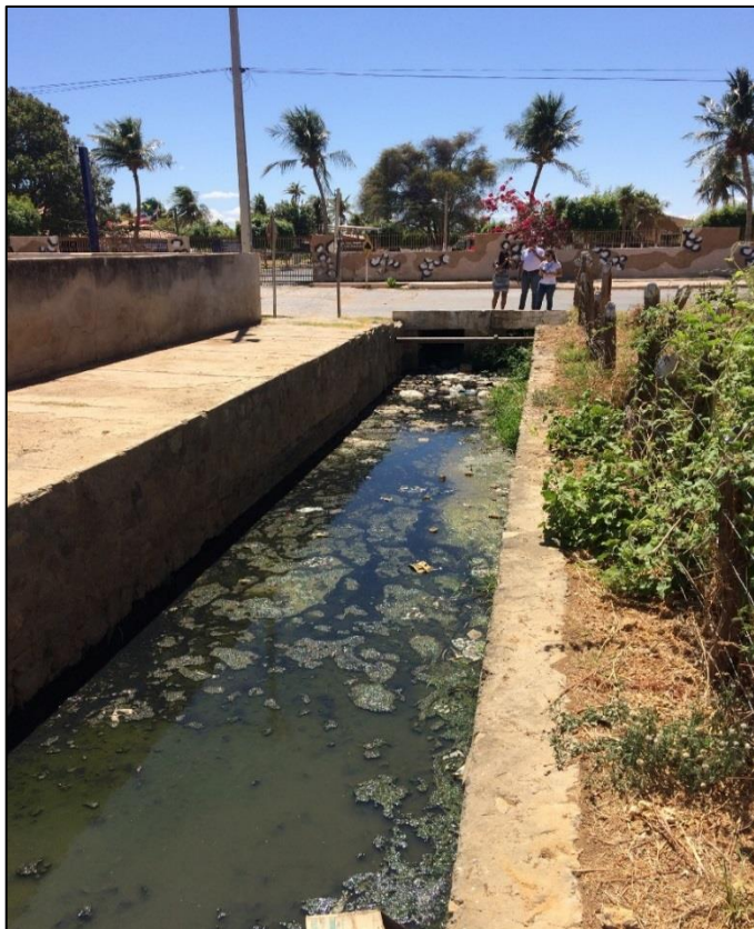
Figura 141 – Utilização dos canais de drenagem para lançamento de esgoto. Fonte: DRZ – Geotecnologia e Consultoria, 2017.
