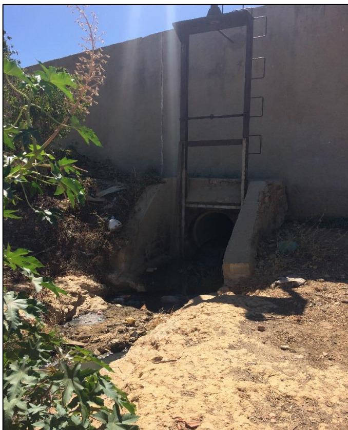
Figura 216 – Comporta instalada junto ao dique, ponto de lançamento de drenagem.
