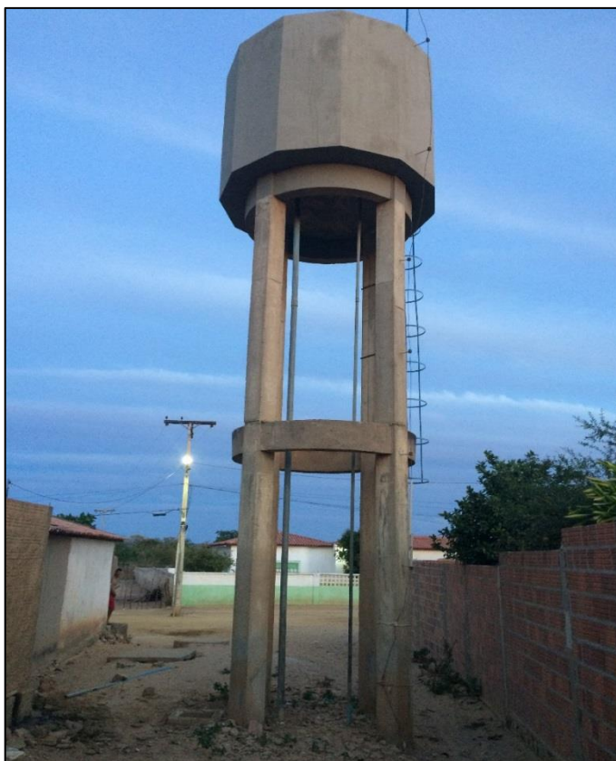
Figura 104 – Reservatório Elevado (REL) de 15 m 3 da comunidade Marreca Velha.
