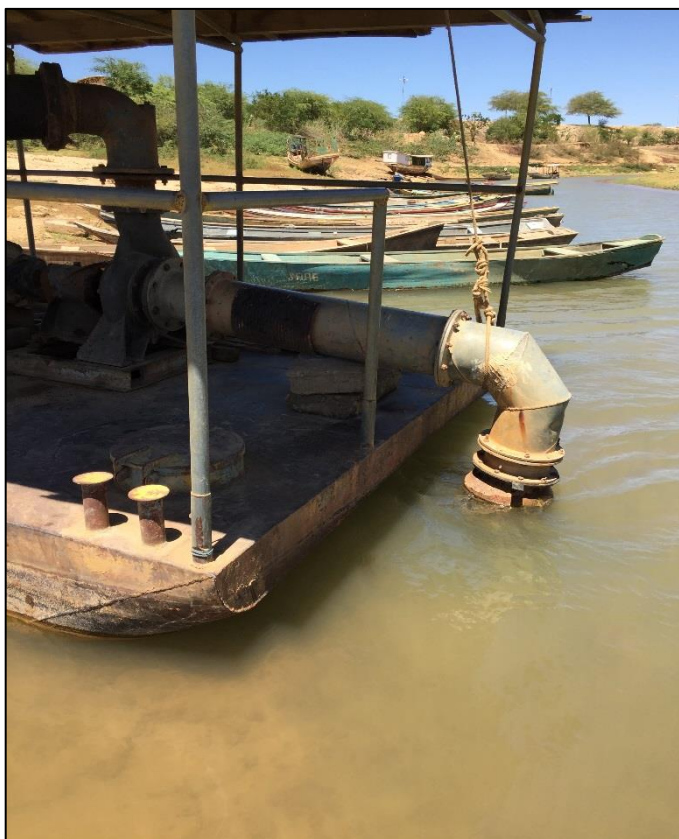
Figura 32 – Captação superficial no rio São Francisco: distrito Sede. Fonte: DRZ – Geotecnologia e Consultoria, 2017.
