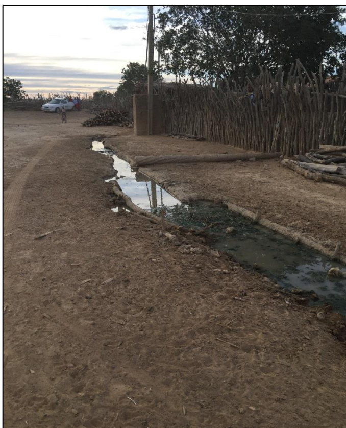
Figura 176 – Lançamento de esgoto em vias públicas: comunidade Vicentes. Fonte: DRZ – Geotecnologia e Consultoria, 2017.
