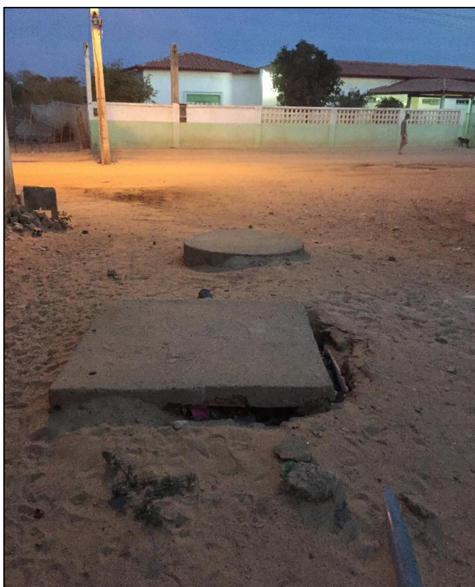
Figura 168 – Fossa rudimentar: comunidade Marreca Velha. Fonte: DRZ – Geotecnologia e Consultoria, 2017.
