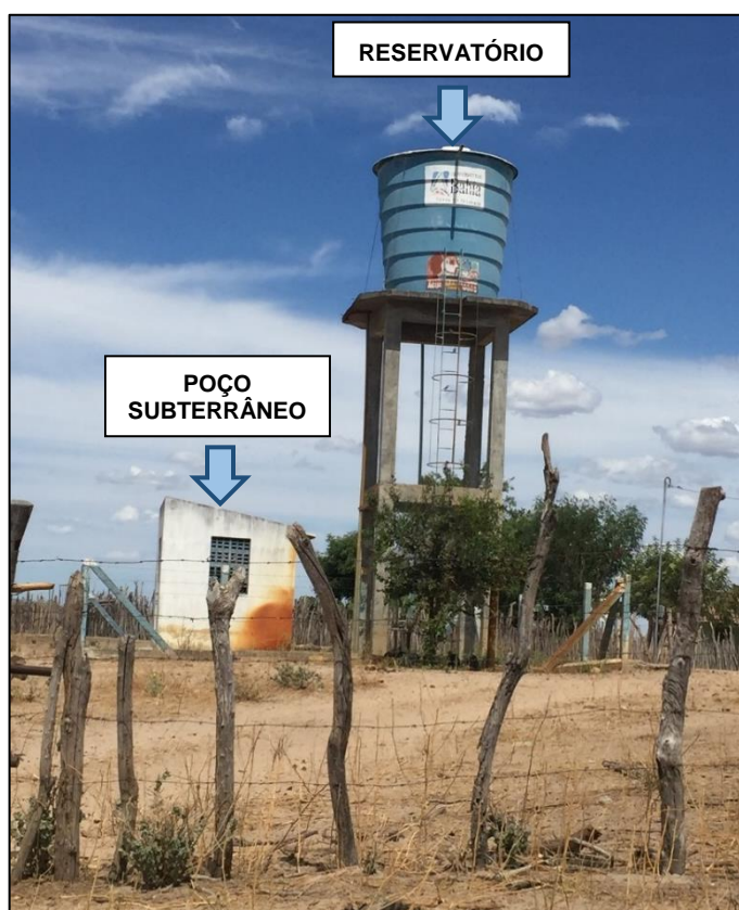
Figura 130 – Poço de captação subterrânea e reservatório: comunidade Paulista.
