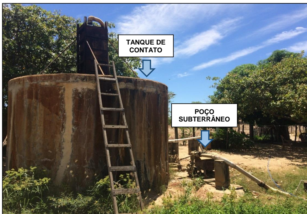
Figura 66 – Captação subterrânea do distrito Copixaba.
