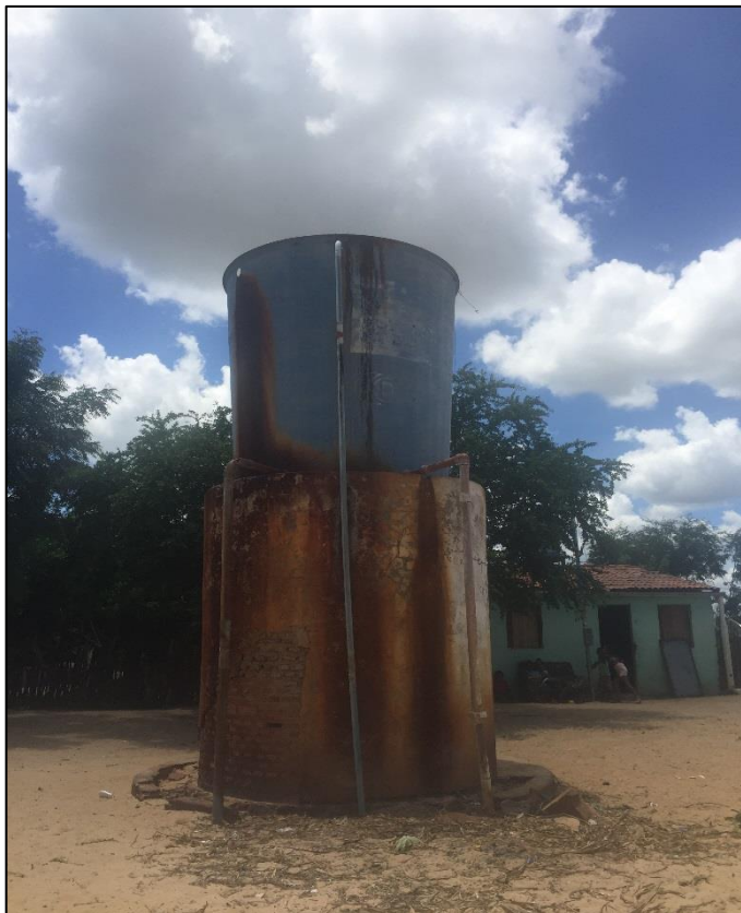
Figura 93 – Reservatório elevado de 10 m 3 da comunidade Capão do Martinho. Fonte: DRZ – Geotecnologia e Consultoria, 2018.
