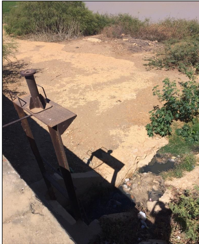
Figura 144 – Comportas de lançamento de drenagem pluvial e de esgoto. Fonte: DRZ – Geotecnologia e Consultoria, 2017.
