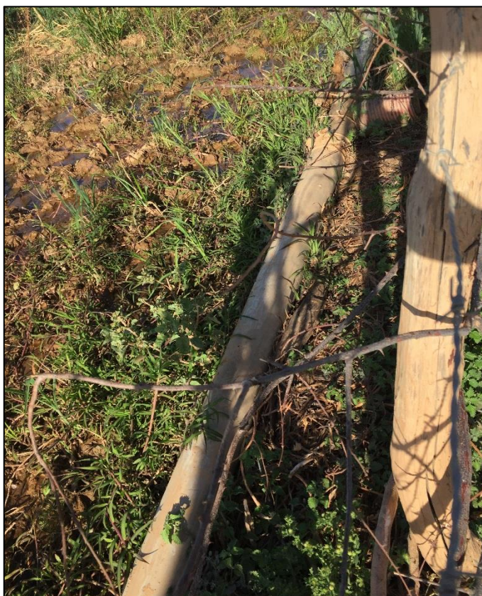
Figura 83 – Adutora de água bruta da comunidade Boa Vista. Fonte: DRZ – Geotecnologia e Consultoria, 2017.
