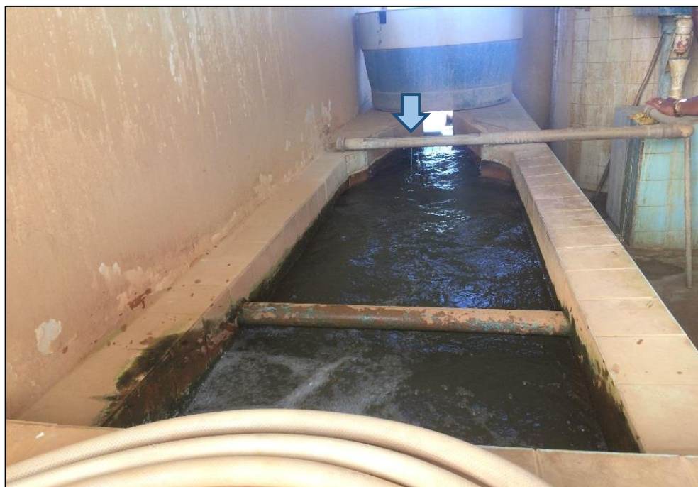
Figura 40 – Calha parshall da ETA do distrito Sede. Fonte: DRZ – Geotecnologia e Consultoria, 2017.
