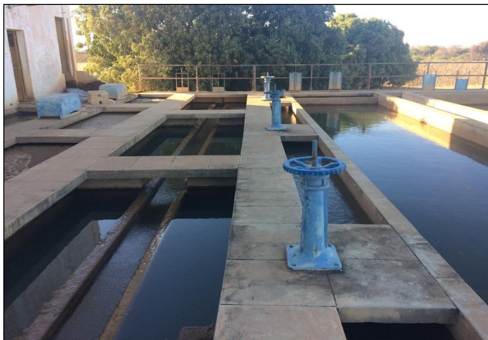
Figura 44 – Decantadores da ETA do distrito Sede. Fonte: DRZ – Geotecnologia e Consultoria, 2017.
