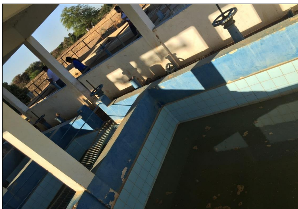
Figura 45 – Filtros da ETA do distrito Sede. Fonte: DRZ – Geotecnologia e Consultoria, 2017.
