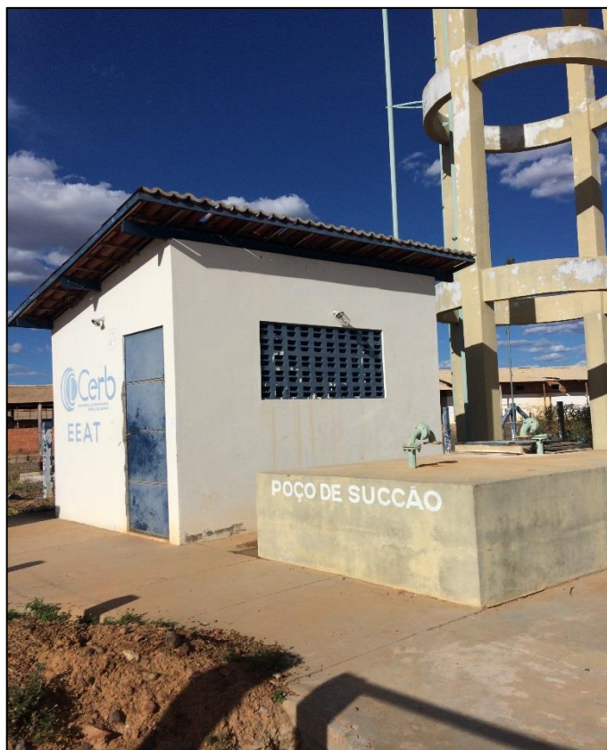
Figura 88 – Poço de sucção e estação elevatória de água tratada da comunidade Boa Vista.
