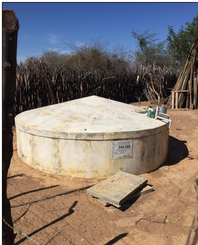
Figura 125 – Cisterna: comunidade Estreito II. Fonte: DRZ – Geotecnologia e Consultoria, 2017.
