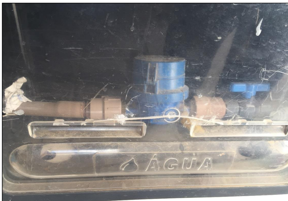
Figura 63 – Exemplos de hidrômetros instalados no distrito Sede. Fonte: DRZ – Geotecnologia e Consultoria, 2017.
