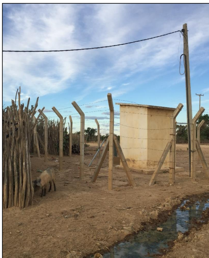
Figura 137 – Poço de captação subterrânea 02: comunidade Vicentes. Fonte: DRZ – Geotecnologia e Consultoria, 2017.
