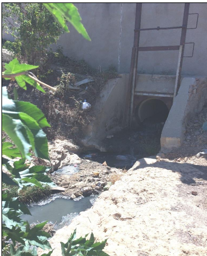
Figura 243 – Ponto de lançamento de drenagem em Xique-Xique. Fonte: DRZ – Geotecnologia e Consultoria, 2017.
