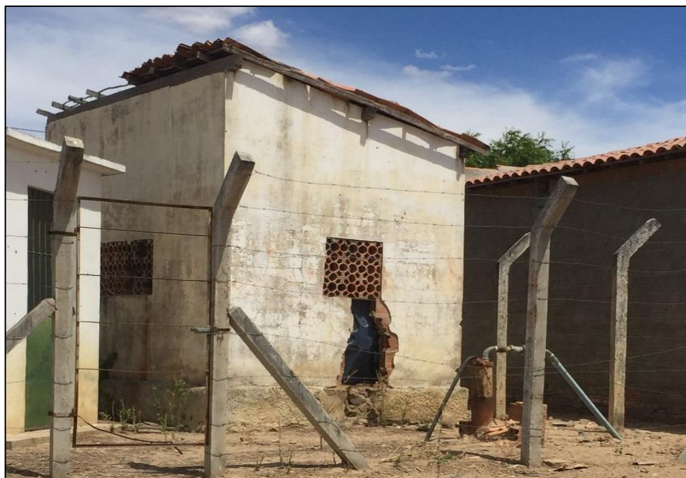
Figura 119 – Poço de captação subterrânea: comunidade Besouro. Fonte: DRZ – Geotecnologia e Consultoria, 2017.
