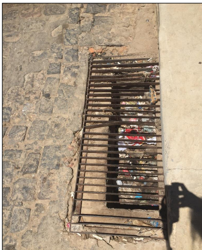
Figura 245 – Estrutura de captação de água pluvial sem manutenção. Fonte: DRZ – Geotecnologia e Consultoria, 2017.
