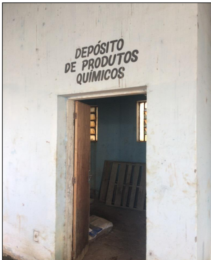
Figura 52 – Depósito de produtos químicos da ETA do distrito Sede. Fonte: DRZ – Geotecnologia e Consultoria, 2017.
