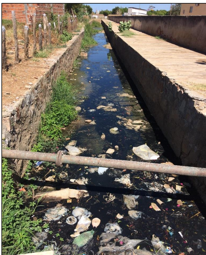
Figura 221 – Canal de drenagem com acúmulo de efluente doméstico. Fonte: DRZ – Geotecnologia e Consultoria, 2017.
