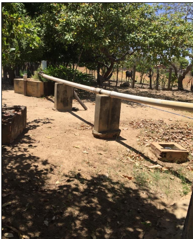
Figura 67 – Adutora de água bruta do distrito Copixaba.
