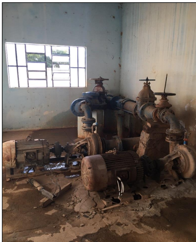
Figura 37 – Estação elevatória de água tratada do distrito Sede. Fonte: DRZ – Geotecnologia e Consultoria, 2017.
