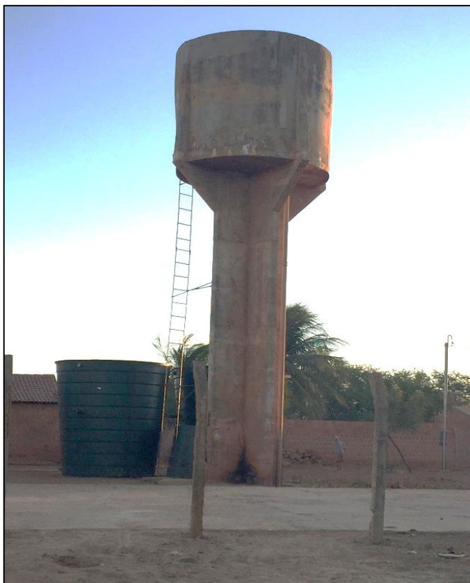
Figura 75 – REL de 25 m 3 do distrito Nova Iguira. Fonte: DRZ – Geotecnologia e Consultoria, 2017.
