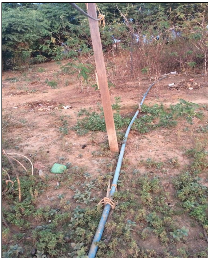
Figura 103 – Adutora de água bruta da comunidade Marreca Velha. Fonte: DRZ – Geotecnologia e Consultoria, 2017.
