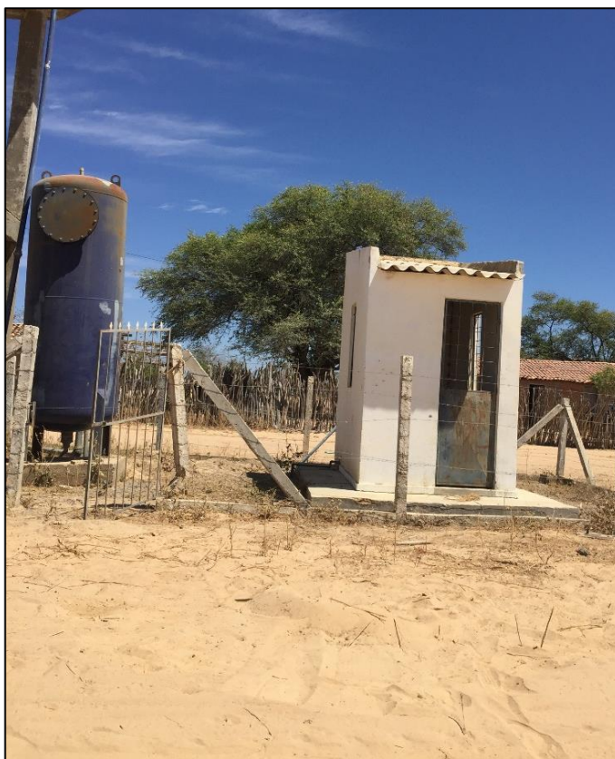
Figura 122 – Poço de captação subterrânea: comunidade Brinco do Soim. Fonte: DRZ – Geotecnologia e Consultoria, 2017.
