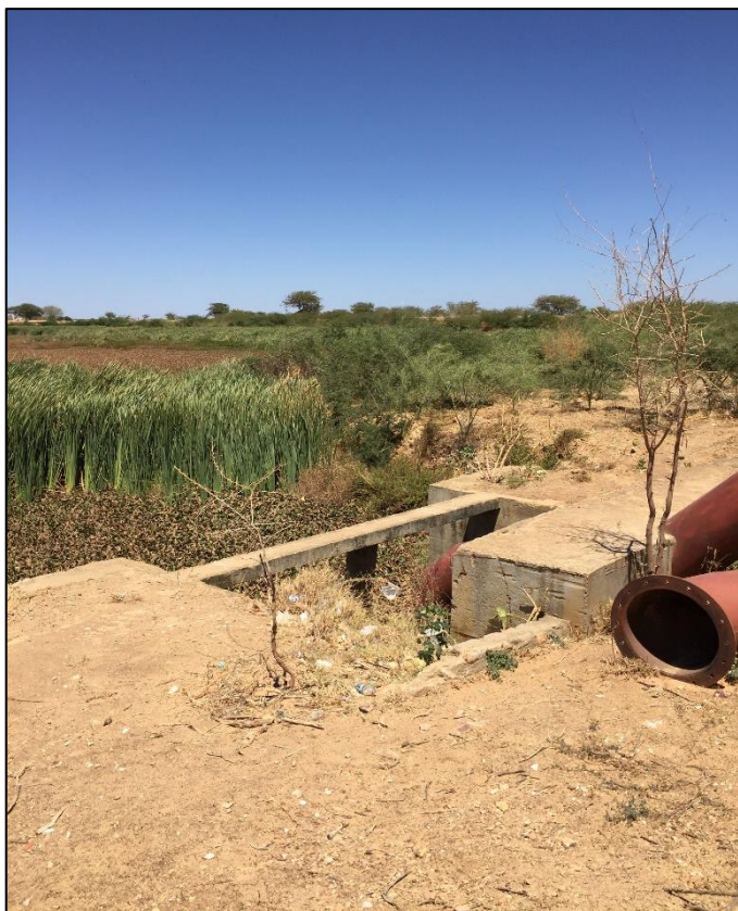
Figura 225 – Recalque da água da lagoa de drenagem pluvial. Fonte: DRZ – Geotecnologia e Consultoria, 2017.
