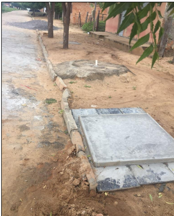
Figura 171 – Fossas rudimentares: comunidade Retiro da Picada. Fonte: DRZ – Geotecnologia e Consultoria, 2018.
