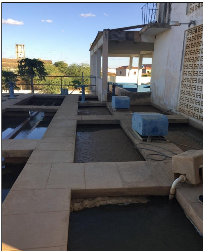
Figura 43 – Floculadores da ETA do distrito Sede. Fonte: DRZ – Geotecnologia e Consultoria, 2017.
