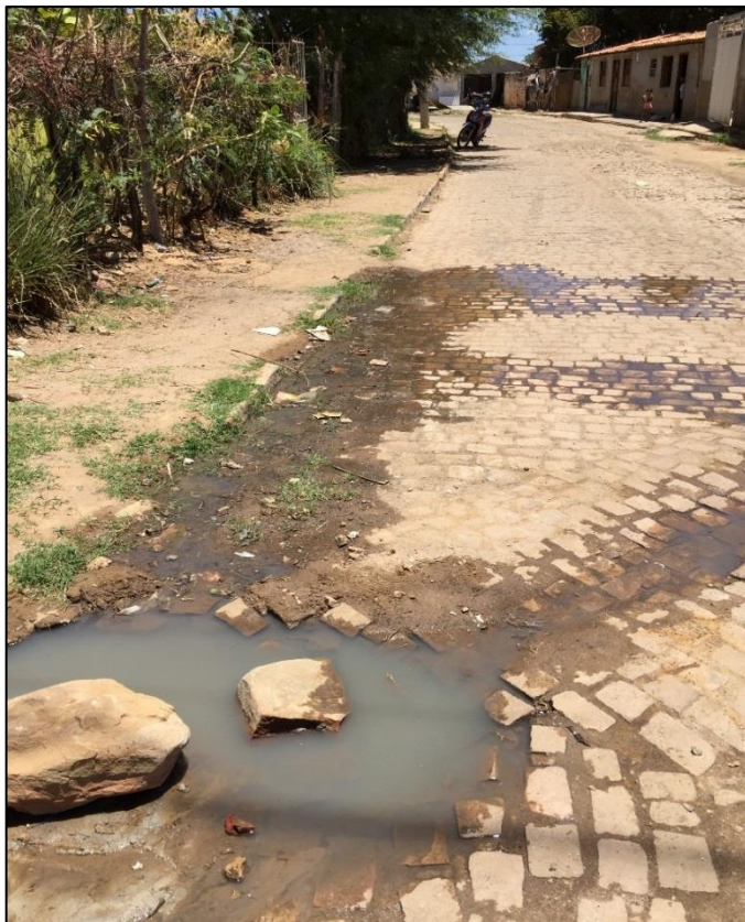
Figura 150 – Lançamento irregular de esgoto diretamente nas vias públicas do distrito Sede.
