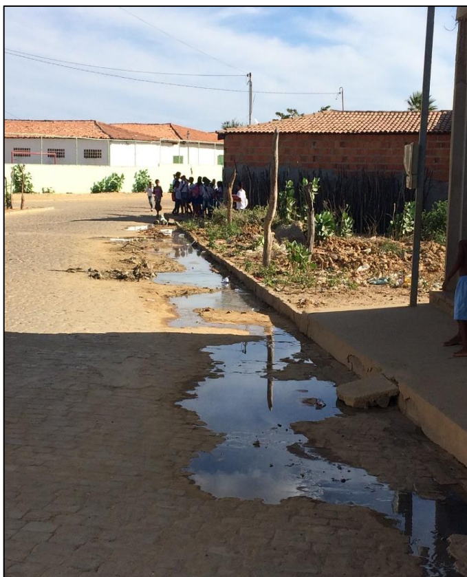
Figura 166 – Lançamento de esgoto em via pública: comunidade Boa Vista. Fonte: DRZ – Geotecnologia e Consultoria, 2017.
