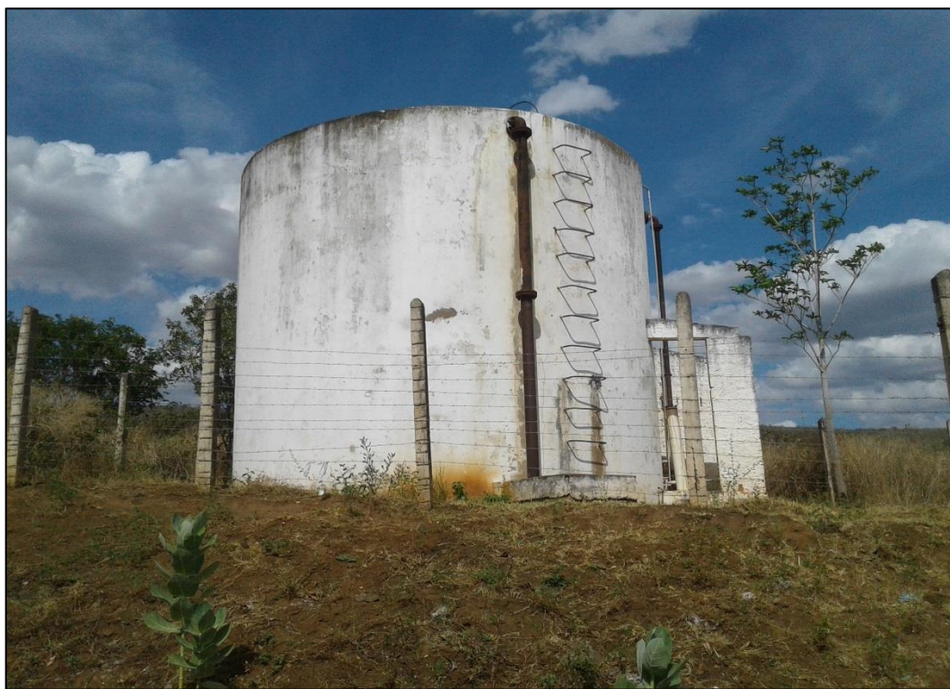
Figura 63 – RAP 50 m 3 do distrito de Entremontes.
