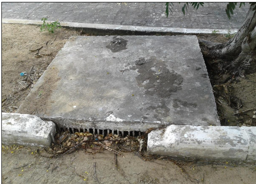
Figura 134 – Estrutura de captação de água da chuva. Fonte: DRZ – Geotecnologia e Consultoria, 2017.
