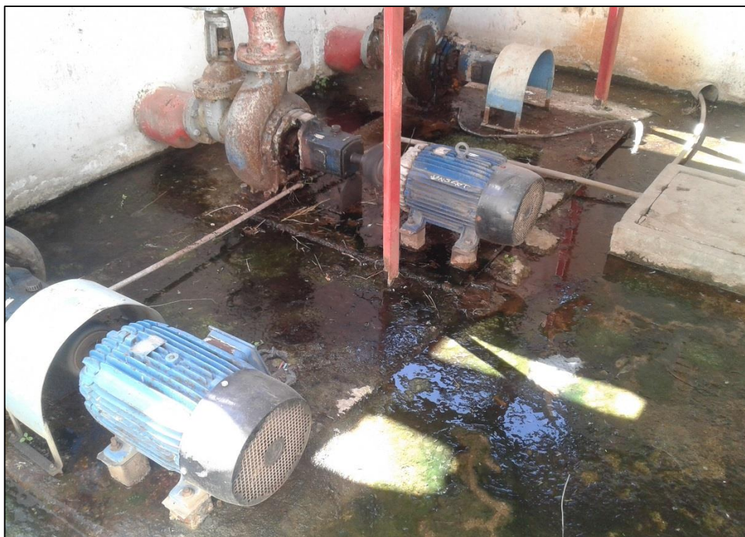
Figura 53 – Bombas da Estação Elevatória de Água Bruta. Fonte: DRZ – Geotecnologia e Consultoria, 2017.
