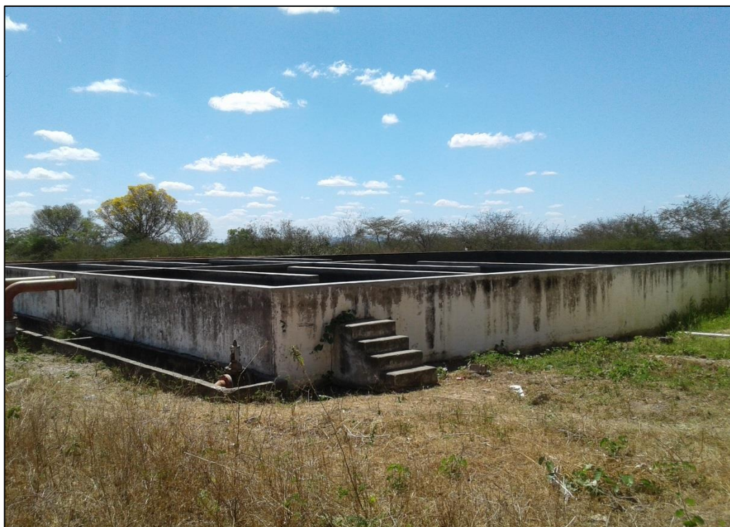
Figura 45 – Floco-decantador da ETA. Fonte: DRZ – Geotecnologia e Consultoria, 2017.
