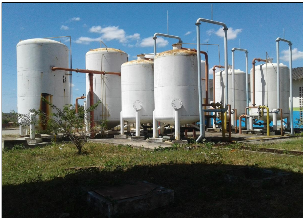
Figura 46 – Pressurização da ETA: filtração e desinfecção. Fonte: DRZ – Geotecnologia e Consultoria, 2017.
