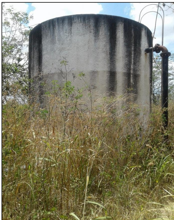
Figura 76 – RAP cilíndrico de concreto de 30 m 3 da comunidade de Lagoa Nova.
