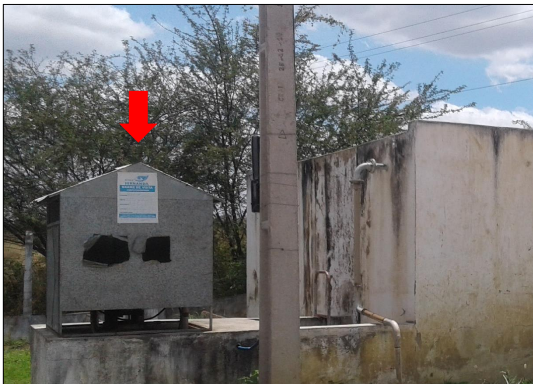
Figura 73 – EEAT do Assentamento Margarida Alves e Antônio Conselheiro. Fonte: DRZ – Geotecnologia e Consultoria, 2017.
