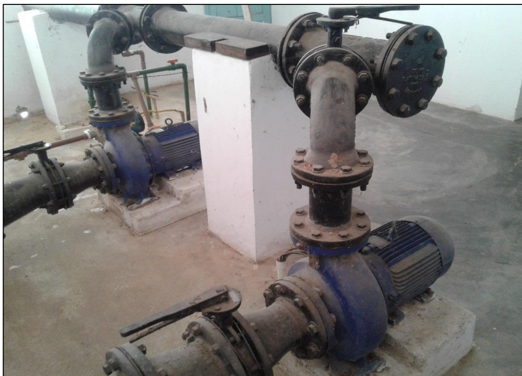
Figura 70 – Estação Elevatória de Água Tratada da ETA ODC. Fonte: DRZ – Geotecnologia e Consultoria, 2017.
