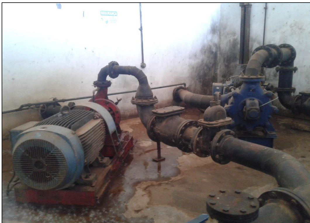
Figura 39 – Bombas da captação superficial no rio São Francisco. Fonte: DRZ – Geotecnologia e Consultoria, 2017.
