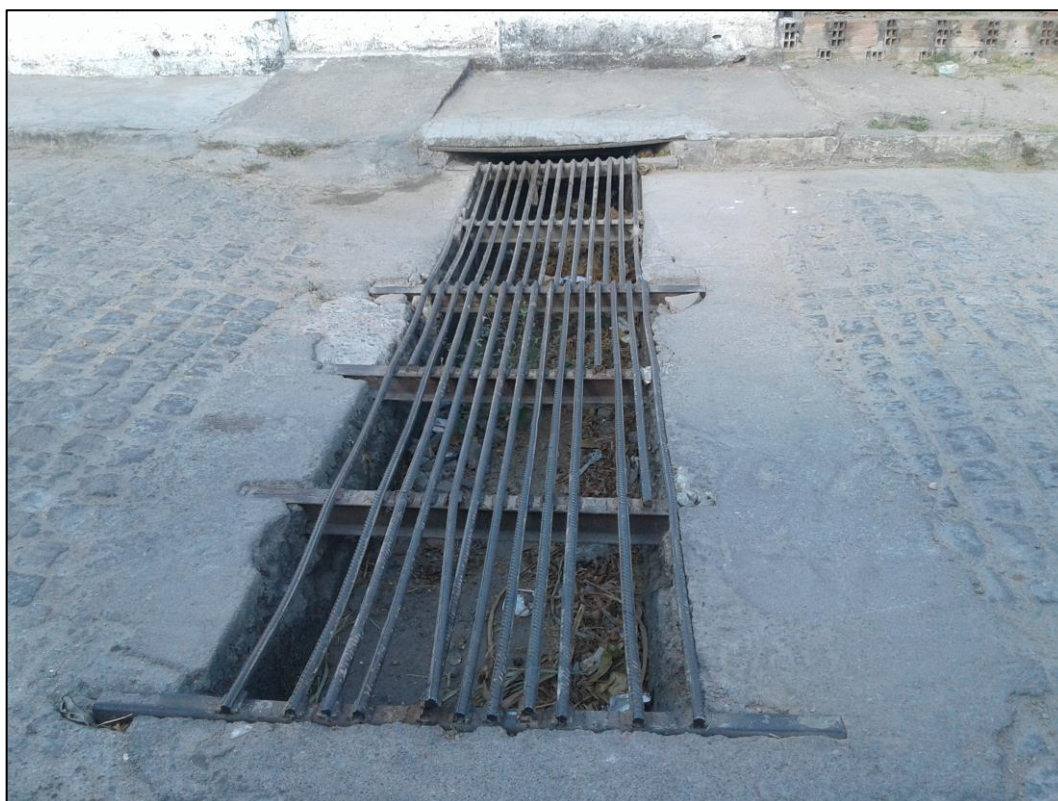
Figura 149 – Estrutura de captação de água pluvial sem manutenção. Fonte: DRZ – Geotecnologia e Consultoria, 2017.
