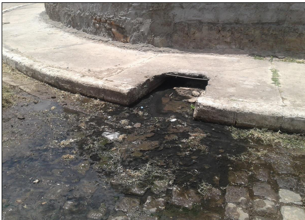
Figura 148 – Dispositivo para captar água de chuva no Bairro Nossa Senhora da Saúde com esgotamento sanitário.
