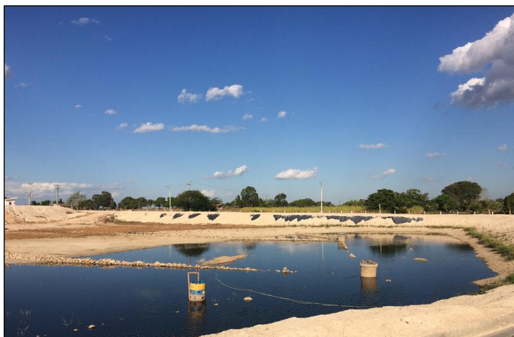
Figura 114 – Drenos de gás em local com acúmulo de água da chuva. Fonte: DRZ – Geotecnologia e Consultoria, 2017.
