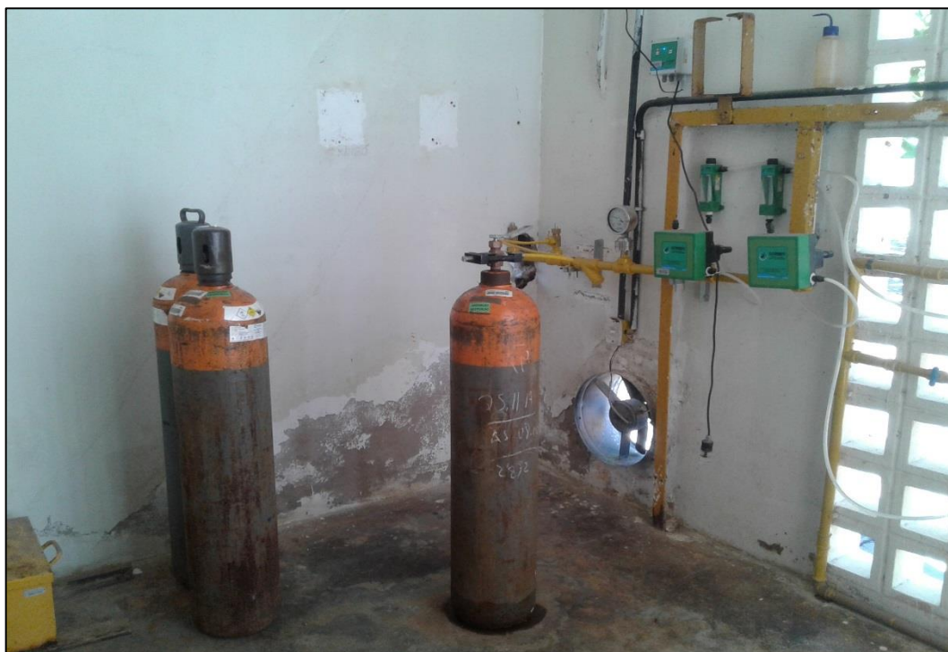
Figura 47 – Dosador de cloro gasoso. Fonte: DRZ – Geotecnologia e Consultoria, 2017.
