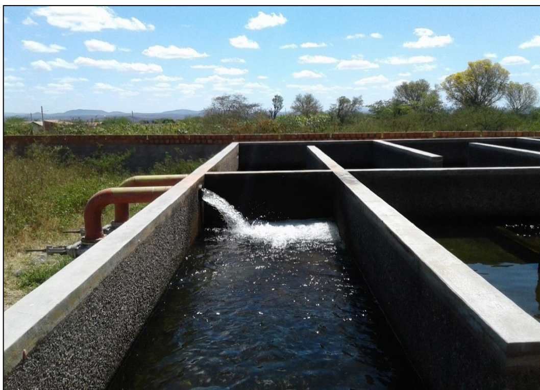
Figura 44 – Chegada da água na ETA da Sede. Fonte: DRZ – Geotecnologia e Consultoria, 2017.
