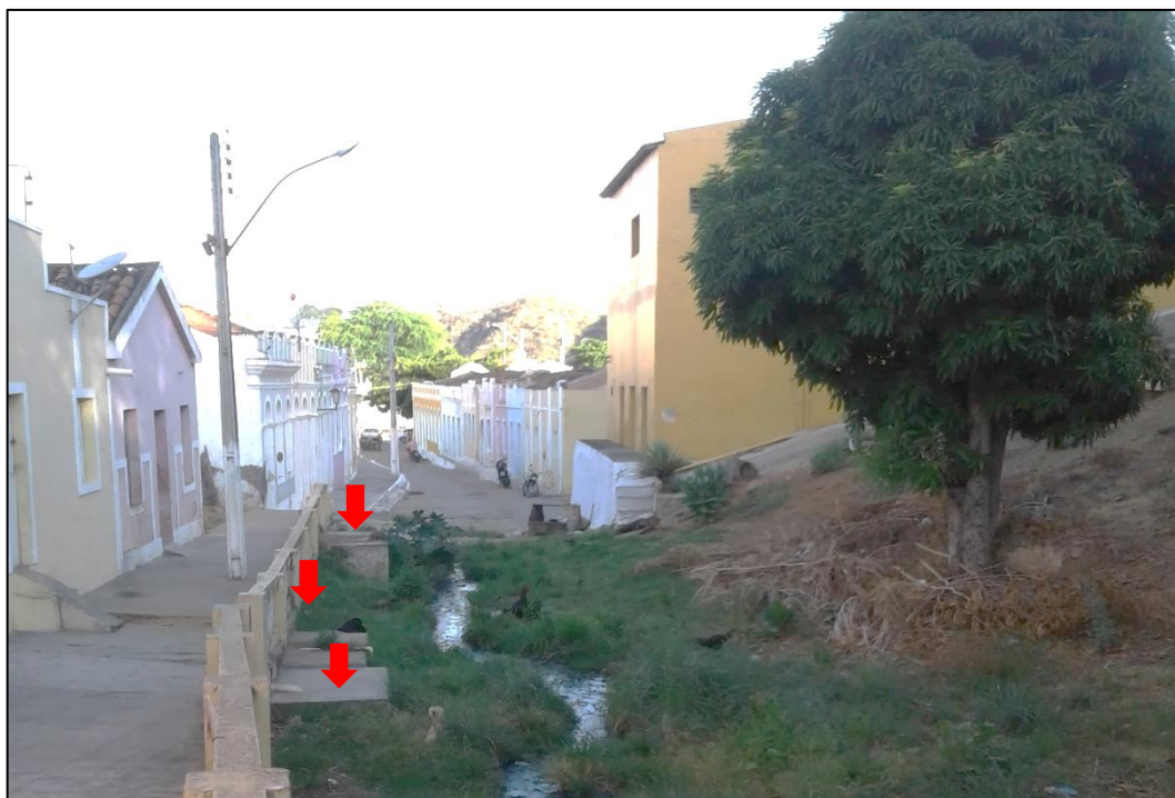
Figura 91 – Fossas individuais instaladas no leito do afluente do rio São Francisco.
