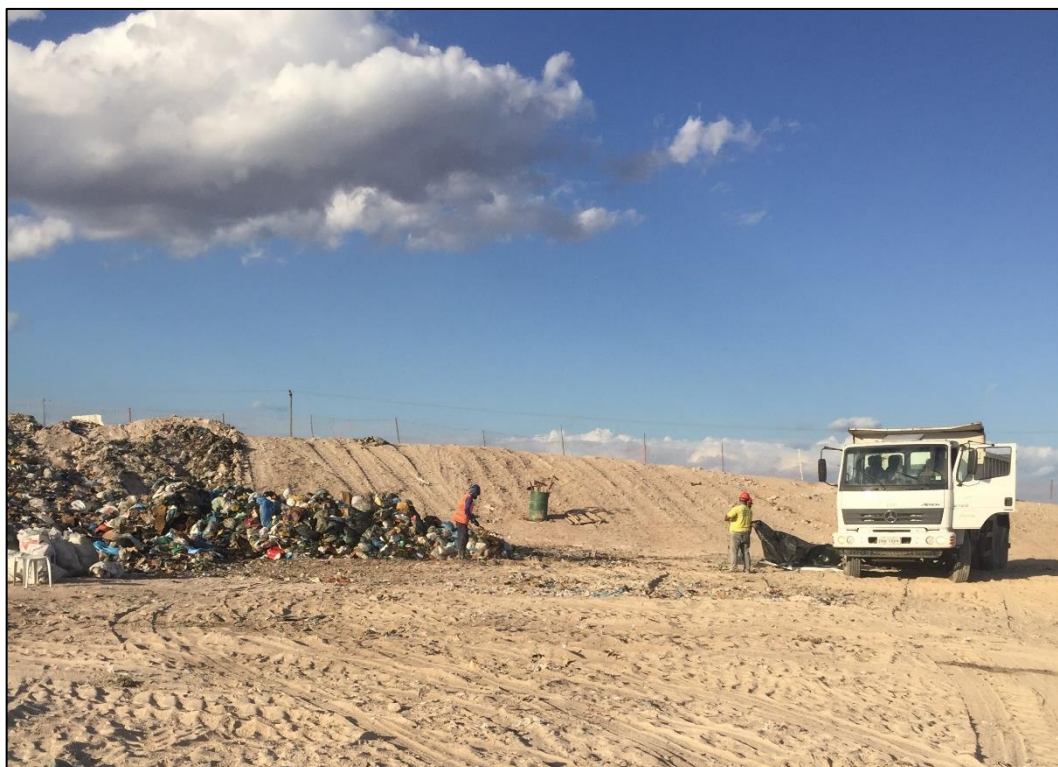
Figura 113 - Célula em operação. Fonte: DRZ – Geotecnologia e Consultoria, 2017.
