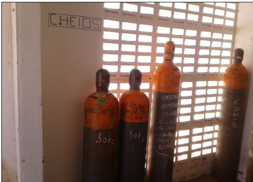
Figura 68 – Cilindros de cloro gasoso. Fonte: DRZ – Geotecnologia e Consultoria, 2017.
