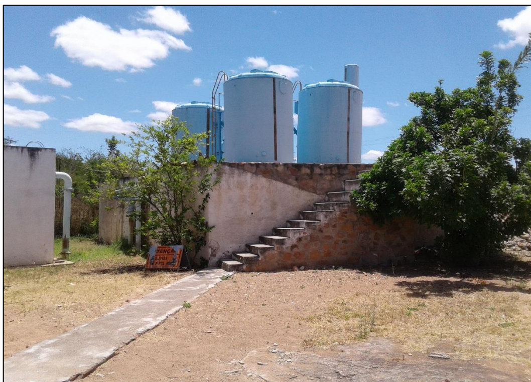
Figura 67 – Filtros e adição de cloro na ETA ODC. Fonte: DRZ – Geotecnologia e Consultoria, 2017.
