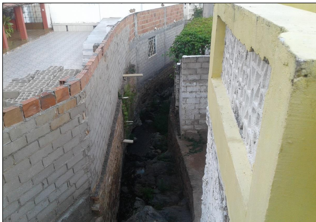
Figura 92 – Ligações de esgoto lançando esgoto diretamente no afluente do rio São Francisco.
