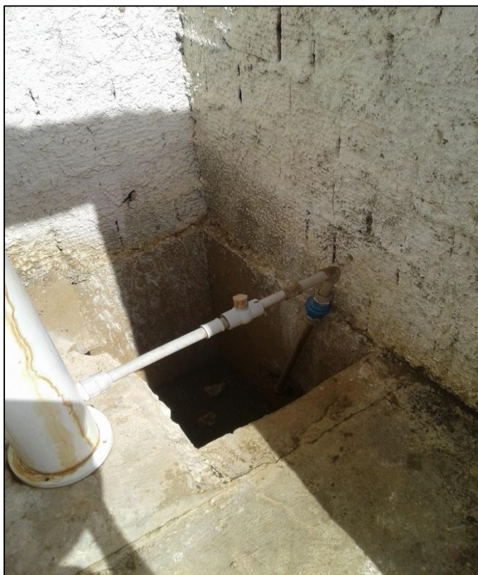
Figura 62 – Dosador de cloro do distrito de Entremontes. Fonte: DRZ – Geotecnologia e Consultoria, 2017
