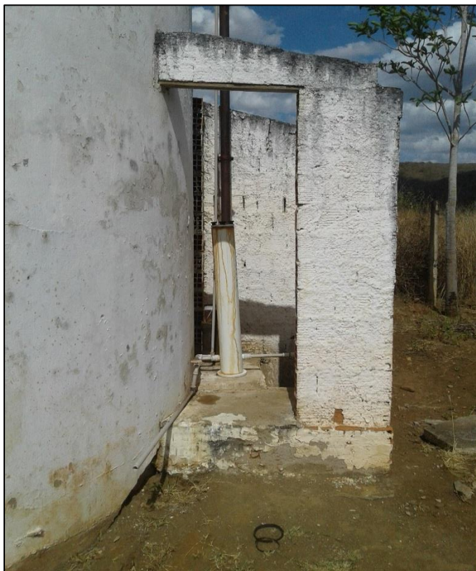
Figura 61 – Sistema de tratamento da água do distrito de Entremontes. Fonte: DRZ – Geotecnologia e Consultoria, 2017.
