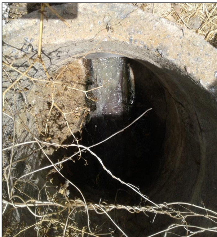
Figura 139 – Lançamento de esgoto na rede de drenagem.
