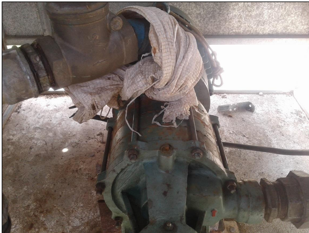
Figura 74 – Reparo improvisado por moradores para conter o vazamento. Fonte: DRZ – Geotecnologia e Consultoria, 2017.
