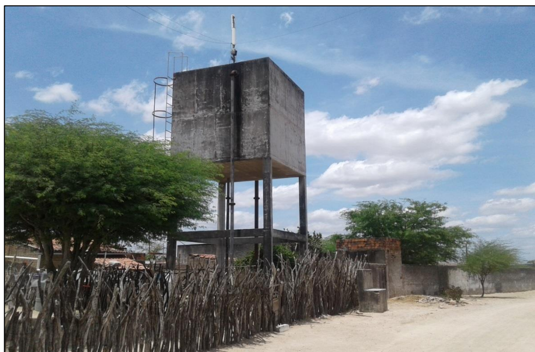
Figura 78 – REL de concreto de 30 m 3 da comunidade de Lagoa Nova.
