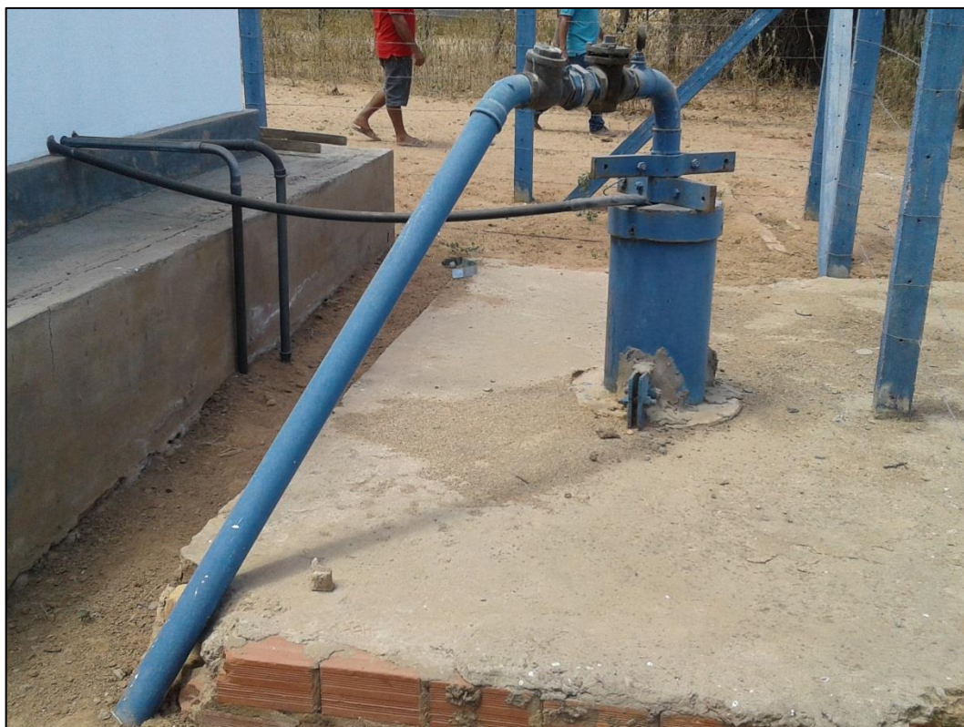
Figura 87 – Poço 1 - Comunidade Várzea. Fonte: DRZ – Geotecnologia e Consultoria, 2017.
