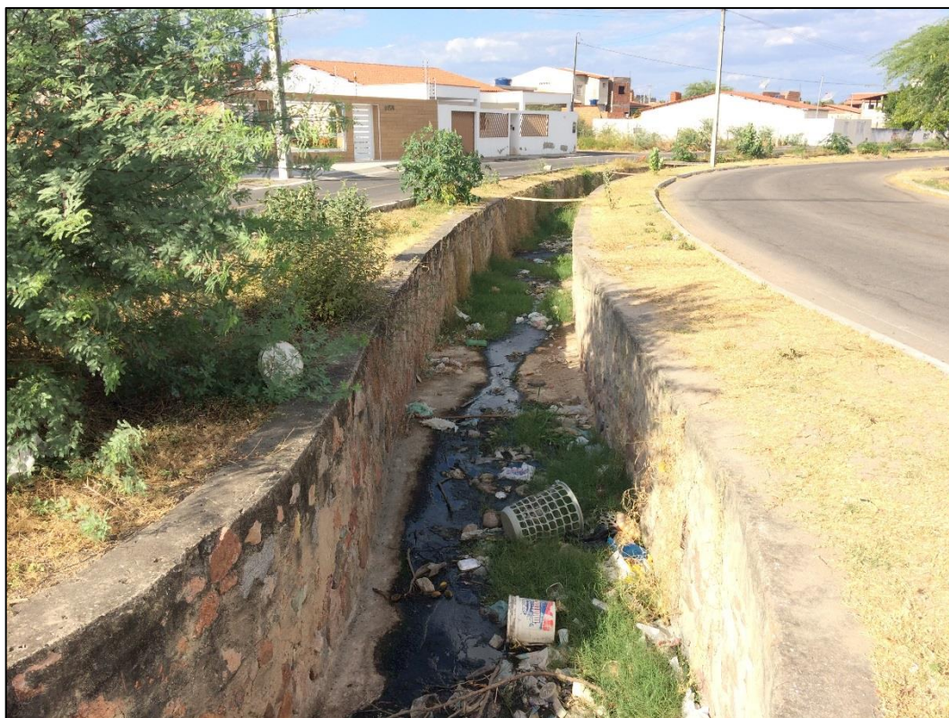
Figura 175 – Sarjeta de drenagem com ligações clandestinas de esgoto - Bairro Moxotó.
