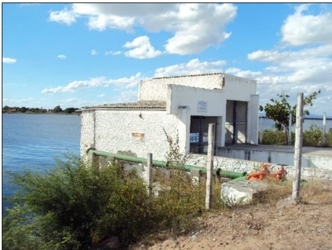
Figura 31 – Captação superficial no rio São Francisco - Sistema Centro. Fonte: DRZ – Geotecnologia e Consultoria, 2017.
