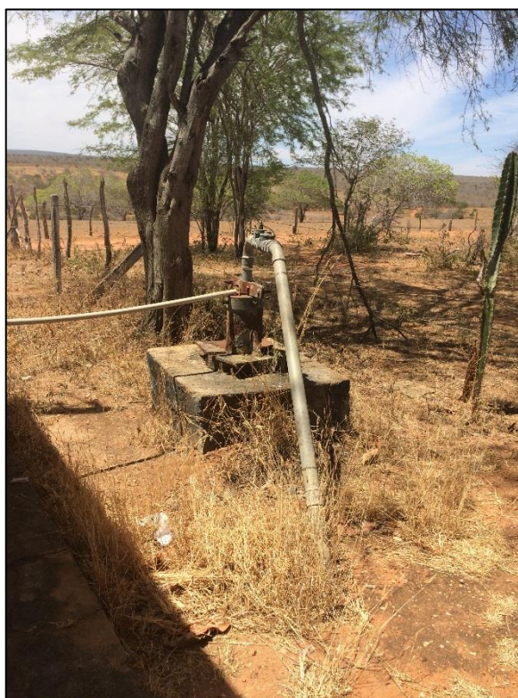
Figura 74 – Poço 2 - Comunidade São José. Fonte: DRZ – Geotecnologia e Consultoria, 2017.
