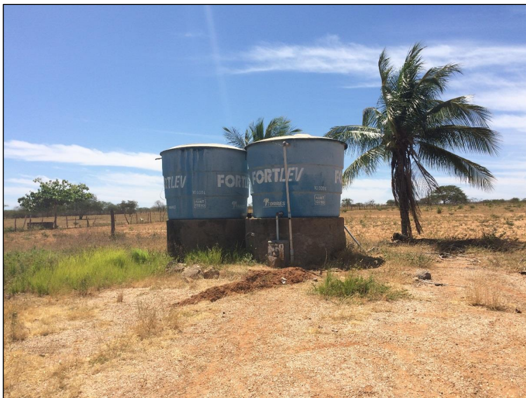
Figura 75 – Reservatórios (10 m 3 cada) - Comunidade São José. Fonte: DRZ – Geotecnologia e Consultoria, 2017.
