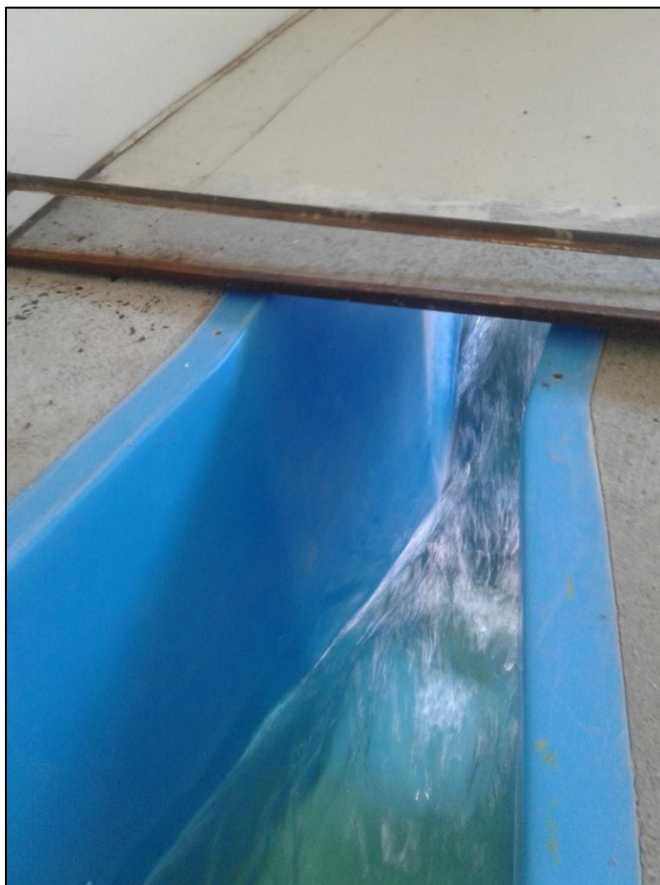
Figura 45 – Calha Parshall - ETA BTN. Fonte: DRZ – Geotecnologia e Consultoria, 2017.
