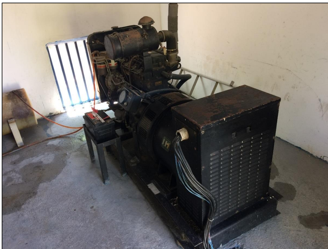
Figura 101 – Gerador de energia da EEE II. Fonte: DRZ – Geotecnologia e Consultoria, 2017.
