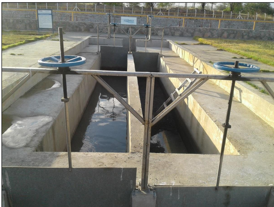
Figura 116 – Caixa de areia - ETE BTN. Fonte: DRZ – Geotecnologia e Consultoria, 2017.
