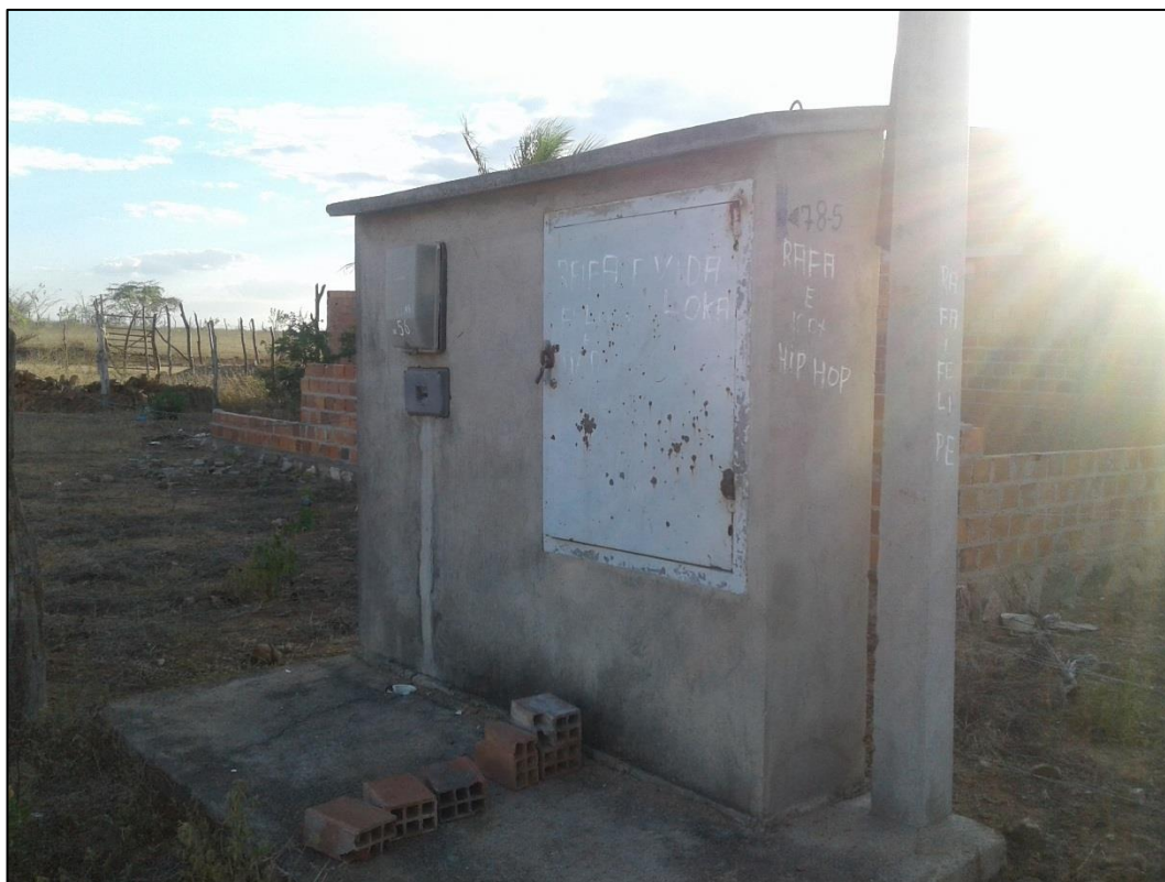
Figura 37 – Quadro elétrico do Booster. Fonte: DRZ – Geotecnologia e Consultoria, 2017.
