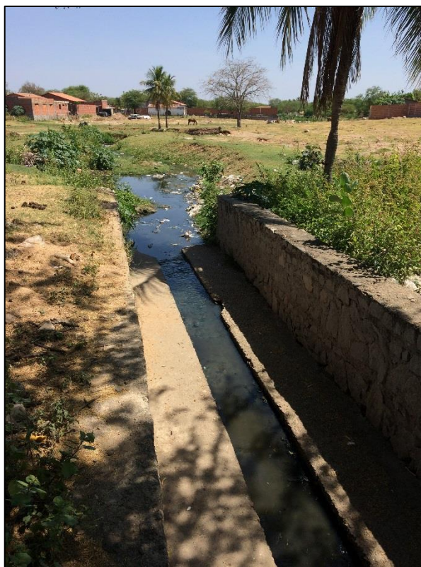
Figura 177 – Emissário de sarjeta de drenagem escoando efluente de esgoto doméstico - BTN II.
