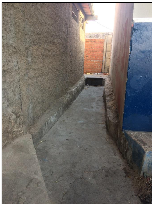
Figura 189 – Área em cota altimétrica menor com rede de drenagem insuficiente - Local 5.
