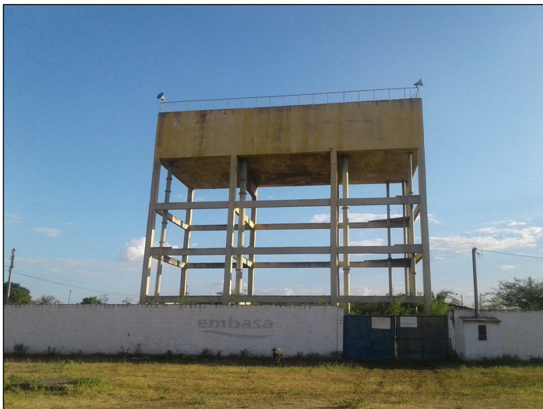
Figura 61 – REL 4 – 500 m 3 - BTN. Fonte: DRZ – Geotecnologia e Consultoria, 2017.
