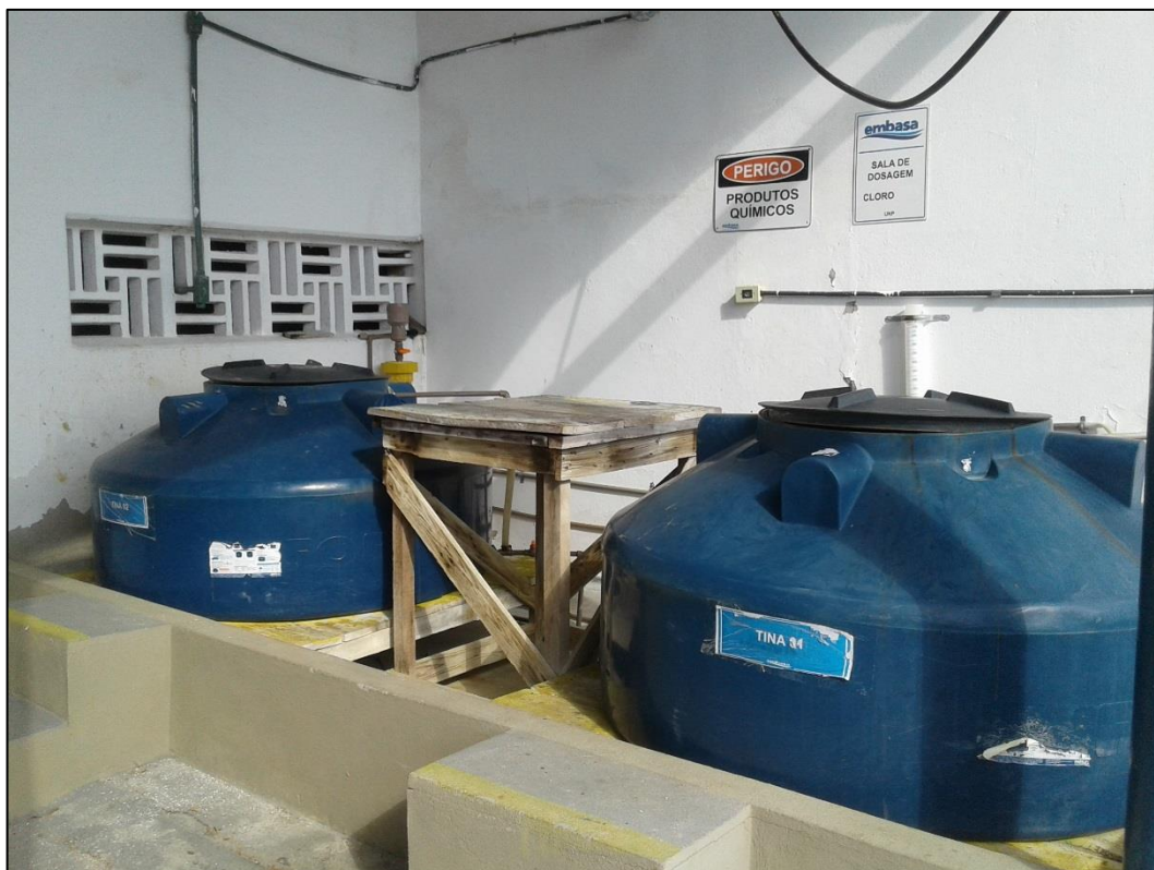
Figura 52 – Misturador de cloro. Fonte: DRZ – Geotecnologia e Consultoria, 2017.
