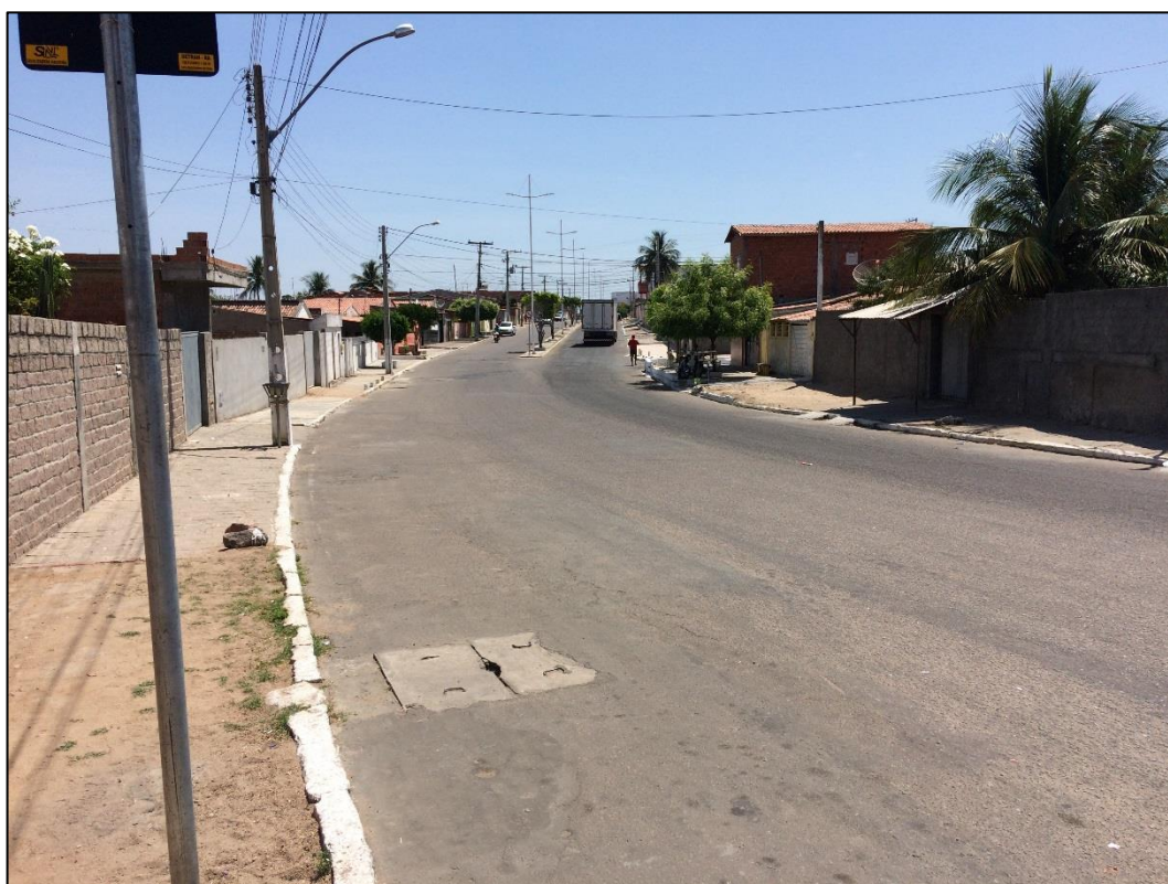
Figura 200 – Ponto com histórico de alagamento devido a insuficiência da rede de drenagem - Local 3. Fonte: DRZ – Geotecnologia e Consultoria, 2017.
