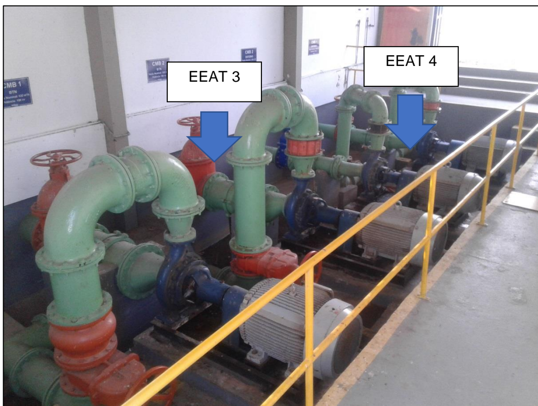
Figura 35 – EEAT 3 e 4. Fonte: DRZ – Geotecnologia e Consultoria, 2017.
