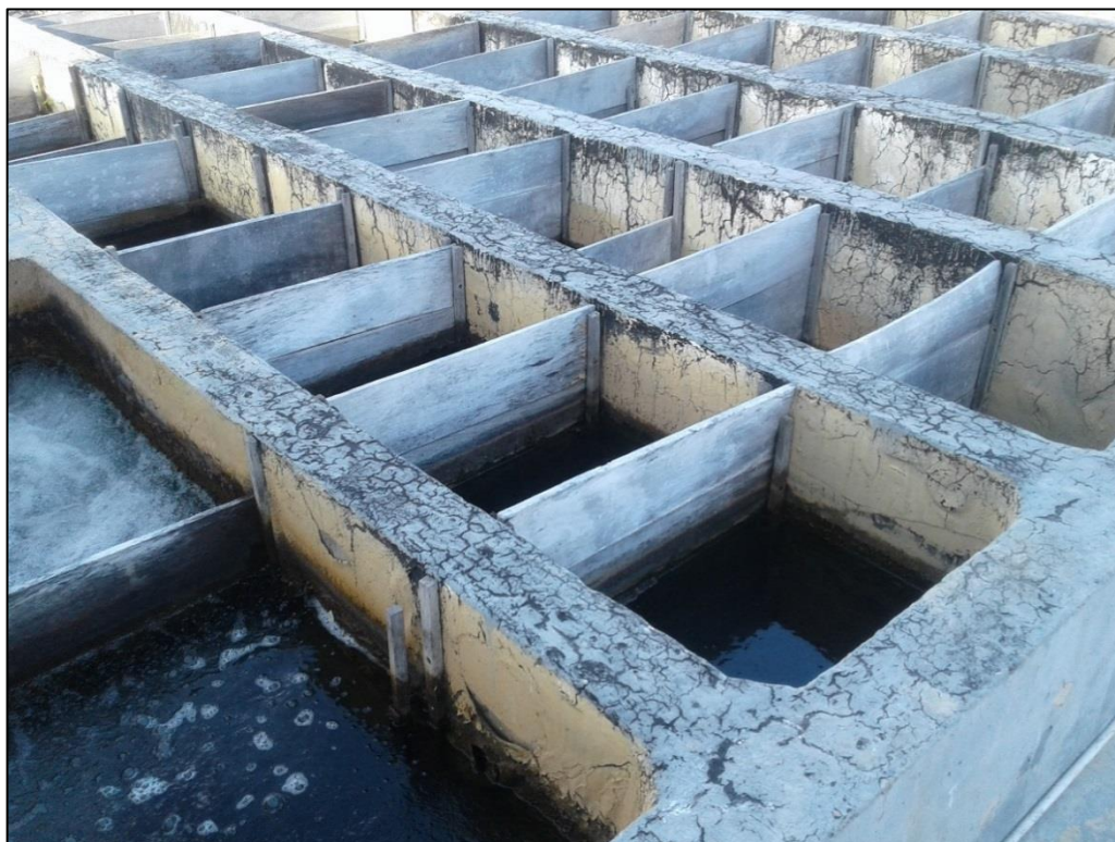
Figura 46 – Flocculadores - Sistema BTN. Fonte: DRZ – Geotecnologia e Consultoria, 2017.
