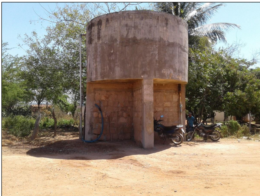
Figura 82 – REL 2 - 50m 3 - Comunidade Juá Fonte: DRZ – Geotecnia e Consultoria, 2017
