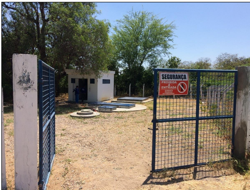
Figura 100 – EEE II. Fonte: DRZ – Geotecnologia e Consultoria, 2017.
