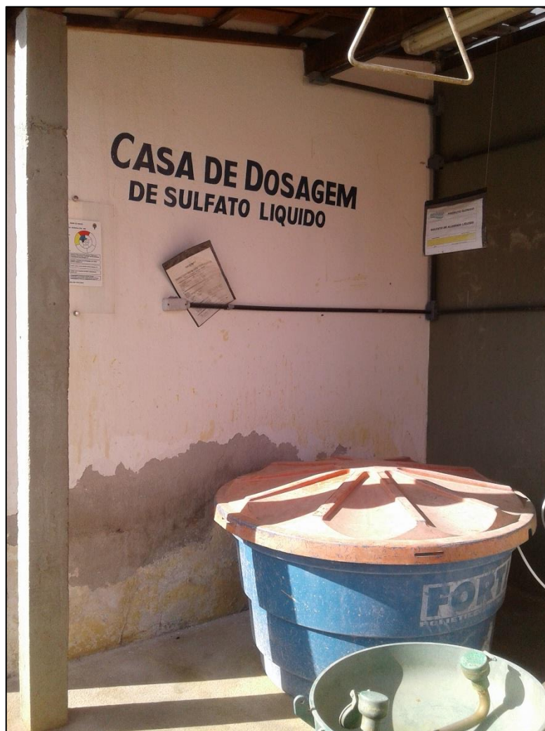
Figura 51 – Misturador de sulfato. Fonte: DRZ – Geotecnologia e Consultoria, 2017.
