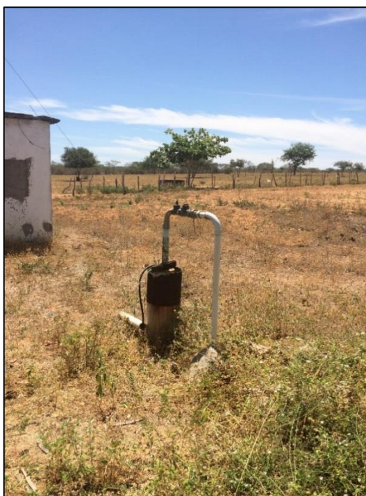
Figura 73 – Poço 1 - Comunidade São José. Fonte: DRZ – Geotecnologia e Consultoria, 2017.
