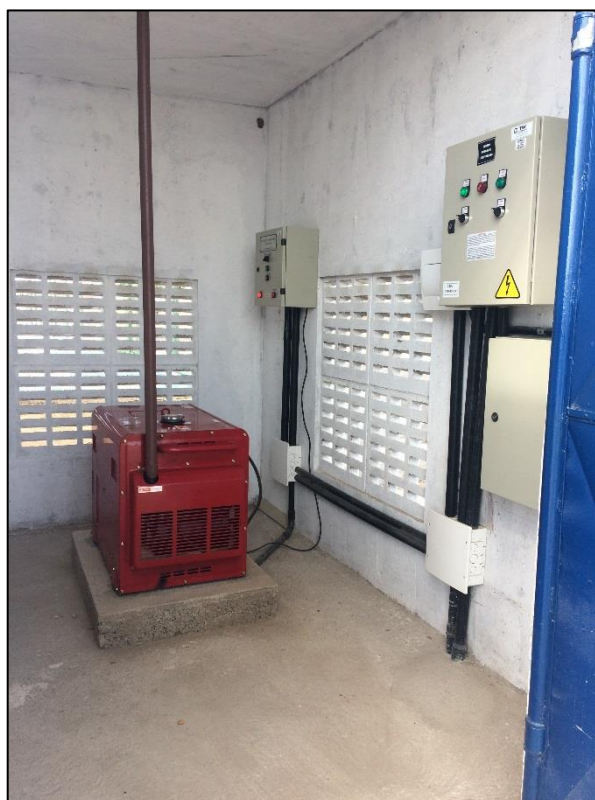
Figura 115 – Gerador de energia da EEE Dom Mário. Fonte: DRZ – Geotecnologia e Consultoria, 2017.
