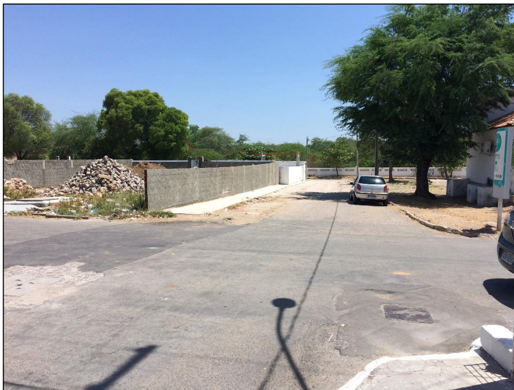
Figura 185 - Ponto em cota altimétrica menor com histórico de acúmulo de água pluvial - Local 1.
