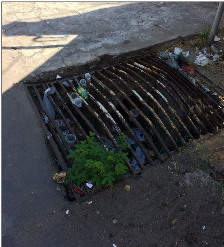
Figura 174 – Estrutura de captação do tipo grelha. Fonte: DRZ – Geotecnologia e Consultoria, 2017.
