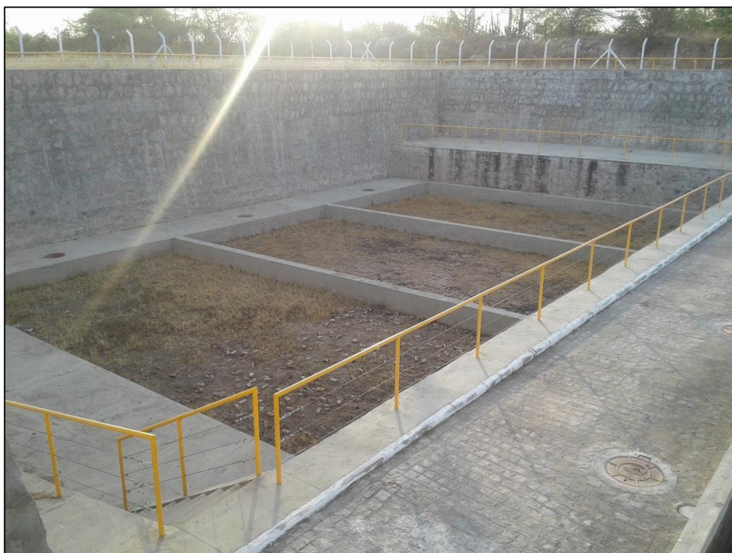
Figura 120 – Área dos leitos de secagem - ETE BTN. Fonte: DRZ – Geotecnologia e Consultoria, 2017.
