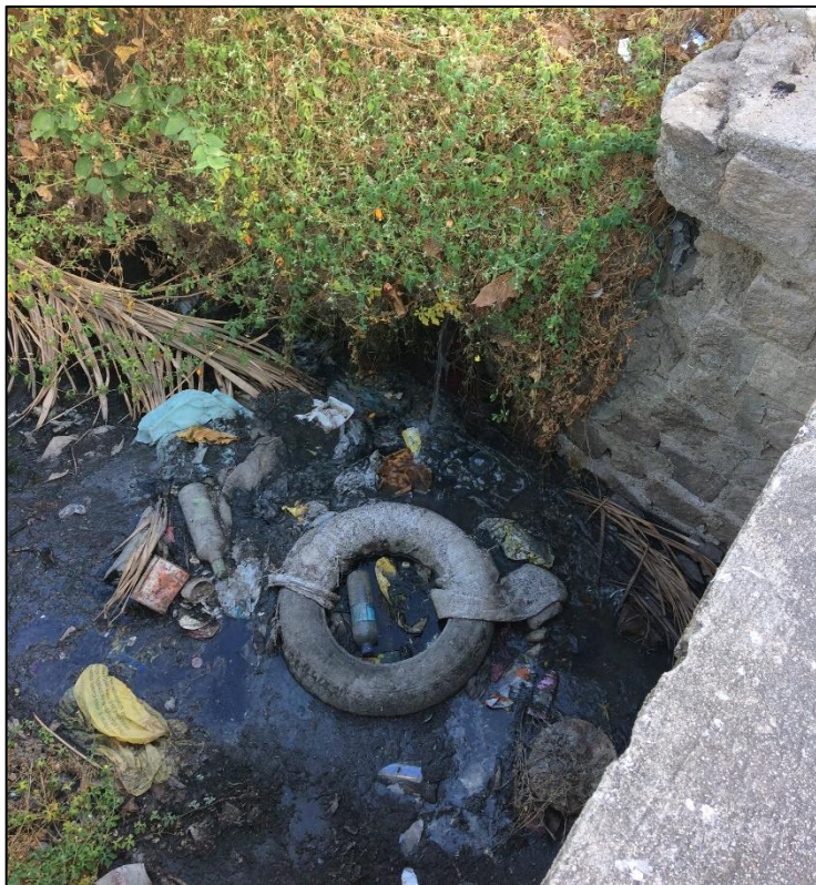
Figura 203 – Sarjeta de drenagem sem manutenção - Bairro Moxotó. Fonte: DRZ – Geotecnologia e Consultoria, 2017.
