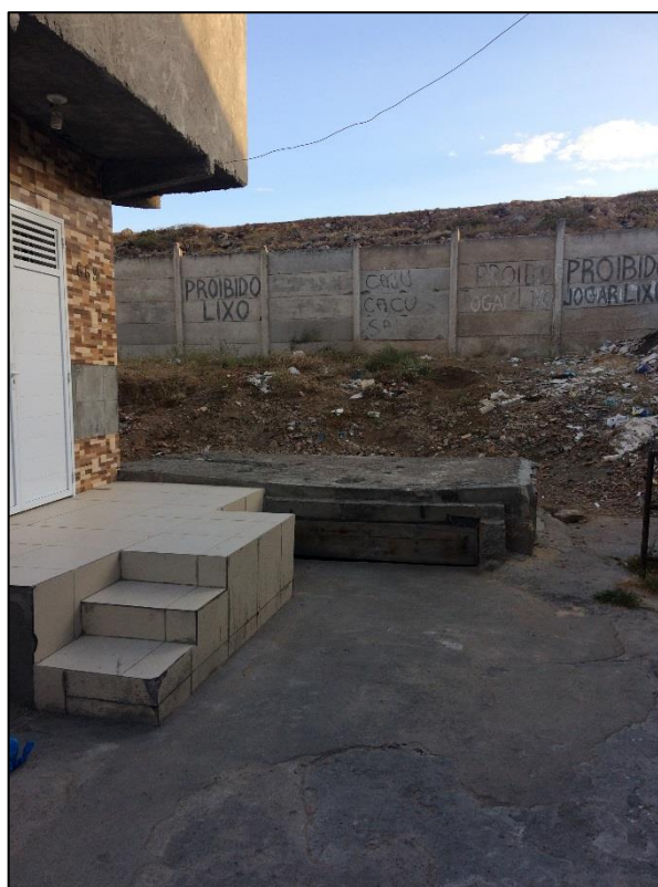
Figura 187 – Ponto em cota altimétrica menor com histórico de extravasamento na rede de drenagem - Local 3.
