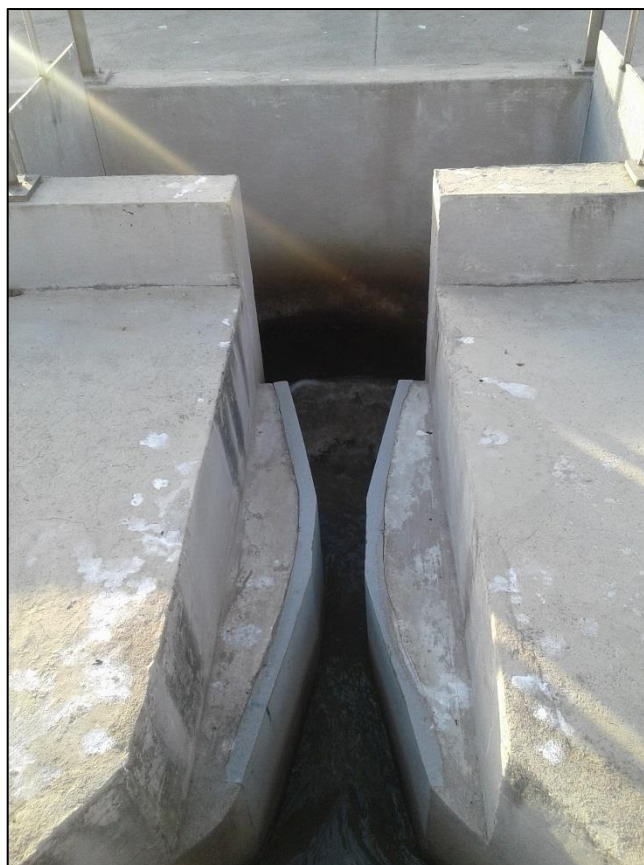
Figura 118 – Calha Parshall - ETE BTN. Fonte: DRZ – Geotecnologia e Consultoria, 2017.
