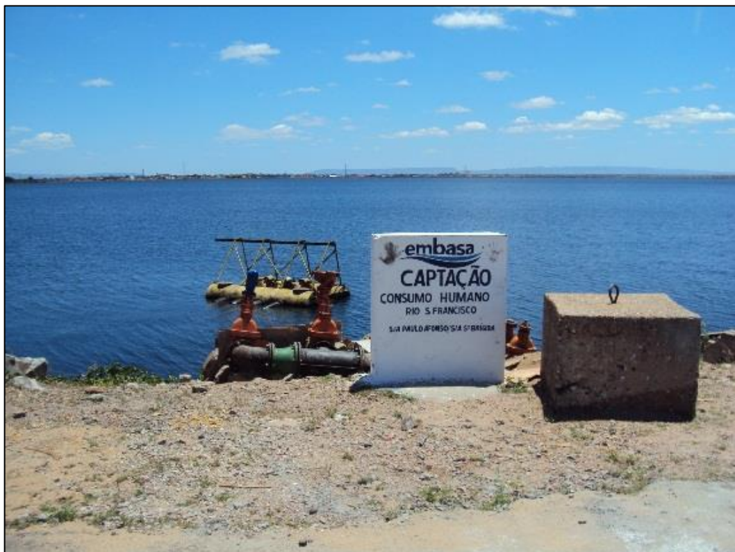
Figura 32 – Captação superficial no rio São Francisco - Sistema BTN. Fonte: DRZ – Geotecnologia e Consultoria, 2017.
