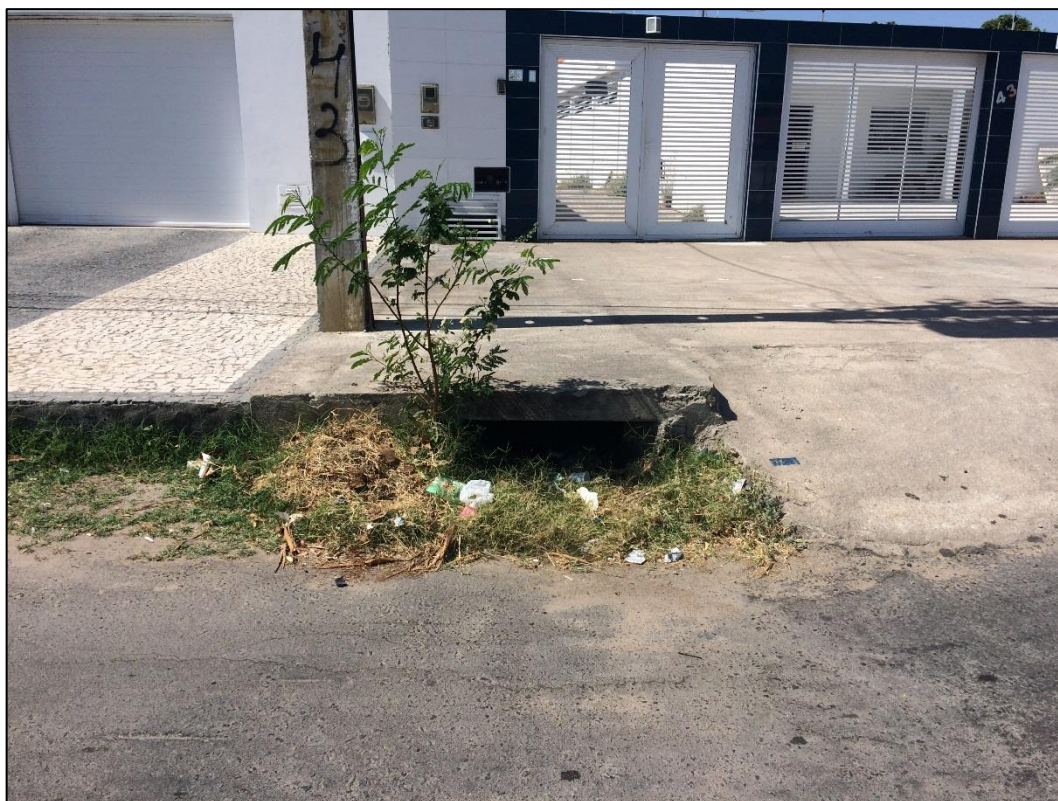
Figura 173 – Estrutura de captação do tipo lateral.
