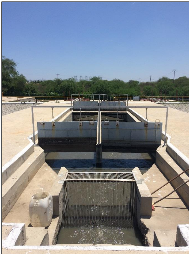
Figura 108 – Caixa de areia e gradeamento - ETE Centro. Fonte: DRZ – Geotecnologia e Consultoria, 2017.
