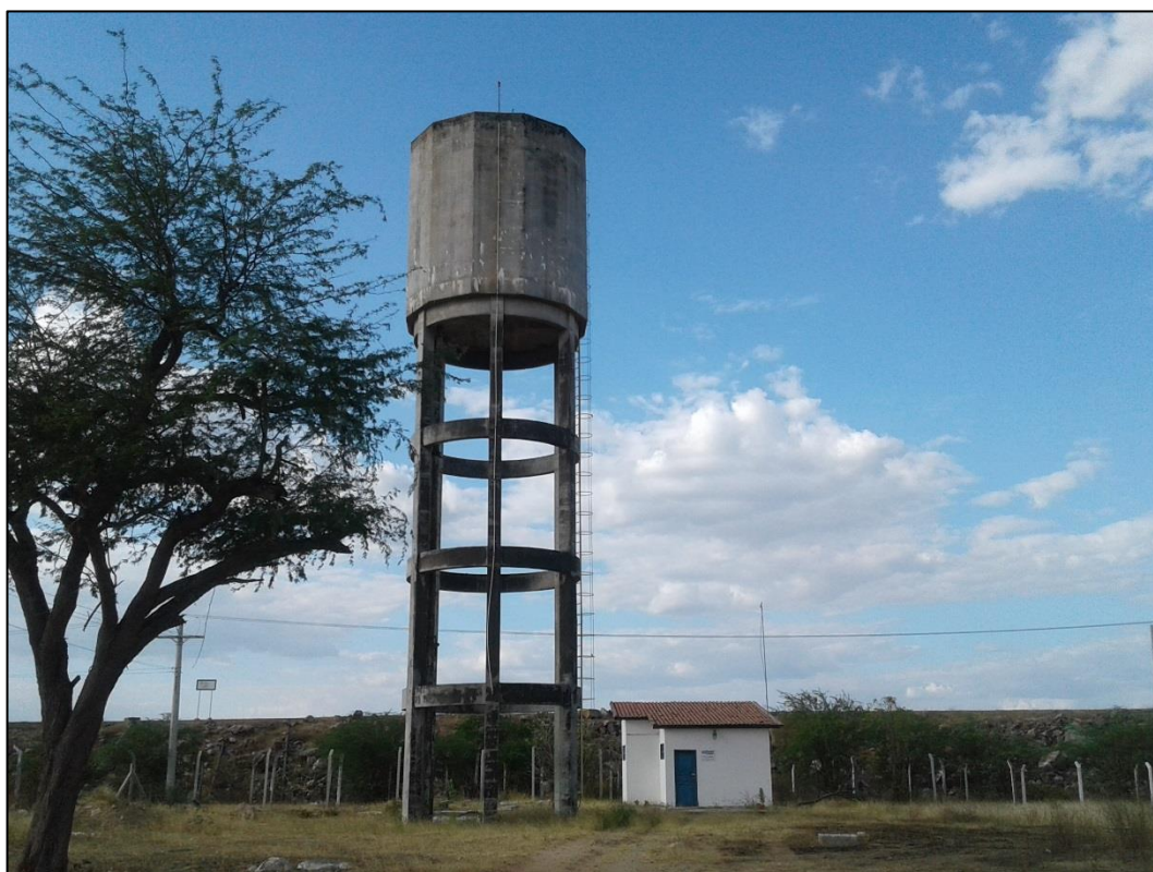
Figura 62 – REL 5 – 150 m 3 - BTN. Fonte: DRZ – Geotecnologia e Consultoria, 2017.
