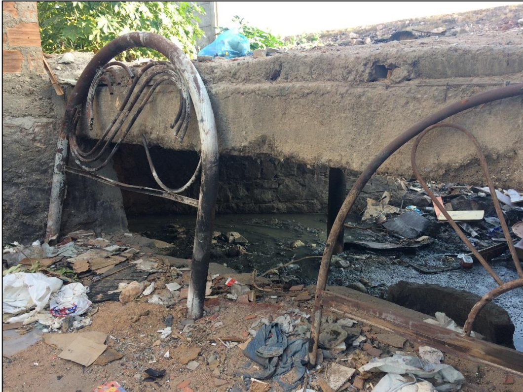
Figura 178 – Sarjeta de drenagem utilizada como interceptor de esgotamento sanitário - Bairro da ilha.
