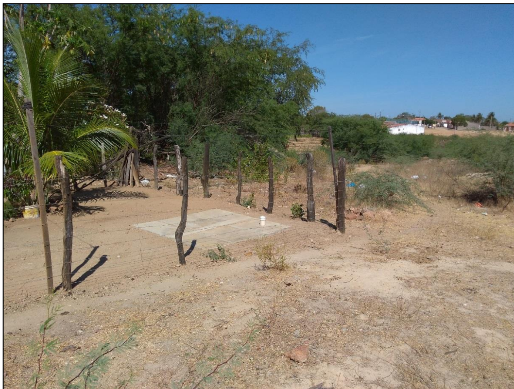
Figura 131 – Fossa séptica da Comunidade Rural de Riacho.
