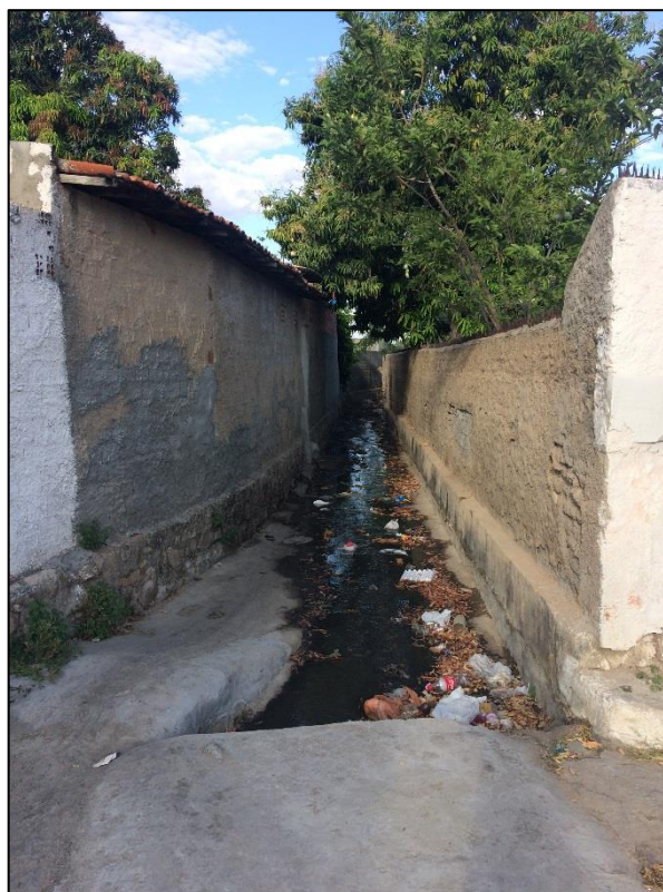
Figura 176 – Sarjeta de drenagem com ligações clandestinas de esgoto - Bairro Jardim Bahia.
