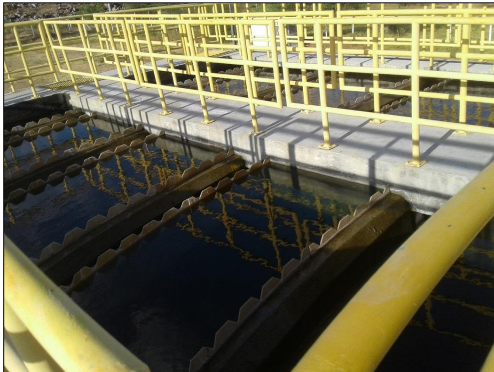
Figura 47 – Decantadores - Sistema BTN. Fonte: DRZ – Geotecnologia e Consultoria, 2017.
