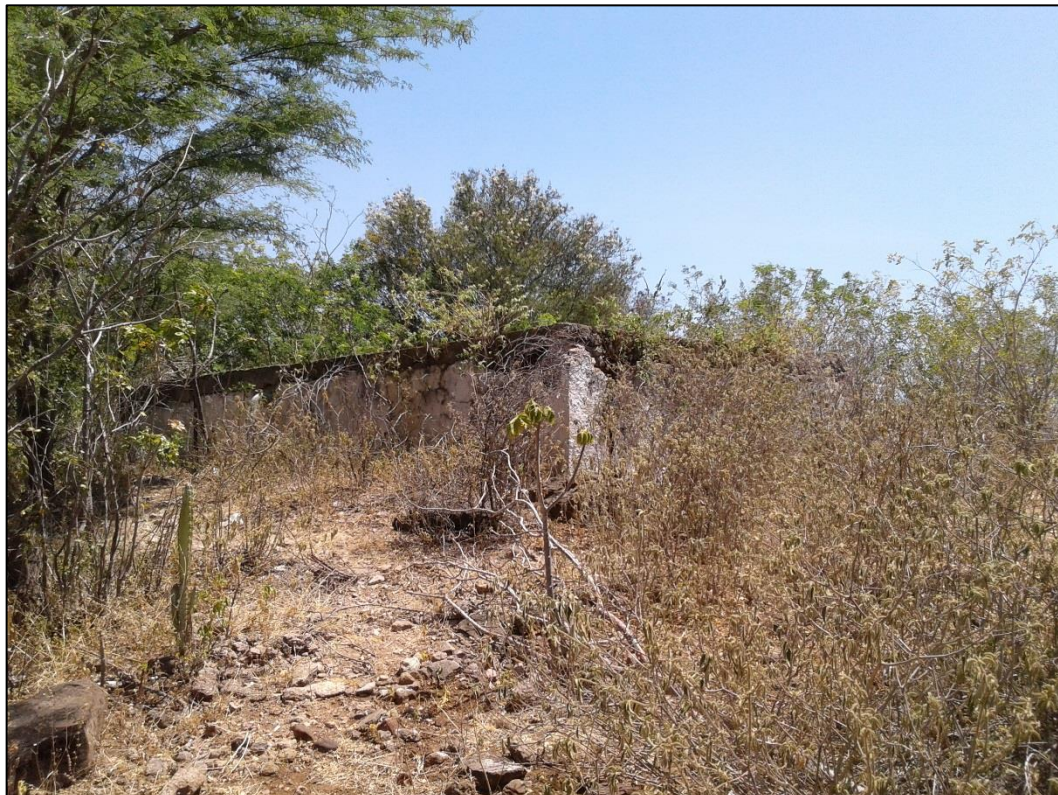
Figura 83 – RAP 3 - 50m 3 - Comunidade Juá. Fonte: DRZ – Geotecnia e Consultoria, 2017
