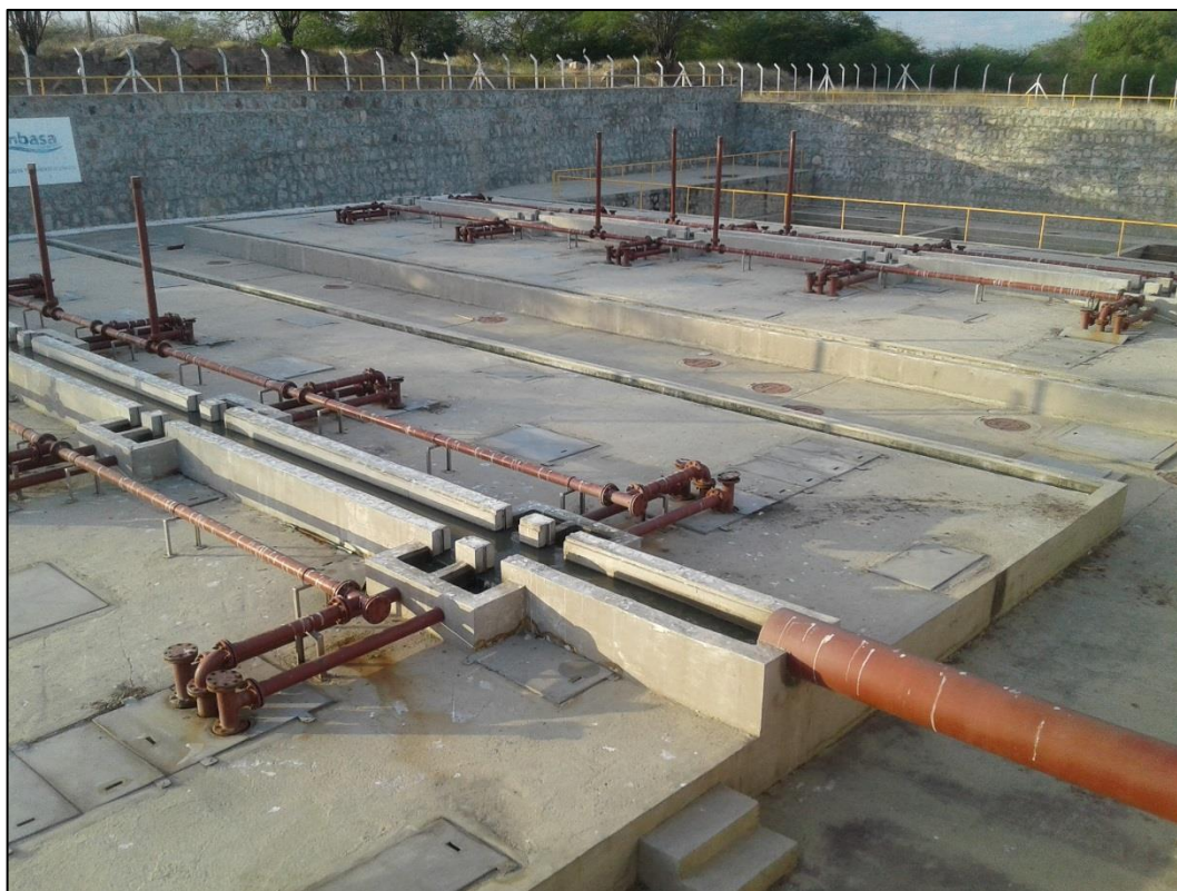
Figura 119 – Digestores de tratamento - ETE BTN. Fonte: DRZ – Geotecnologia e Consultoria, 2017.
