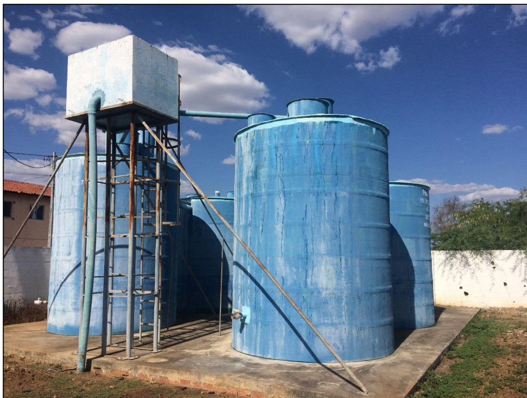
Figura 127 – ETE Beira Rio. Fonte: DRZ – Geotecnologia e Consultoria, 2017.
