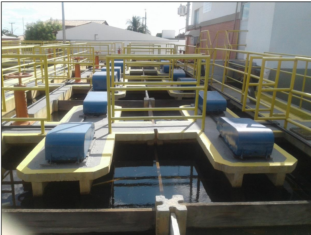
Figura 41 – Floculadores mecânicos - Sistema Centro. Fonte: DRZ – Geotecnologia e Consultoria, 2017.
