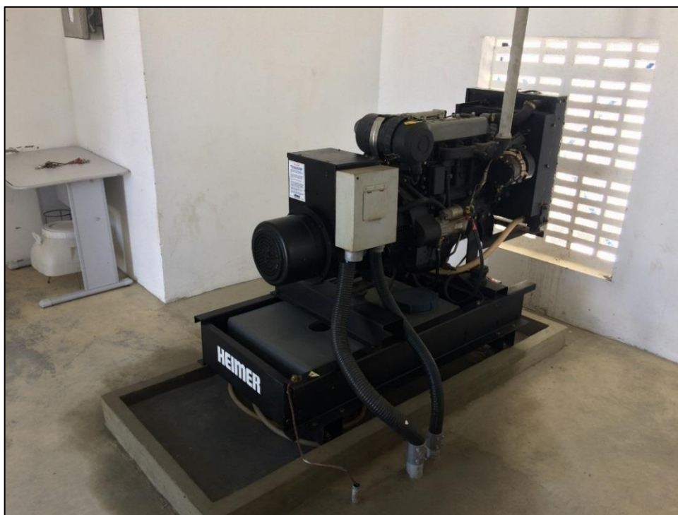
Figura 99 – Gerador de energia da EEE I.
