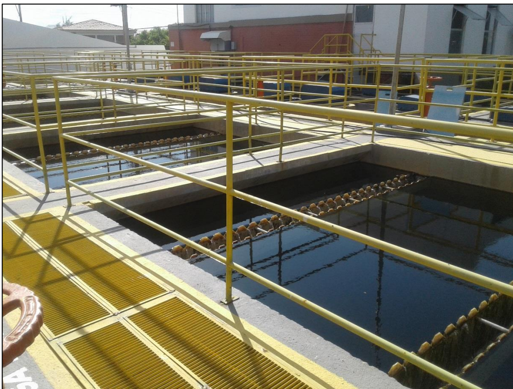
Figura 42 – Decantadores - Sistema Centro. Fonte: DRZ – Geotecnologia e Consultoria, 2017.
