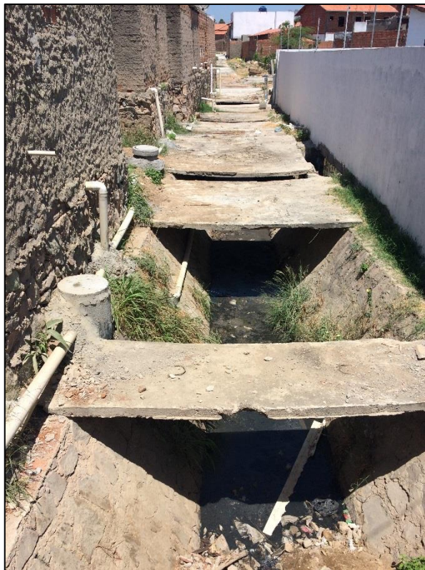
Figura 94 – Rede de drenagem que encaminha o efluente de esgoto doméstico à EEE III.
