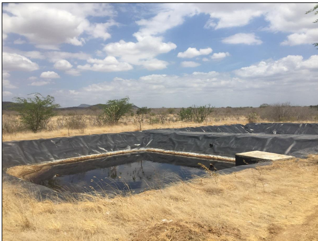
Figura 151 – Lagoa de tratamento de chorume do Aterro Sanitário de Paulo Afonso.
