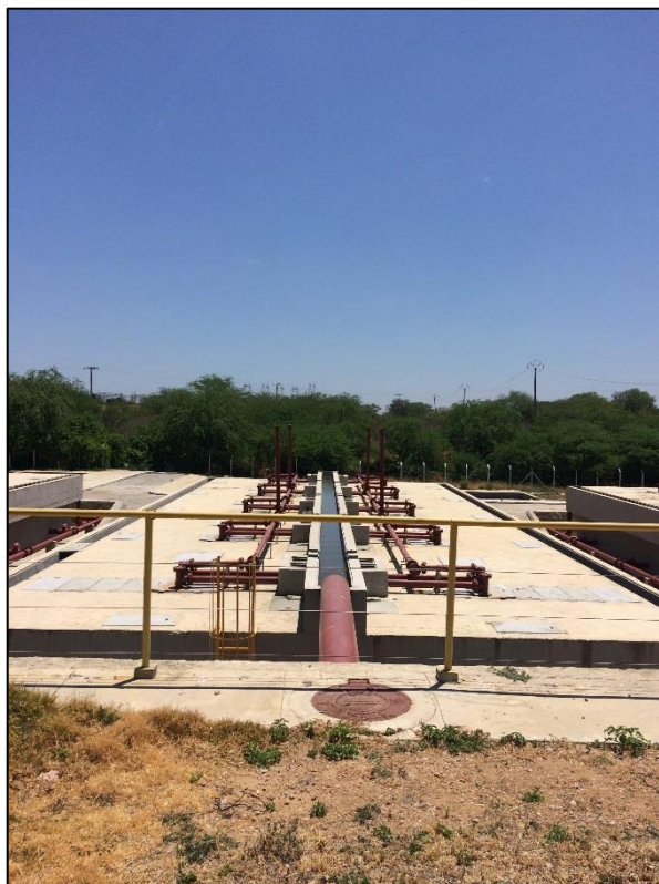
Figura 110 – Um dos quatro digestores de tratamento - ETE Centro. Fonte: DRZ – Geotecnologia e Consultoria, 2017.
