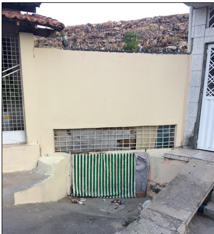
Figura 186 – Área em cota altimétrica com rede drenagem insuficiente - Local 2.
