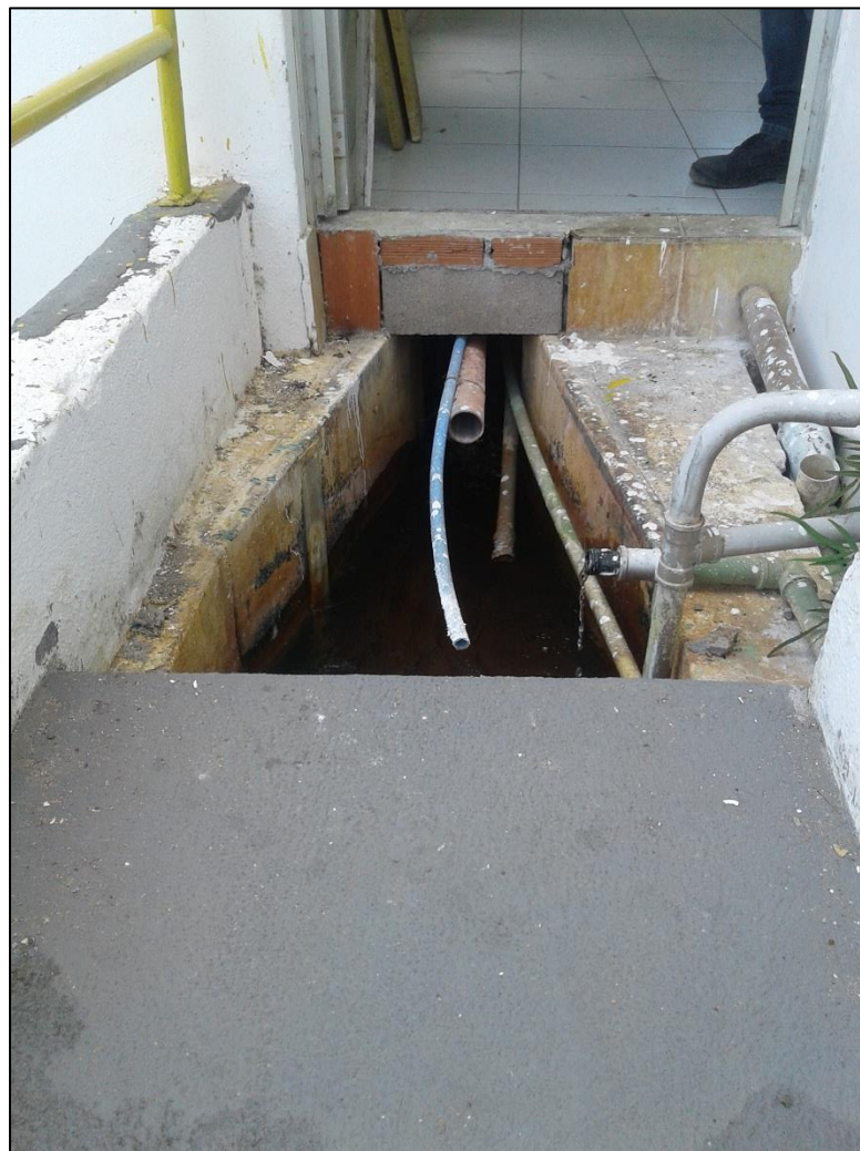
Figura 40 – Calha Parshall - Sistema Centro. Fonte: DRZ – Geotecnologia e Consultoria, 2017.
