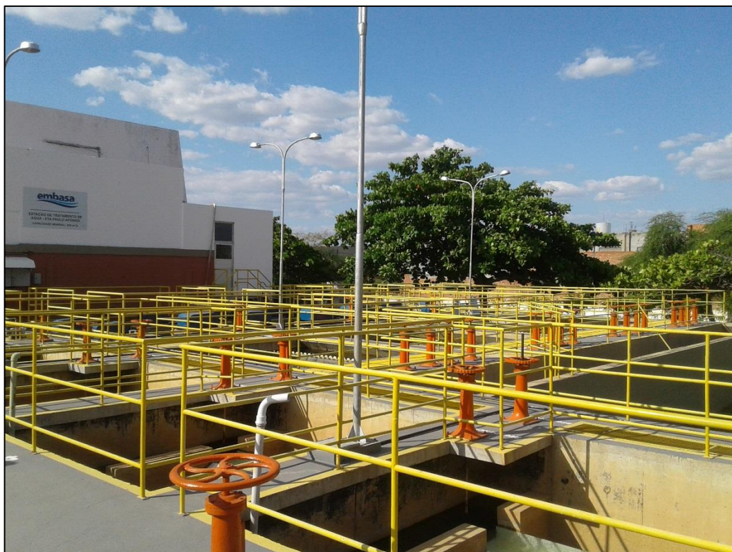
Figura 43 – Filtros - Sistema Centro. Fonte: DRZ – Geotecnologia e Consultoria, 2017.
