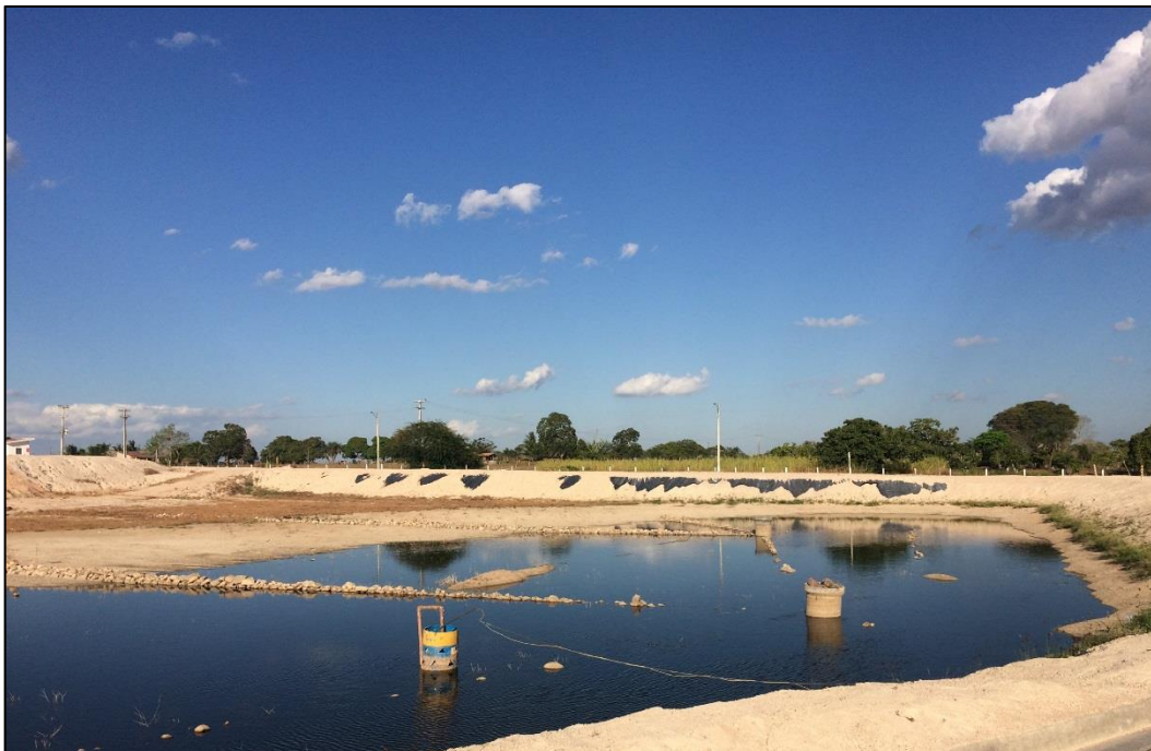
Figura 89 – Drenos de gás em local com acúmulo de água da chuva. Fonte: DRZ – Geotecnologia e Consultoria, 2017.
