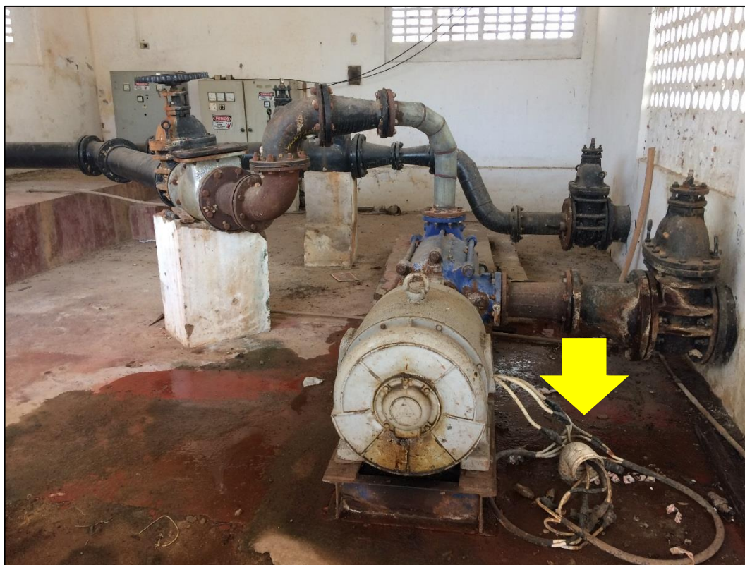
Figura 51 – Casa de bombas da EEAT IV. Fonte: DRZ – Geotecnologia e Consultoria, 2017.
