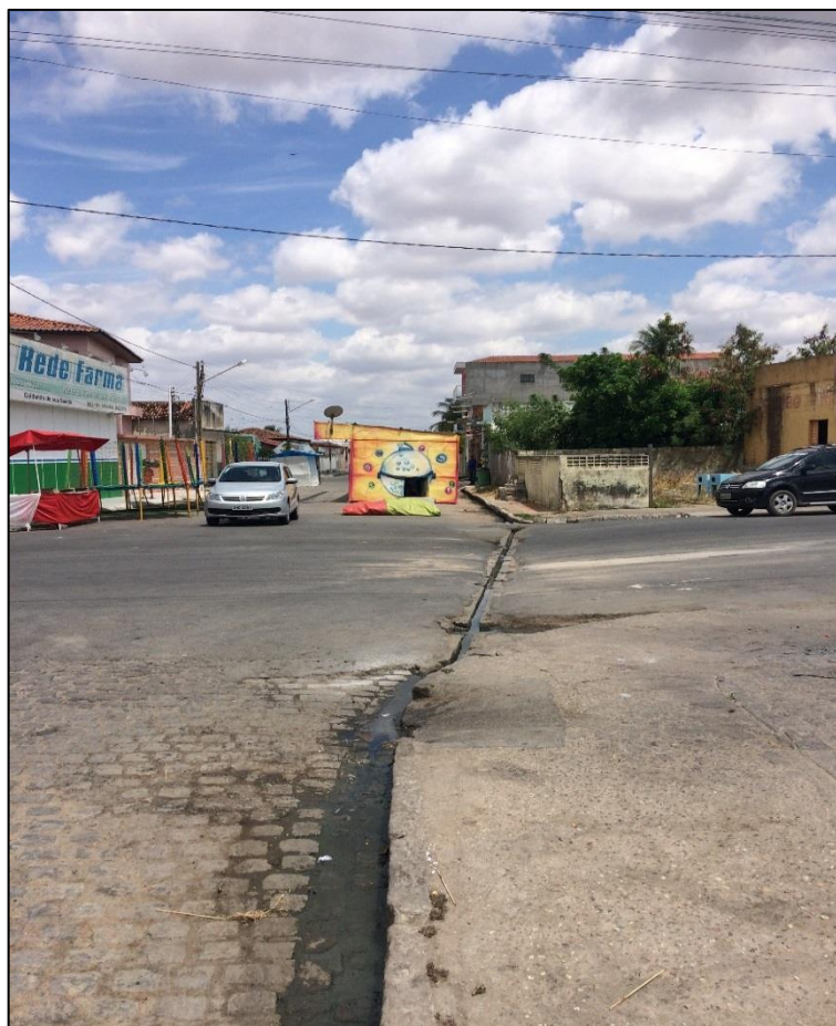
Figura 75 – Escoamento de esgoto pelas guias das calçadas na área urbana. Fonte: DRZ – Geotecnologia e Consultoria, 2017.
