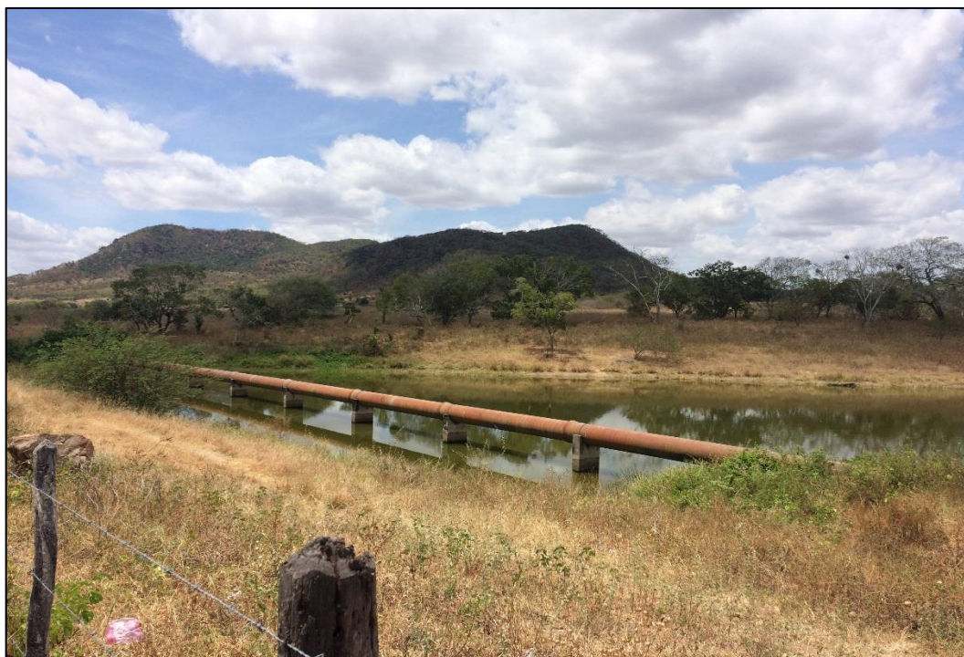
Figura 37 – Adutora de Água Tratada. Fonte: DRZ – Geotecnologia e Consultoria, 2017.
