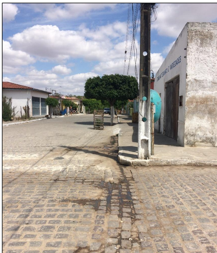
Figura 80 – Lançamento de esgoto na via pública no Distrito São Cristóvão. Fonte: DRZ – Geotecnologia e Consultoria, 2017.
