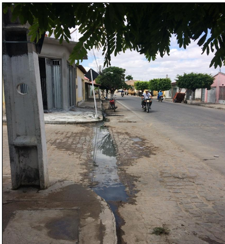
Figura 74 – Esgoto lançado diretamente nas vias públicas do Distrito Sede. Fonte: DRZ – Geotecnologia e Consultoria, 2017.
