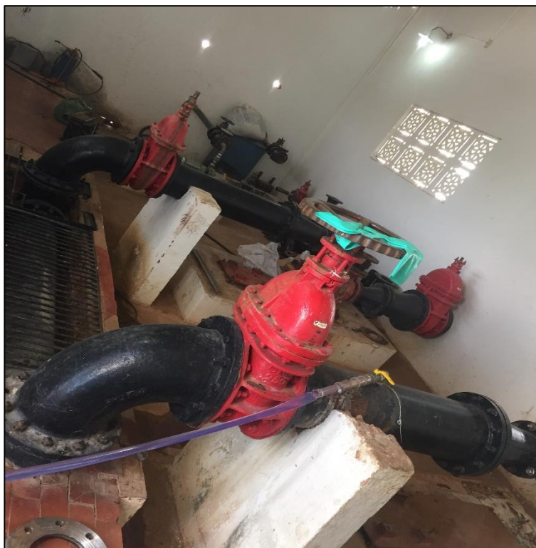
Figura 48 – Casa de bombas da EEAT III. Fonte: DRZ – Geotecnologia e Consultoria, 2017.
