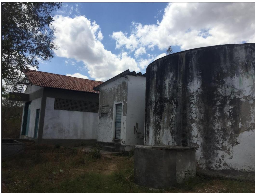
Figura 50 – Estação Elevatória de Água Tratada – EEAT IV. Fonte: DRZ – Geotecnologia e Consultoria, 2017.
