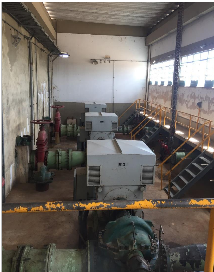
Figura 40 – Casa de bombas da EEAT I. Fonte: DRZ – Geotecnologia e Consultoria, 2017.
