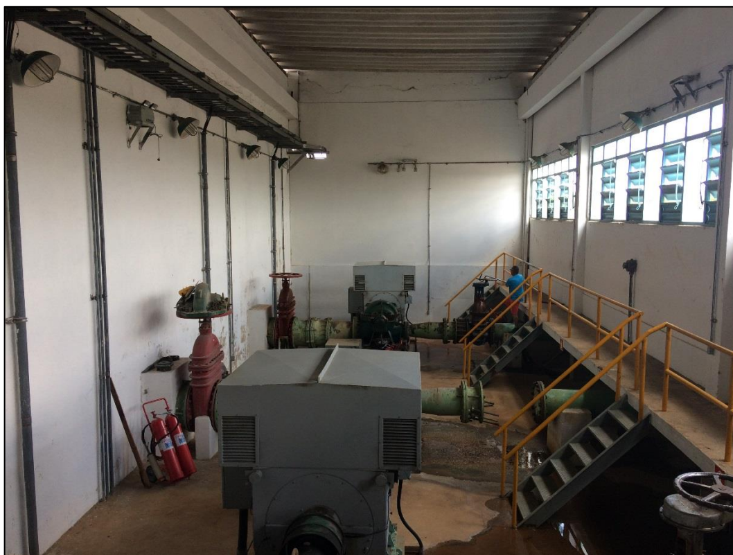
Figura 43 – Casa de bombas da EEAT II. Fonte: DRZ – Geotecnologia e Consultoria, 2017.
