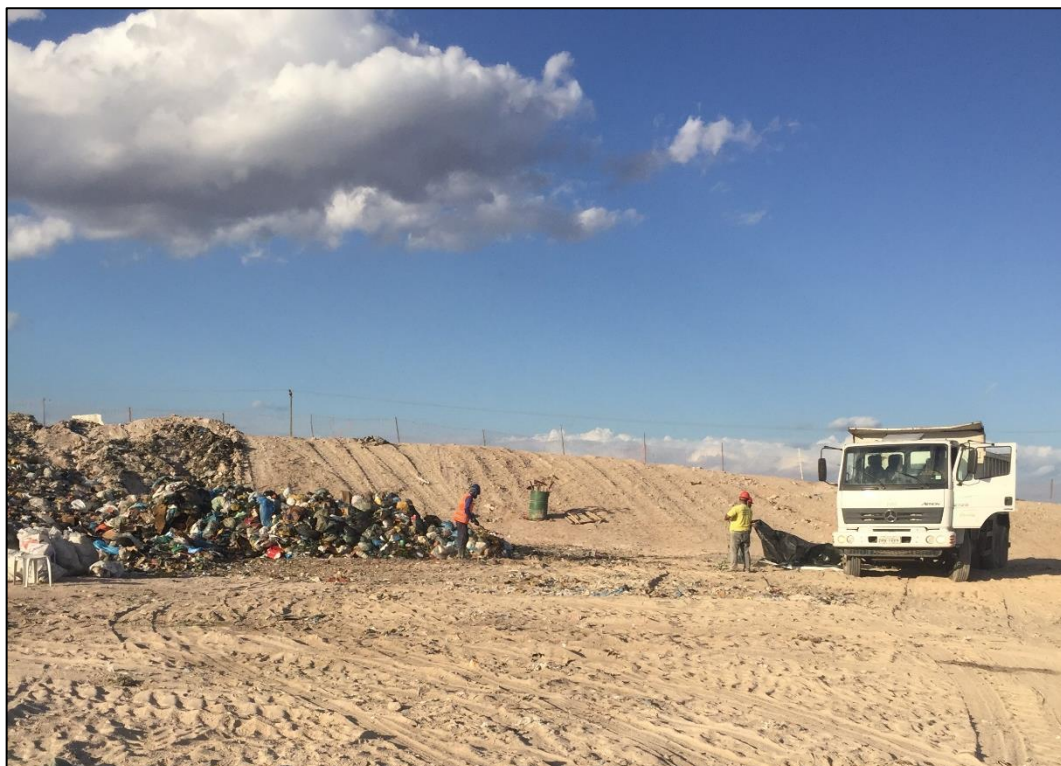
Figura 88 - Célula em operação. Fonte: DRZ – Geotecnologia e Consultoria, 2017.
