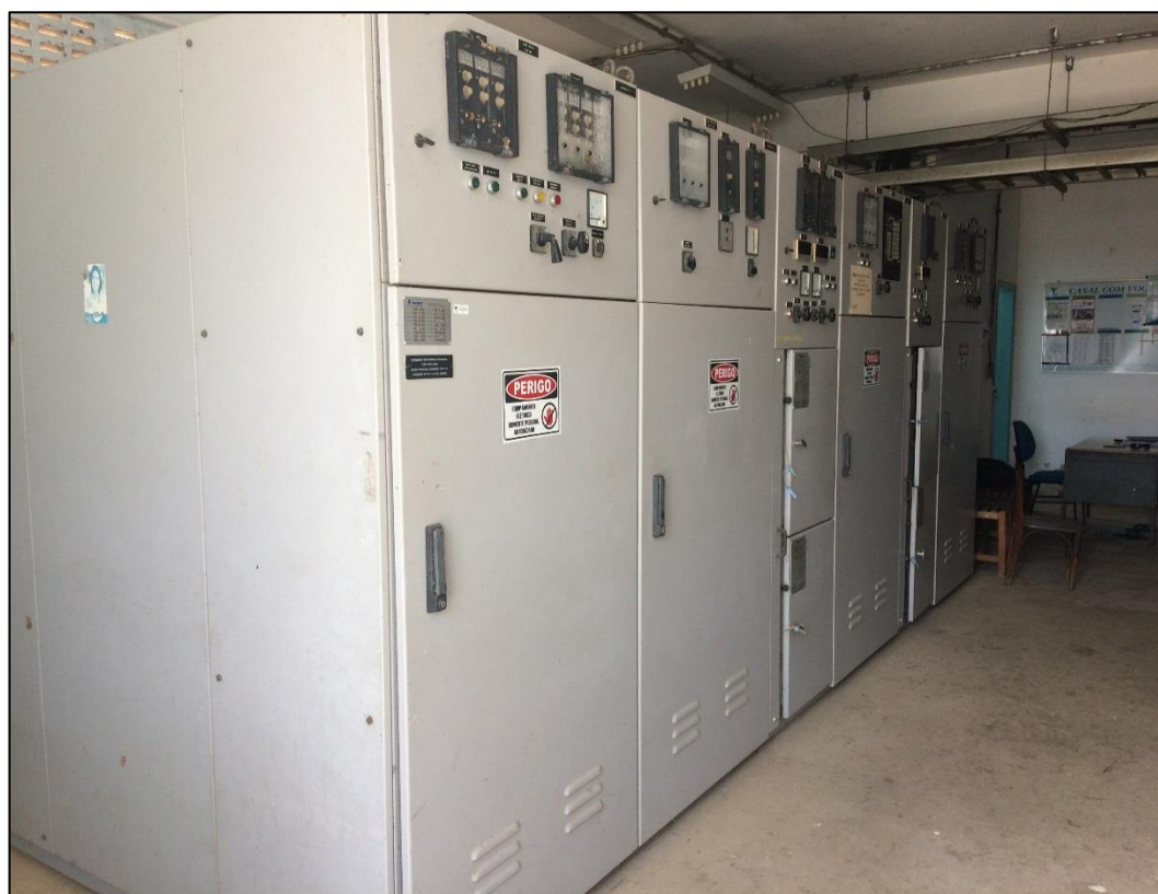
Figura 33 – Quadro de comando da captação.
