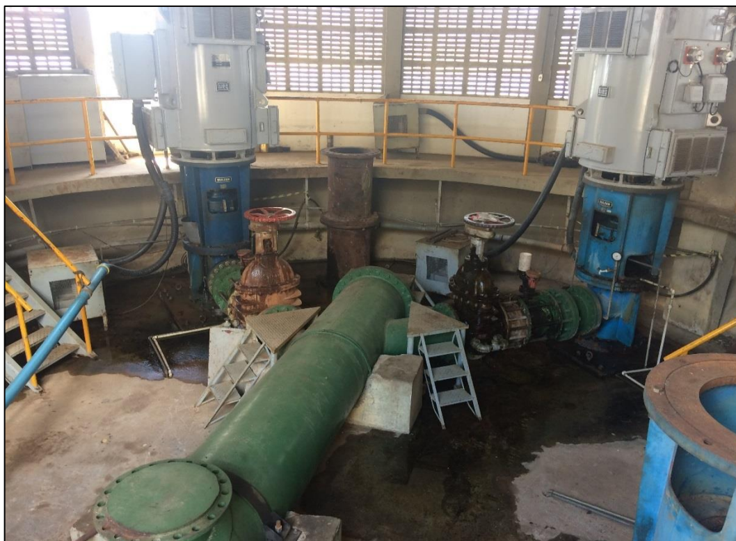
Figura 32 – Casa de bombas da captação do Sistema Coletivo da Bacia Leiteira.
