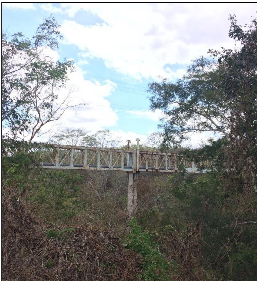
Figura 36 – Linha Suspensa Adutora de Água. Fonte: DRZ – Geotecnologia e Consultoria, 2017.
