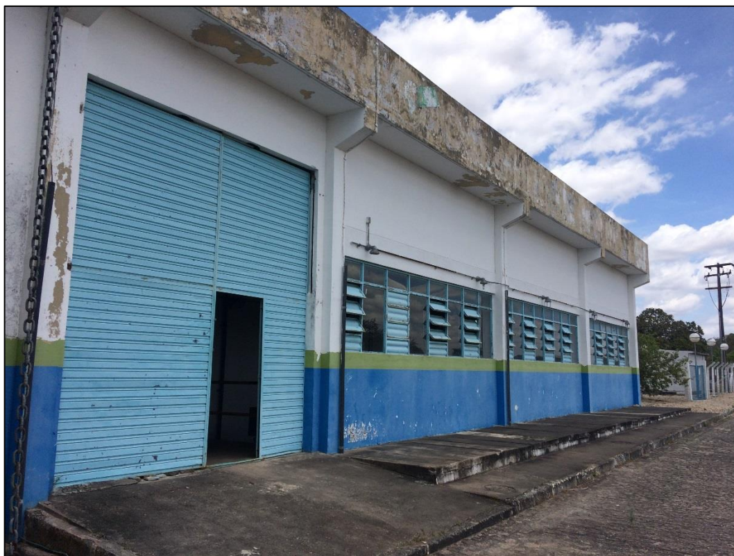
Figura 42 – Estação Elevatória de Água Tratada – EEAT II. Fonte: DRZ – Geotecnologia e Consultoria, 2017.
