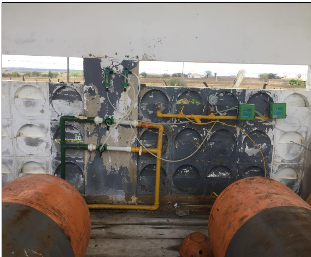
Figura 54 – Dosador de cloro gás. Fonte: DRZ – Geotecnologia e Consultoria, 2017.
