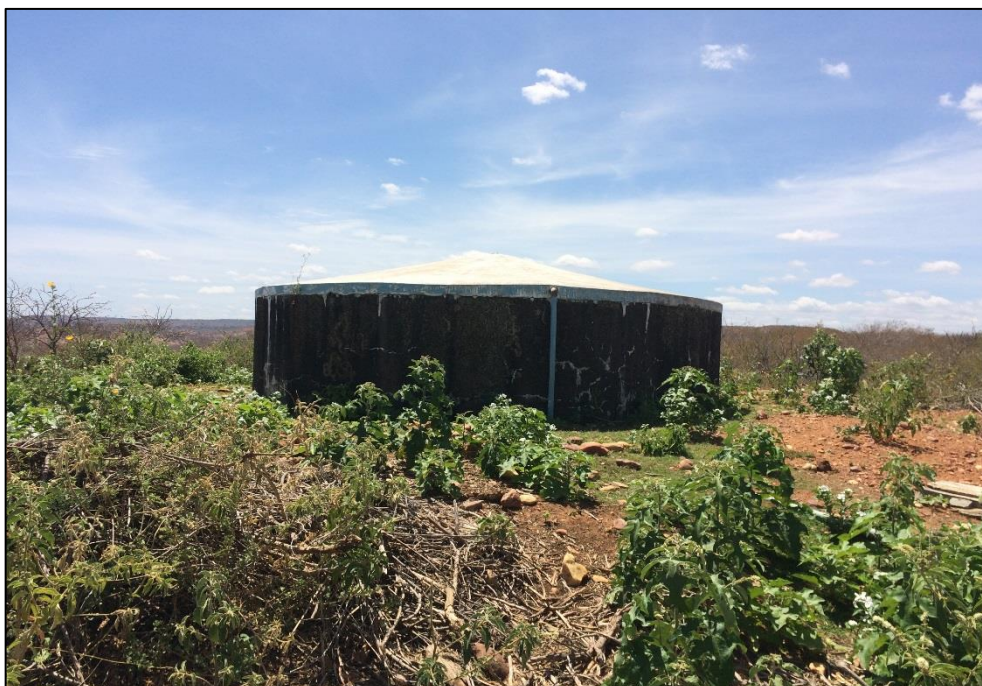
Figura 103 – Reservatório de água (RAP) do distrito Canché. Fonte: DRZ – Geotecnologia e Consultoria, 2017.
