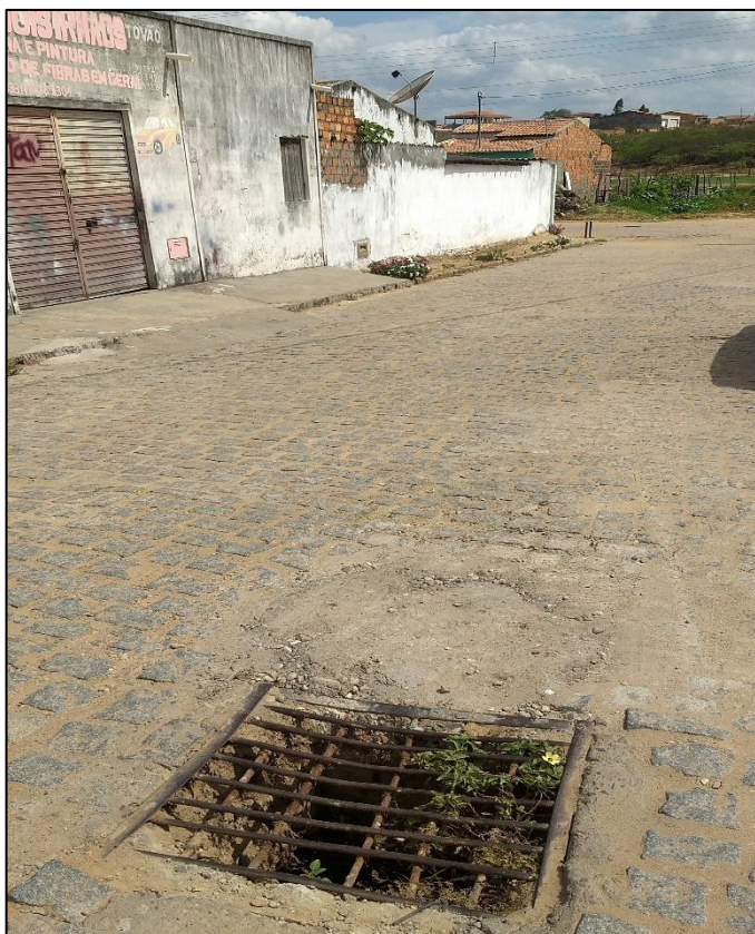
Figura 263 – Dispositivo para captação de águas pluviais (coordenadas UTM 571454.94 E 8886817.18 S).
