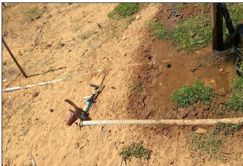
Figura 102 – Adutora de água bruta do distrito Canché.
