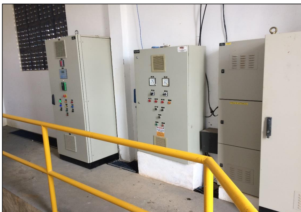
Figura 61 – Quadro de comando da EEAT do Poço 01. Fonte: DRZ – Geotecnologia e Consultoria, 2017.
