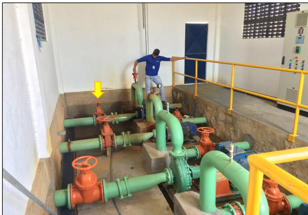
Figura 60 – Bombas da EEAT do Poço 01. Fonte: DRZ – Geotecnologia e Consultoria, 2017.
