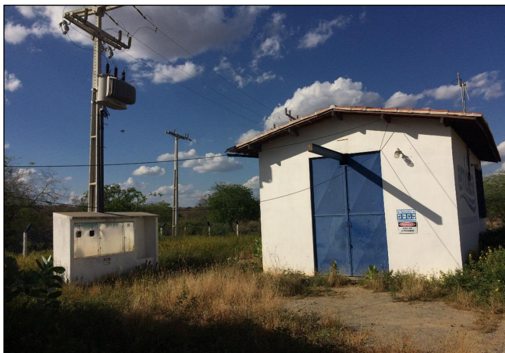
Figura 59 – Estação elevatória de água tratada do Poço 01. Fonte: DRZ – Geotecnologia e Consultoria, 2017.
