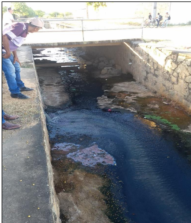
Figura 285 – Lançamento irregular de esgoto no canal de drenagem (coordenadas UTM 572057.92 E 8885448.27 S). Fonte: DRZ – Geotecnologia e Consultoria, 2017.
