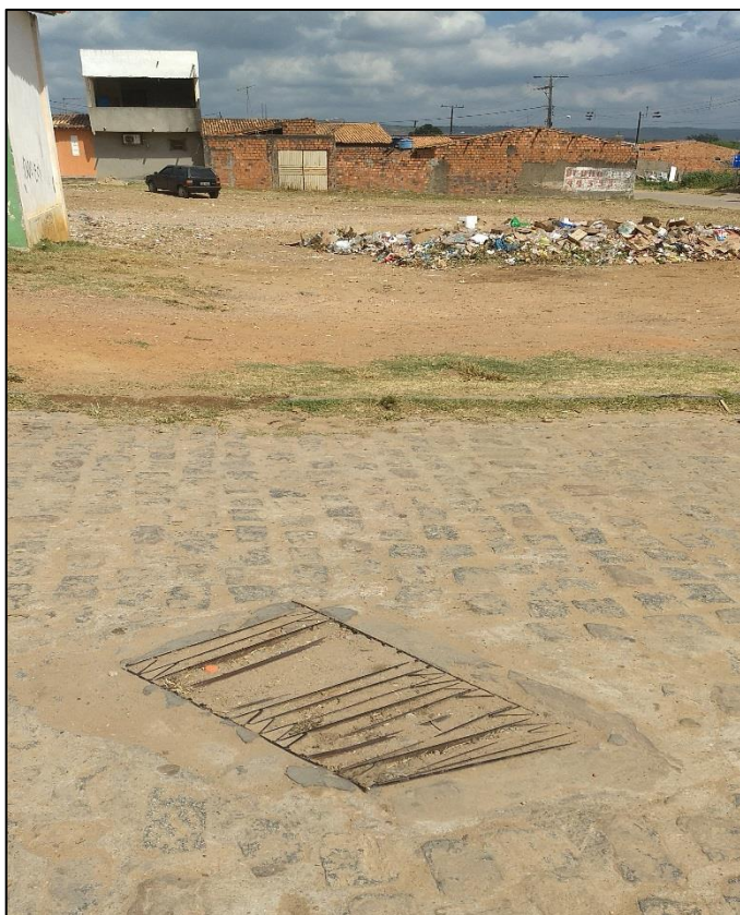
Figura 264 – Estrutura de captação de água pluvial sem manutenção (coordenadas UTM 571495.60 E 8886749.53 S). Fonte: DRZ – Geotecnologia e Consultoria, 2017.
