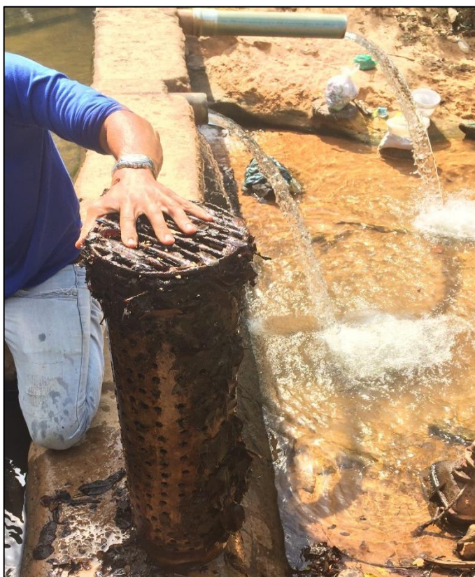
Figura 44 – Acúmulo de resíduos vegetais na tubulação de entrada na captação superficial. Fonte: DRZ – Geotecnologia e Consultoria, 2017.
