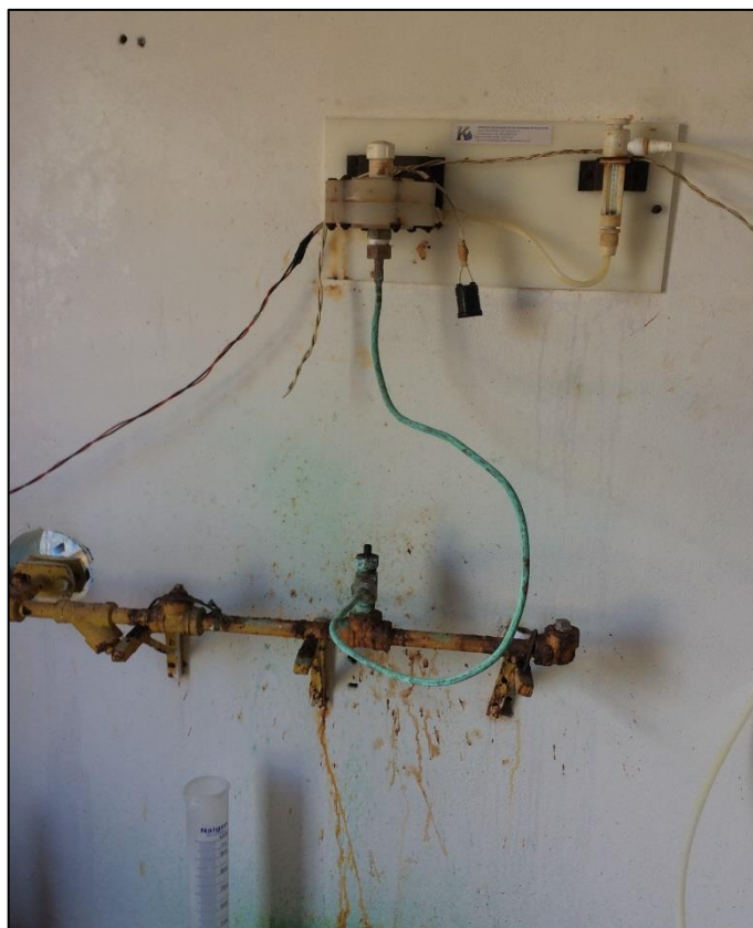
Figura 74 – Aparelho dosador de produtos químicos. Fonte: DRZ – Geotecnologia e Consultoria, 2017.
