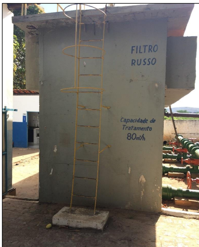
Figura 79 – Filtro russo da ETA. Fonte: DRZ – Geotecnologia e Consultoria, 2017.
