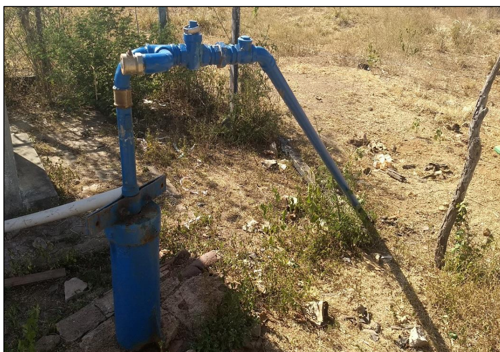
Figura 127 – Poço da comunidade Lagoa do Inácio. Fonte: DRZ – Geotecnologia e Consultoria, 2017.
