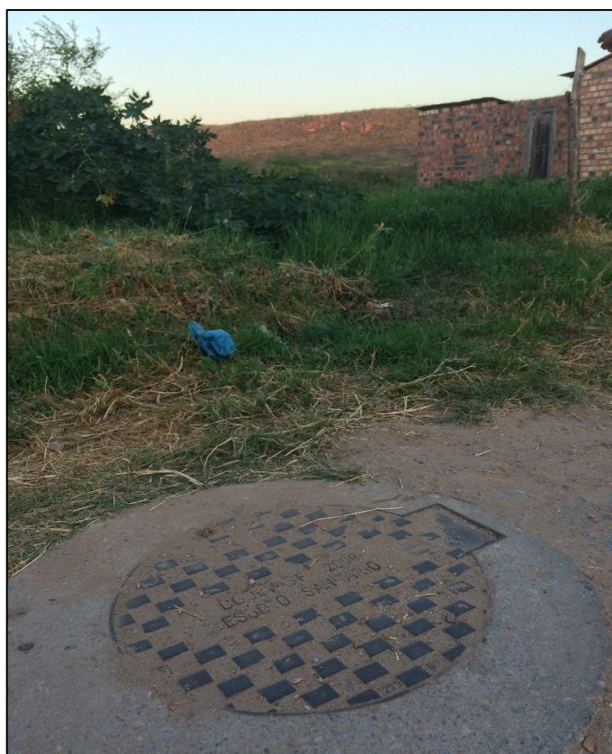
Figura 146 – Ponto de lançamento de esgoto sanitário (coordenadas UTM 571520.11 E 8886765.30 S).
