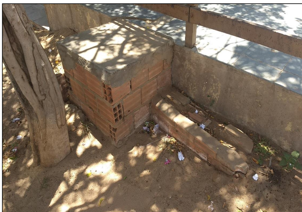
Figura 161 – Exemplo de fossa rudimentar utilizada na comunidade Água Branca.
