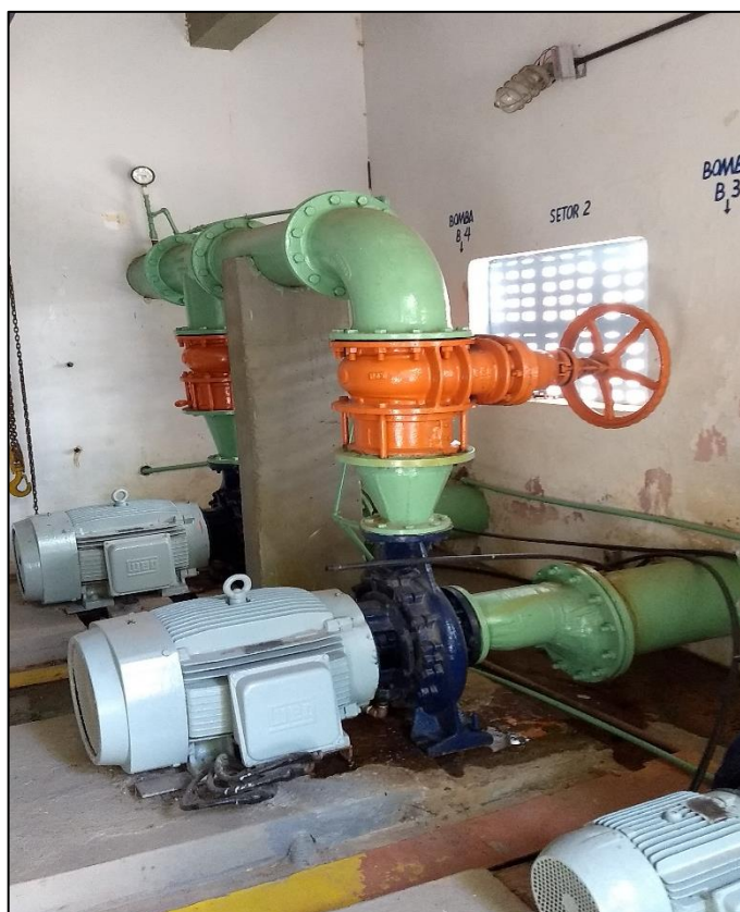
Figura 64 – Bombas principal e reserva da EEAT 2. Fonte: DRZ – Geotecnologia e Consultoria, 2017.
