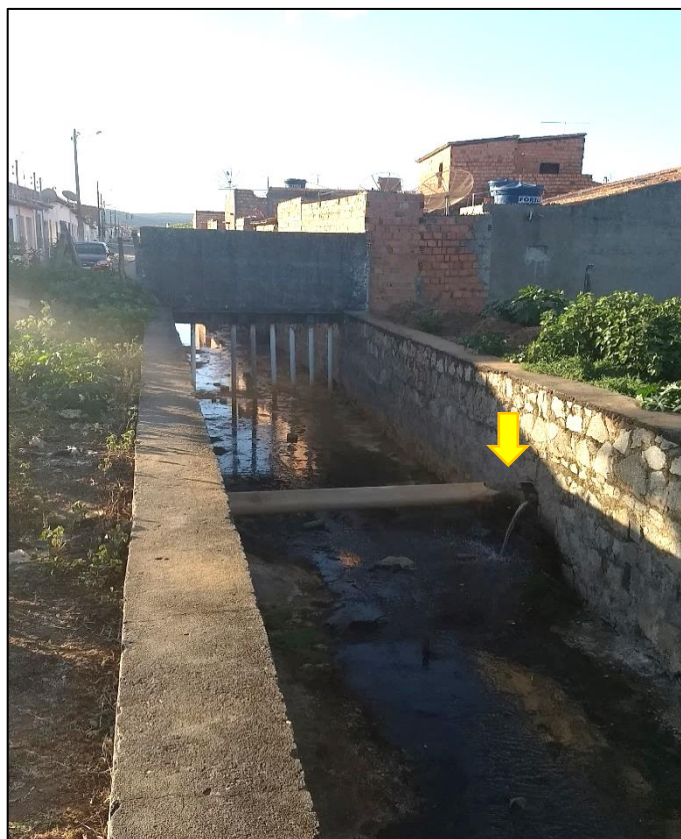
Figura 143 – Lançamento de esgoto no canal de drenagem, em área próxima às fossas.
