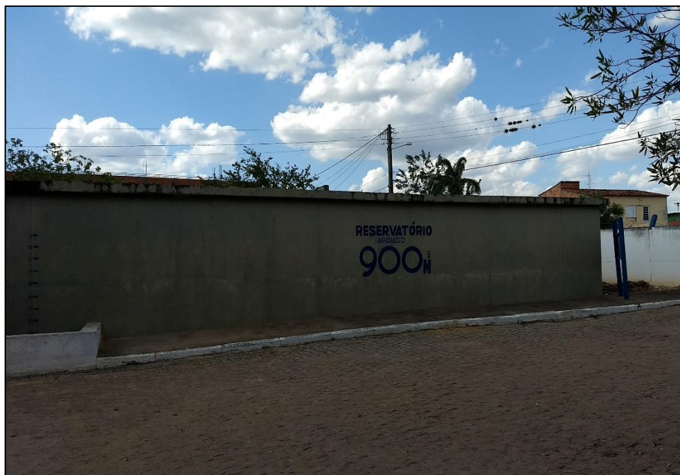
Figura 94 – Reservatório apoiado (RAP), 900 m 3 . Fonte: DRZ – Geotecnologia e Consultoria, 2017.
