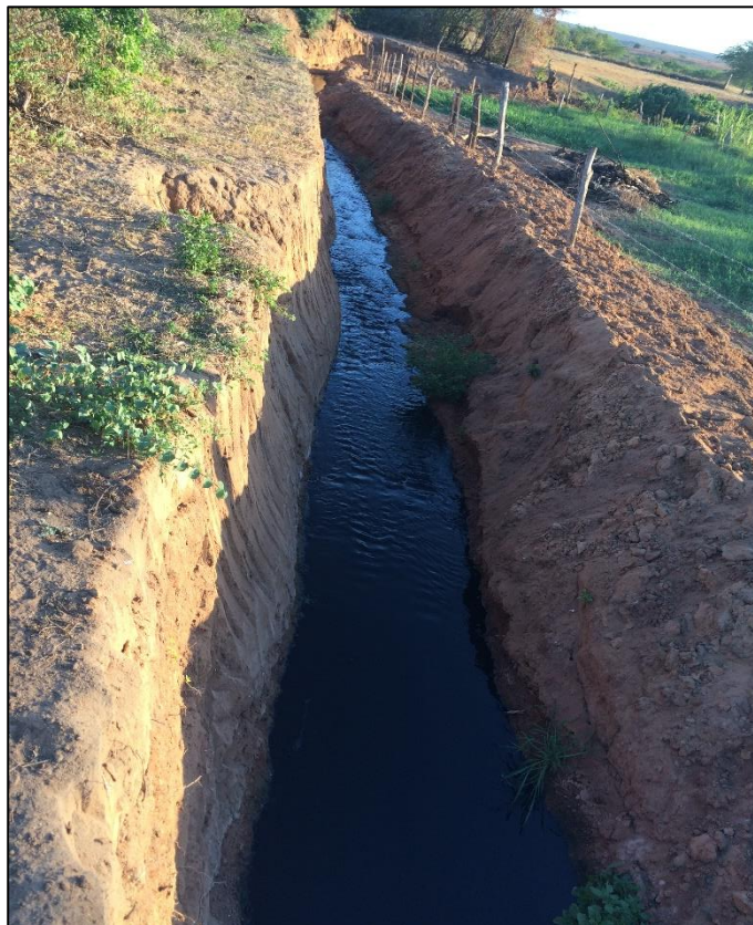
Figura 292 – Vala aberta para o escoamento da drenagem pluvial com esgoto sanitário (coordenadas UTM 572333.82 E 8884866.69 S). Fonte: DRZ – Geotecnologia e Consultoria, 2017.
