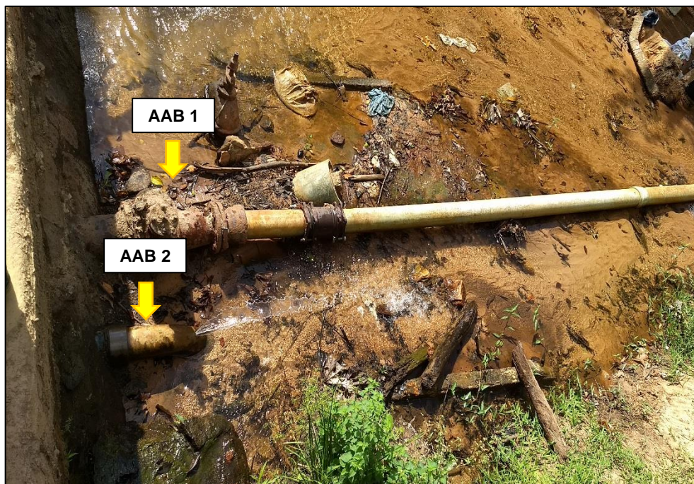
Figura 57 – Adutoras de água bruta (AAB 1 e AAB 2) da captação superficial. Fonte: DRZ – Geotecnologia e Consultoria, 2017.
