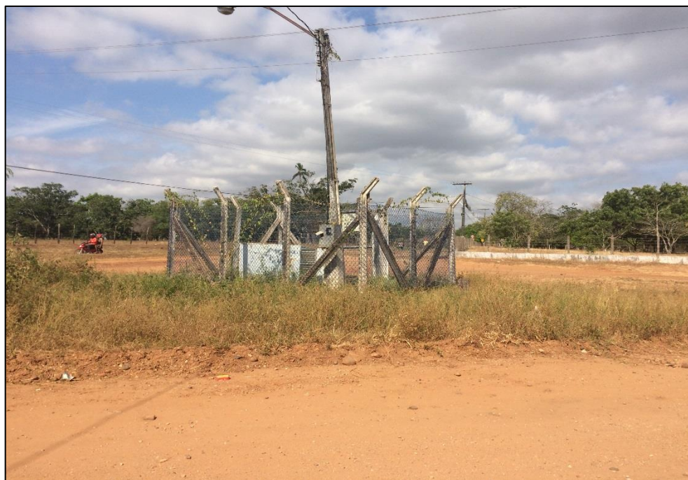
Figura 66 – Estação elevatória de água tratada, booster Romão. Fonte: DRZ – Geotecnologia e Consultoria, 2017.
