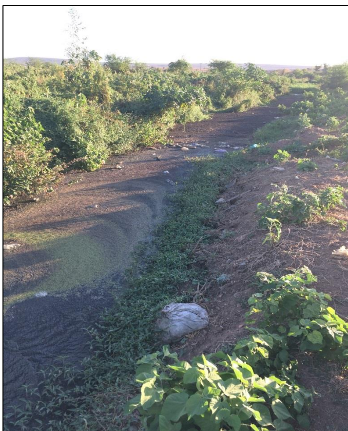
Figura 152 – Acúmulo de esgoto sanitário após o término do canal de drenagem.
