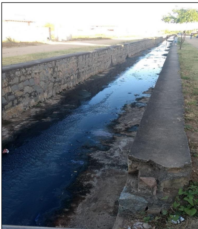
Figura 151 – Canal de drenagem com lançamento de efluente doméstico (coordenadas UTM 571837.58 E 8885575.42 S). Fonte: DRZ – Geotecnologia e Consultoria, 2017.
