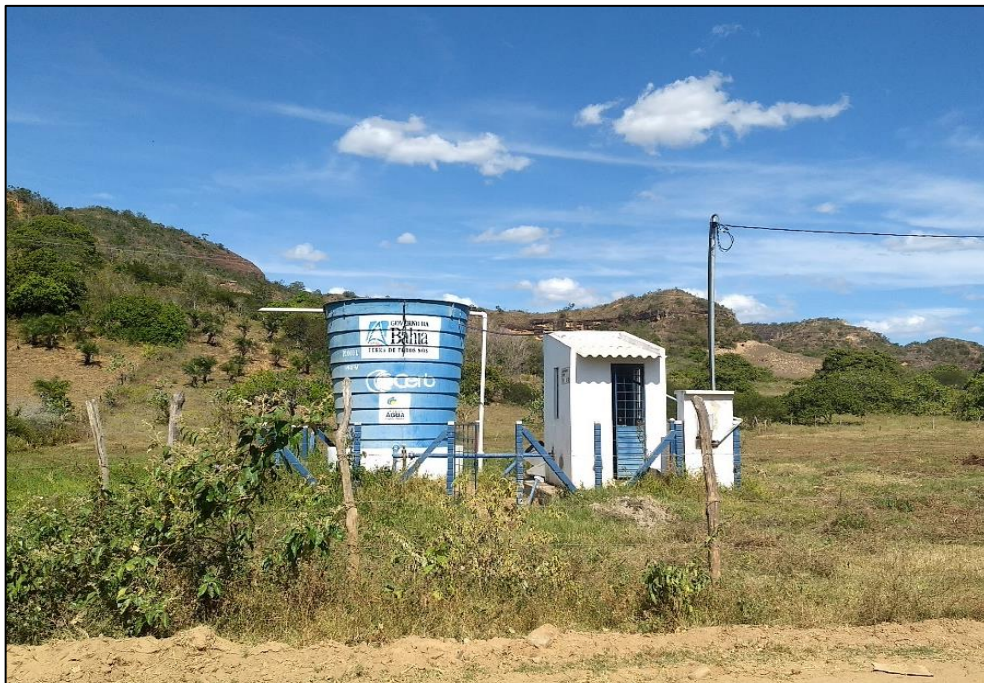
Figura 123 – Área do poço que atende a comunidade Cirica, localizado em Serra do Noel.
