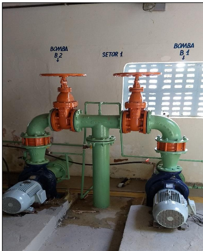
Figura 63 – Bombas principal e reserva da EEAT 1. Fonte: DRZ – Geotecnologia e Consultoria, 2017.
