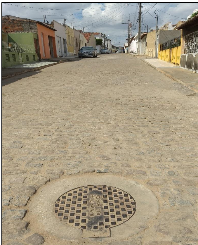
Figura 145 – PV da rede coletora de esgoto sanitário não finalizada no Distrito Sede.
