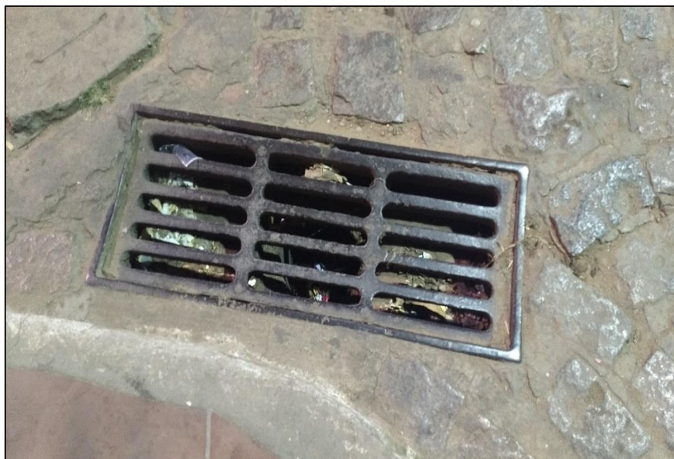
Figura 261 – Exemplo de boca de lobo utilizada em Jeremoabo (coordenadas UTM 571296.01 E 8886512.90 S).
