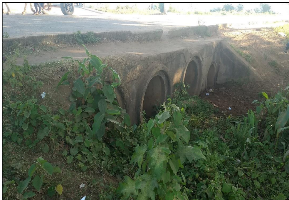
Figura 281 – Manilhas para entrada da água no Canal do Rio Vermelho (coordenadas UTM 571180.40 E 8886258.09 S). Fonte: DRZ – Geotecnologia e Consultoria, 2017.
