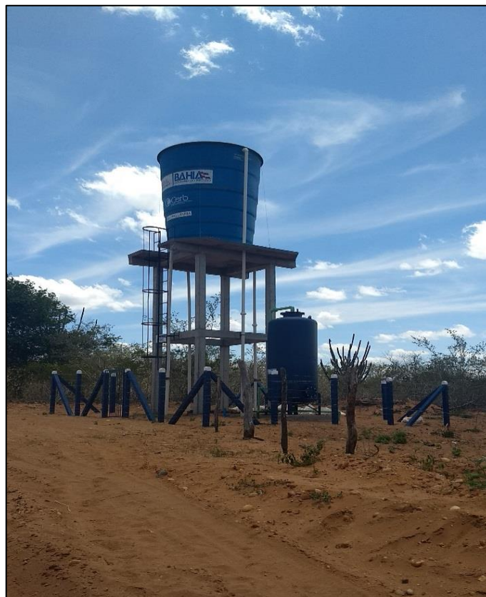
Figura 119 – Novo reservatório da comunidade Brancos. Fonte: DRZ – Geotecnologia e Consultoria, 2017.
