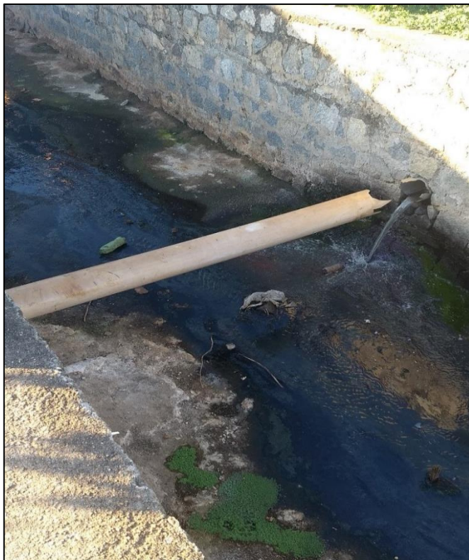
Figura 150 – Lançamento irregular de esgoto no canal de drenagem (coordenadas UTM 571787.16 E 8885604.85 S). Fonte: DRZ – Geotecnologia e Consultoria, 2017.
