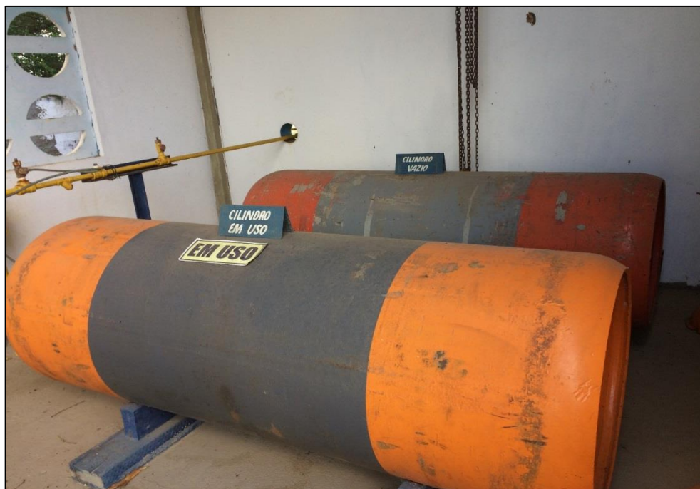
Figura 86 – Cilindros de cloro gás. Fonte: DRZ – Geotecnologia e Consultoria, 2017.
