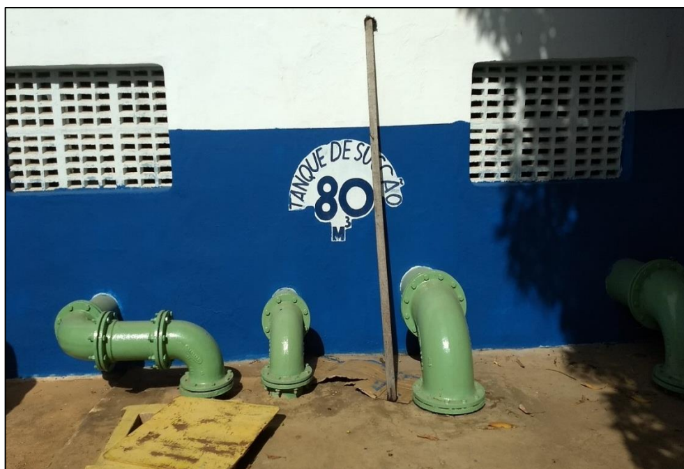
Figura 83 – Tanque de sucção (REN) de 80 m 3 . Fonte: DRZ – Geotecnologia e Consultoria, 2017.
