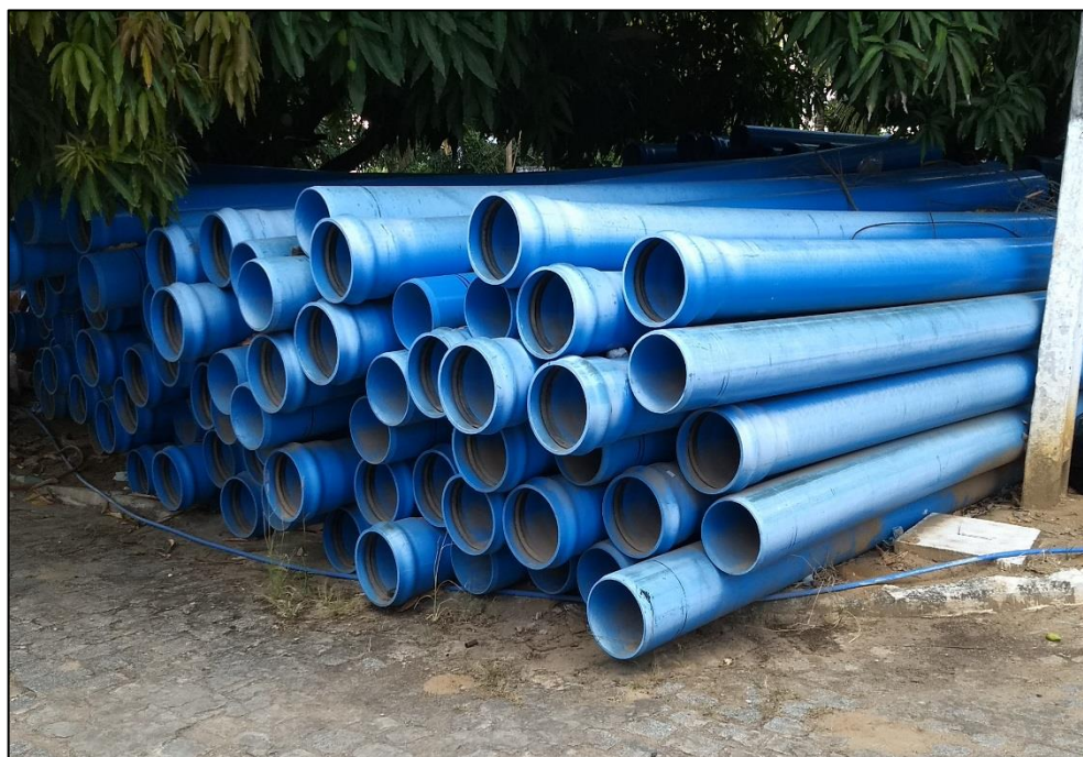
Figura 62 – Material para substituição da adutora de água tratada (AAT 1). Fonte: DRZ – Geotecnologia e Consultoria, 2017.
