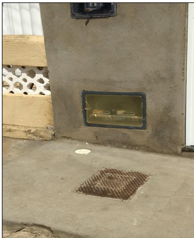
Figura 99 – Hidrômetros instalados no distrito Sede. Fonte: DRZ – Geotecnologia e Consultoria, 2017.
