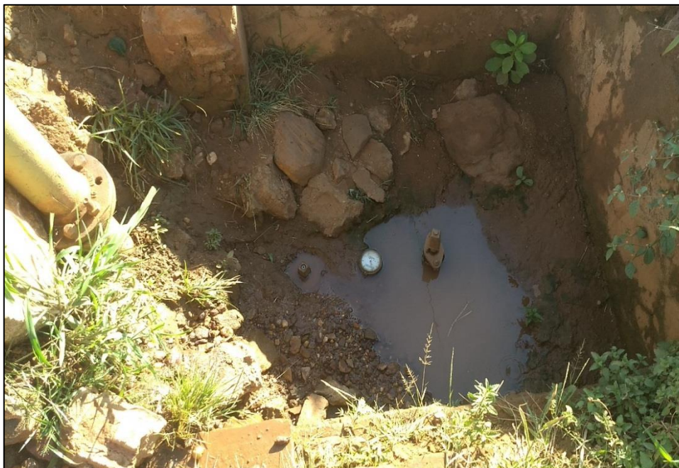
Figura 110 – Macromedidor do ponto de abastecimento dos caminhões-pipa. Fonte: DRZ – Geotecnologia e Consultoria, 2017.
