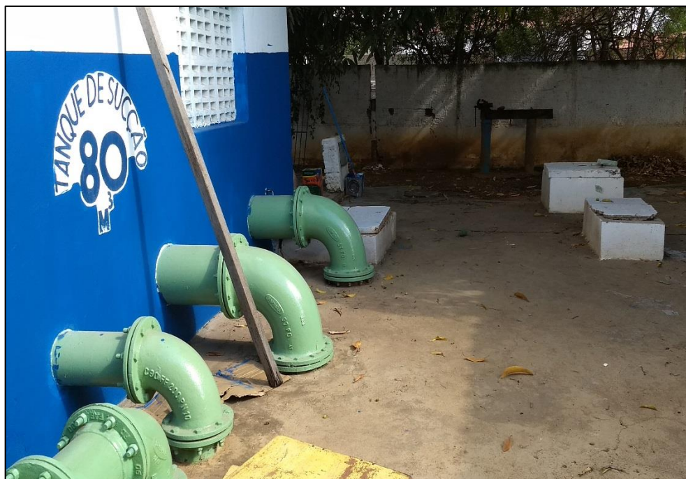
Figura 95 – Reservatório enterrado (REN), 80 m 3 . Fonte: DRZ – Geotecnologia e Consultoria, 2017.
