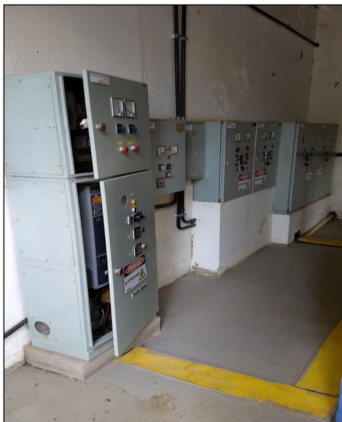
Figura 65 – Quadros de comando e inversor de frequência. Fonte: DRZ – Geotecnologia e Consultoria, 2017.
