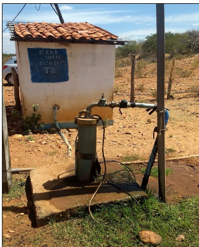
Figura 100 – Poço do distrito Canché. Fonte: DRZ – Geotecnia e Consultoria, 2017.
