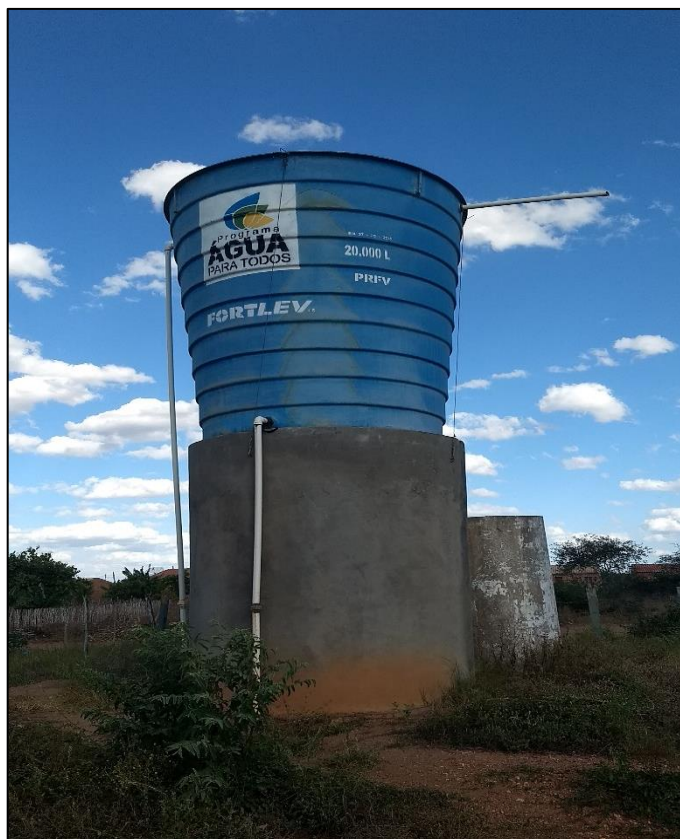
Figura 122 – Reservatório da comunidade Caritá. Fonte: DRZ – Geotecnologia e Consultoria, 2017.
