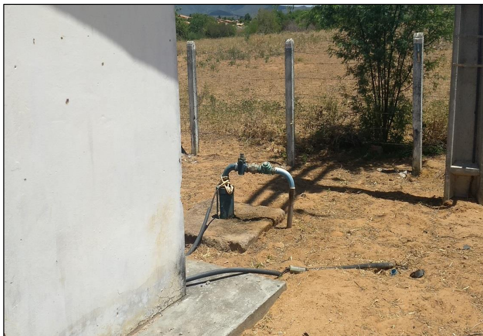
Figura 121 – Poço da comunidade Brejo Grande. Fonte: DRZ – Geotecnologia e Consultoria, 2017.
