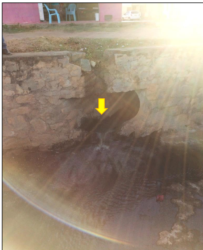
Figura 265 – Despejo irregular de esgoto na rede de drenagem. Fonte: DRZ – Geotecnologia e Consultoria, 2017.
