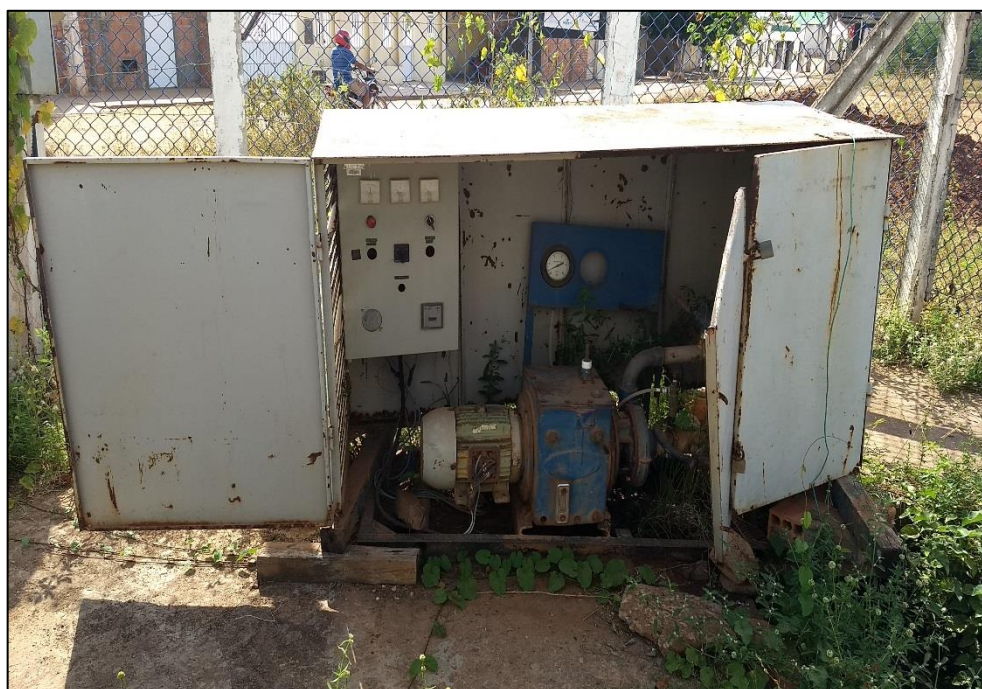
Figura 68 – Booster Romão em estado precário. Fonte: DRZ – Geotecnologia e Consultoria, 2017.
