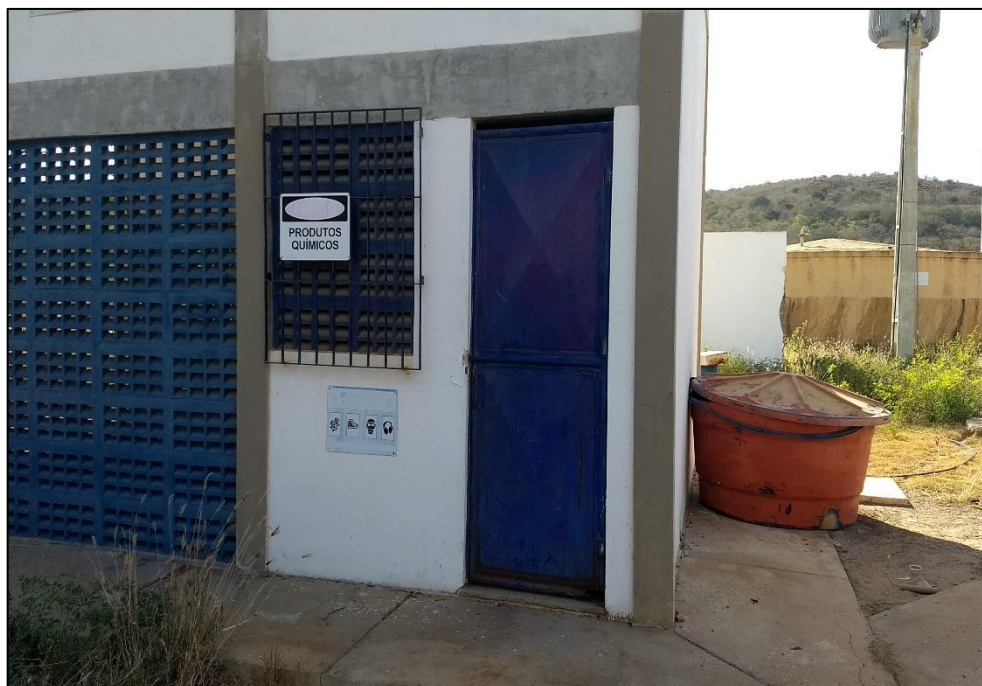
Figura 72 – Aplicação de produtos químicos na água captada pelos poços. Fonte: DRZ – Geotecnologia e Consultoria, 2017.
