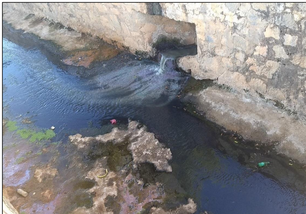
Figura 149 – Canal de drenagem com lançamento de esgoto no distrito Sede (coordenadas UTM 572074.34 E 8885440.56 S).
