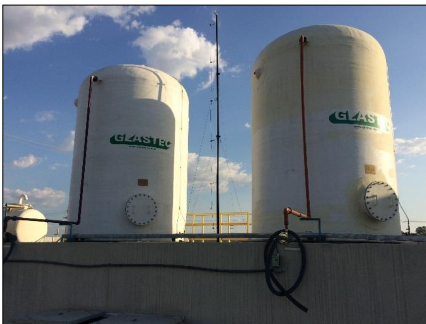
Figura 103 – Depósitos de produtos químicos utilizados no processo de tratamento.
