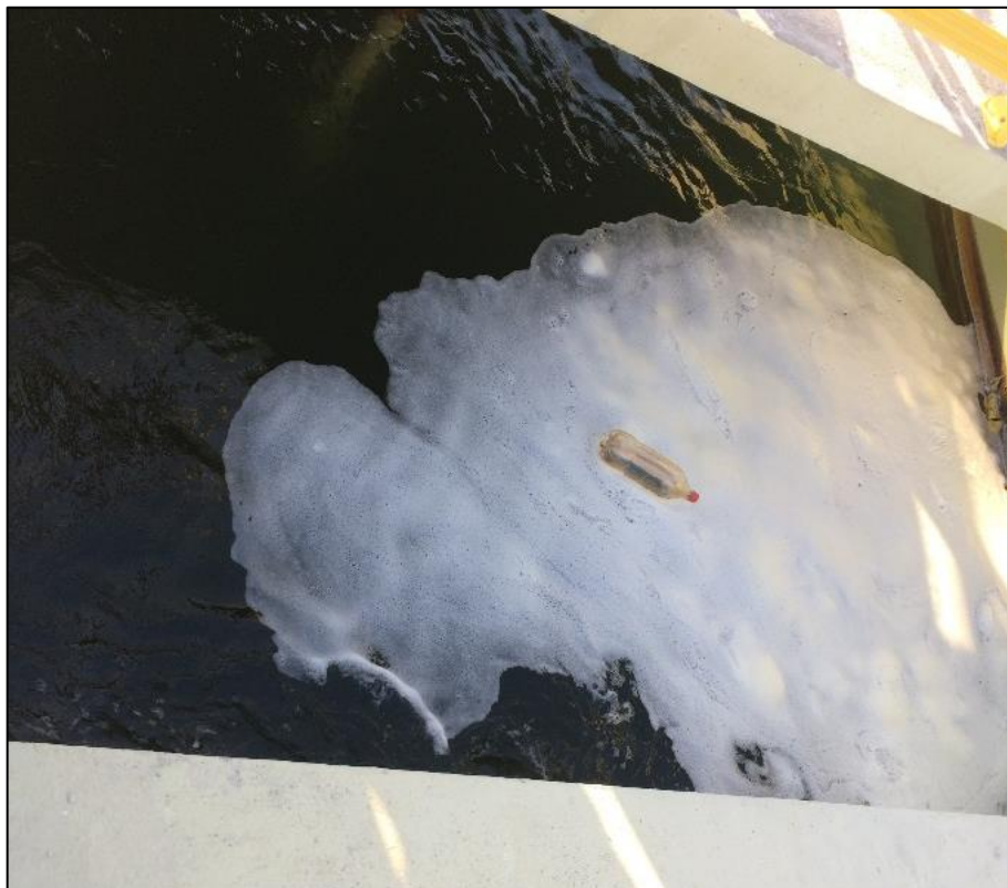
Figura 104 – Floculadores da ETA Alto Sertão. Fonte: DRZ – Geotecnologia e Consultoria, 2017.
