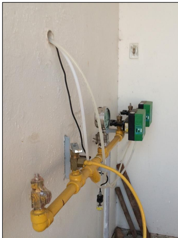
Figura 49 – Dosador de cloro - ETA Delmiro. Fonte: DRZ – Geotecnologia e Consultoria, 2017.
