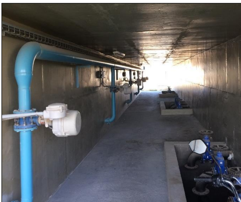
Figura 110 - Tubulação cloro gás e flúor. Fonte: DRZ – Geotecnologia e Consultoria, 2017.
