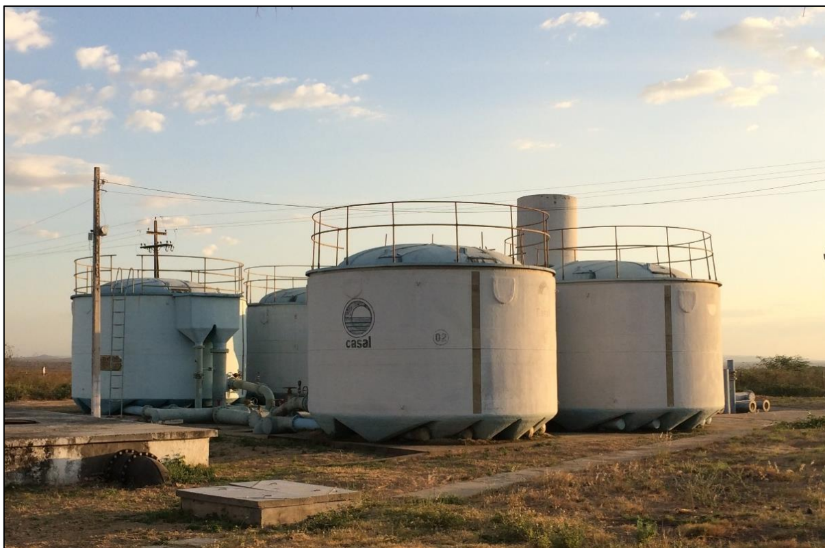
Figura 43 – Conjunto de filtros da ETA do Sistema Delmiro. Fonte: DRZ – Geotecnologia e Consultoria, 2017.
