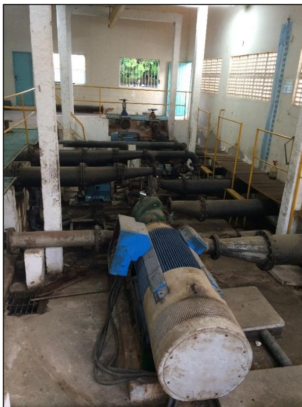
Figura 53 – Bombas EEAT da ETA Sistema. Delmiro. Fonte: DRZ – Geotecnologia e Consultoria, 2017.
