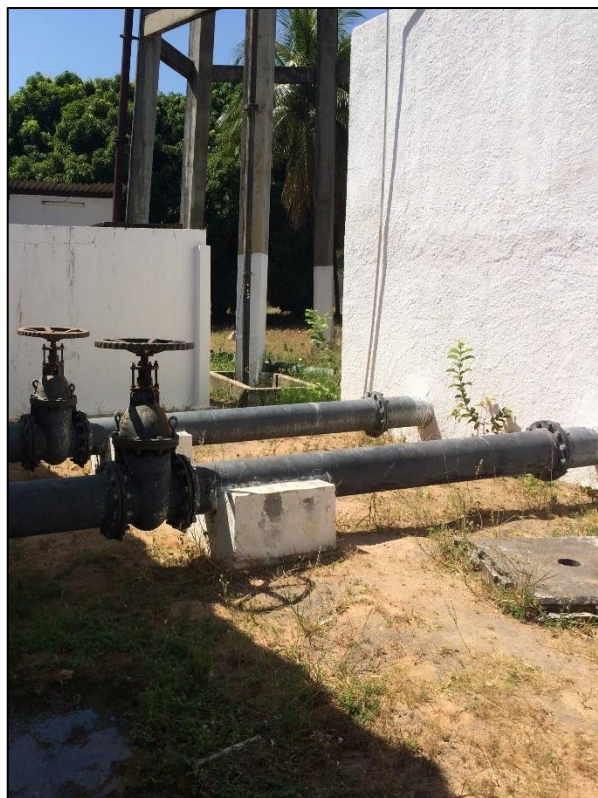
Figura 83 – Registros Estação elevatória de água tratada – EEAT Sistema Barragem Leste Fonte: DRZ – Geotecnologia e Consultoria, 2017.
