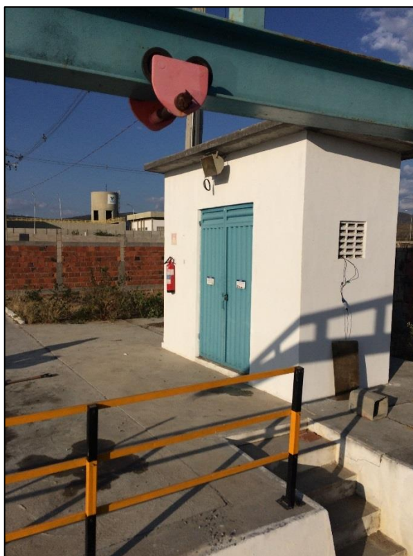
Figura 96 – Quadro de Comando Ponto de captação do Manancial (Canal de Transposição do Alto Sertão)
