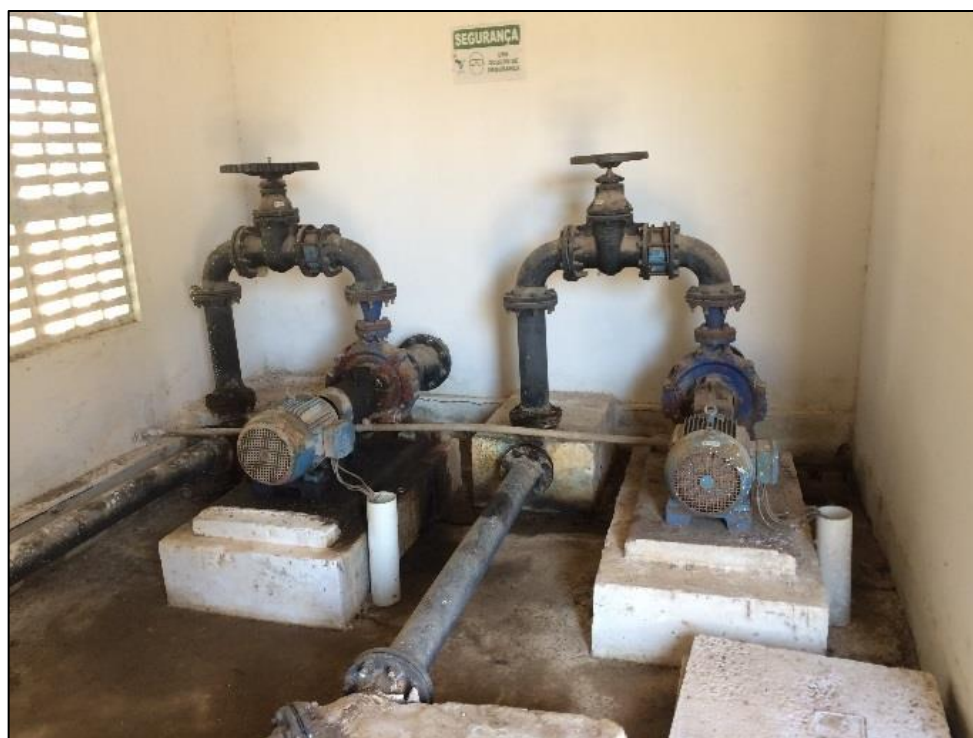
Figura 87 – Bombas EEAT de abastecimento do povoado de Jardim Cordeiro. Fonte: DRZ – Geotecnologia e Consultoria, 2017.
