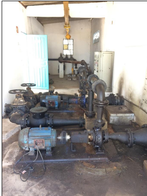
Figura 82 – Estação elevatória de água tratada – EEAT Sistema Barragem Leste Fonte: DRZ – Geotecnologia e Consultoria, 2017.
