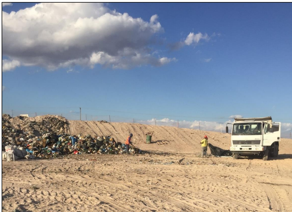
Figura 153 - Célula em operação. Fonte: DRZ – Geotecnologia e Consultoria, 2017.
