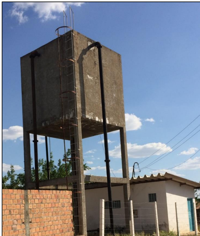
Figura 68 – Reservatório Elevado REL Povoado de Salgado. Fonte: DRZ – Geotecnologia e Consultoria, 2017.
