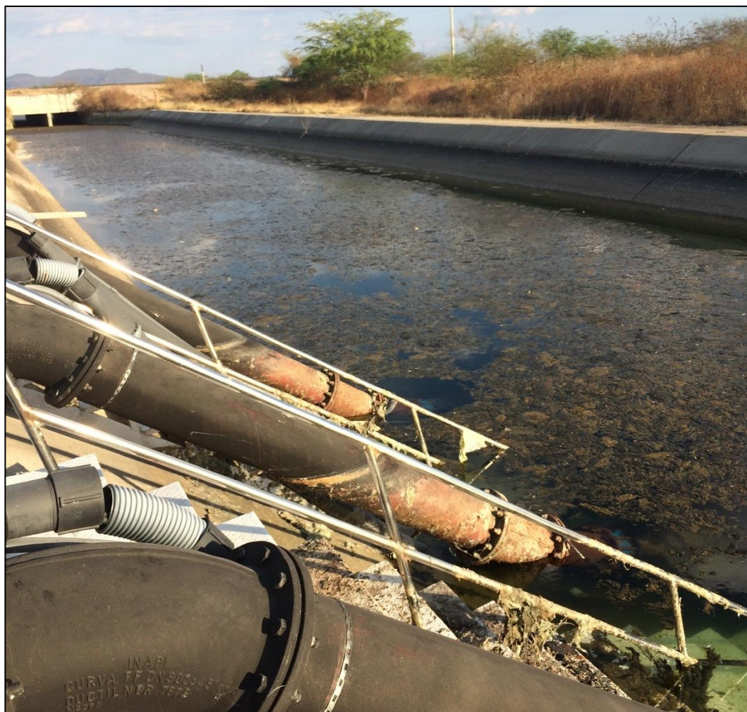
Figura 118 - Formação de algas no canal de captação. Fonte: DRZ – Geotecnologia e Consultoria, 2018.
