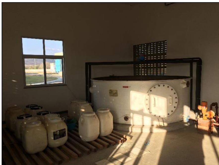
Figura 101 – Tanques para mistura rápida de produtos químicos. Fonte: DRZ – Geotecnologia e Consultoria, 2017.
