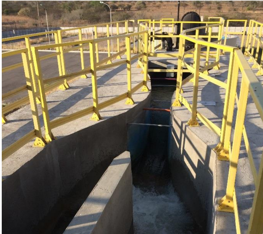
Figura 98 – Calha Parshall da ETA. Fonte: DRZ – Geotecnologia e Consultoria, 2017.
