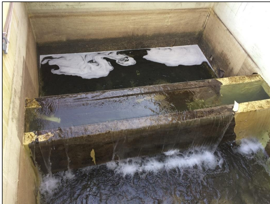
Figura 106 – Filtro da ETA Alto Sertão. Fonte: DRZ – Geotecnologia e Consultoria, 2017.
