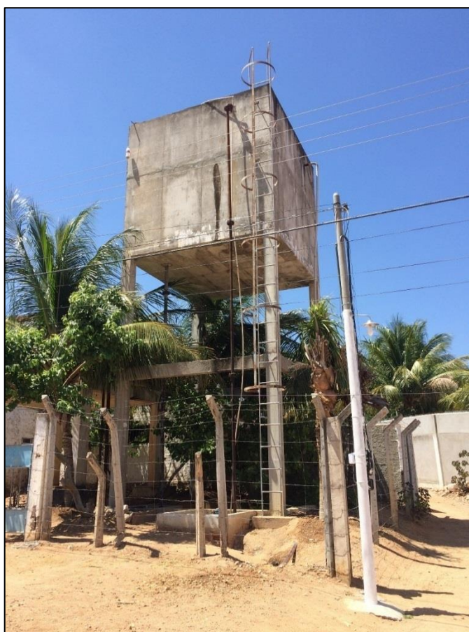
Figura 125 – REL 100 m 3 do povoado de São Sebastião.
