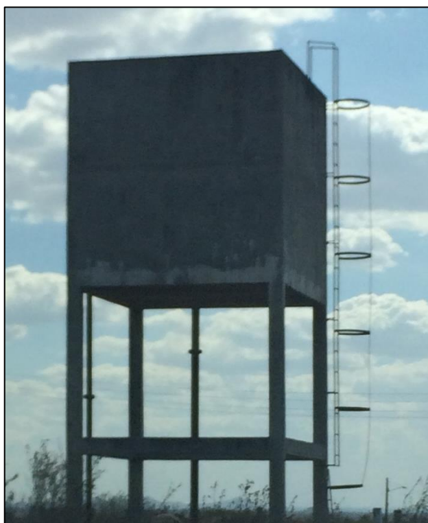
Figura 69 – Reservatório Elevado REL Povoado Cruz. Fonte: DRZ – Geotecnologia e Consultoria, 2017.
