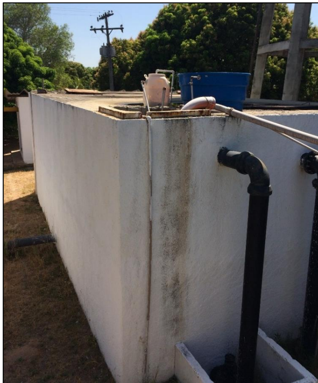
Figura 88 – Tanque de contato ETA Barragem Leste. Fonte: DRZ – Geotecnologia e Consultoria, 2017.
