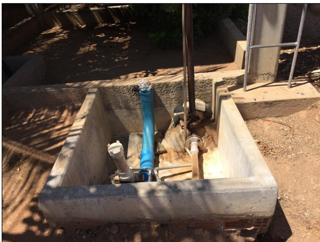
Figura 126 – Sistema de tratamento da água do povoado São Sebastião. Fonte: DRZ – Geotecnologia e Consultoria, 2017.
