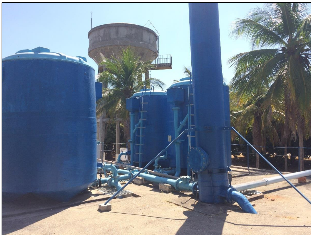
Figura 75 – Sistema de tratamento da água do distrito de Barragem Leste Fonte: DRZ – Geotecnologia e Consultoria, 2017.
