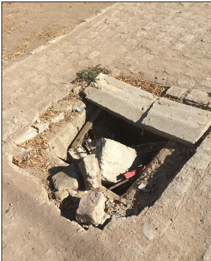
Figura 194 – Estrutura de captação de água pluvial danificada.
