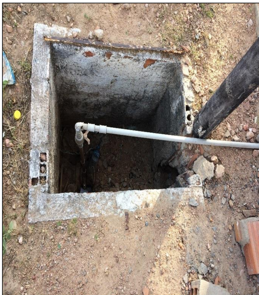
Figura 50 – Sistema de cloração por barrilha de Cloro. Fonte: DRZ – Geotecnologia e Consultoria, 2017.
