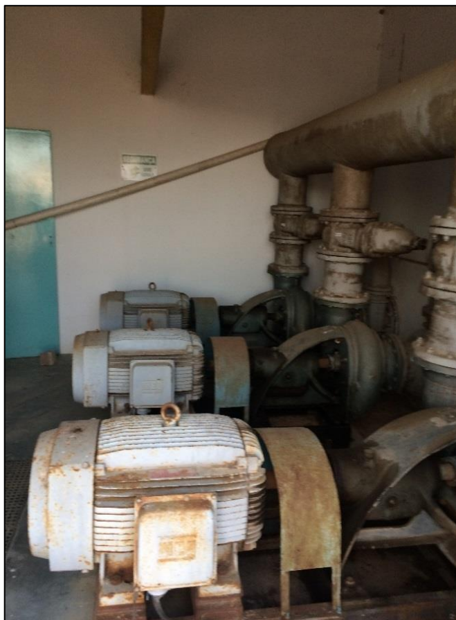
Figura 46 – Conjunto Motobomba para retrolavagem. Fonte: DRZ – Geotecnologia e Consultoria, 2017.
