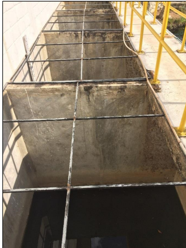
Figura 37 – Poço de captação. Fonte: DRZ – Geotecnologia e Consultoria, 2017.
