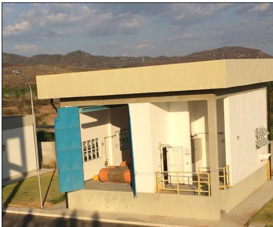
Figura 109 - Equipamentos de cloro gás e flúor. Fonte: DRZ – Geotecnologia e Consultoria, 2017.
