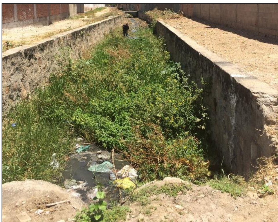
Figura 129 – Canal de drenagem com lançamento de esgoto da cidade. Fonte: DRZ – Geotecnologia e Consultoria, 2017.
