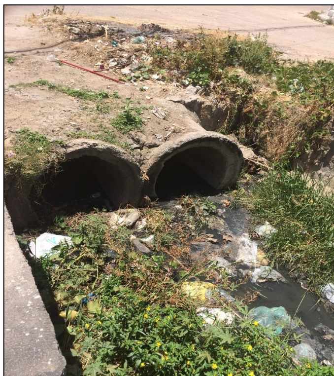
Figura 185– Manilha de concreto com saída para o canal de drenagem. Fonte: DRZ – Geotecnologia e Consultoria, 2017.
