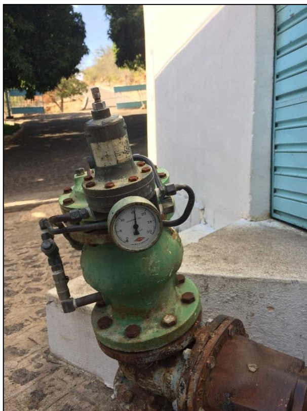
Figura 41 – Medidor de pressão EEAB do Salgado. Fonte: DRZ – Geotecnologia e Consultoria, 2017.
