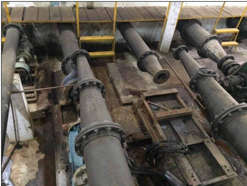
Figura 54 – Falta de conjunto moto bomba reserva.
