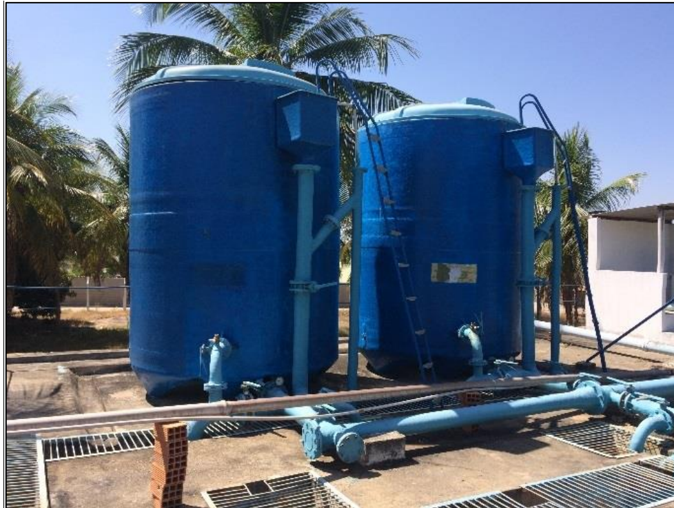
Figura 76 – Filtros - ETA Barragem Leste Fonte: DRZ – Geotecnologia e Consultoria, 2017
