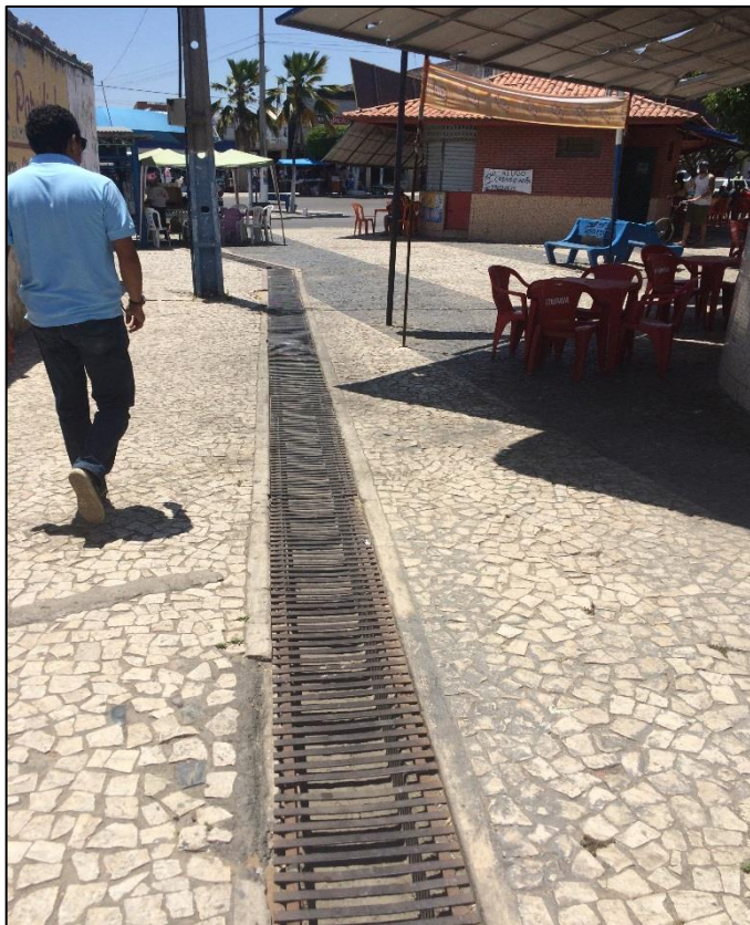
Figura 183 – Equipamento de drenagem na área central da cidade. Fonte: DRZ – Geotecnologia e Consultoria, 2017.
