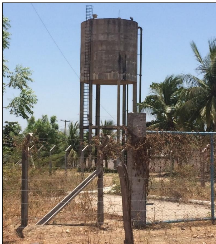
Figura 64 – R4: Reservatório Elevado Sistema Delmiro. Fonte: DRZ – Geotecnologia e Consultoria, 2017.
