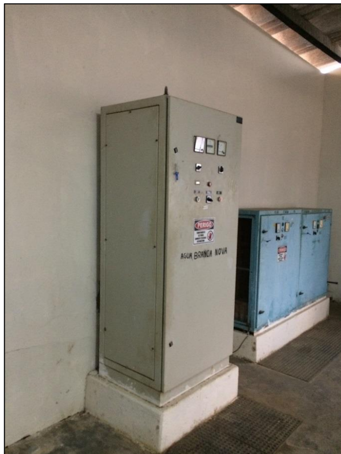
Figura 56 – Quadro de comando da EEAT. Fonte: DRZ – Geotecnologia e Consultoria, 2017.
