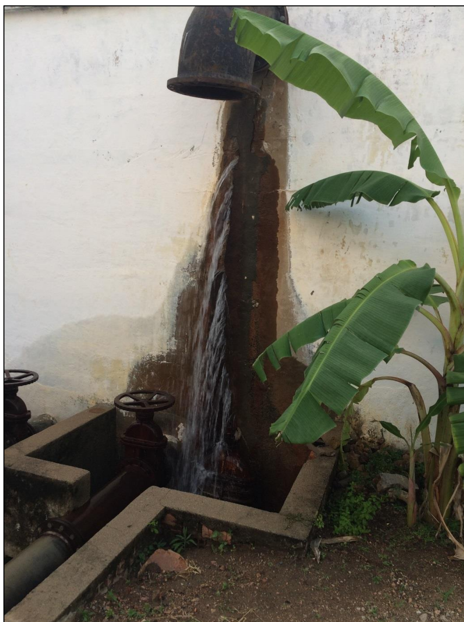
Figura 63 – Vazamento no Reservatório Apoiado da ETA Delmiro. Fonte: DRZ – Geotecnologia e Consultoria, 2017.
