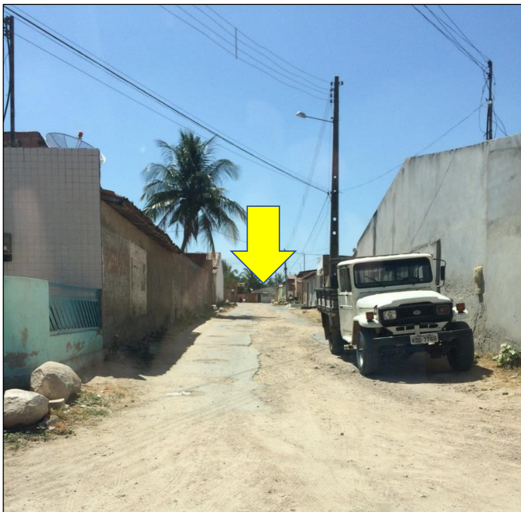
Figura 139 – Rede de esgoto instalada, sem reposição do pavimento.
