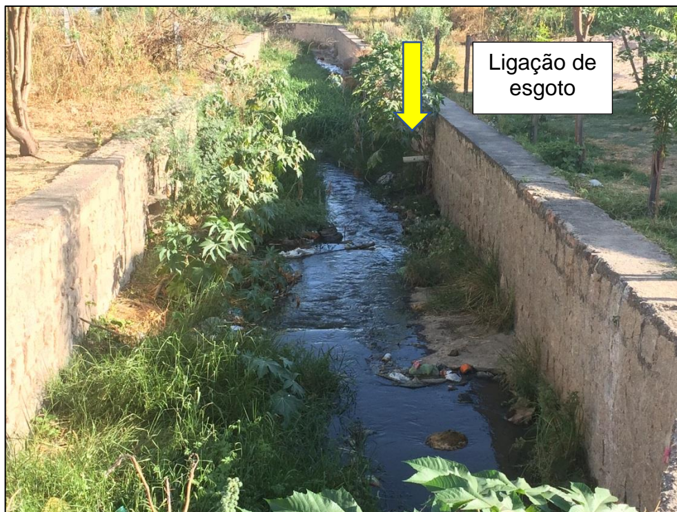
Figura 186 – Canal de drenagem com ligação de esgoto doméstico. Fonte: DRZ – Geotecnologia e Consultoria, 2017.
