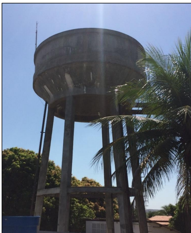
Figura 89 – Reservatório Elevado REL - ETA Barragem Leste Fonte: DRZ – Geotecnologia e Consultoria, 2017.
