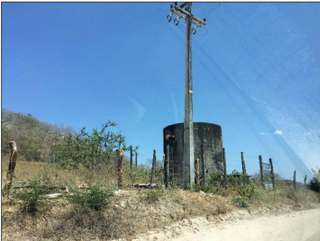
Figura 84 – Caixa de passagem - EEAT, Simimbú Fonte: DRZ – Geotecnologia e Consultoria, 2017.
