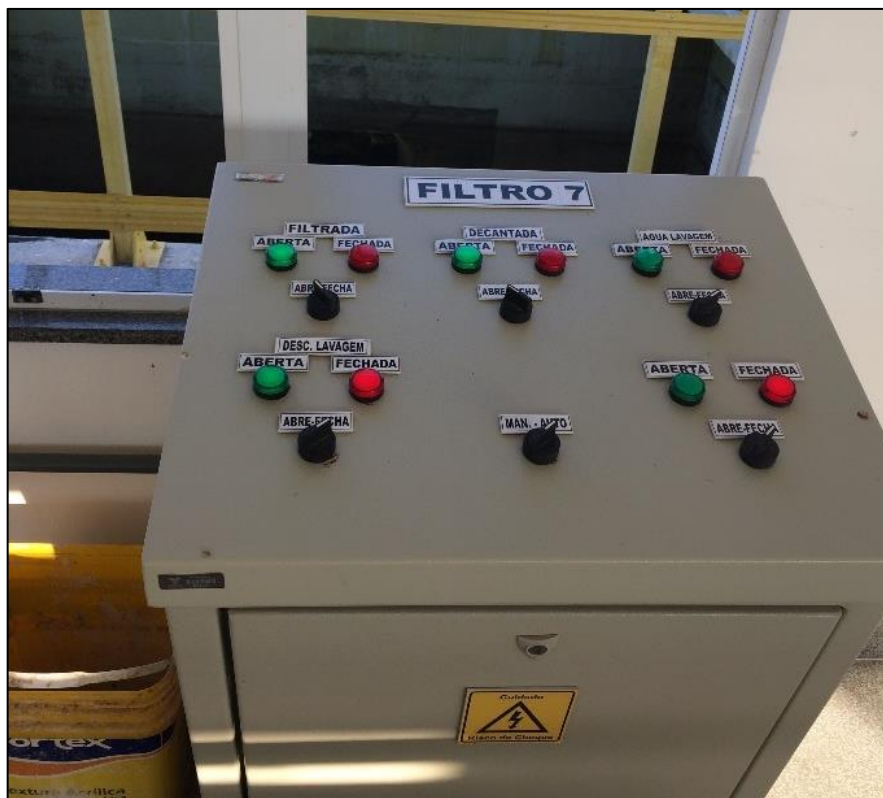
Figura 113 – equipamentos para automação do sistema. Fonte: DRZ – Geotecnologia e Consultoria, 2017.
