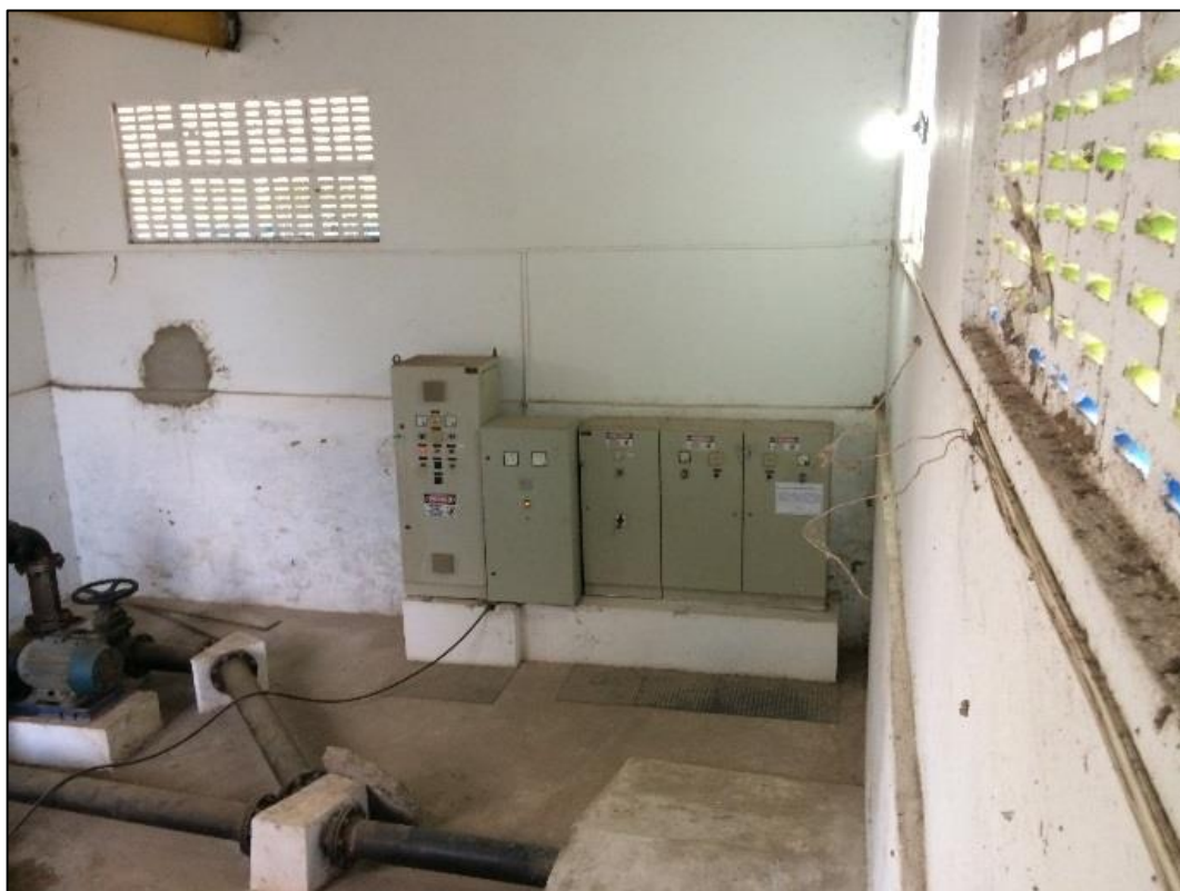
Figura 59 – EEAT da ETA Delmiro - 2. Fonte: DRZ – Geotecnologia e Consultoria, 2017.
