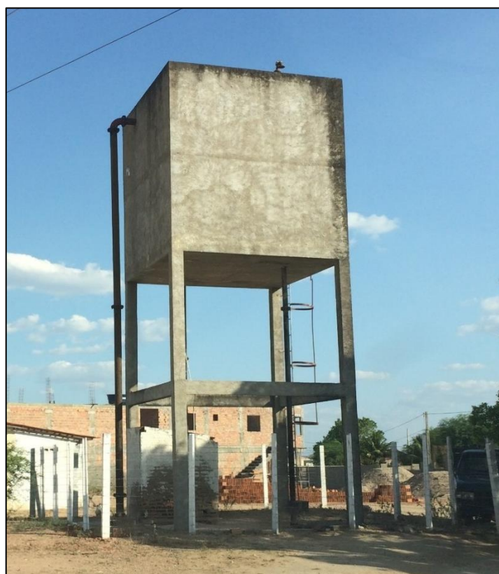
Figura 67 – Reservatório Elevado - REL Povoado de Lagoinha. Fonte: DRZ – Geotecnologia e Consultoria, 2017.
