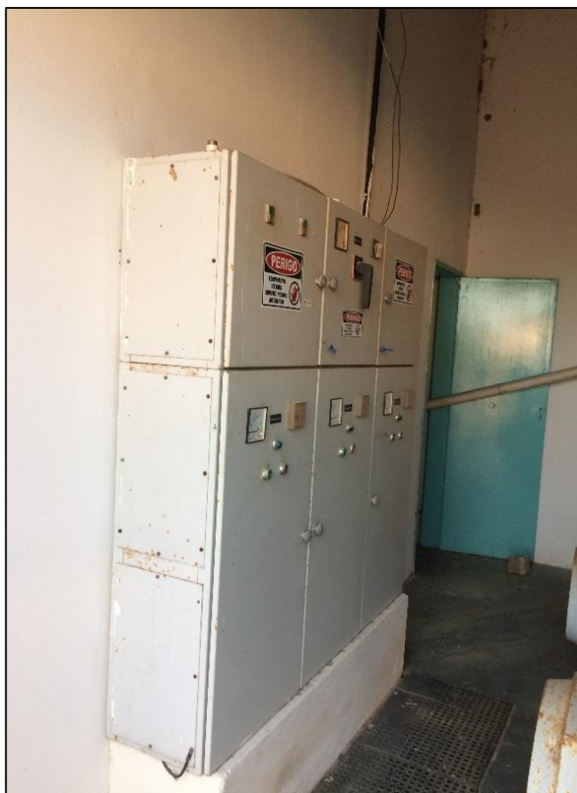
Figura 47 – Quadro de comando - Conjunto Motobomba. Fonte: DRZ – Geotecnologia e Consultoria, 2017.
