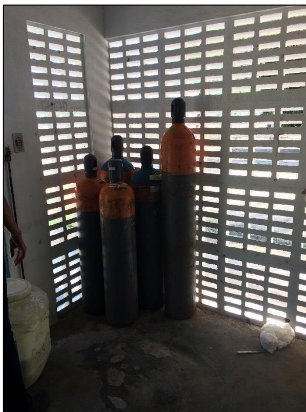
Figura 80 – Cilindros de cloro Gás da ETA Barragem Leste. Fonte: DRZ – Geotecnologia e Consultoria, 2017.
