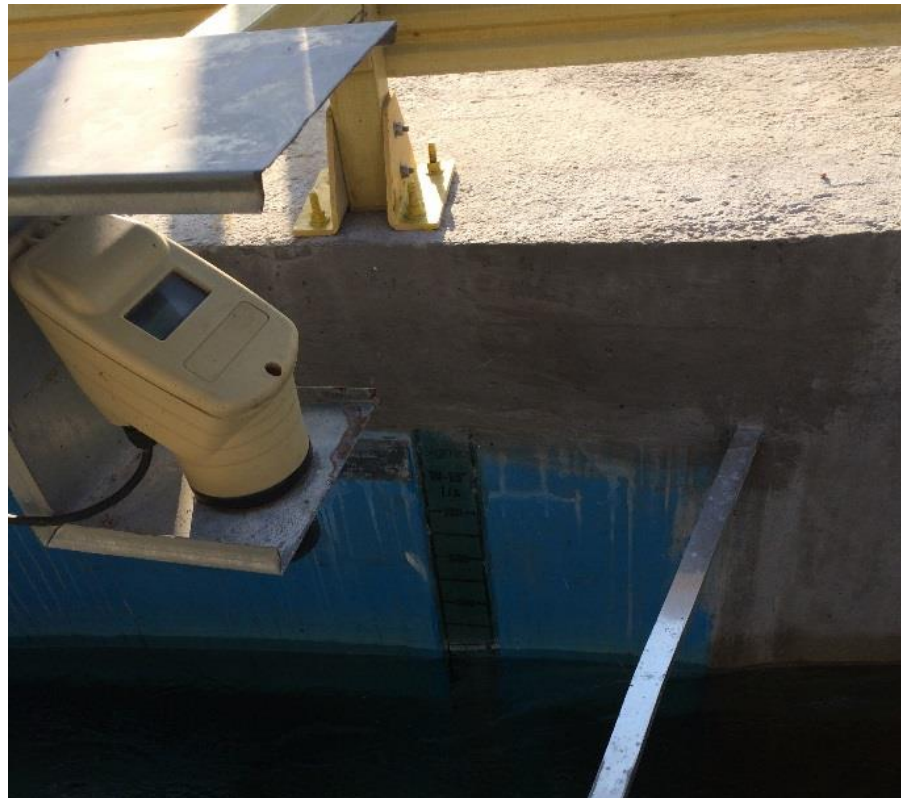
Figura 99 – Medidor de Vazão de entrada da ETA. Fonte: DRZ – Geotecnologia e Consultoria, 2017.
