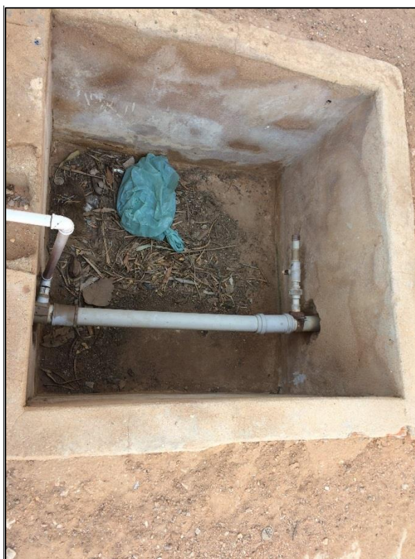
Figura 122 – Sistema de desinfecção do povoado São José. Fonte: DRZ – Geotecnologia e Consultoria, 2017.
