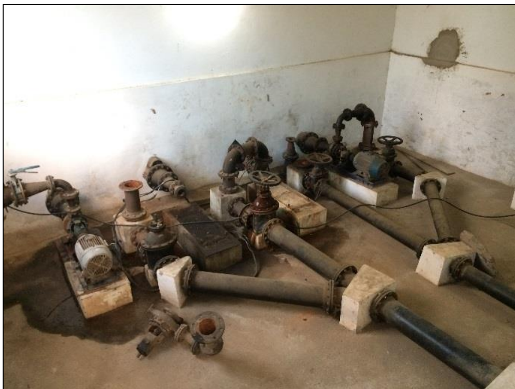
Figura 58 – EEAT da ETA Delmiro - 2. Fonte: DRZ – Geotecnologia e Consultoria, 2017.
