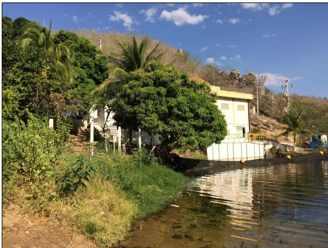
Figura 35 – Estação elevatória de água bruta do Sistema Delmiro Gouveia. Fonte: DRZ – Geotecnologia e Consultoria, 2017.
