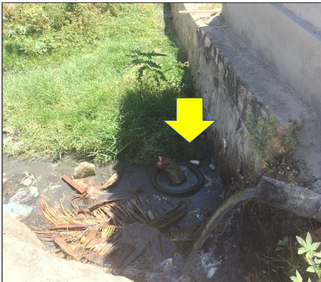
Figura 136 – Ligações de esgoto doméstico na rede pluvial.
