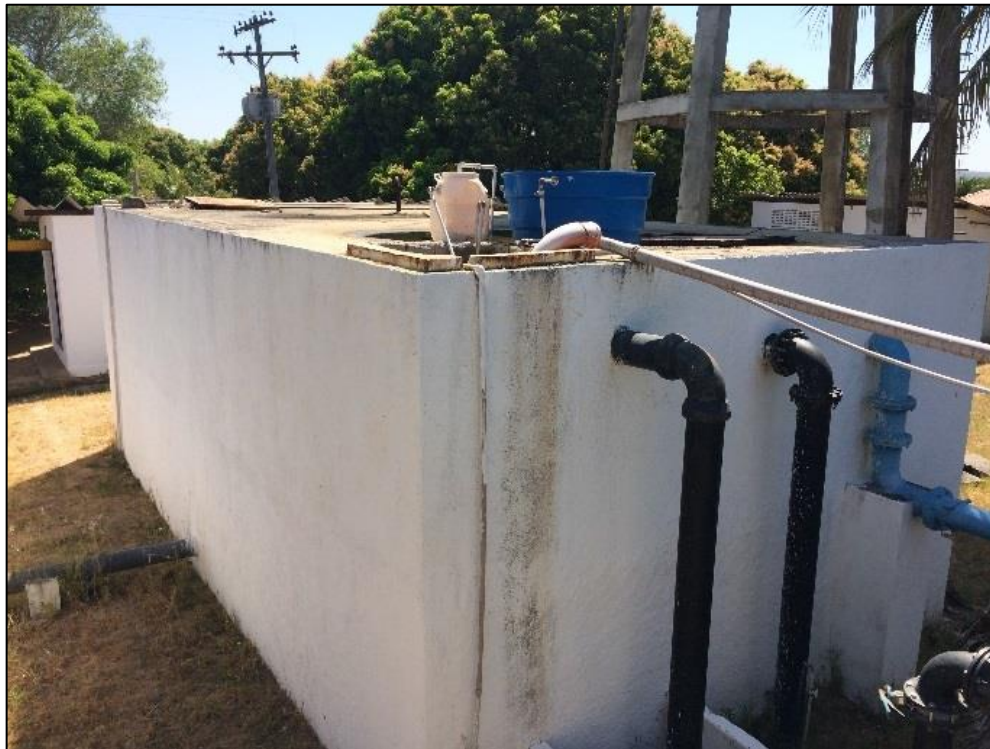
Figura 78 – Tanque de contato - ETA Barragem Leste Fonte: DRZ – Geotecnologia e Consultoria, 2017
