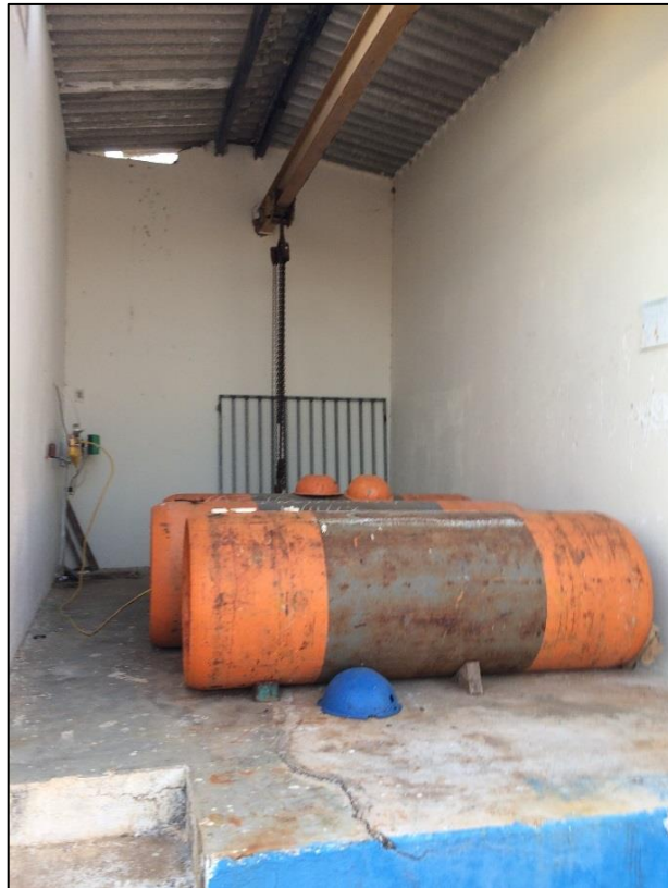
Figura 48 – Cilindros de cloro gás. Fonte: DRZ – Geotecnologia e Consultoria, 2017.
