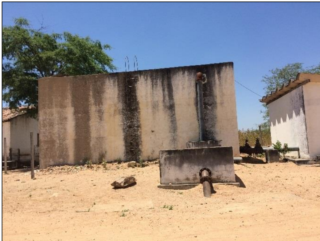
Figura 85 – Estação Elevatória de Água Tratada - EEAT, Simimbú Fonte: DRZ – Geotecnologia e Consultoria, 2017.
