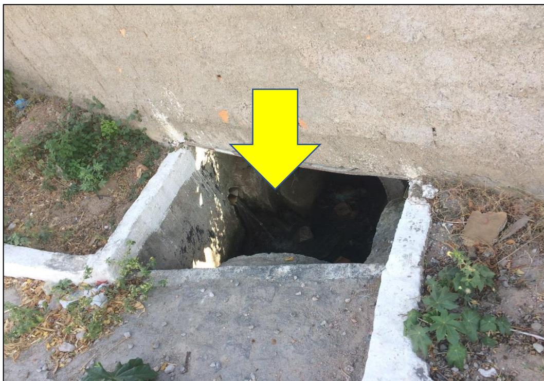
Figura 182 – Lançamento de efluente de esgoto doméstico em rede de drenagem.
