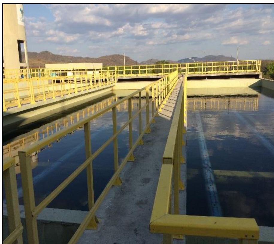
Figura 105 – Decantadores da ETA Alto Sertão.
