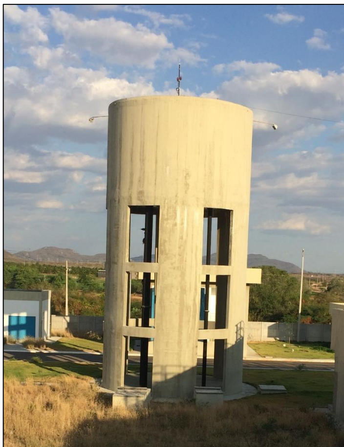
Figura 116 – REL 100 m 3 ETA Alto Sertão (retro lavagem). Fonte: DRZ – Geotecnologia e Consultoria, 2017.
