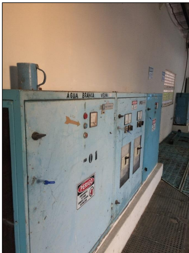
Figura 52 – Quadro de comando EEAT da ETA Sistema. Delmiro. Fonte: DRZ – Geotecnologia e Consultoria, 2017.
