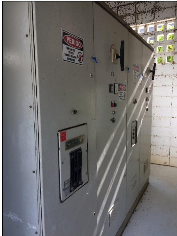
Figura 39 – Quadro de comando. Fonte: DRZ – Geotecnologia e Consultoria, 2017.
