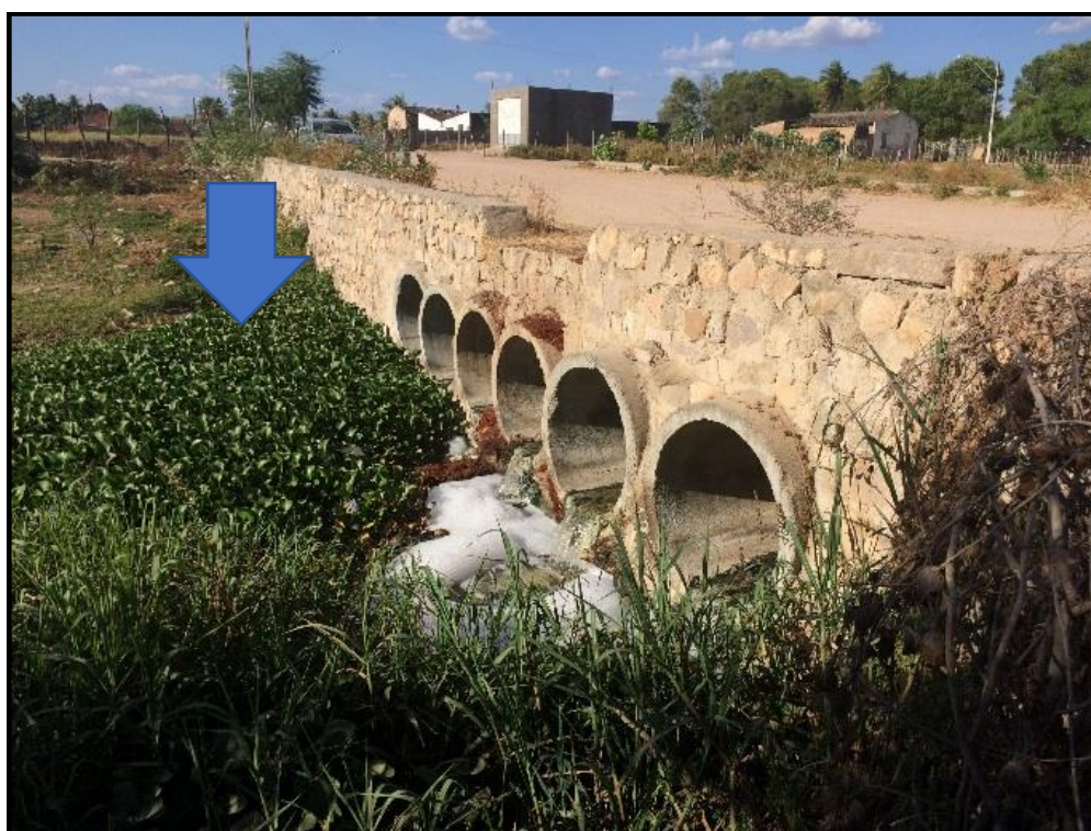
Figura 133 – Lançamento de efluente de esgoto em rede de drenagem. Fonte: DRZ – Geotecnologia e Consultoria, 2017.
