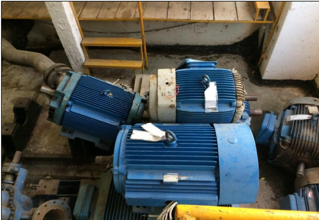
Figura 55 – Bombas da EEAT. Fonte: DRZ – Geotecnologia e Consultoria, 2017.
