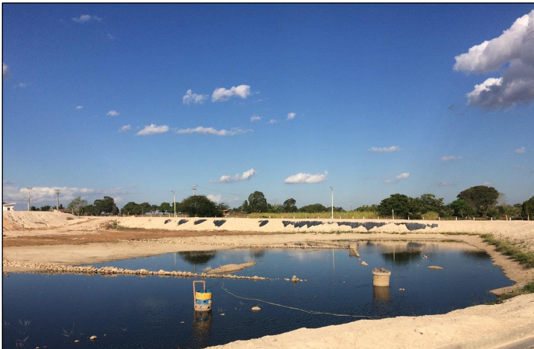
Figura 154 – Drenos de gás em local com acúmulo de água da chuva. Fonte: DRZ – Geotecnologia e Consultoria, 2017.
