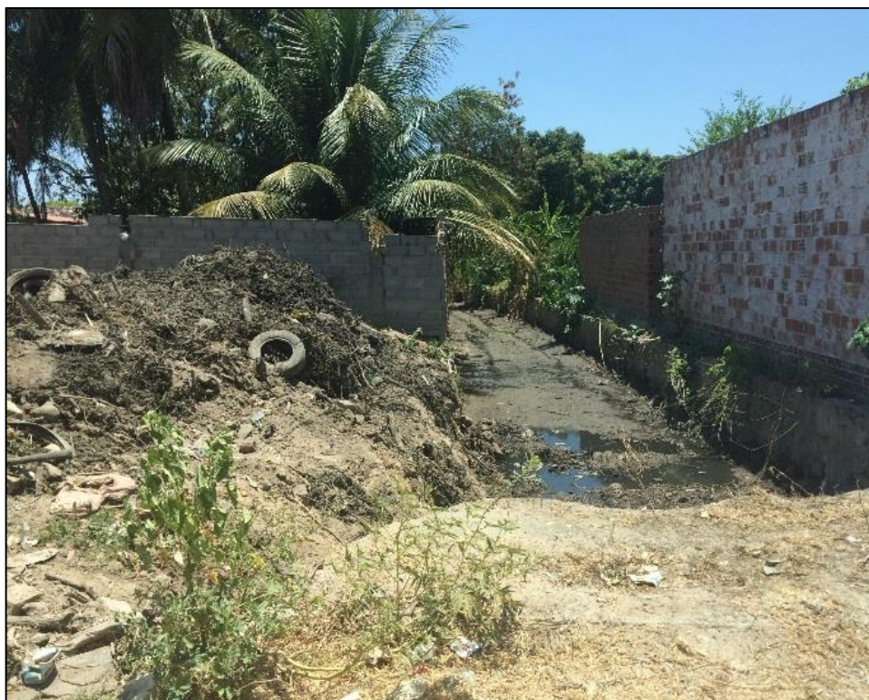
Figura 128 – Canal de drenagem com acúmulo de lixo. Fonte: DRZ – Geotecnologia e Consultoria, 2017.
