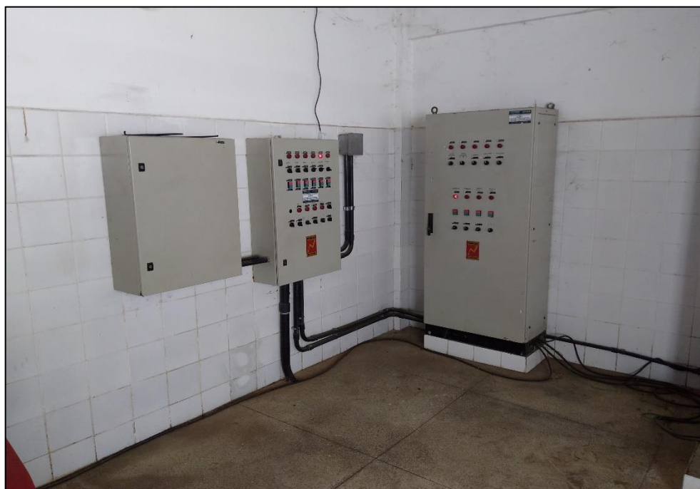
Figura 66 – Quadro de comandos da ETA. Fonte: DRZ – Geotecnologia e Consultoria, 2017.
