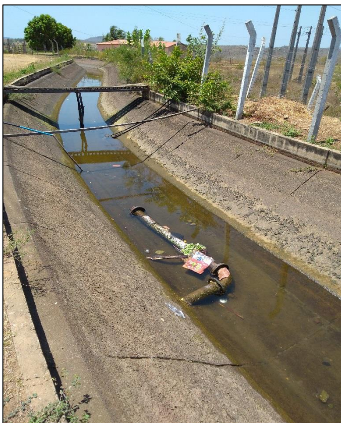
Figura 36 – Tubulação de captação da água no canal do Projeto Califórnia. Fonte: DRZ Geotecnologia e Consultoria, 2017.
