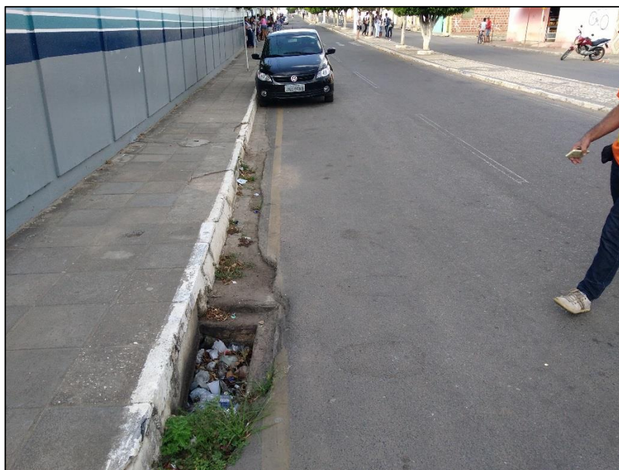
Figura 207 – Boca de lobo entupida com resíduos sólidos. Fonte: DRZ – Geotecnologia e Consultoria, 2017.
