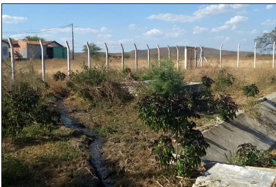
Figura 149 – Lançamento irregular de esgoto próximo ao sistema coletivo de tratamento no Povoado Capim Grosso. Fonte: DRZ – Geotecnologia e Consultoria, 2017.
