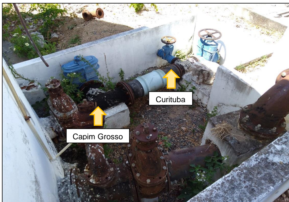
Figura 81 – Sistema de bombeamento para os povoados Capim Grosso e Curituba.
