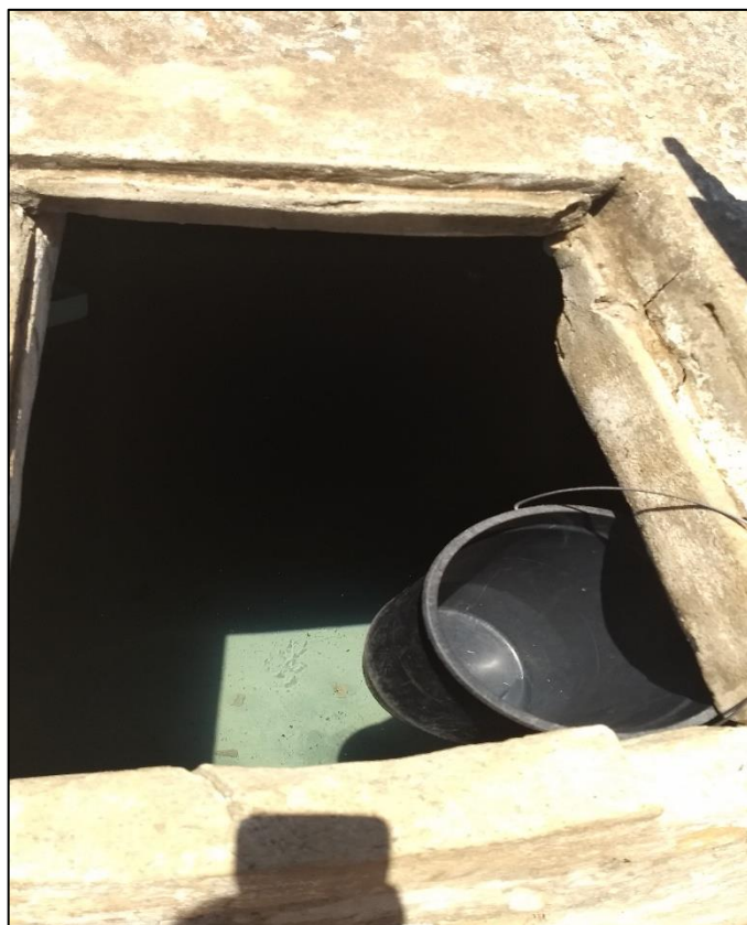
Figura 105 – Água armazenada na cisterna. Fonte: DRZ – Geotecnologia e Consultoria, 2017.
