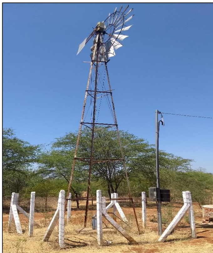
Figura 101 – Poço do Programa Água Doce no Assentamento Mandacaru. Fonte: DRZ – Geotecnologia e Consultoria, 2017.
