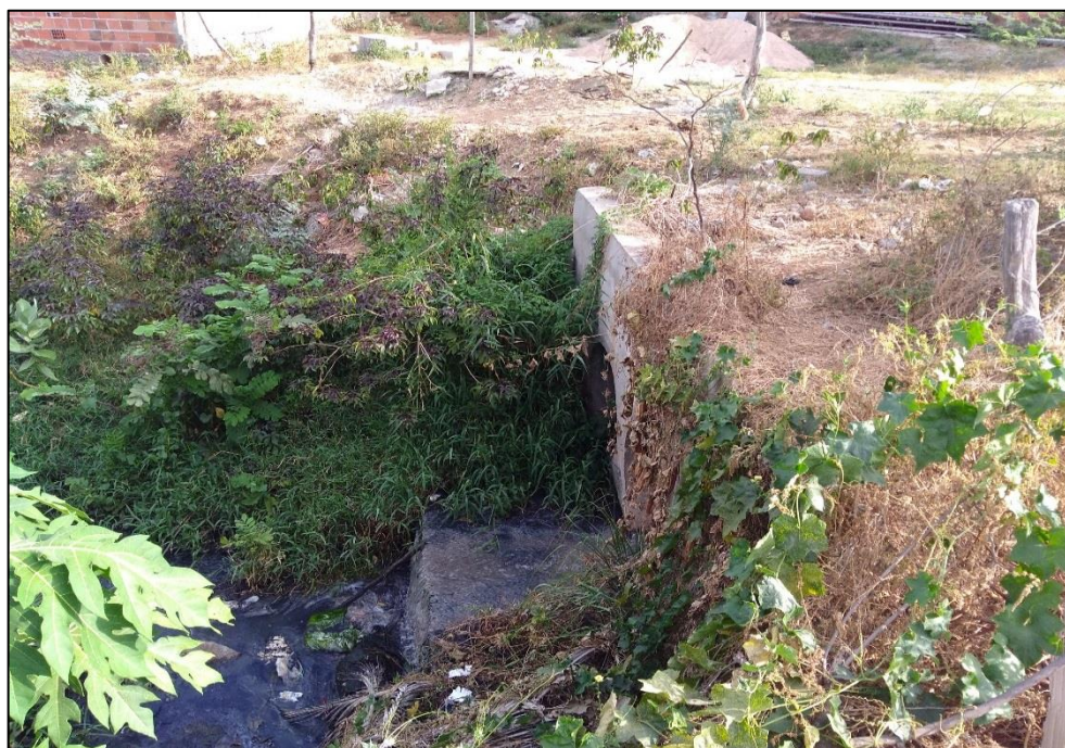
Figura 193 – Lançamento de efluente de esgoto doméstico em rede de drenagem.
