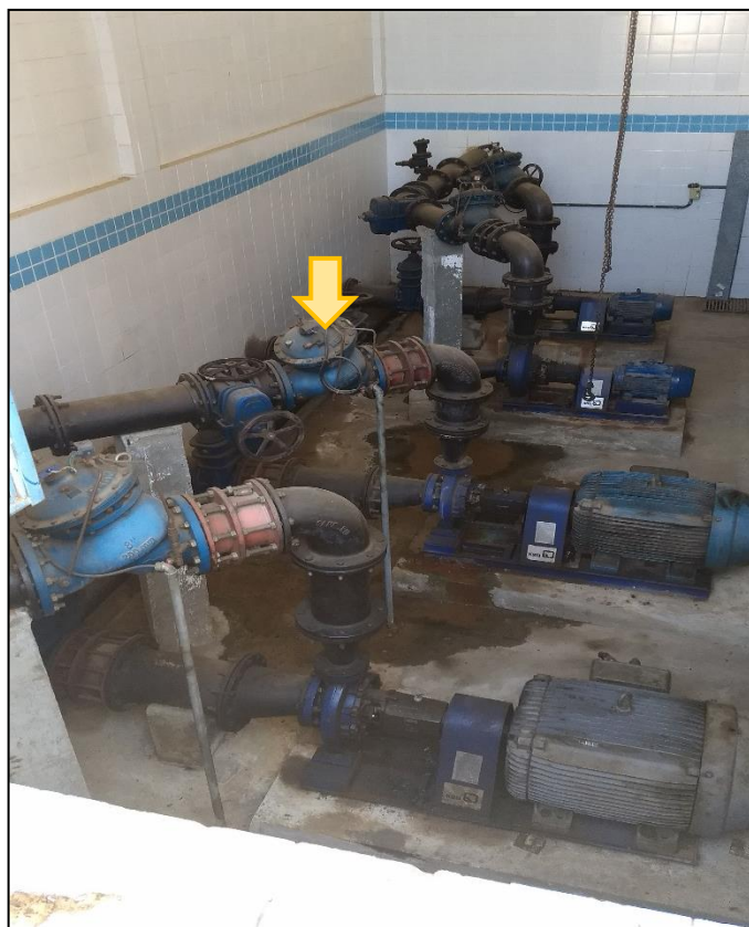
Figura 76 – Estação Elevatória Água Tratada (EEAT) localizada na ETA. Fonte: DRZ Geotecnologia e Consultoria, 2017.
