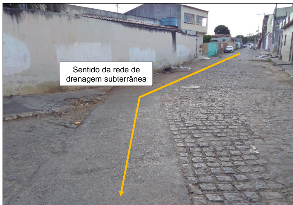
Figura 194 – Rede de drenagem subterrânea em Canindé de São Francisco. Fonte: DRZ – Geotecnologia e Consultoria, 2017.
