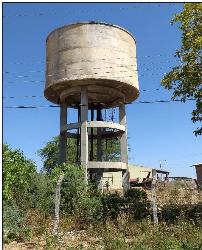
Figura 99 – Reservatório elevado (REL) do povoado Curitiba. Fonte: DRZ – Geotecnologia e Consultoria, 2017.
