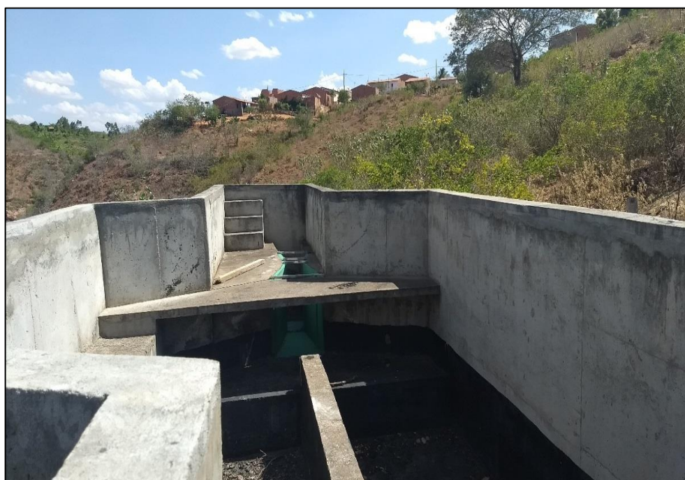
Figura 138 – Calha Parshall e desarenador da ETE I.
