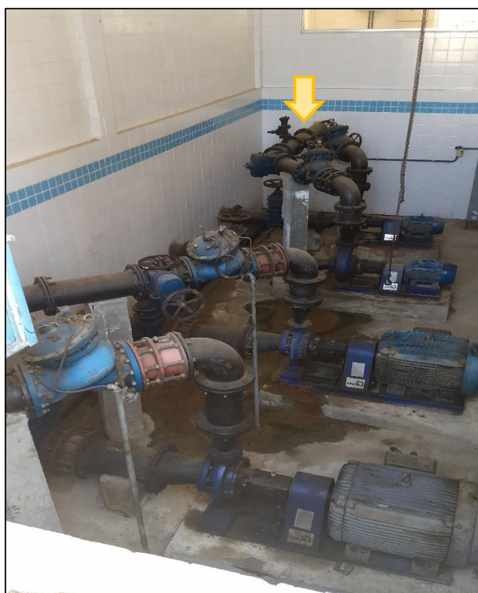
Figura 44 – Estação Elevatória de Água Tratada (EEAT): área urbana. Fonte: DRZ Geotecnologia e Consultoria, 2017.
