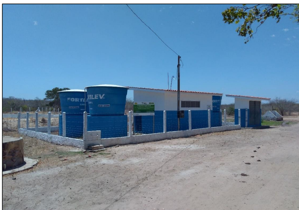
Figura 109 – Sistema de dessalinização do Programa Água Doce no Assentamento 12 de Março. Fonte: DRZ – Geotecnologia e Consultoria, 2017.
