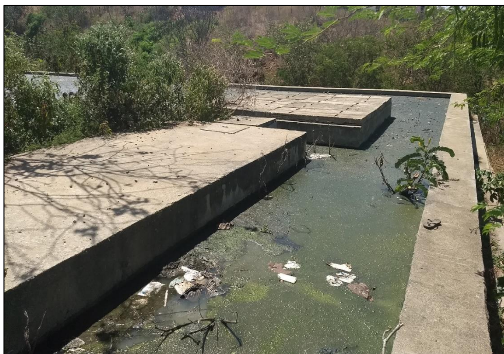
Figura 144 – Sistema de tratamento de esgoto da ETE II. Fonte: DRZ – Geotecnologia e Consultoria, 2017.
