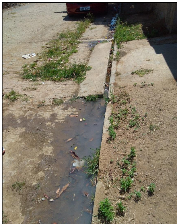
Figura 155 – Acúmulo de efluente doméstico próximo à entrada das residências no Povoado Curituba. Fonte: DRZ – Geotecnologia e Consultoria, 2017.
