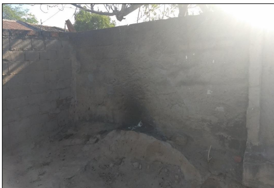
Figura 172 – Exemplo de queima de resíduos na comunidade Nova Vida. Fonte: DRZ – Geotecnologia e Consultoria, 2017.
