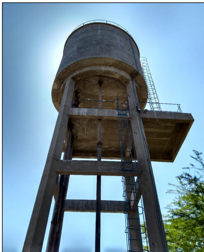
Figura 85 – Reservatório Elevado (REL) inoperante da EEAT Capim Grosso, 200 m 3 .
