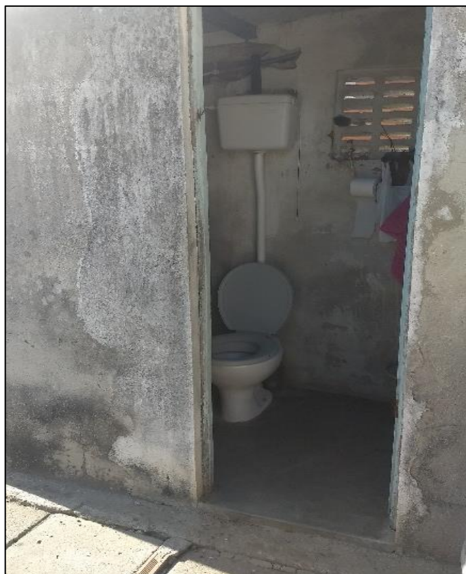
Figura 159 – Exemplo de banheiro na comunidade Nova Vida. Fonte: DRZ – Geotecnologia e Consultoria, 2017.
