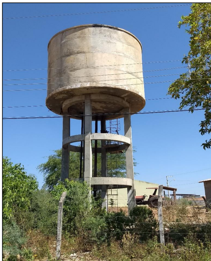
Figura 89 – Reservatório Elevado (REL) do Povoado Curituba, 100 m 3 . Fonte: DRZ Geotecnologia e Consultoria, 2017.
