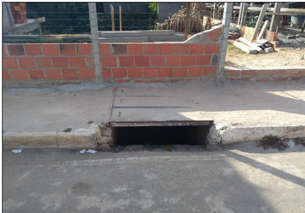
Figura 191 – Boca de lobo lateral sem grade. Fonte: DRZ – Geotecnologia e Consultoria, 2017.
