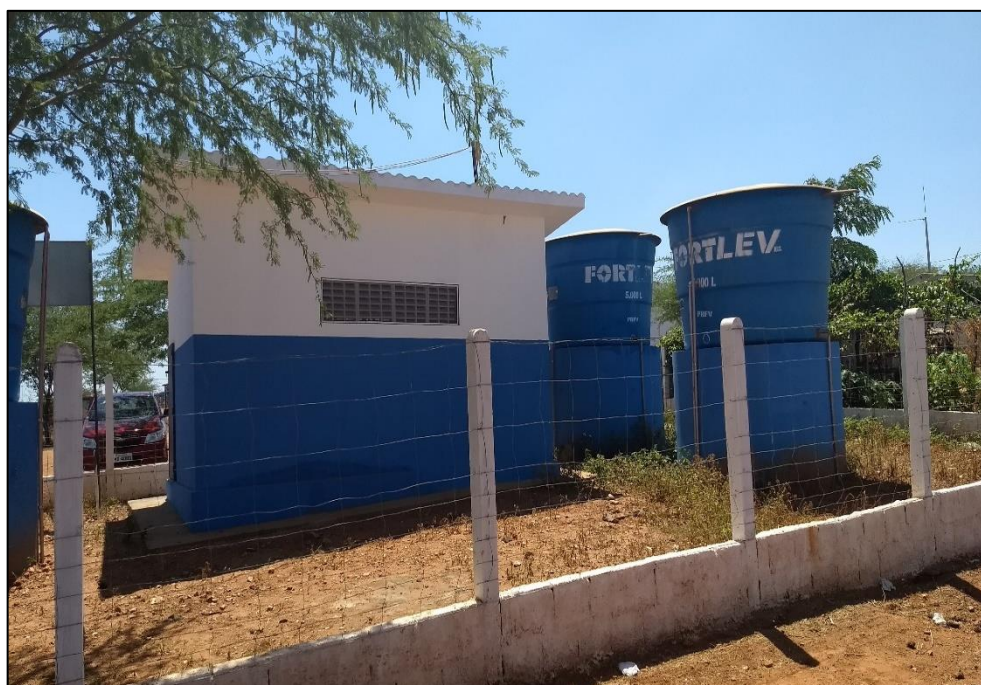
Figura 102 – Sistema do dessalinizador do Programa Água Doce no Assentamento Mandacaru. Fonte: DRZ – Geotecnologia e Consultoria, 2017.
