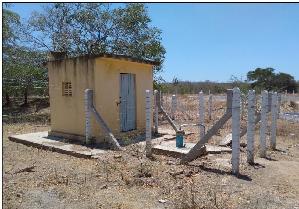
Figura 108 – Poço de captação de água subterrânea. Fonte: DRZ – Geotecnologia e Consultoria, 2017.
