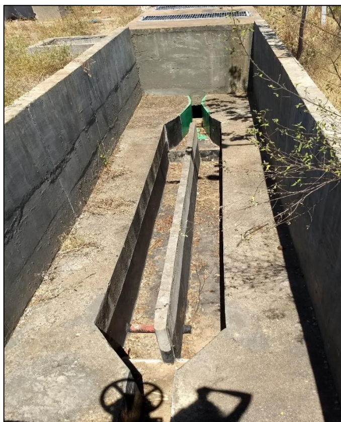
Figura 136 – Calha Parshall e desarenador da EEE II. Fonte: DRZ – Geotecnologia e Consultoria, 2017.
