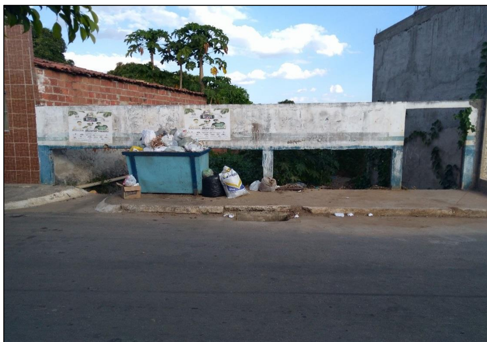
Figura 195 – Ponto de lançamento de rede de drenagem no Riacho das Onças. Fonte: DRZ – Geotecnologia e Consultoria, 2017.
