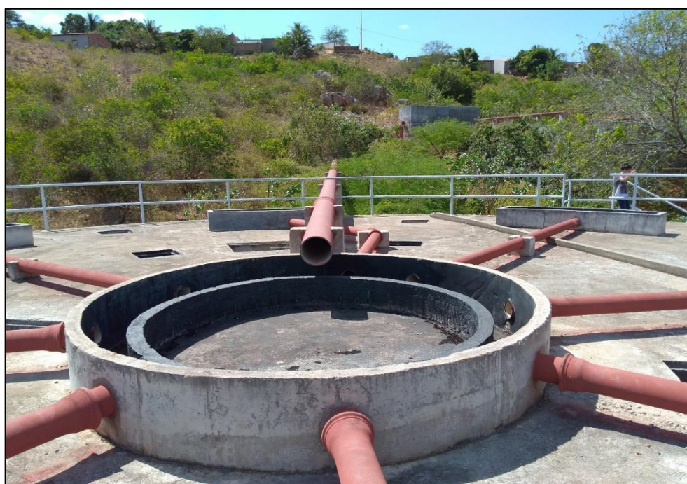
Figura 140 – Módulo do reator UASB Fonte: DRZ – Geotecnologia e Consultoria, 2017.
