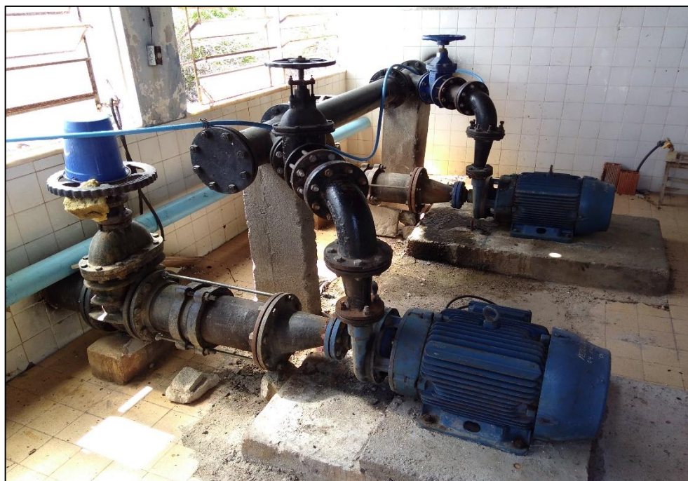
Figura 79 – Conjuntos motobombas da EEAT Pedra D'Água. Fonte: DRZ Geotecnologia e Consultoria, 2017.
