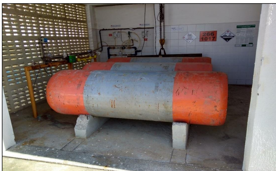
Figura 56 – Cilindros de cloro gás. Fonte: DRZ – Geotecnologia e Consultoria, 2017.
