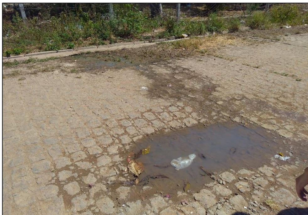
Figura 154 – Acúmulo de efluente doméstico nas ruas do Povoado Curituba.
