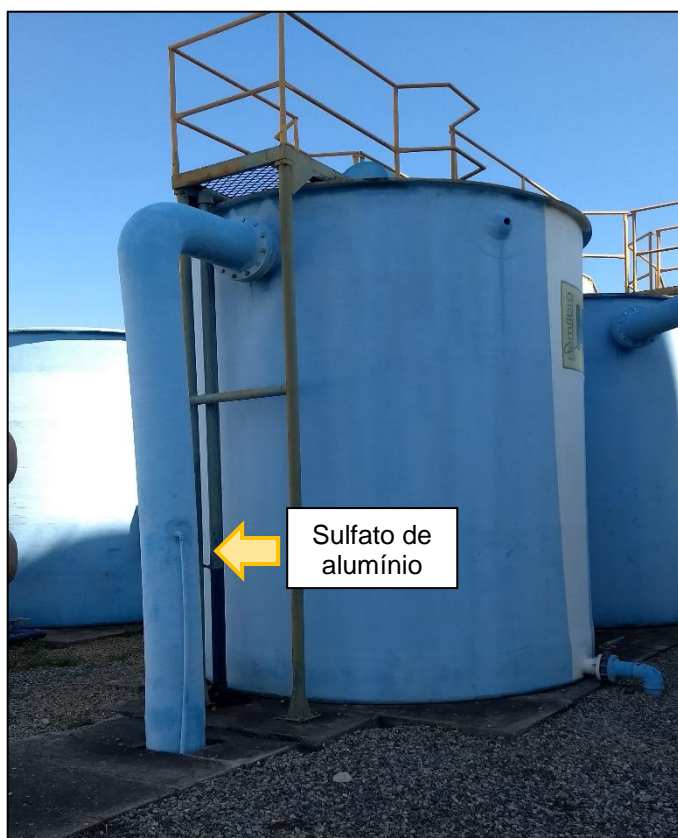
Figura 48 – Entrada da água bruta na ETA. Fonte: DRZ – Geotecnologia e Consultoria, 2017.
