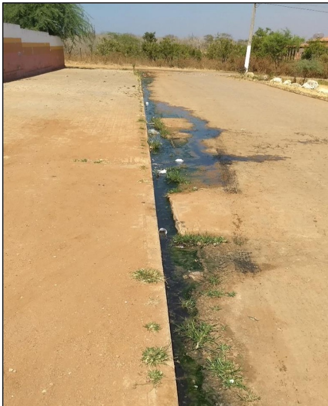
Figura 158 – Lançamento inadequado da água residual gerada nas residências do Assentamento Cuiabá.
