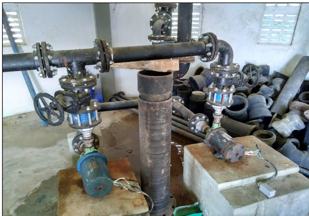
Figura 84 – Conjuntos motobombas da EEAT Capim Grosso. Fonte: DRZ Geotecnologia e Consultoria, 2017.
