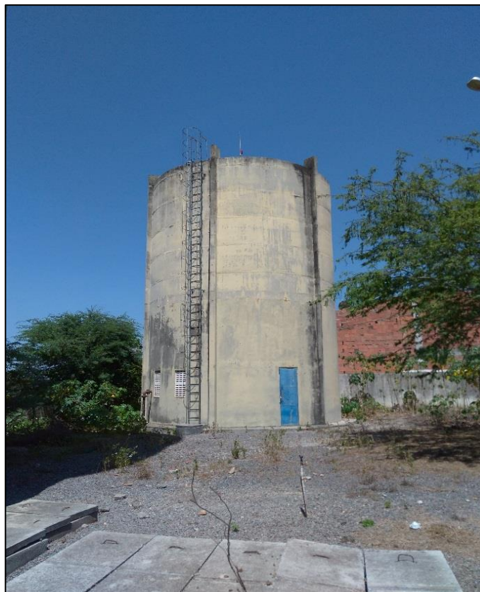
Figura 98 – Reservatório apoiado (RAP) da comunidade Capim Grosso. Fonte: DRZ – Geotecnologia e Consultoria, 2017.
