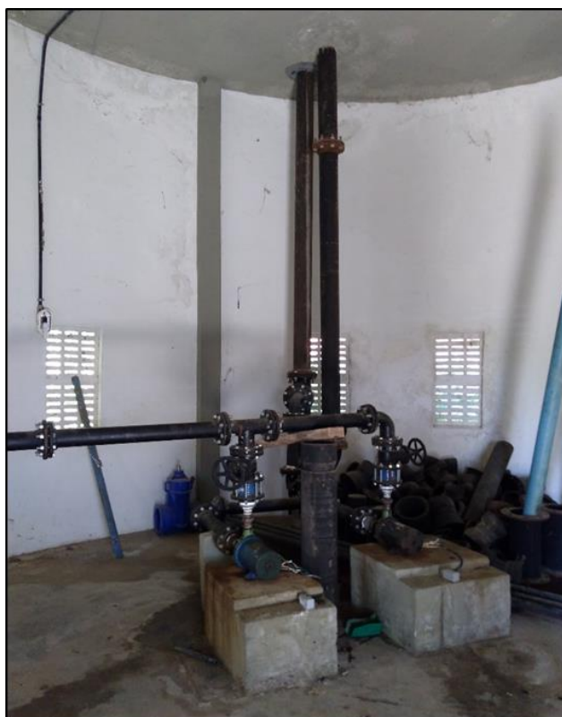
Figura 83 – Estação Elevatória de Água Tratada Capim Grosso. Fonte: DRZ Geotecnologia e Consultoria, 2017.
