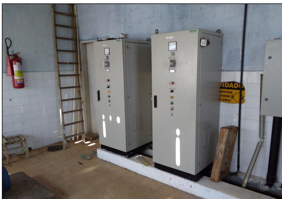
Figura 80 – Quadro de comandos da EEAT Pedra D'Água. Fonte: DRZ Geotecnologia e Consultoria, 2017.
