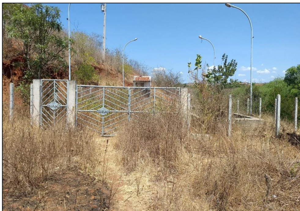
Figura 134 – Estação Elevatória de Esgoto II (EEE II). Fonte: DRZ – Geotecnologia e Consultoria, 2017.
