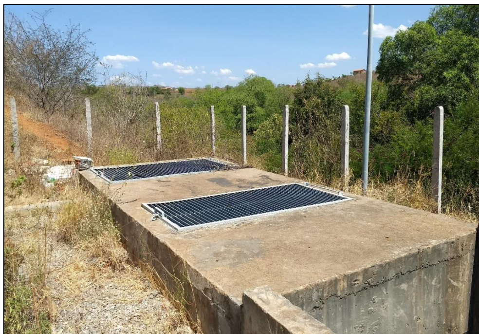
Figura 135 – Gradeamento da EEE II. Fonte: DRZ – Geotecnologia e Consultoria, 2017.
