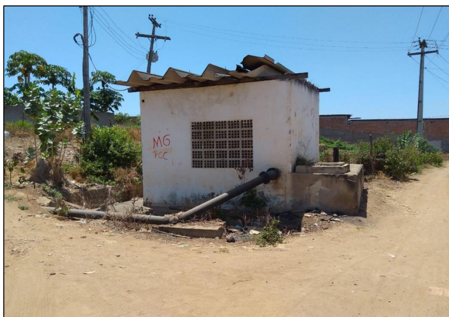
Figura 43 – Estação Elevatória de Água Bruta (EEAB) da água captada no canal do Projeto Califórnia.
