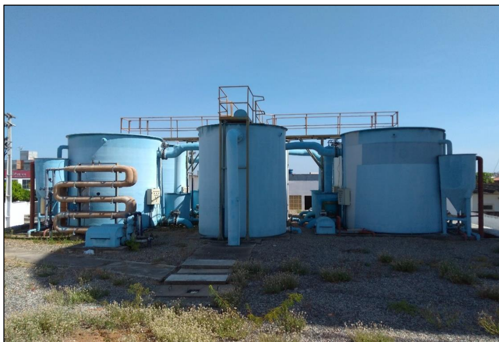
Figura 47 – Estação de Tratamento de Água I. Fonte: DRZ – Geotecnologia e Consultoria, 2017.
