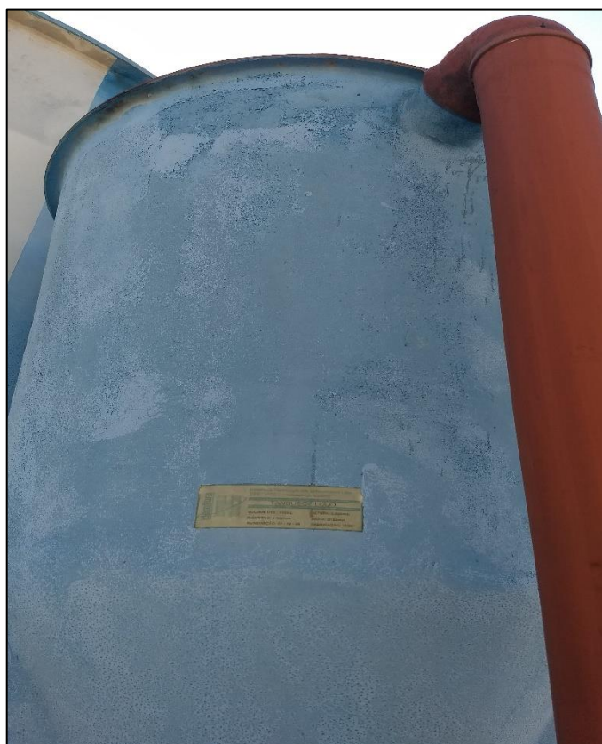
Figura 52 – Tanque de lodo. Fonte: DRZ – Geotecnologia e Consultoria, 2017.
