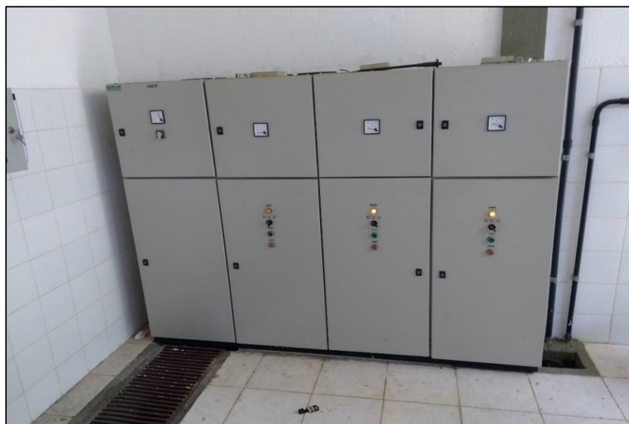
Figura 42 – Quadro de comandos da EEAB da água captada no lago da Usina Xingó.
