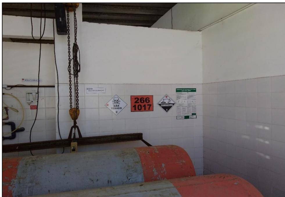
Figura 57 – Instruções de manuseio e identificação de riscos na sala de aplicação do cloro.
