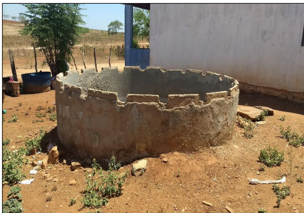
Figura 106 – Cisterna com estrutura danificada no Assentamento Mandacaru. Fonte: DRZ – Geotecnologia e Consultoria, 2017.
