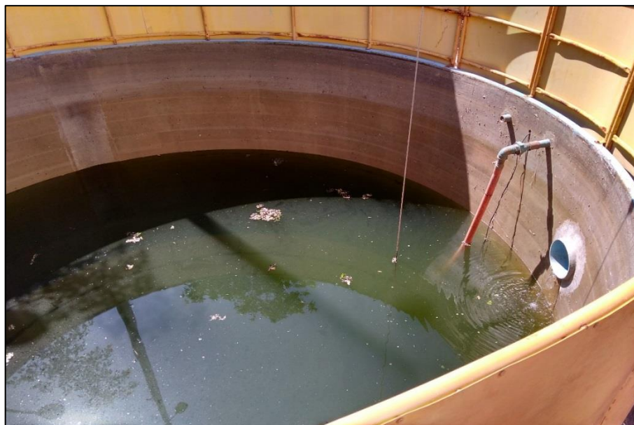
Figura 61 – Tanque de recirculação da água de lavagem dos filtros. Fonte: DRZ – Geotecnologia e Consultoria, 2017.
