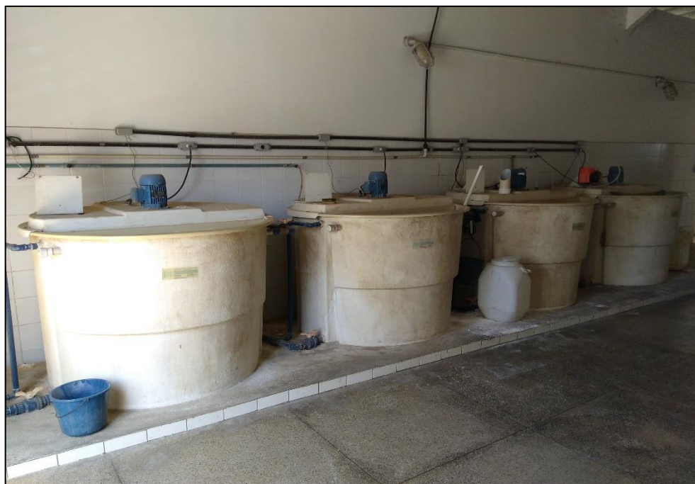
Figura 58 – Sala de dosagem.
