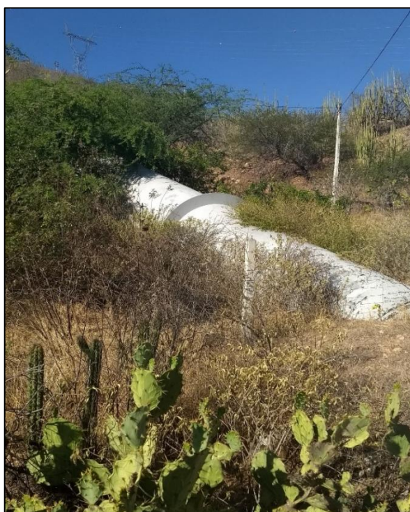
Figura 38 – Adutora de Água Bruta (AAB) do lago da Usina Xingó. Fonte: DRZ Geotecnologia e Consultoria, 2017.
