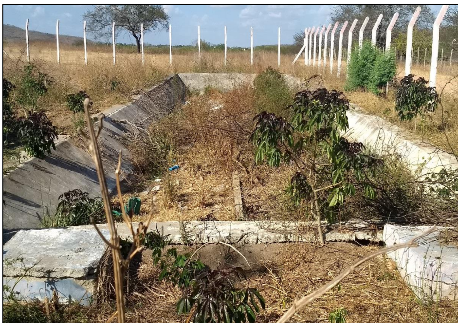
Figura 148 – Estrutura inutilizada do sistema de tratamento de esgoto. Fonte: DRZ – Geotecnologia e Consultoria, 2017.
