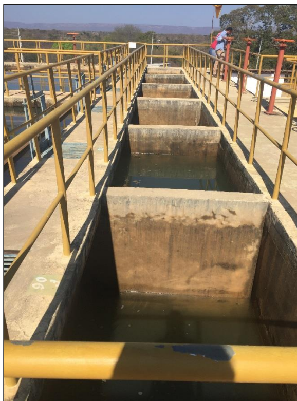
Figura 34 – Filtros da ETA – distrito Sede. Fonte: DRZ – Geotecnologia e Consultoria, 2017.
