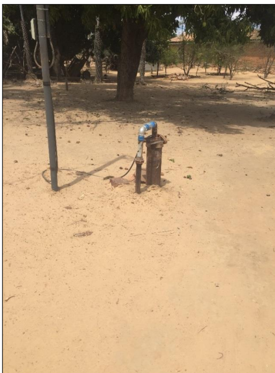
Figura 66 – Poço de captação – Comunidade de Caraíbas.
