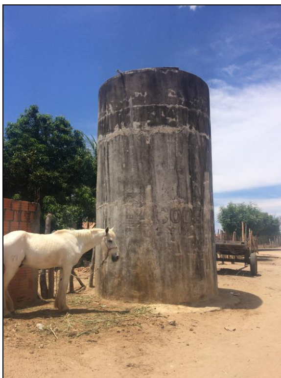
Figura 54 – RAP 15 m 3 (Desativado) – distrito de Boa Vista Lagamar. Fonte: DRZ – Geotecnologia e Consultoria, 2017.
