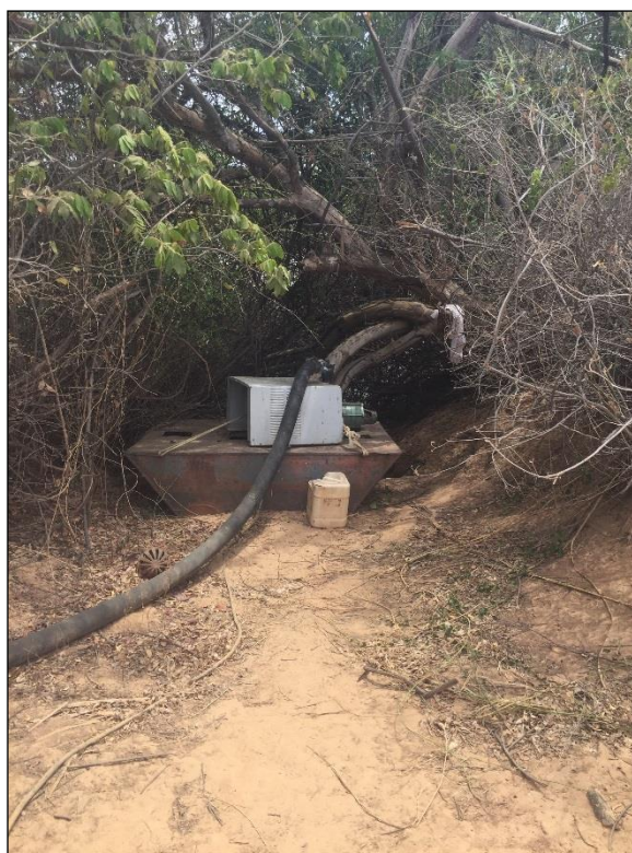
Figura 67 – Captação superficial – Comunidade de Caraíbas. Fonte: DRZ – Geotecnologia e Consultoria, 2017.
