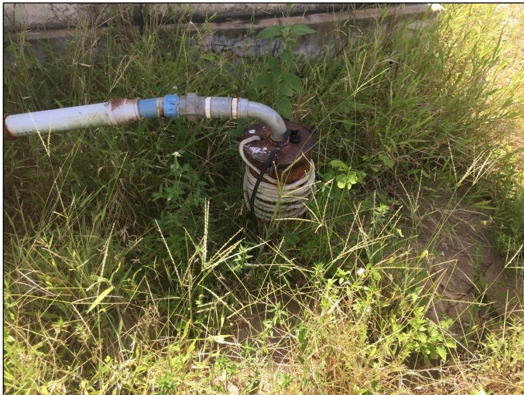
Figura 78 - Poço 1 - Comunidade Olho D'água dos Tanques. Fonte: DRZ – Geotecnologia e Consultoria, 2018.
