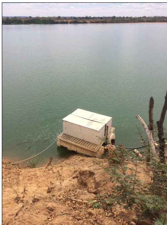
Figura 71 – Captação superficial – Comunidade Novo Horizonte. Fonte: DRZ – Geotecnologia e Consultoria, 2017.
