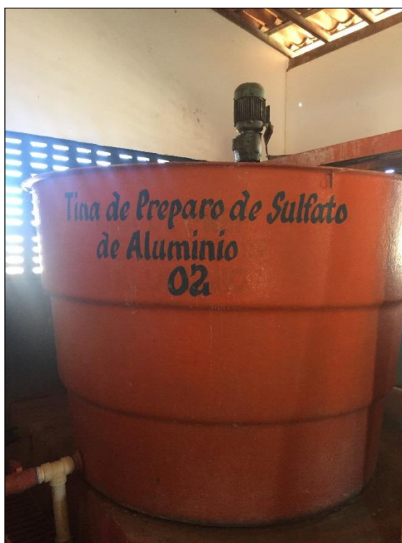
Figura 40 – Misturador de Sulfato de Alumínio. Fonte: DRZ – Geotecnologia e Consultoria, 2017.
