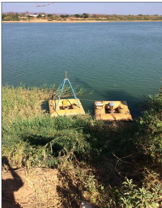
Figura 26 – Captação superficial no rio São Francisco – distrito Sede. Fonte: DRZ – Geotecnologia e Consultoria, 2017.
