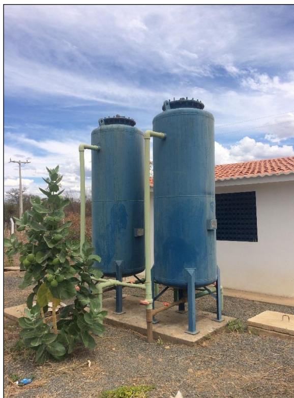
Figura 75 – Filtros de tratamento – Comunidade Novo Horizonte. Fonte: DRZ – Geotecnologia e Consultoria, 2018.
