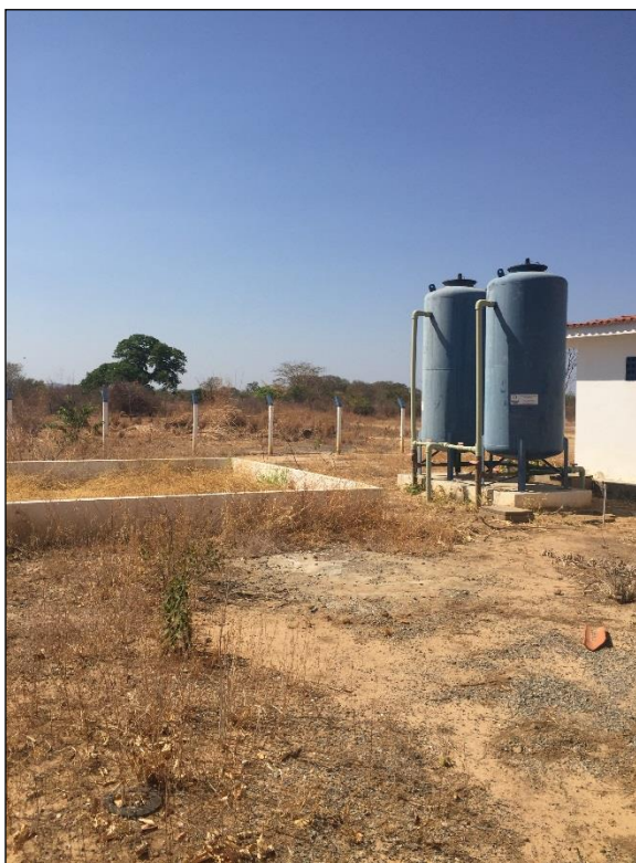
Figura 85 – Filtros de Tratamento – Comunidade Ilha Grande. Fonte: DRZ – Geotecnologia e Consultoria, 2017.
