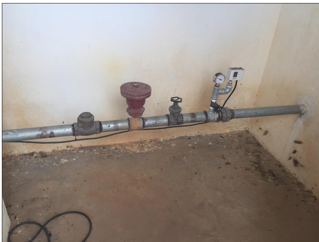
Figura 74 – Medidor de pressão – Comunidade Novo Horizonte. Fonte: DRZ – Geotecnologia e Consultoria, 2017.
