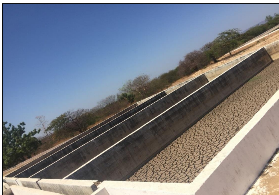
Figura 96 – Leito de secagem. Fonte: DRZ – Geotecnologia e Consultoria, 2017.
