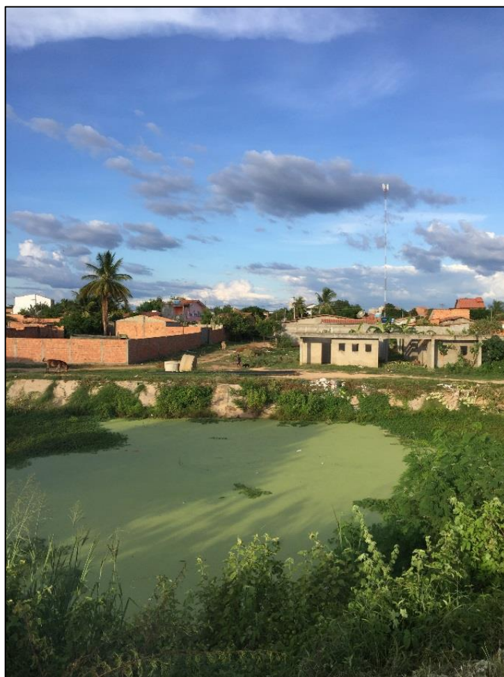
Figura 127 - Reservatório de detenção com acúmulo de efluente de esgoto doméstico.
