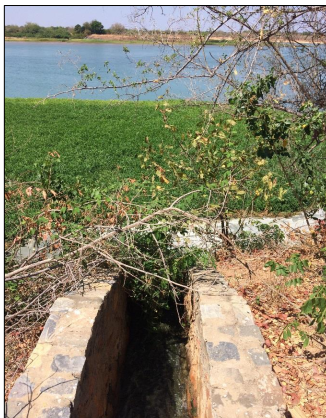
Figura 98 – Emissário do efluente de esgoto doméstico tratado. Fonte: DRZ – Geotecnologia e Consultoria, 2017.
