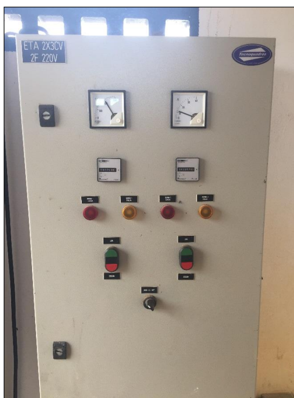
Figura 73 – Quadro elétrico – Comunidade Novo Horizonte. Fonte: DRZ – Geotecnologia e Consultoria, 2017.
