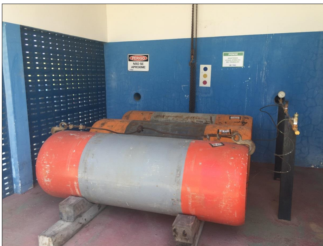
Figura 37 – Cilindro de cloro gás. Fonte: DRZ – Geotecnologia e Consultoria, 2017.
