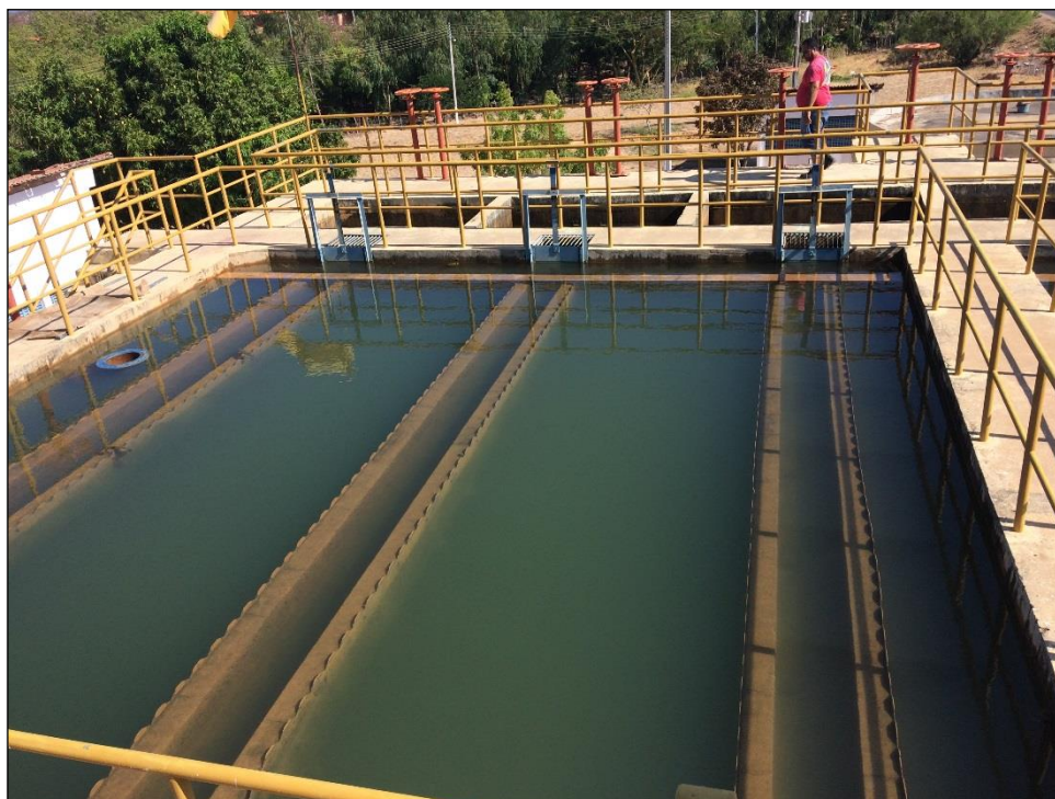
Figura 32 – Floccodecantadores ETA – distrito Sede. Fonte: DRZ – Geotecnologia e Consultoria, 2017.
