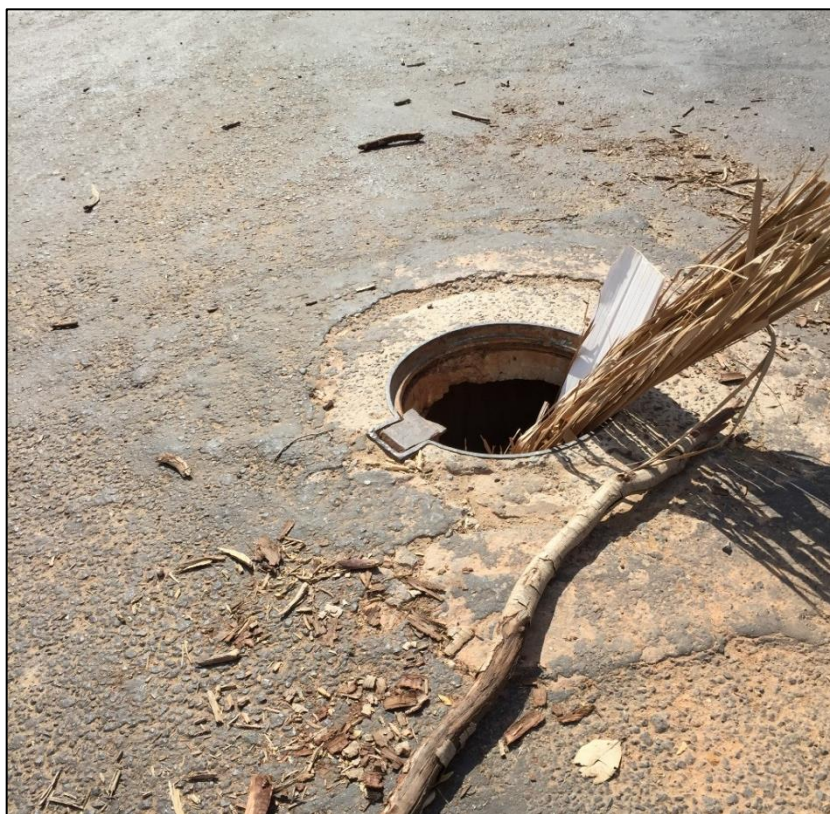
Figura 125 - Poço de visita da rede de drenagem. Fonte: DRZ – Geotecnologia e Consultoria, 2017.
