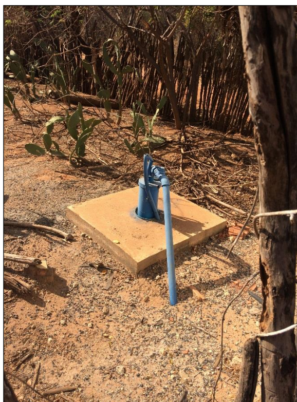
Figura 58 – Poço – Comunidade Boqueirão. Fonte: DRZ – Geotecnologia e Consultoria, 2017.
