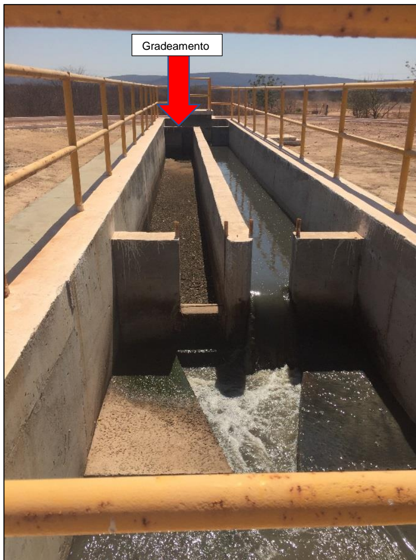
Figura 94 – Calha Parshall e gradeamento (em destaque). Fonte: DRZ – Geotecnologia e Consultoria, 2017.
