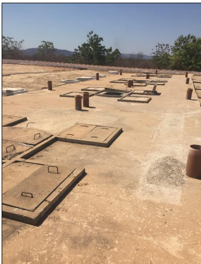
Figura 95 – Módulo do reator UASB. Fonte: DRZ – Geotecnologia e Consultoria, 2017.
