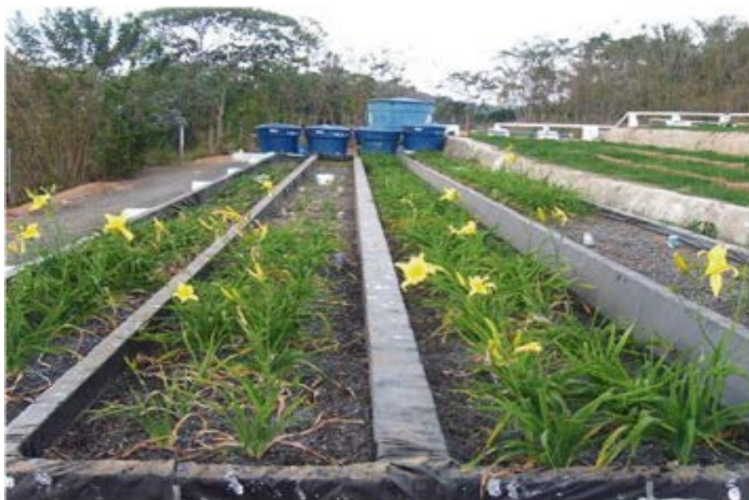
Figura 29 – Tratamento de Esgoto Sanitário em Sistemas Alagados Construídos Cultivados com Lírio Amarelo
