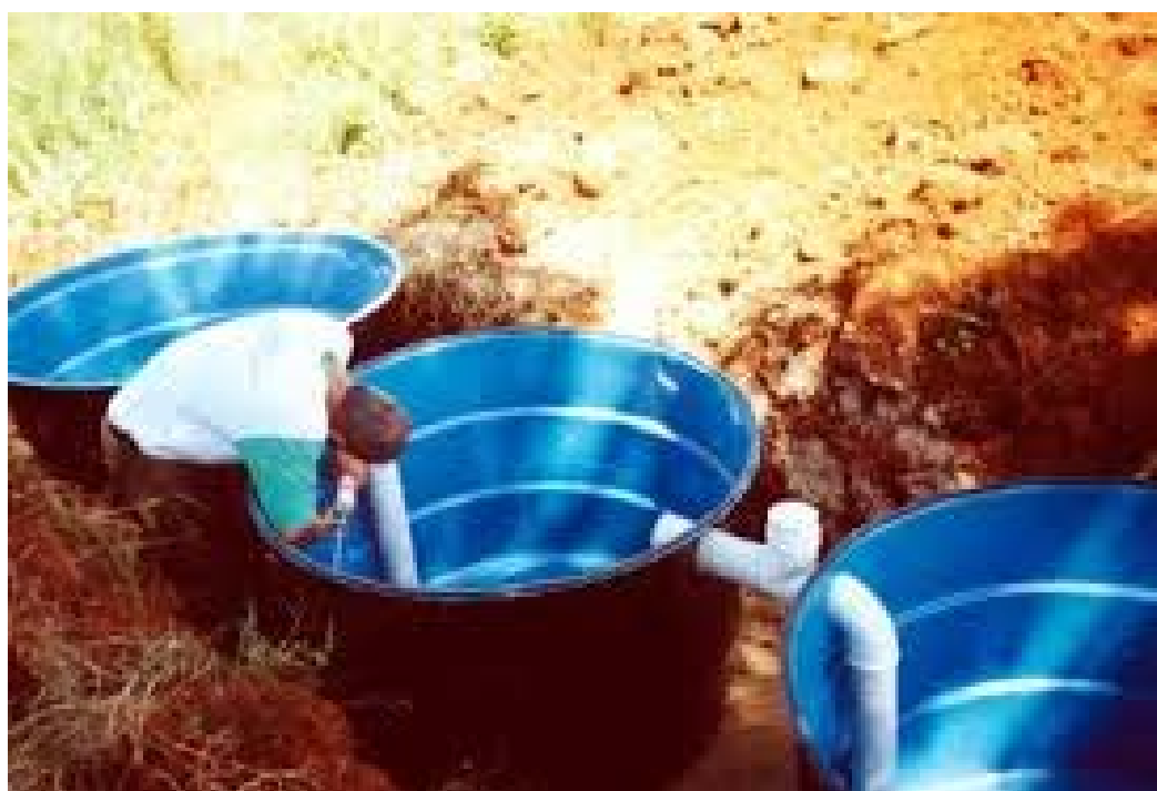
Figura 28 – Fossa Séptica Fonte: EMATER, 2014
