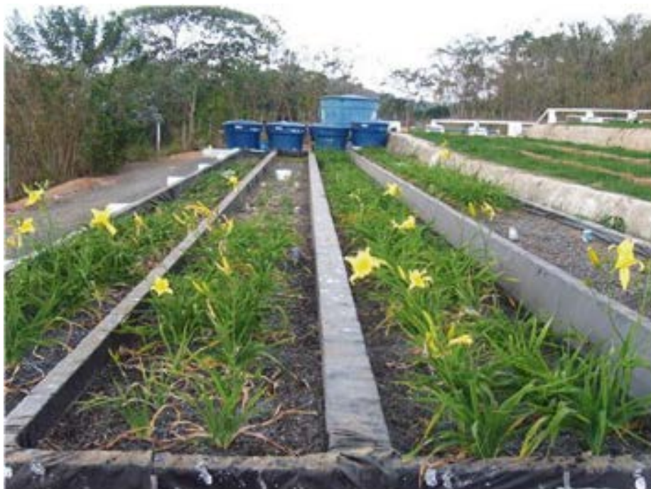
Figura 34 – Tratamento de Esgoto Sanitário em Sistemas Alagados Construídos Cultivados com Lírio Amarelo
