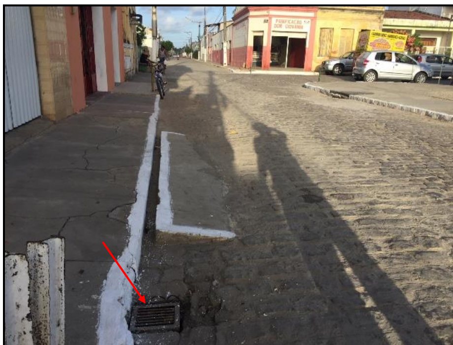
Figura 97 – Boca-de-lobo com dimensões reduzidas
