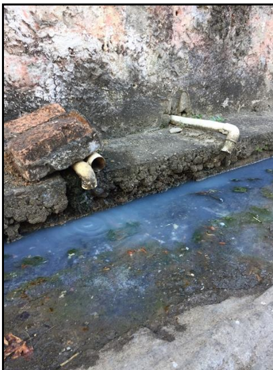
Figura 102 – Lançamento de esgoto em via pública (Pontal do Peba) Fonte: Premier Engenharia, 2018.
