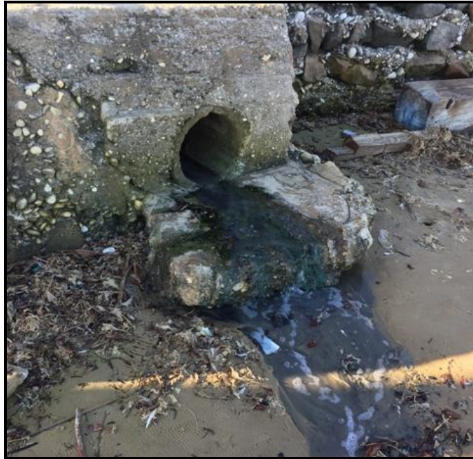
Figura 48 – Ponto de lançamento de esgoto a céu aberto e que escoam para o mar do Oceano Atlântico no distrito Pontal do Peba Fonte – Premier Engenharia, 2018.
