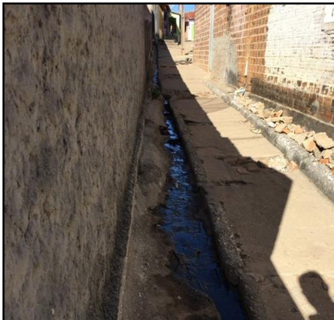
Figura 50 – Ponto de lançamento de esgoto a céu aberto na localidade de Potengi
