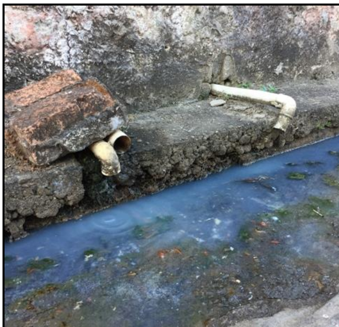
Figura 46 – Ponto de lançamento de esgoto a céu aberto no distrito Pontal do Peba
