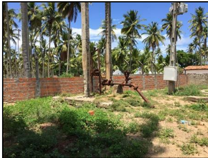
Figura 33– Poços Feliz Deserto Fonte: Premier Engenharia, 2018.
