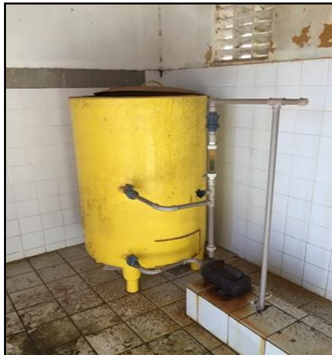
Figura 39 – Tratamento desativado Fonte: Premier Engenharia, 2018.
