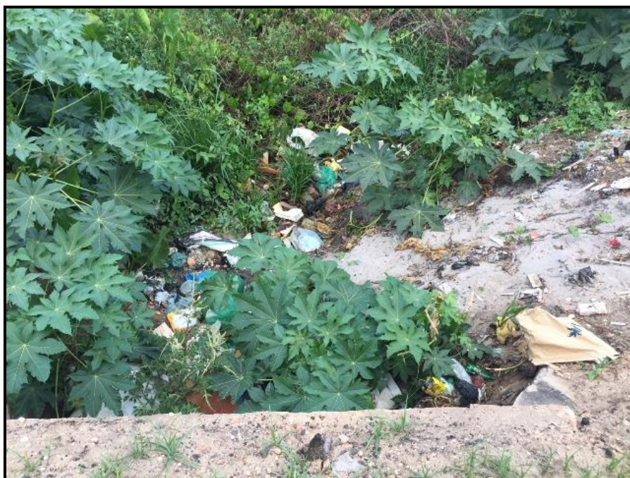
Figura 101 – Bueiro com excesso de vegetação e lixo no Bairro Brasília (drenagem para o Rio São Francisco) Fonte: Premier Engenharia, 2018.
