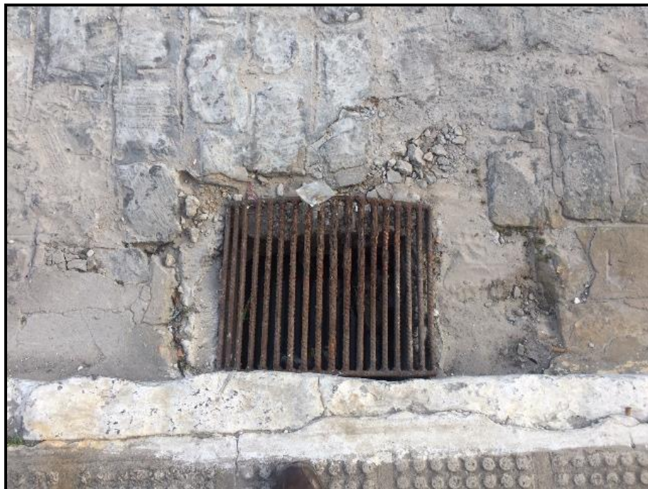
Figura 99 – Boca-de-lobo com grelha de ferro pouco resistente (apresentando envergamento)
