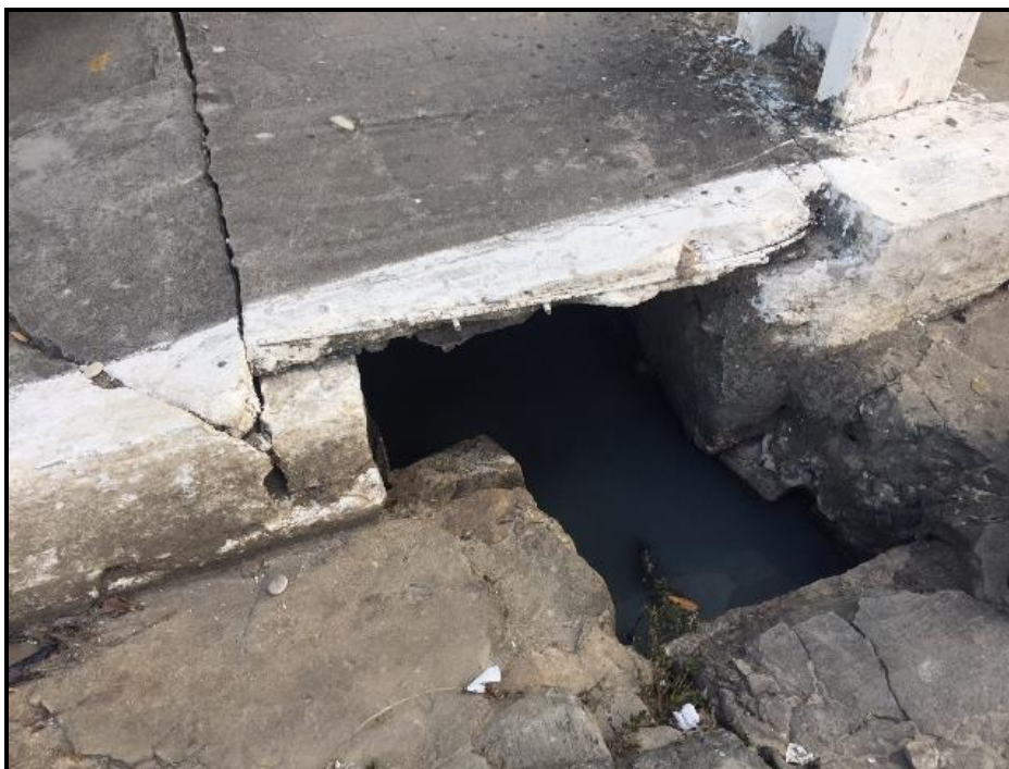
Figura 94 – Dispositivo de captação de água pluvial sem qualquer proteção Fonte: Premier Engenharia, 2018.
