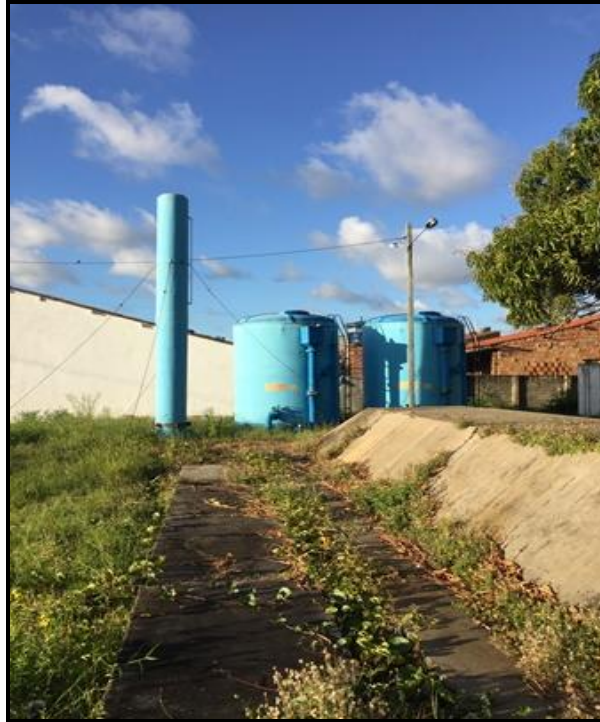
Figura 32 – Unidades de Tratamento que compõem a ETA Fonte: Premier Engenharia, 2018.
