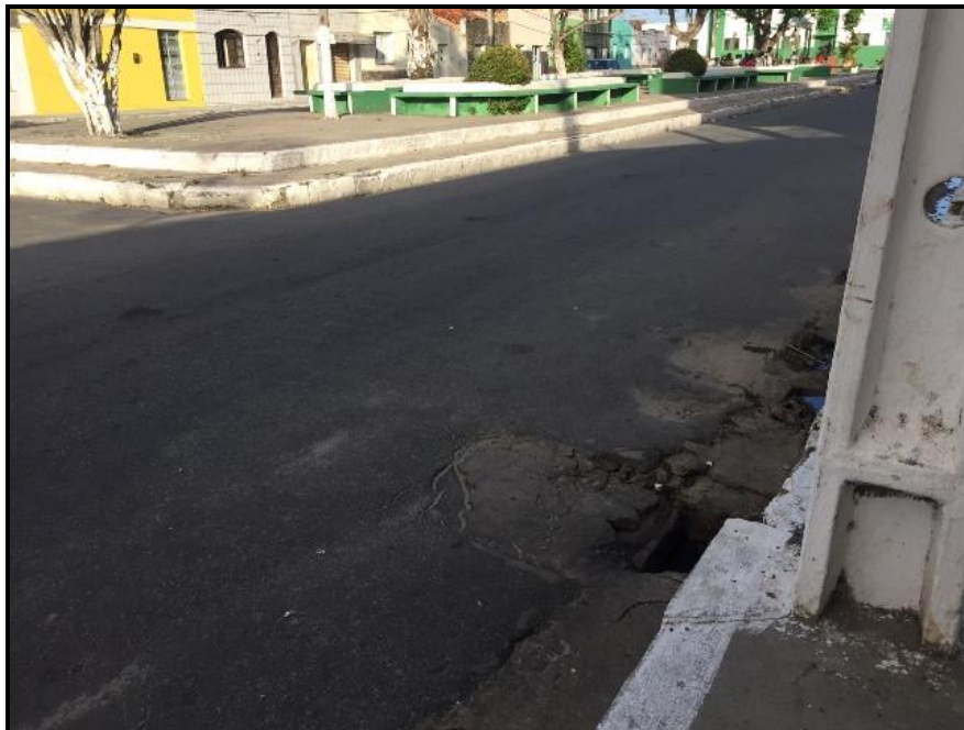
Figura 107 – Rua Padre Curador (ponto afetado por alagamento – vista 1) Fonte: Premier Engenharia, 2018.
