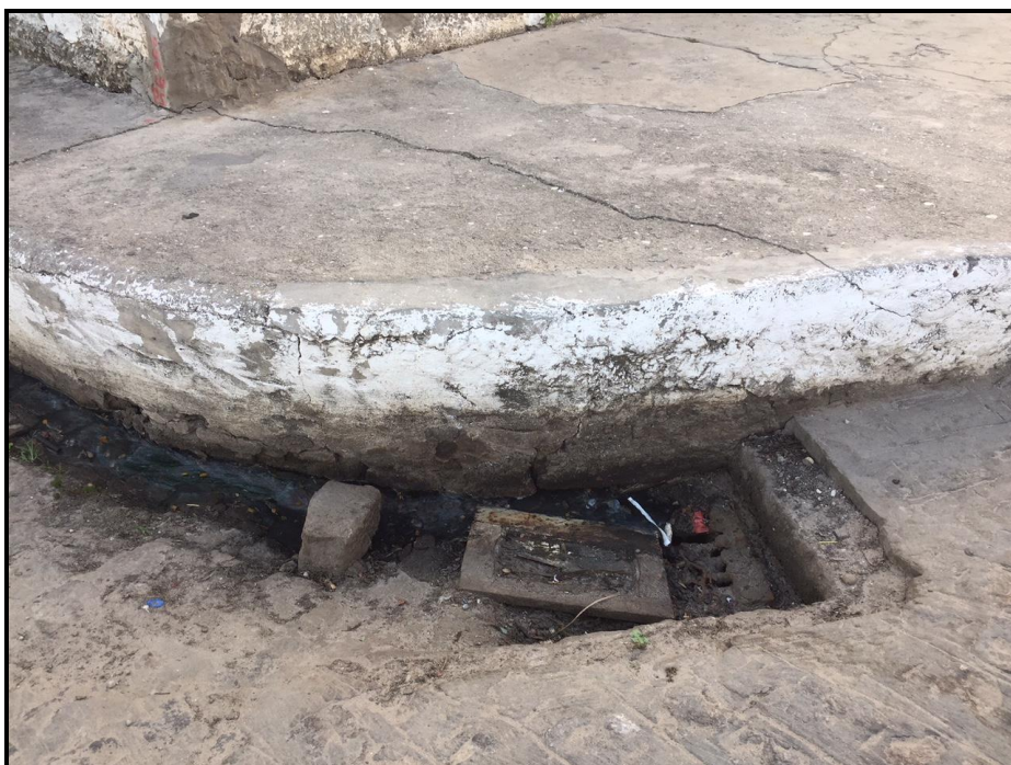
Figura 96 – Boca-de-lobo com grelha de concreto (com excesso de areia em sua superfície)
