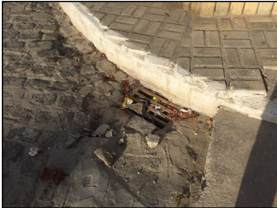
Figura 98 – Boca-de-lobo com grelha de ferro (presença de lixo em sua superfície)
