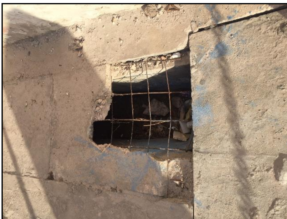
Figura 95 – Dispositivo em mal estado de conservação (com presença de resíduos sólidos no seu interior) Fonte: Premier Engenharia, 2018.
