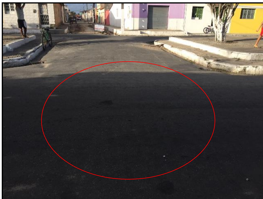
Figura 108 – Rua Padre Curador (ponto afetado por alagamento – vista 2) Fonte: Premier Engenharia, 2018.
