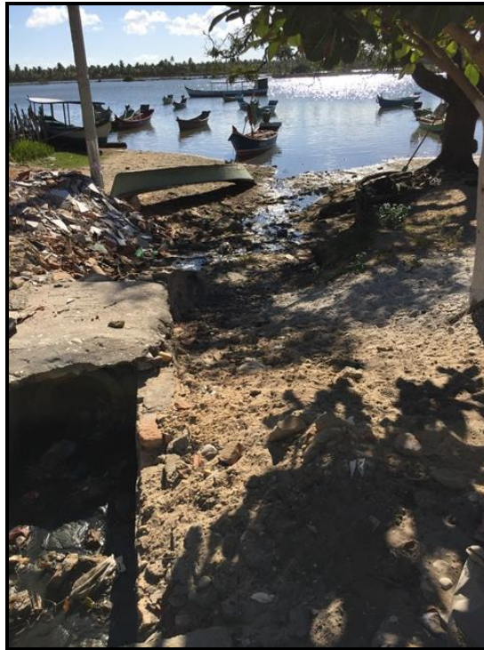
Figura 104 – Lançamento de esgoto próximo ao Rio São Francisco (Potengi) Fonte: Premier Engenharia, 2018.
