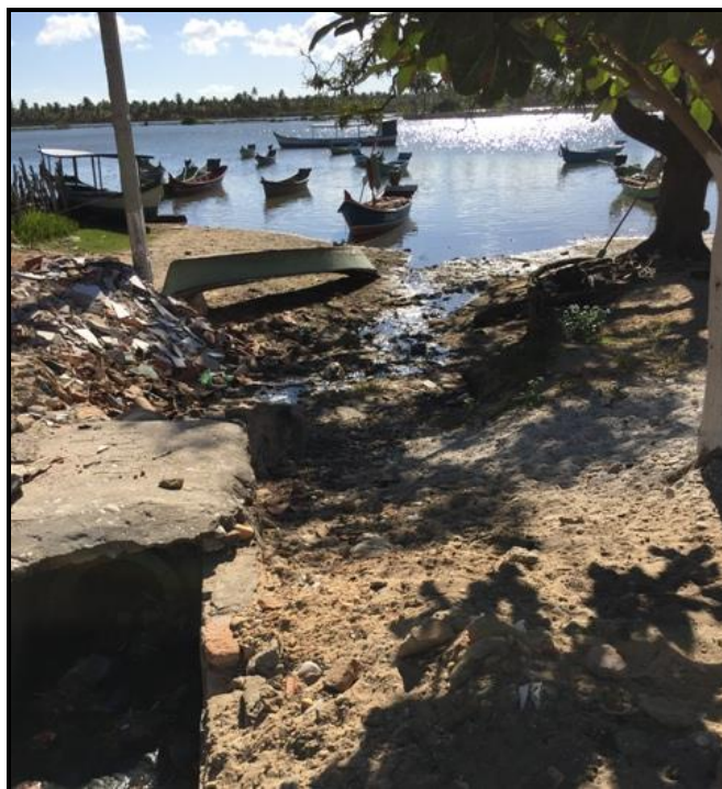
Figura 51 – Ponto de lançamento de esgoto a céu aberto na localidade de Potengi Fonte – Premier Engenharia, 2018.
