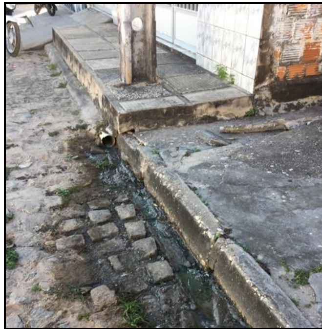
Figura 45 – Ponto de lançamento de esgoto a céu aberto no distrito Pontal do Peba
