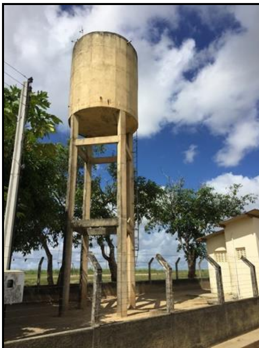
Figura 112 - Reservatório – Pov. Carapina Fonte: Premier Engenharia, 2018.
