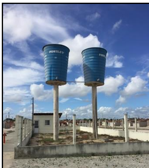
Figura 64 - Reservatórios – Conj. Hab. Velho Chico II Fonte: Premier Engenharia, 2018.
