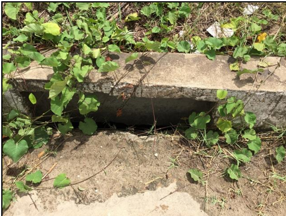
Figura 212 – Rua Jatobá – ponto de alagamento 2 (falta de manutenção)
