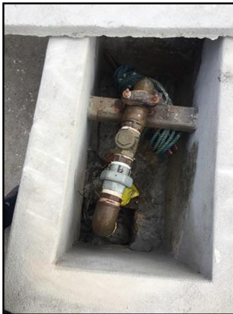
Figura 101 – Poço - Povoado Murici Fonte: Premier Engenharia, 2018.
