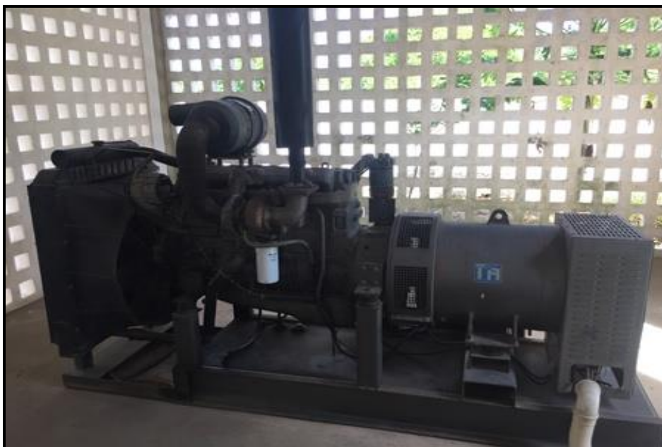
Figura 153 – EEE Final – Gerador Fonte: Premier Engenharia, 2018.
