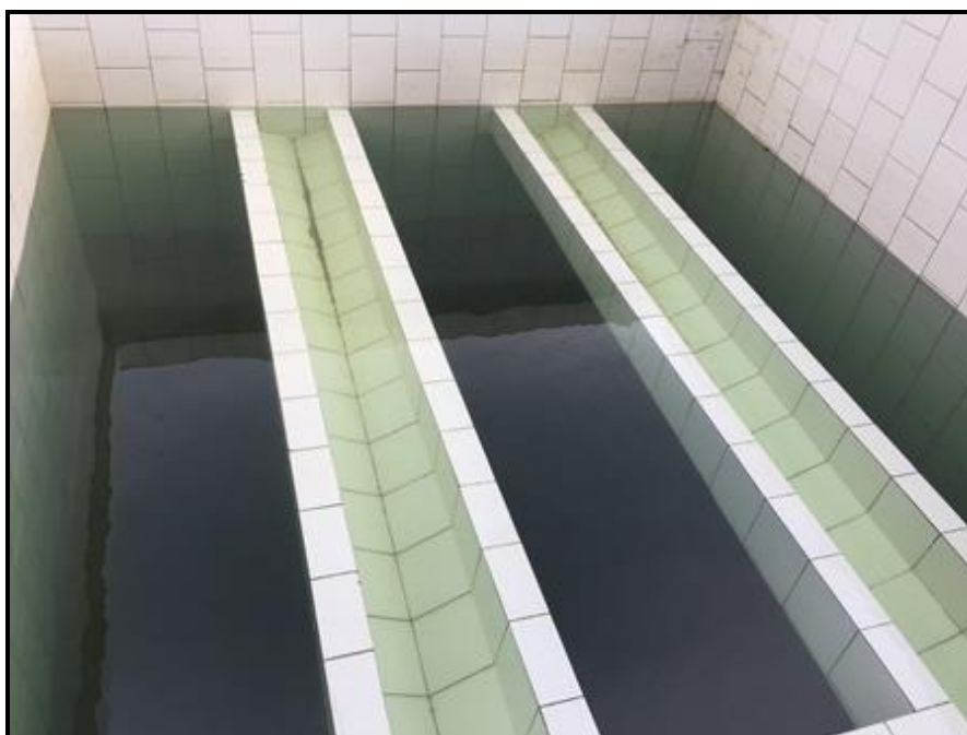
Figura 44 - Filtro Fonte: Premier Engenharia, 2018.
