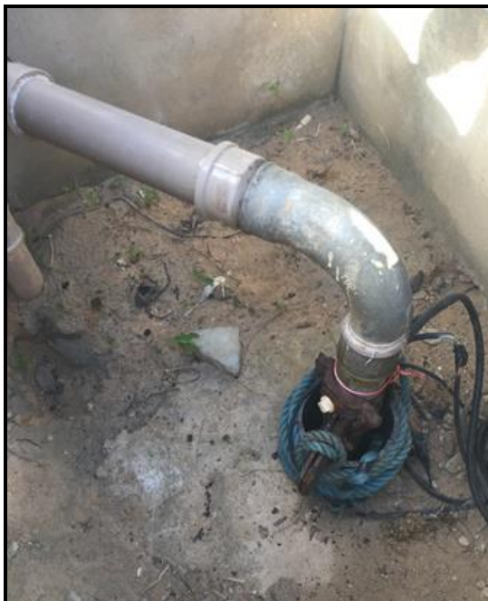
Figura 98 – Poço - Povoado Campo Redondo Fonte: Premier Engenharia, 2018.
