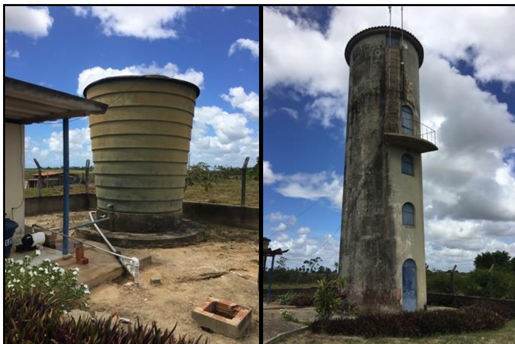
Figura 139 - Reservatórios – Pov. Espigão
