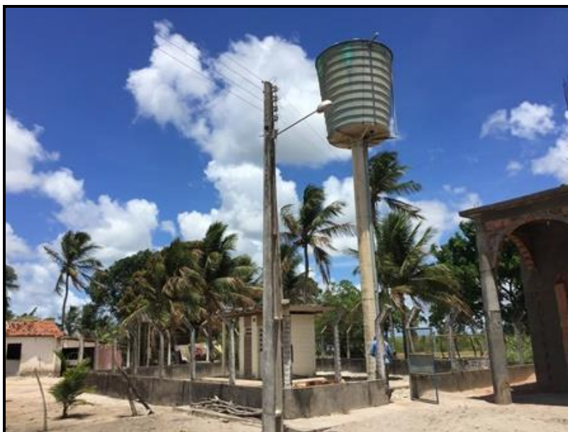
Figura 133 - Reservatório – Pov. Conrado I Fonte: Premier Engenharia, 2018.
