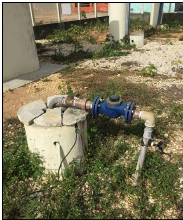
Figura 65 - Poços Conj. Hab. Marisa Letícia Fonte: Premier Engenharia, 2018.
