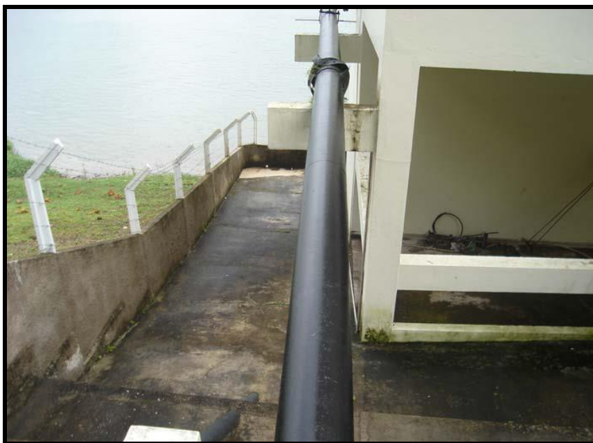
Figura 36 – Saída da adutora 2 da ERAB 1 Fonte: Intersan Projetos de Engenharia, 2013.
