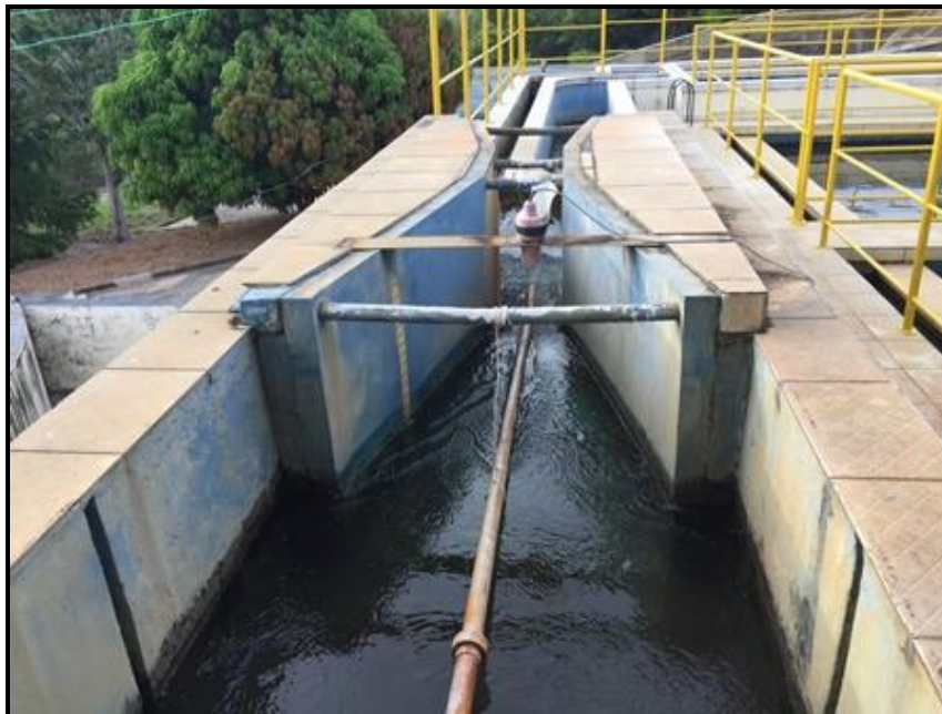
Figura 39 - Calha Parshall Fonte: Premier Engenharia, 2018.
