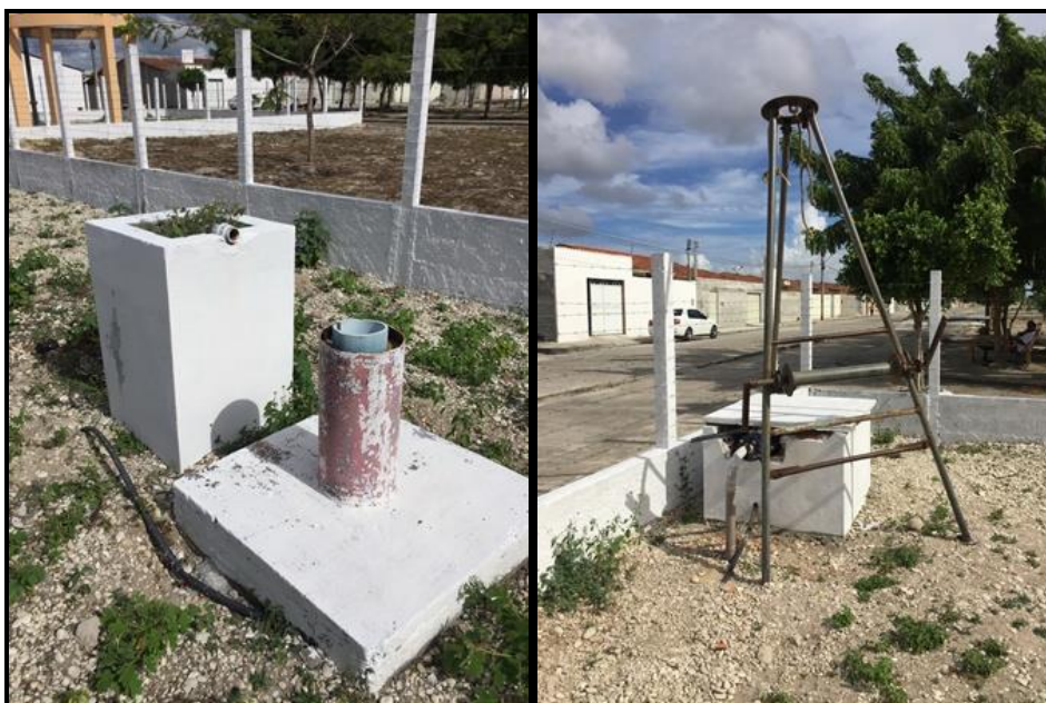
Figura 52 – Poços Conj. Hab. Mata Atlântica I Fonte: Premier Engenharia, 2018.
