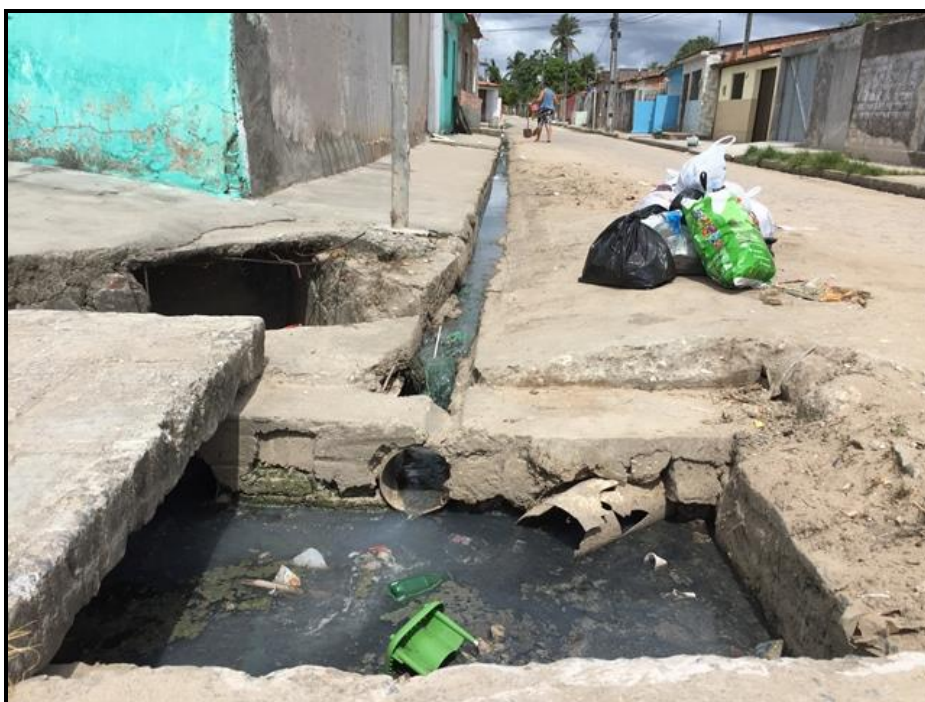
Figura 205 – Dispositivo de captação de água pluvial sem qualquer proteção e sem manutenção
