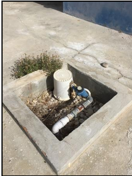
Figura 77 – Poço do Conj. Hab. Santo Expedito Fonte: Premier Engenharia, 2018.
