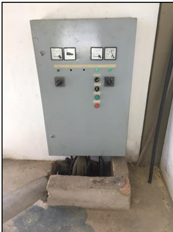
Figura 155 – EEE Final – Quadro de Comando Fonte: Premier Engenharia, 2018.
