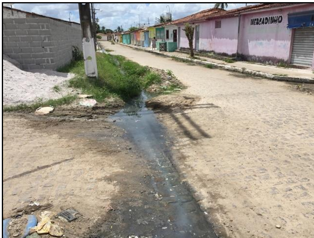
Figura 225 – Bairro Leitoal – ponto sem rede de drenagem Fonte: Premier Engenharia, 2018.
