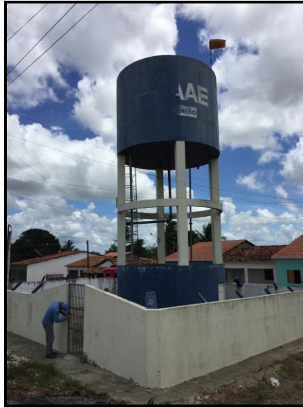
Figura 94 - Reservatório – Pov. Itaporanga Fonte: Premier Engenharia, 2018.
