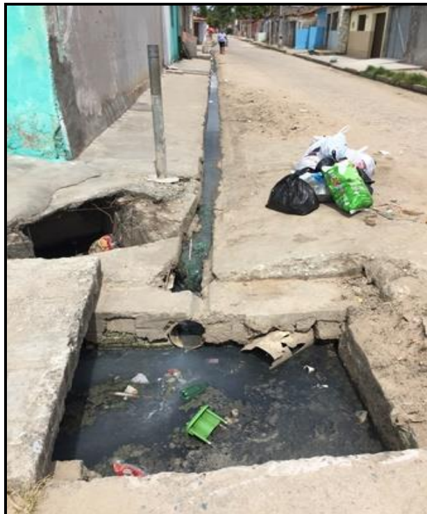
Figura 150 – Ponto de lançamento de esgoto a céu aberto. Fonte: Premier Engenharia, 2018.
