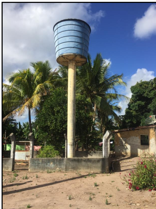
Figura 146 - Reservatório – Pov. Povoado Marituba de Cima Fonte: Premier Engenharia, 2018.
