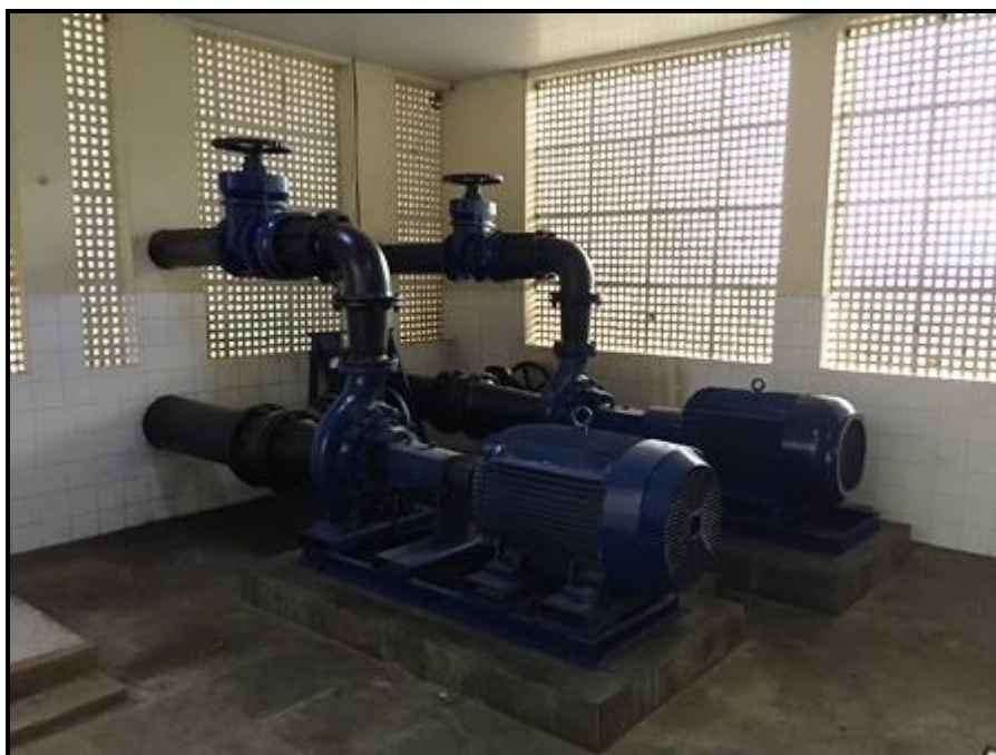
Figura 51 – Conjuntos Motobombas da ERAT-1 Fonte: Premier Engenharia, 2018.
