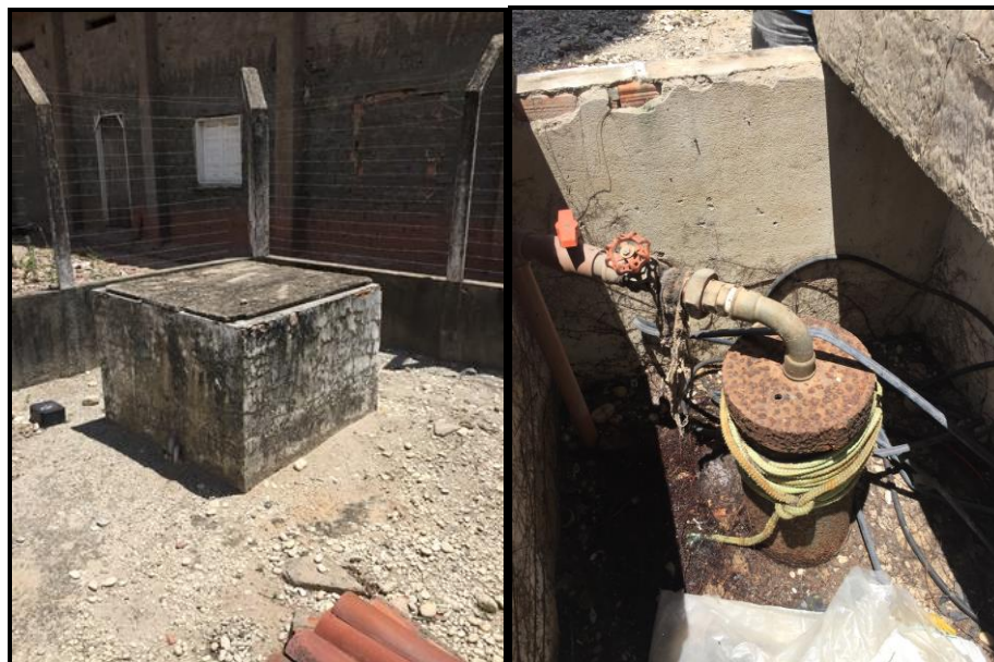
Figura 131 – Poço - Povoado Conrado I Fonte: Premier Engenharia, 2018.
