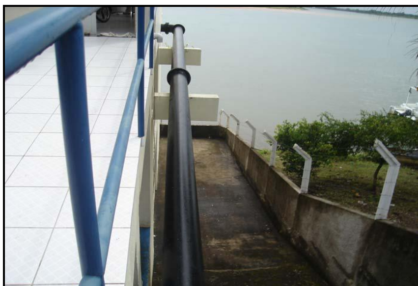
Figura 35 – Saída da adutora 1 da ERAB 1 Fonte: Intersan Projetos de Engenharia, 2013.
