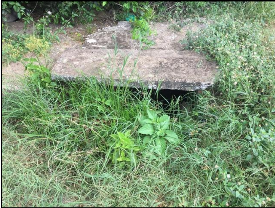
Figura 206 – Excesso de vegetação prejudicando o escoamento das águas pluviais
