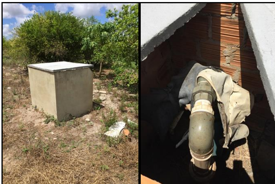
Figura 128 – Poço - Povoado Imbira Fonte: Premier Engenharia, 2018.
