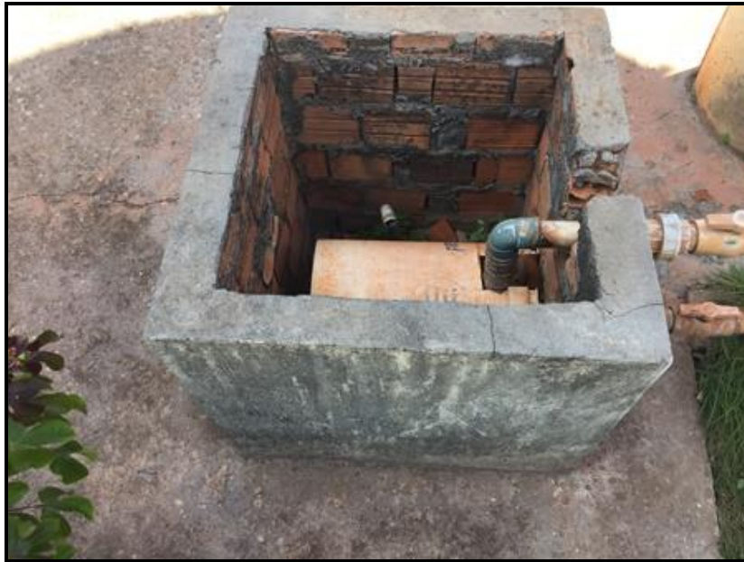
Figura 134 – Poço - Povoado Conrado II Fonte: Premier Engenharia, 2018.
