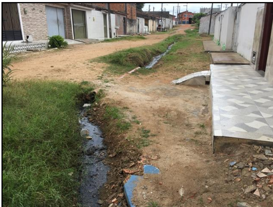
Figura 219 – Conj. Hab. Madre do Esp. Santo – drenagem insuficiente Fonte: Premier Engenharia, 2018.
