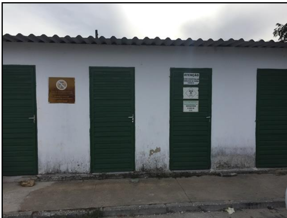
Figura 179 – Local de armazenamento da UPA de Penedo (vista externa) Fonte: Premier Engenharia, 2018.
