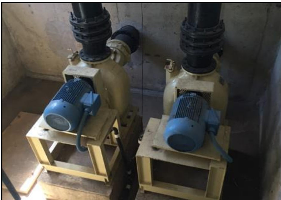
Figura 154 – EEE Final – Conjuntos Motobomba Fonte: Premier Engenharia, 2018.
