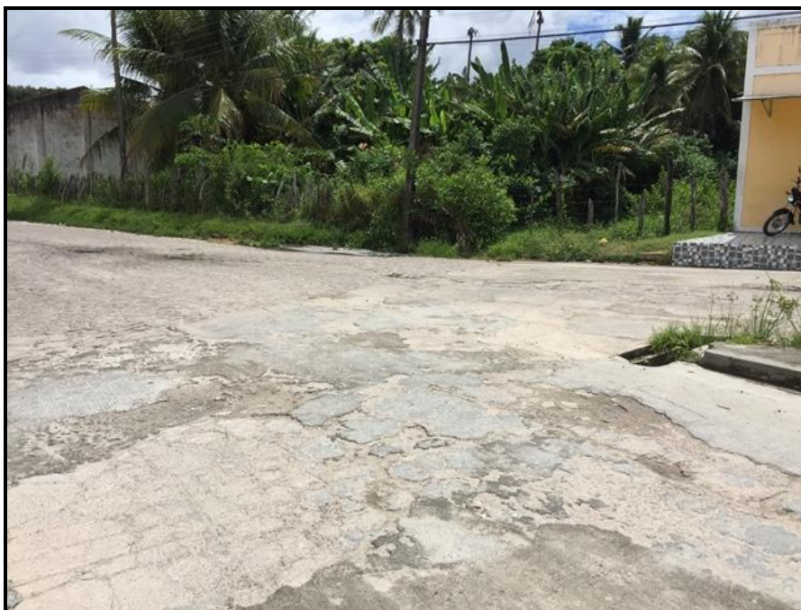
Figura 210 – Rua Jatobá – ponto de alagamento 1 (vista 1) Fonte: Premier Engenharia, 2018.
