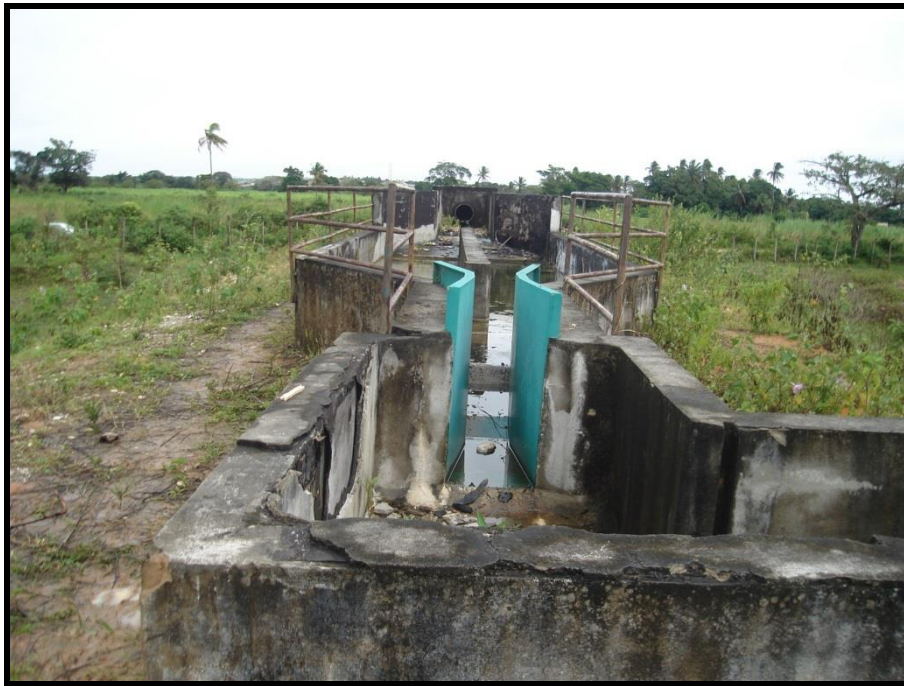
Figura 159 – Chegada na ETE Fonte: Alagoas / PMP, 2010.
