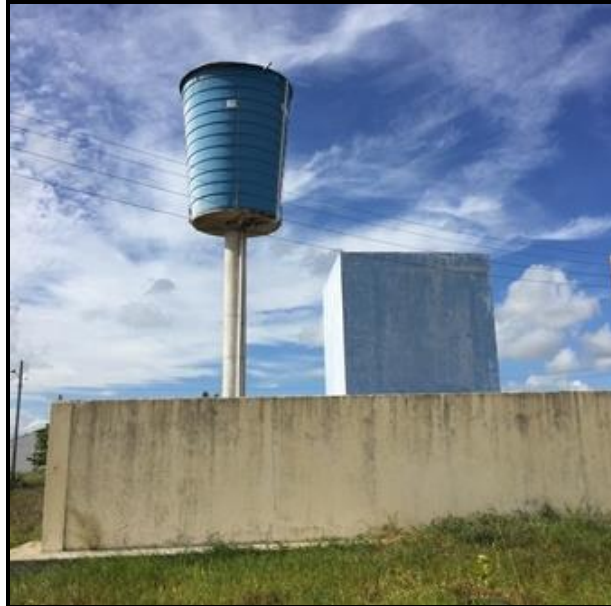
Figura 79 - Reservatório – Conj. Hab. Santo Expedito Fonte: Premier Engenharia, 2018.
