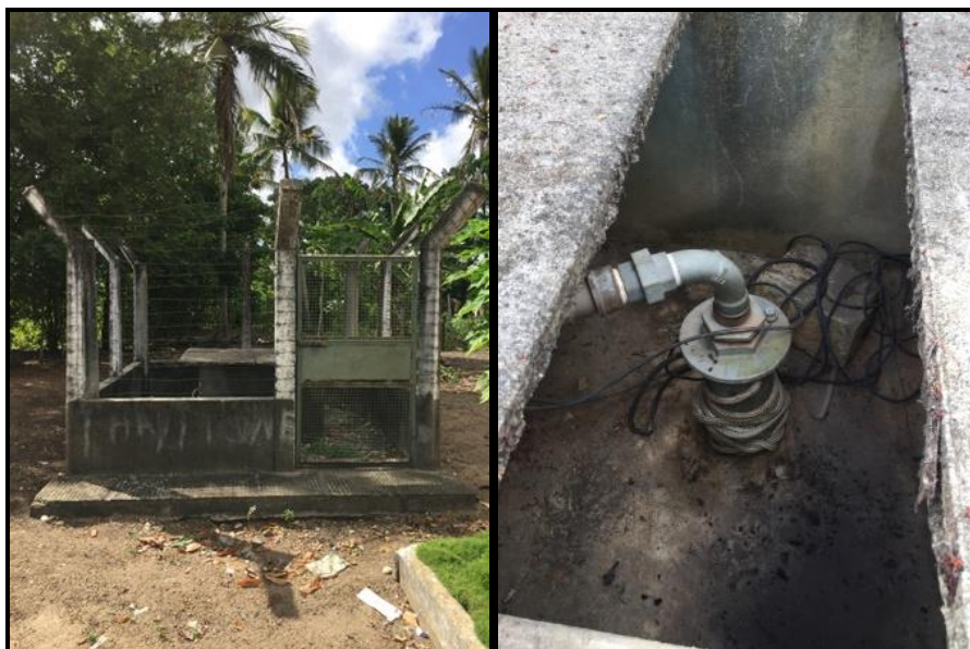
Figura 116 – Poço - Povoado Manimbu Fonte: Premier Engenharia, 2018.
