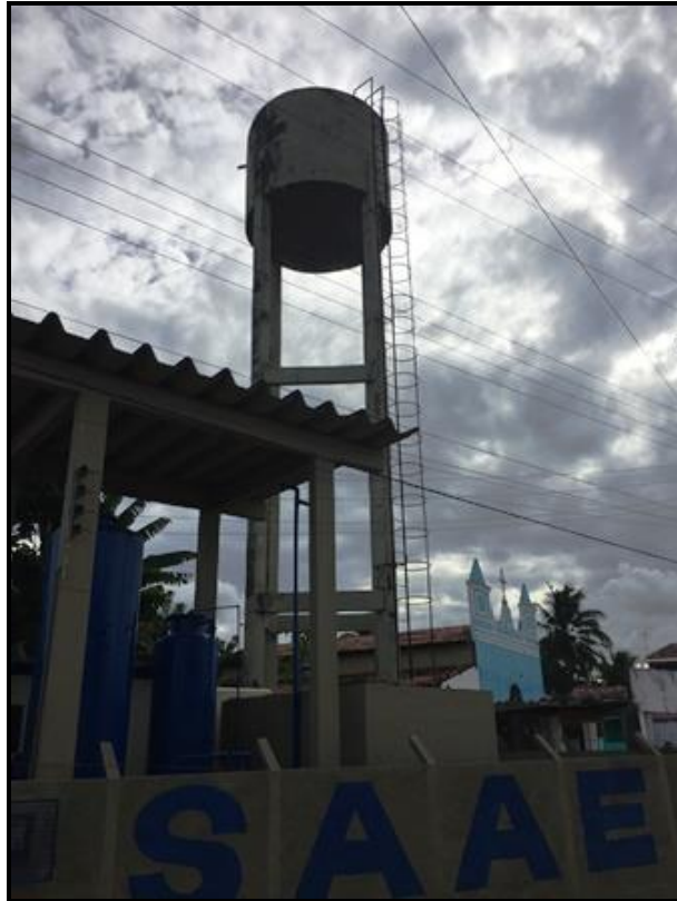
Figura 108 - Reservatório – Povoado Ponta Mofina Fonte: Premier Engenharia, 2018
