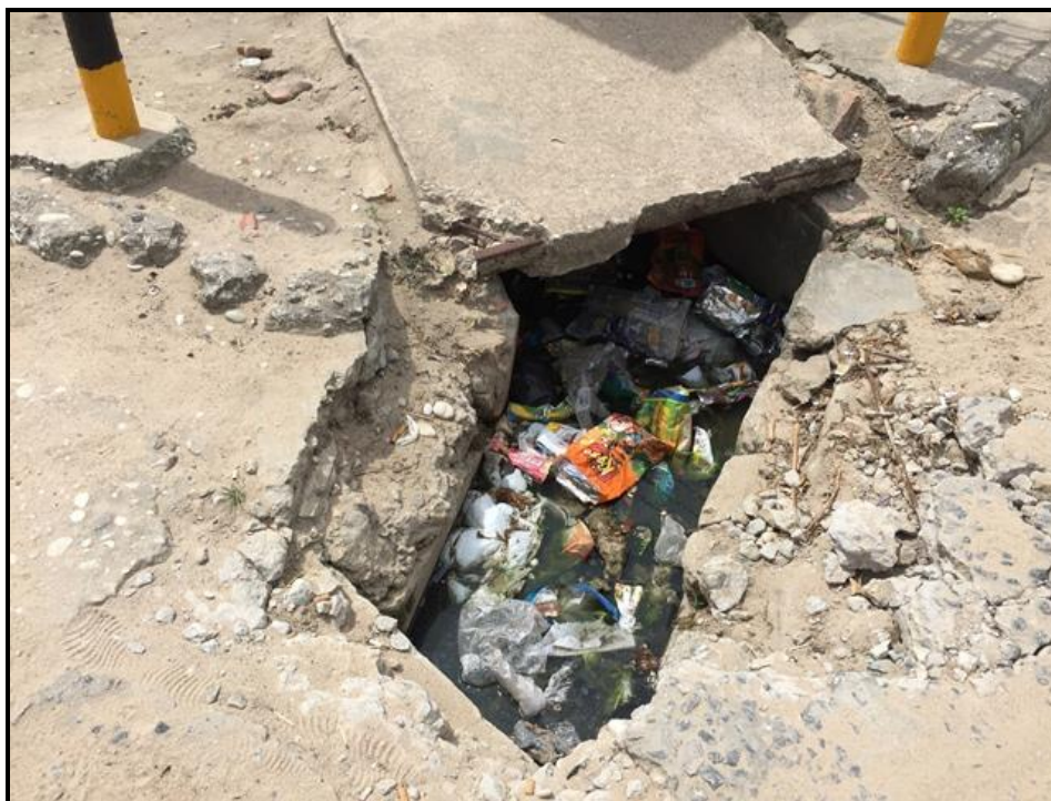
Figura 214 – Rua Guarani – falta de manutenção Fonte: Premier Engenharia, 2018.
