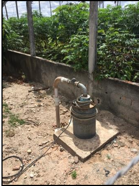
Figura 136 – Poço - Povoado Santa Margarida Fonte: Premier Engenharia, 2018.
