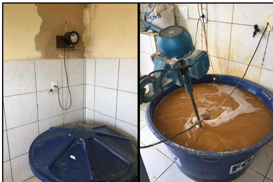
Figura 141- ETA Compacta – Pov. Povoado Ilha das Canas Fonte: Premier Engenharia, 2018
