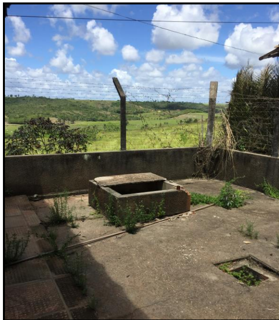
Figura 125 – Poço - Povoado Pescoço Fonte: Premier Engenharia, 2018.
