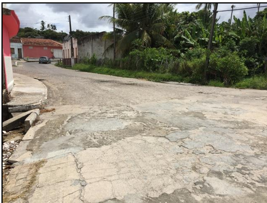
Figura 211 – Rua Jatobá – ponto de alagamento 1 (vista 2) Fonte: Premier Engenharia, 2018.
