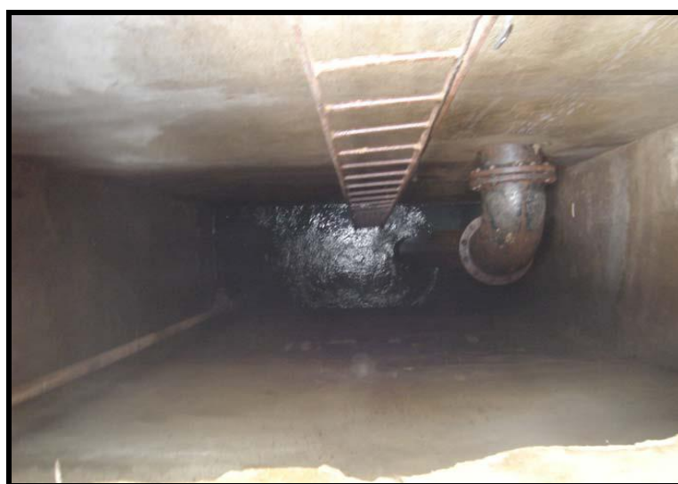
Figura 32 - Poço de Captação de água bruta no Rio São Francisco Fonte: Intersan Projetos de Engenharia, 2013.
