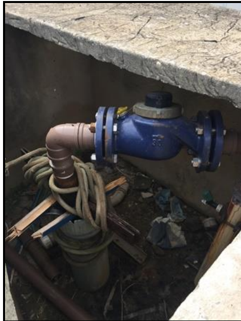
Figura 87 – Poço - Povoado Cooperativa Núcleo II Fonte: Premier Engenharia, 2018.
