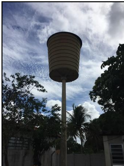
Figura 86 - Reservatório – Pov. Cerquinha das Laranjas Fonte: Premier Engenharia, 2018.
