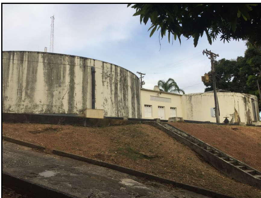
Figura 48 – Reservatórios de 600 m 3 cada Fonte: Premier Engenharia, 2018.
