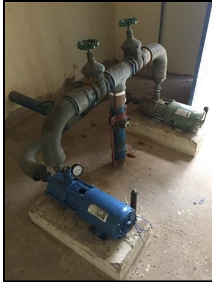
Figura 142- Conjunto Motobomba – Pov. Ilha das Canas Fonte: Premier Engenharia, 2018.
