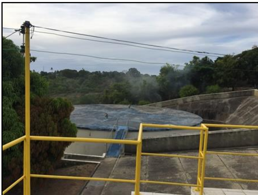
Figura 49 – Reservatório de 1.500m 3 Fonte: Premier Engenharia, 2018.
