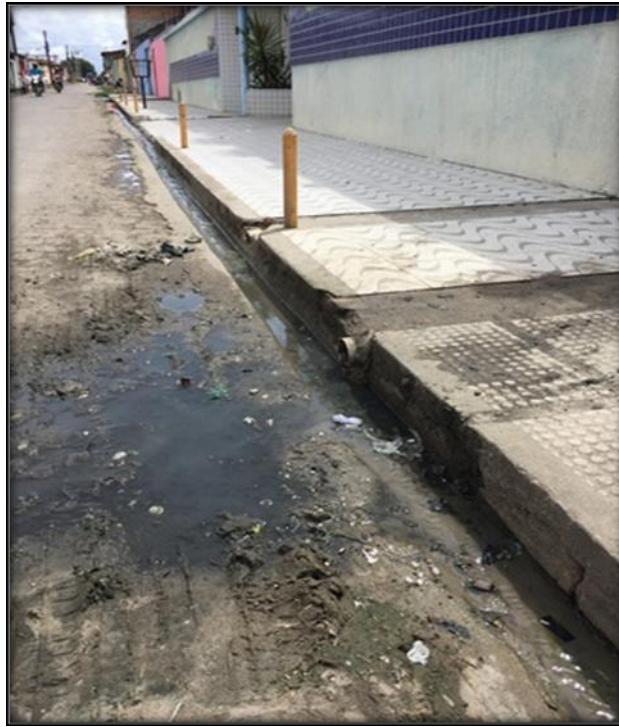
Figura 149– Ponto de lançamento de esgoto a céu aberto. Fonte: Premier Engenharia, 2018.
