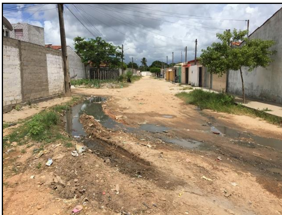
Figura 223 – Bairro Santa Isabel – rua afetada por alagamento Fonte: Premier Engenharia, 2018.
