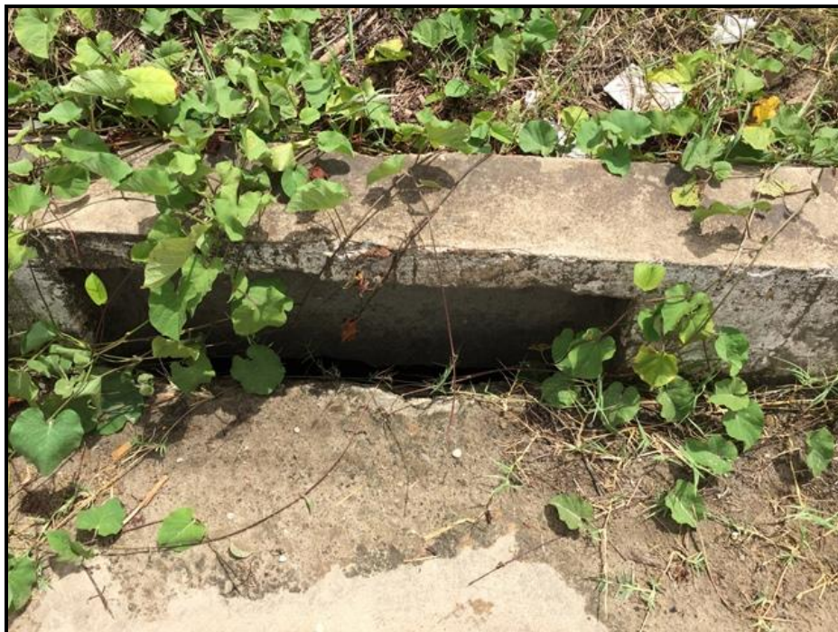
Figura 207 – Entrada da boca-de-lobo com excesso de areia e vegetação
