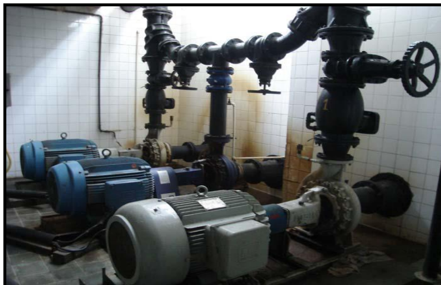
Figura 34 – Conjuntos motobombas e barrilete de recalque de água bruta Fonte: Intersan Projetos de Engenharia, 2013.
