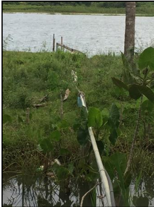
Figura 140 – Captação Rio São Francisco - Povoado Ilha das Canas Fonte: Premier Engenharia, 2018
