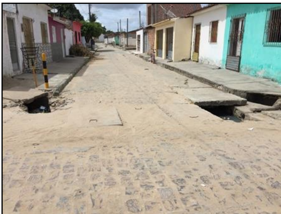
Figura 215 – Rua Guarani– região afetada por alagamento Fonte: Premier Engenharia, 2018.
