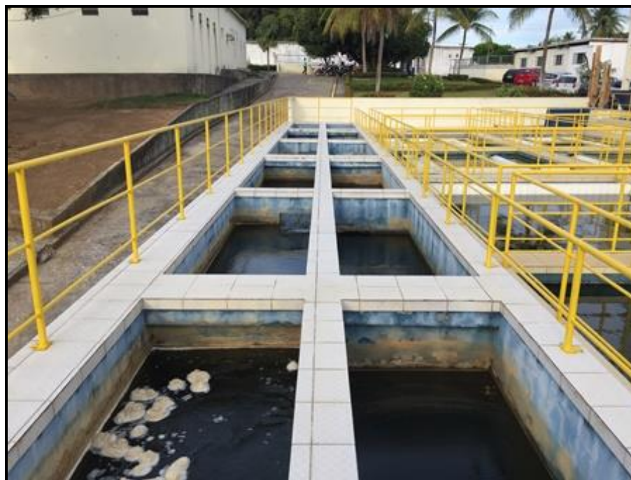
Figura 41 – Floculador Fonte: Premier Engenharia, 2018.
