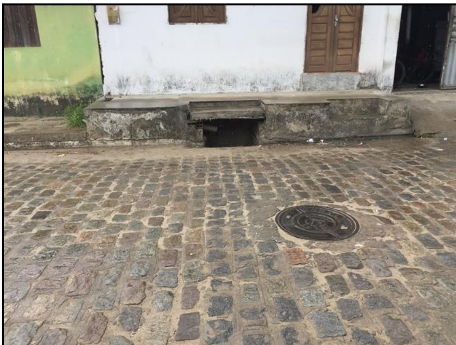
Figura 217 – Conj. Hab. Madre do Esp. Santo - sistema de drenagem nesse ponto
