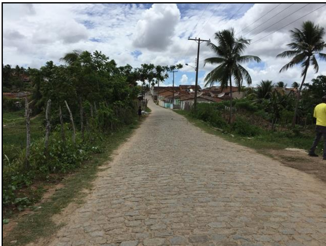
Figura 226 – Bairro Koréia – rua suscetível a alagamento Fonte: Premier Engenharia, 2018.
