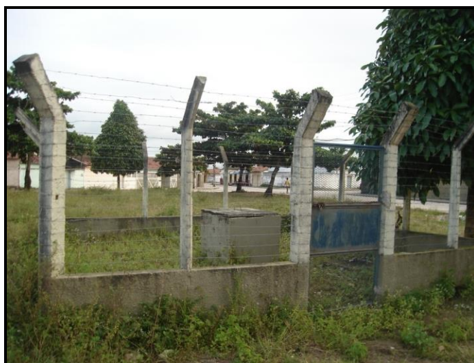
Figura 73 – Poço – Conj Hab. Rosseti Andrade Fonte: Intersan Projetos de Engenharia, 2013.
