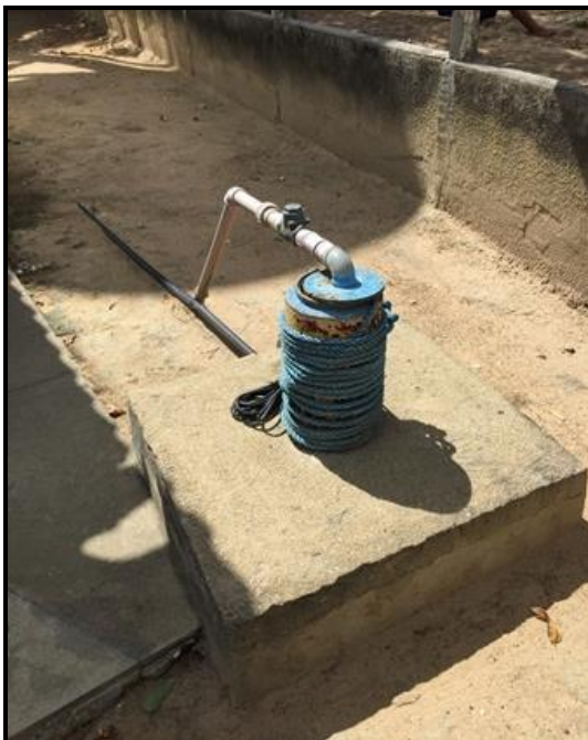
Figura 110 – Poço - Povoado Carapina Fonte: Premier Engenharia, 2018.
