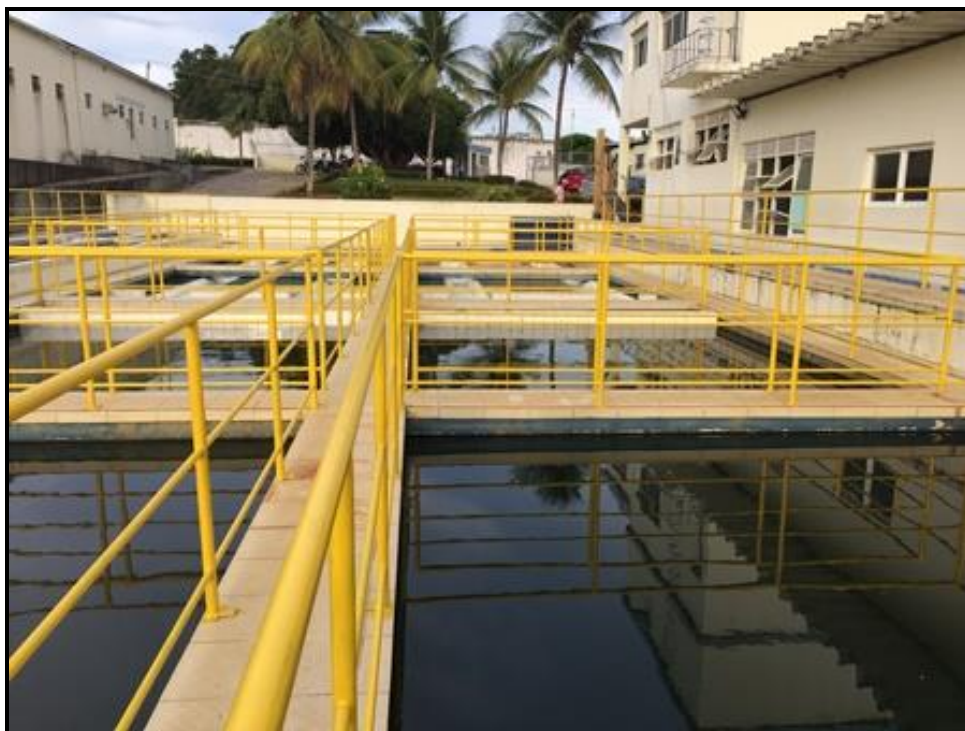
Figura 42 – Decantadores Fonte: Premier Engenharia, 2018.
