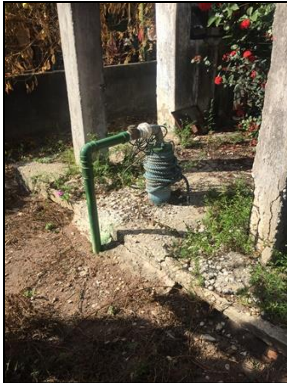
Figura 145 – Poço - Povoado Marituba de Cima Fonte: Premier Engenharia, 2018.
