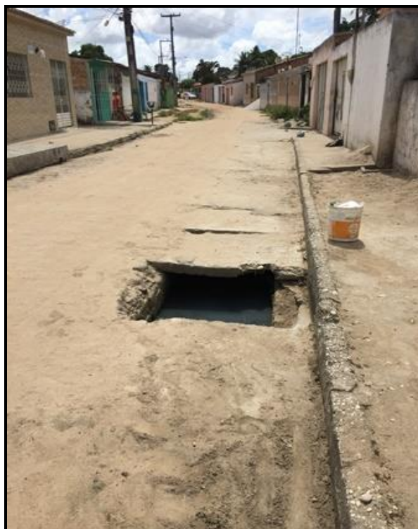
Figura 161 – Lançamento do esgoto no canal de drenagem Fonte: Premier Engenharia, 2018.
