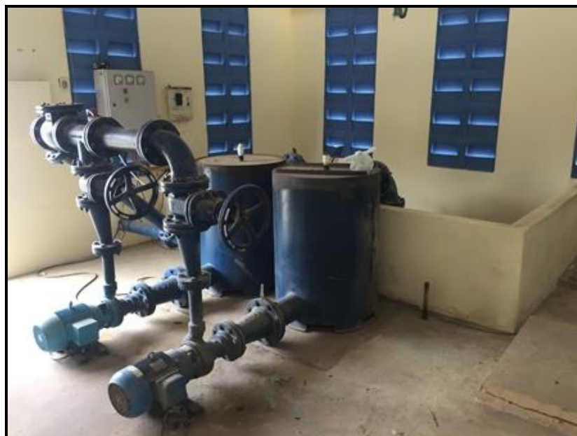
Figura 75 – Conjunto Motobomba – Conj Hab. Rosseti Andrade Fonte: Premier Engenharia, 2018.
