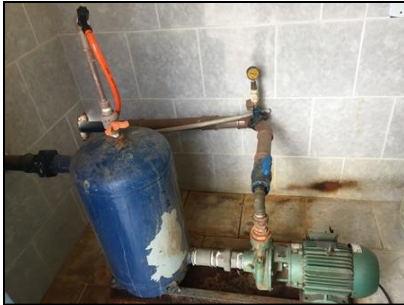
Figura 103- Conjunto Motobomba – Pov. Murici Fonte: Premier Engenharia, 2018.
