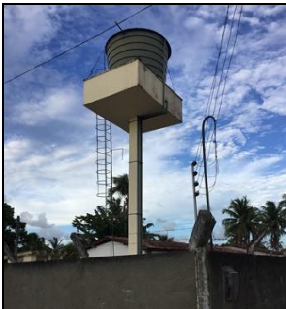
Figura 104- Reservatório – Pov. Murici Fonte: Premier Engenharia, 2018.
